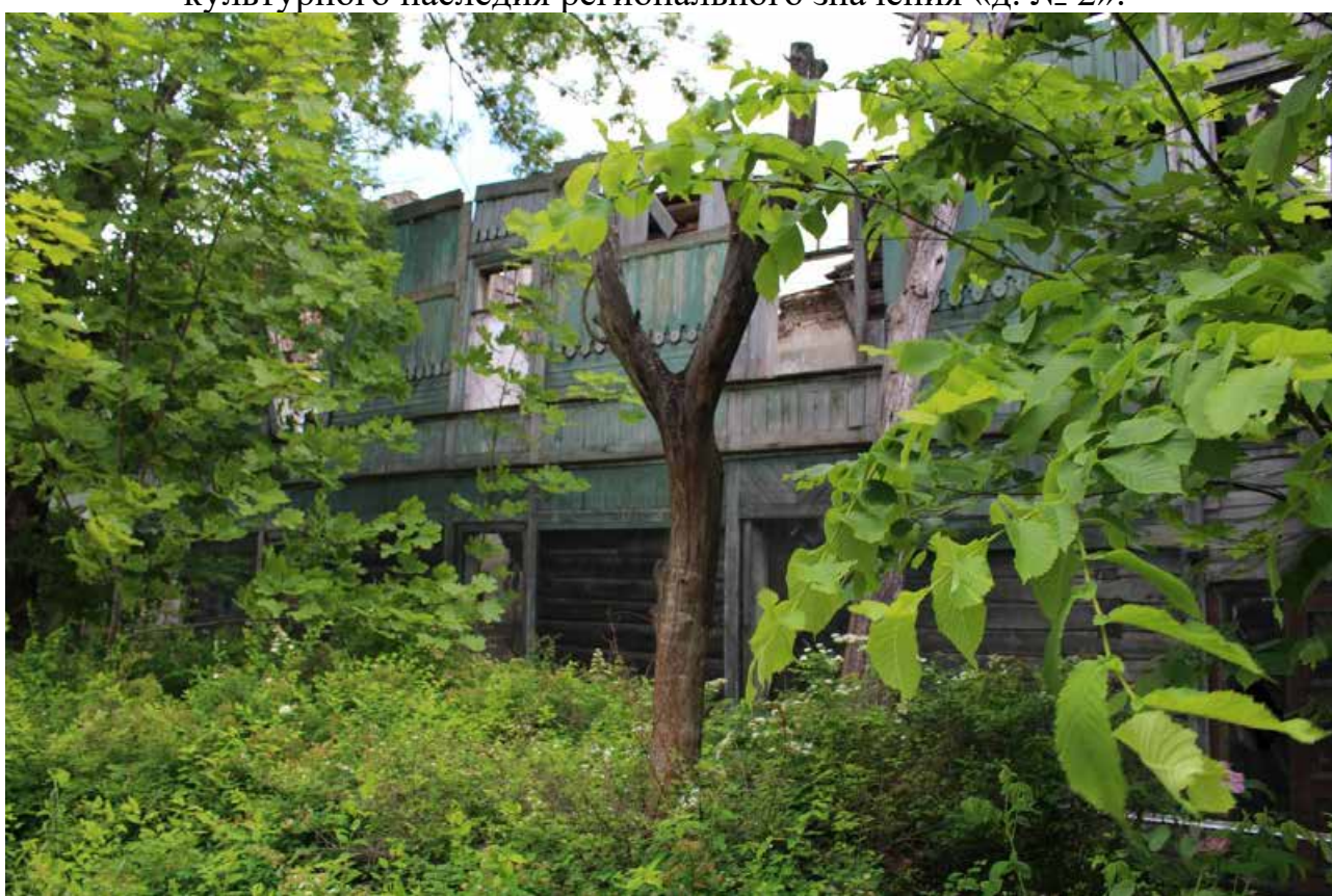
Фото 28. Вид на фрагмент (центральный) западного фасада объекта культурного наследия регионального значения «д. № 2».
