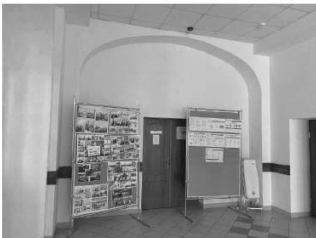
Фото №32. Забивка исторической светопрозрачной перегородки на втором этаже главного корпуса в осях 1-2.
