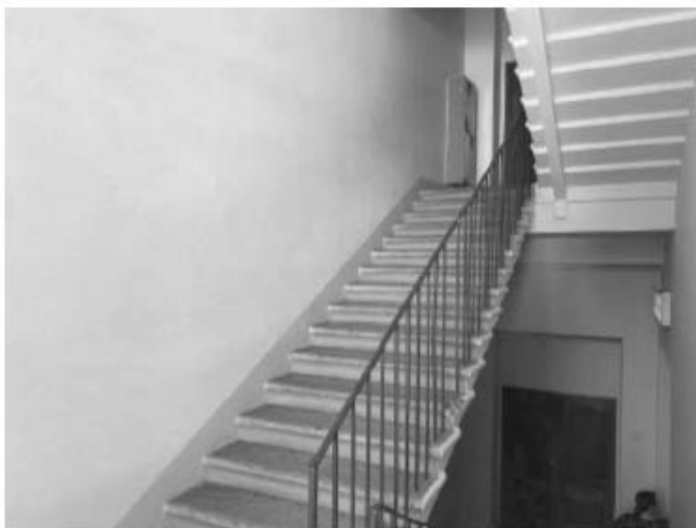
Фото №43. Запасная лестница центрального корпуса в осях 3-5, вид с площадки между этажами.
