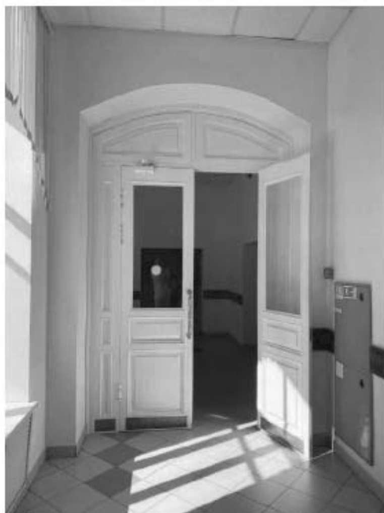
Фото №34. Заполнение дверного проема вестибюля второго этажа.
