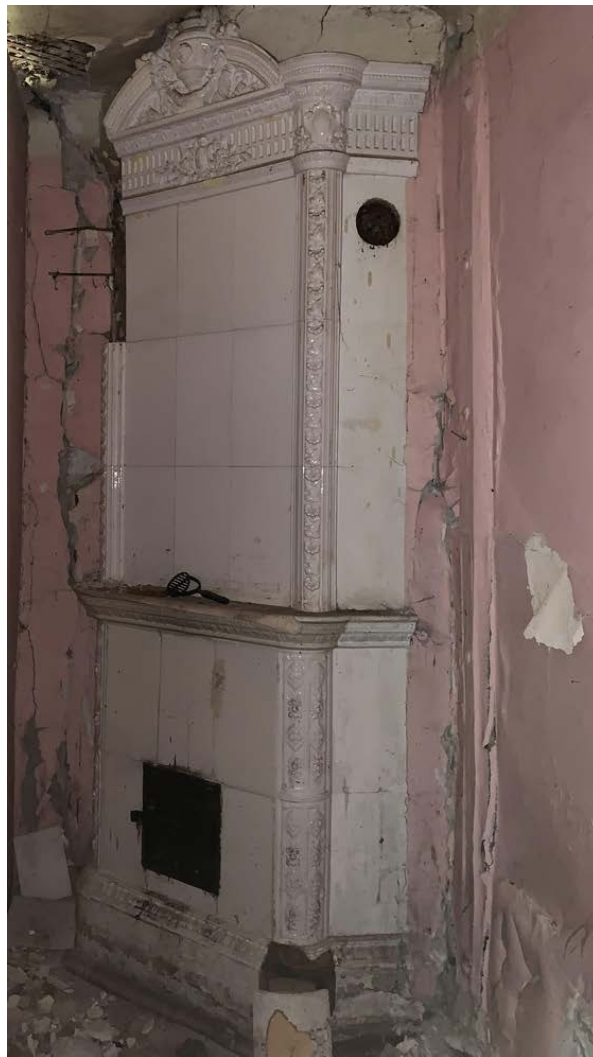
13. Печь в помещении 1-го этажа (пом. 1-Н (7)). 03.06.2022
