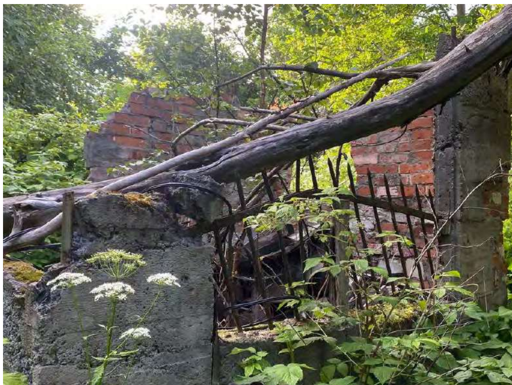
Фото №19. Фрагменты кирпичной постройки (габаритами ок. 2,5х2,5 м) вдоль восточной границы территории объекта, вид в направлении с востока на запад.
