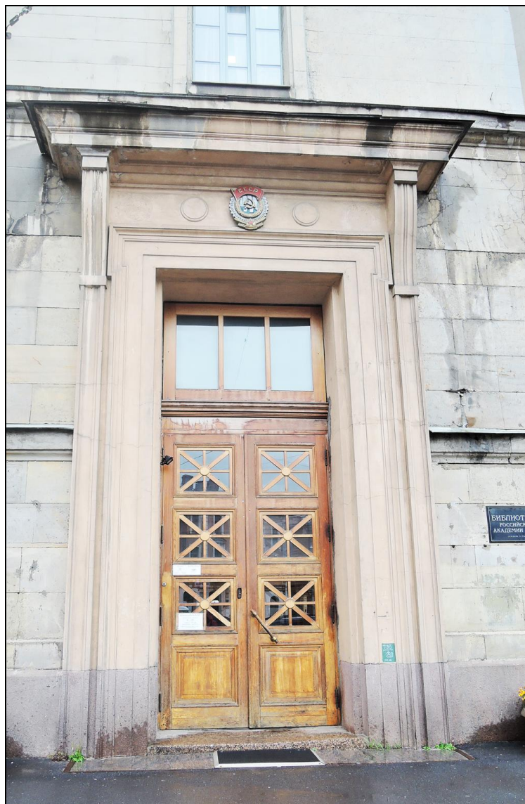
3. Выявленный объект культурного наследия «Здание Библиотеки Академии наук», расположенный по адресу: г. Санкт-Петербург, Василеостровский район, Биржевая линия, д. 1, Тифлисская ул., д. 1, литера А. Главный (южный) фасад. Портал главного входа.
