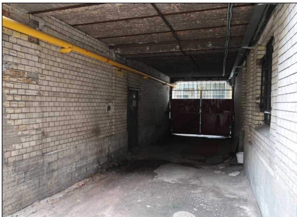
13. Выявленный объект культурного наследия «Здание Библиотеки Академии наук», расположенный по адресу: г. Санкт-Петербург, Василеостровский район, Биржевая линия, д. 1, Тифлисская ул., д. 1, литера А. Арочный проезд. Общий вид.
