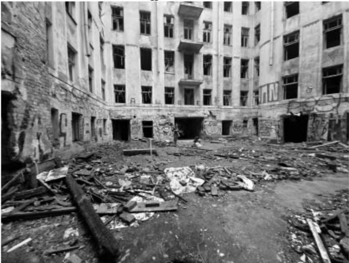
Рис. 22. СПб-2022. Петроградский район, Большая Пушкарская ул., д. 7. Общий вид участка обследования. Точка фотофиксации 1. Вид с севера
