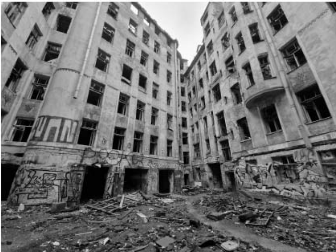
Рис. 23. СПб-2022. Петроградский район, Большая Пушкарская ул., д. 7. Общий вид участка обследования. Точка фотофиксации 2. Вид с севера
