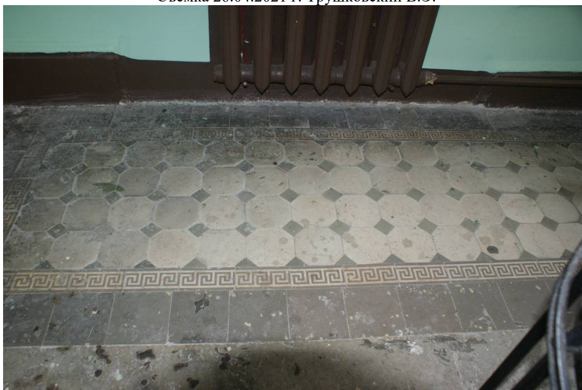
Фото 171. Лестница № 1: Площадка между 4-м и 5-м этажом. Покрытие пола.
