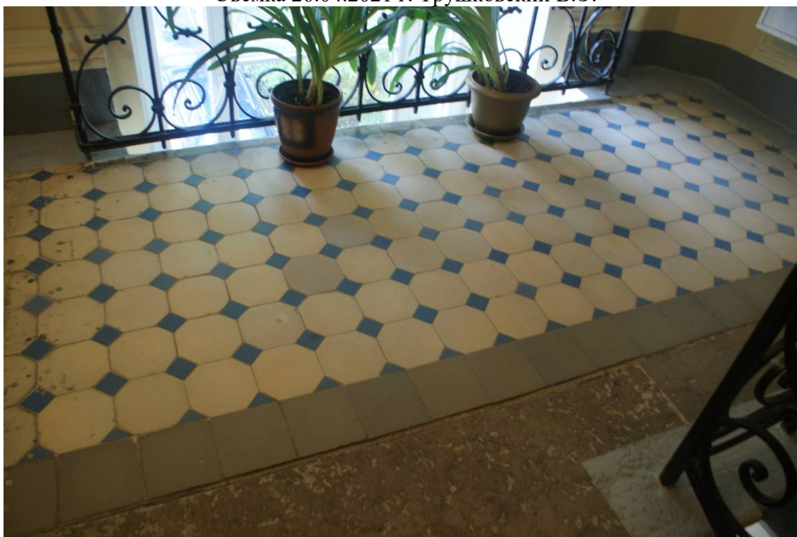
Фото 246. Лестница № 1: Смежная площадка 2-го этажа. Покрытие пола. Съемка 26.04.2021 г. Трушковский В.Э.
