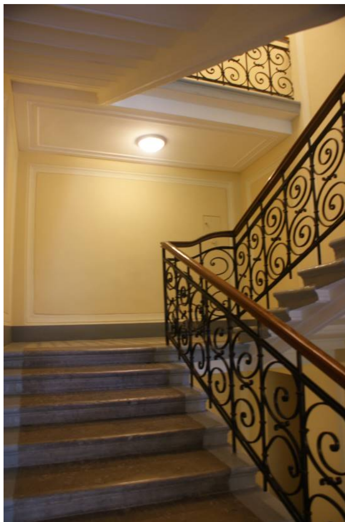
Фото 247. Лестница № 1: Площадка между 2-м и 3-м этажом. Съемка 26.04.2021 г. Трушковский В.Э.
