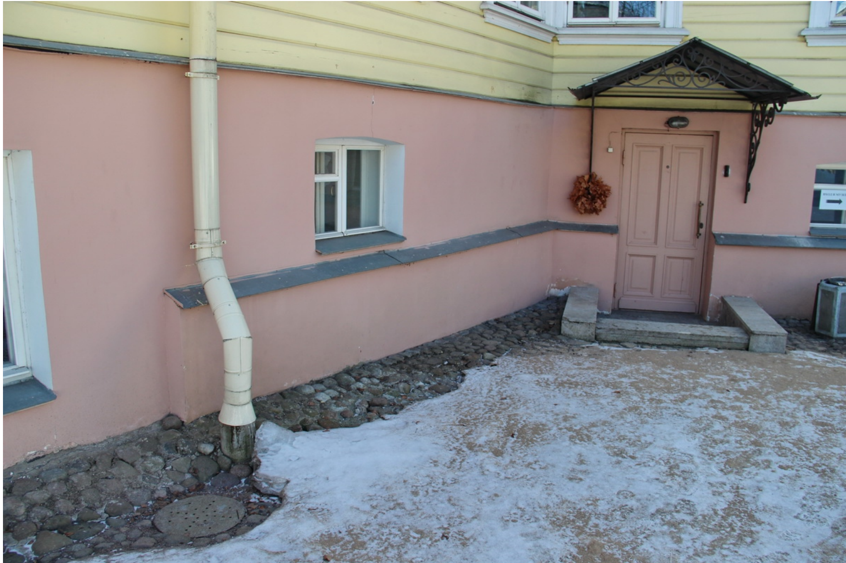
23 ОКН федерального значения "Дом Китаева Я. с оградой и садом. Здесь в 1831 г. жил поэт Пушкин А.С.» Санкт-Петербург, г. Пушкин, Пушкинская ул., д. 2/19, лит. А Северо-восточный дворовый фасад. Фрагмент Дата съемки: 01.04.2022 Фото Д.А. Зайцевой
