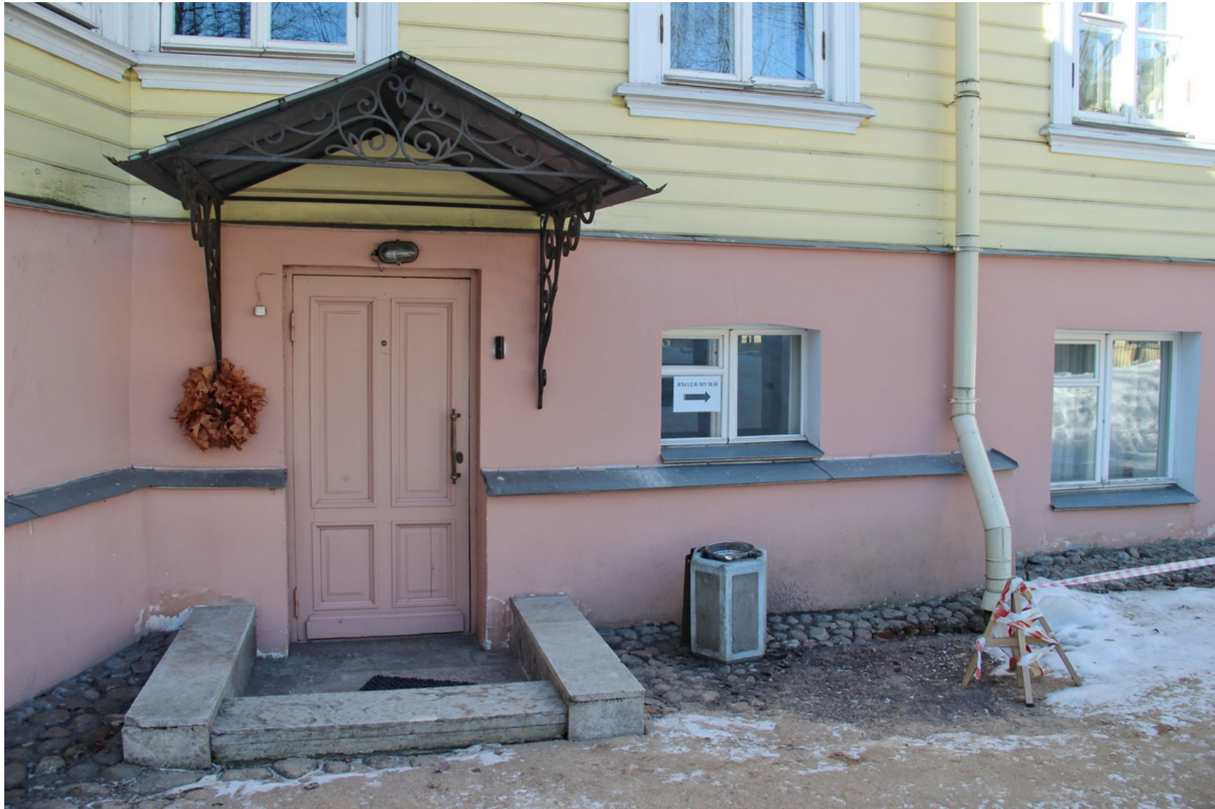
25 ОКН федерального значения "Дом Китаева Я. с оградой и садом. Здесь в 1831 г. жил поэт Пушкин А.С.» Санкт-Петербург, г. Пушкин, Пушкинская ул., д. 2/19, лит. А Восточный дворовый фасад. Фрагмент Дата съемки: 01.04.2022 Фото Д.А. Зайцевой
