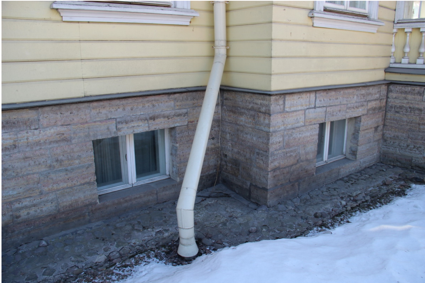
8 ОКН федерального значения "Дом Китаева Я. с оградой и садом. Здесь в 1831 г. жил поэт Пушкин А.С.» Санкт-Петербург, г. Пушкин, Пушкинская ул., д. 2/19, лит. А Западный фасад. Фрагмент Дата съемки: 01.04.2022 Фото Д.А. Зайцевой
