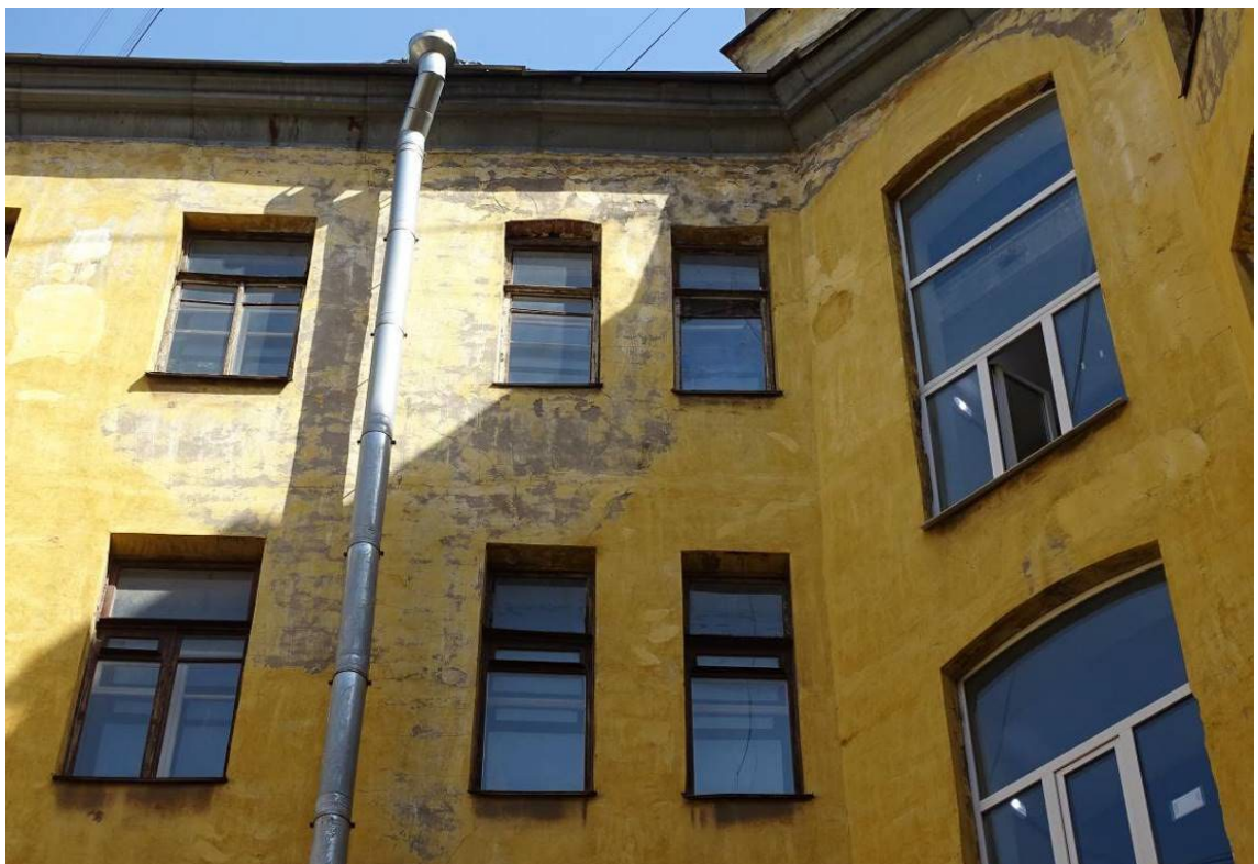
Фото 86. Здание по адресу: г. Санкт-Петербург, Коломенская ул., 14, литера Б. Фрагмент восточного фасада внутреннего двора. 4-й и 5-й этажи. Съемка 26.04.2021 г. Трушковский В.Э.
