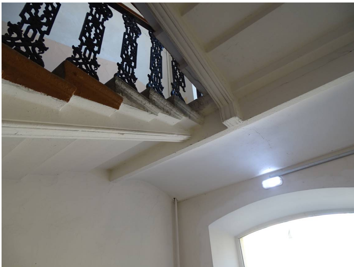
Фото 289. Лестница №4. Площадка между 3-м и 4-м этажом. Перекрытие в виде цилиндрического свода. Съемка 26.04.2021 г. Трушковский В.Э.
