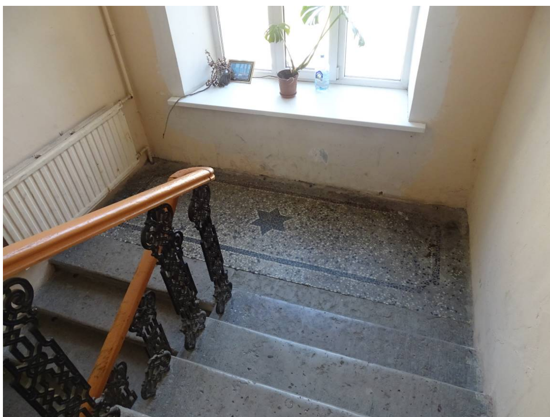
Фото 292. Лестница №4. Площадка между 4-м и 5-м этажом. Покрытие террасо. Съемка 26.04.2021 г. Трушковский В.Э.
