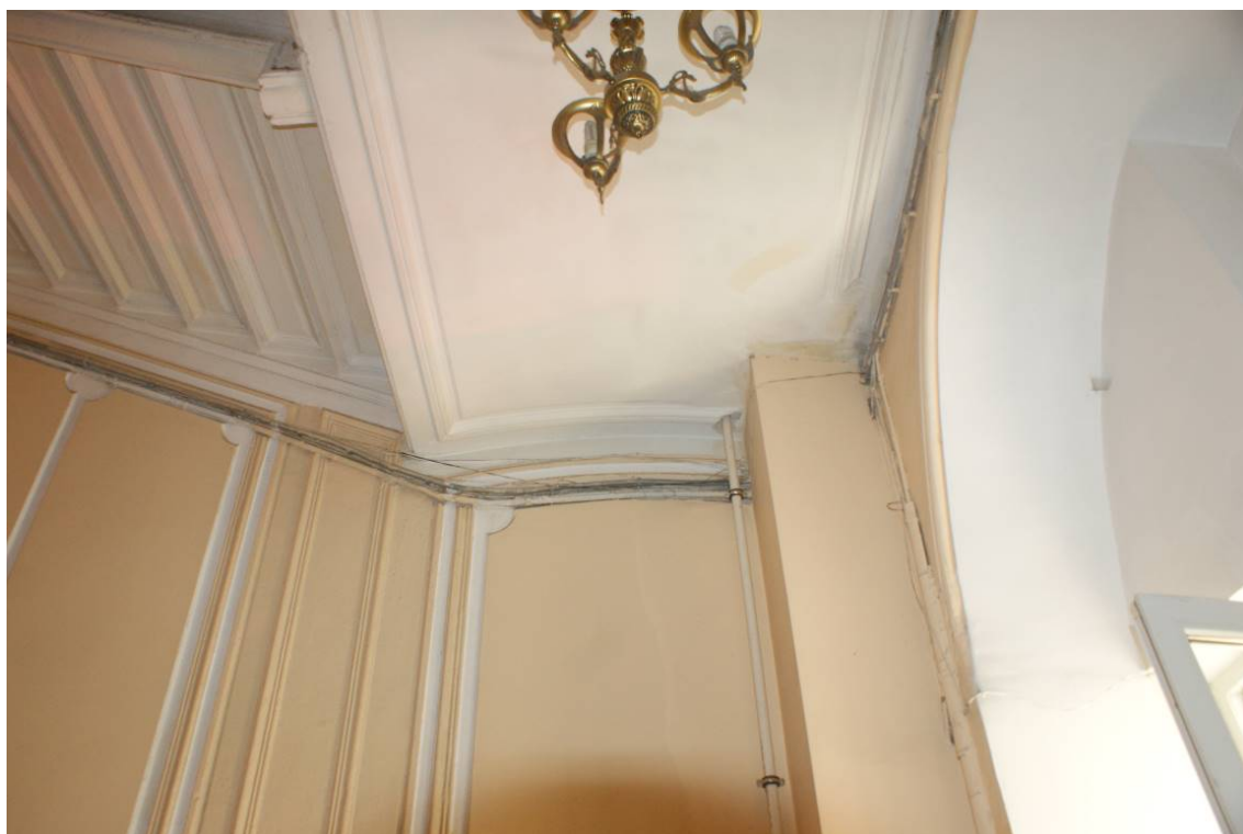
Фото 161. Лестница №1. Площадка между 1-м и 2-м этажом. Съемка 26.04.2021 г. Трушковский В.Э.
