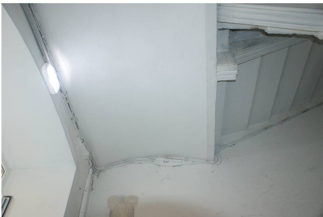
Фото 205. Лестница №2. Площадка между 1-м и 2-м этажом. Перекрытие из цилиндрического сводика. Съемка 26.04.2021 г. Трушковский В.Э.
