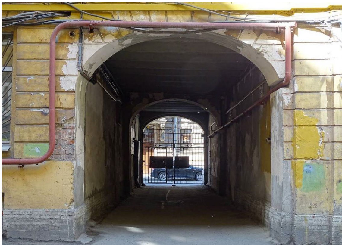
Фото 77. Здание по адресу: г. Санкт-Петербург, Коломенская ул., 14, литера Б. Западный воротный проезд. Вид со двора. Съемка 26.04.2021 г. Трушковский В.Э.
