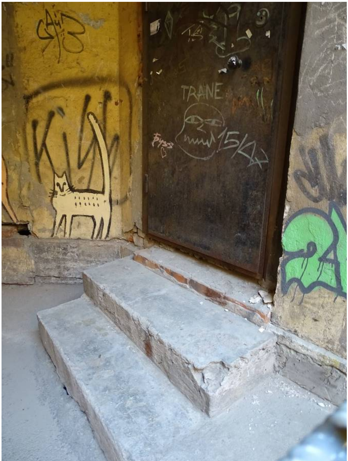
Фото 99. Здание по адресу: г. Санкт-Петербург, Коломенская ул., 14, литера Б. Ступени ко входу в сквозном проходе. Съемка 26.04.2021 г. Трушковский В.Э.
