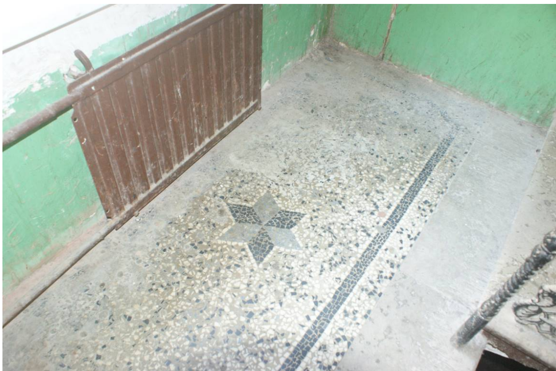
Фото 204. Лестница №2. Площадка между 1-м и 2-м этажом. Покрытие террацо. Съемка 26.04.2021 г. Трушковский В.Э.
