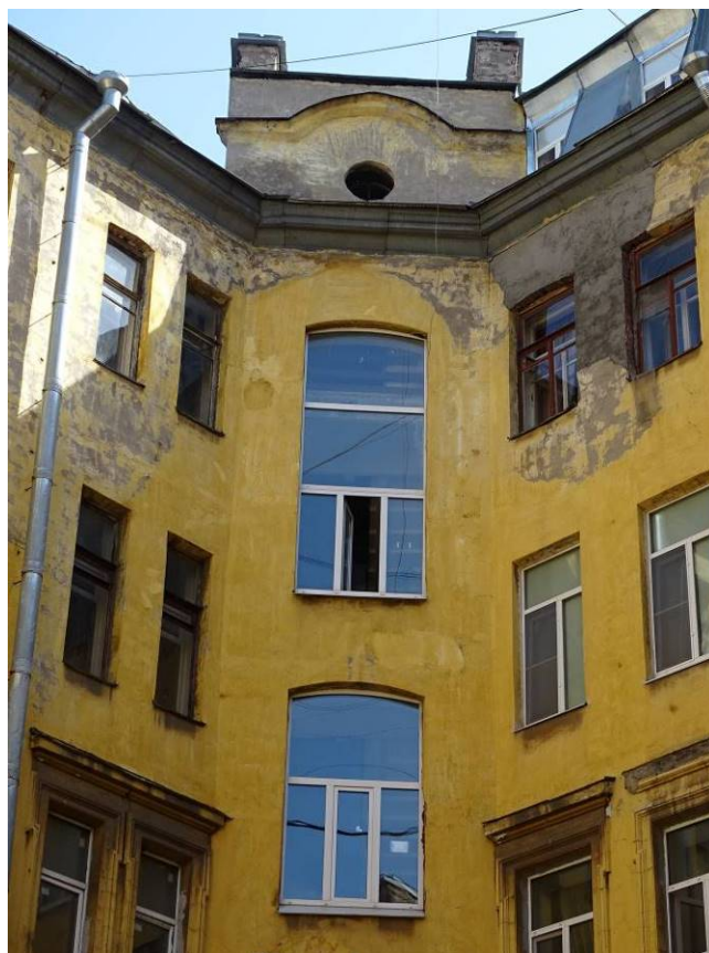
Фото 83. Здание по адресу: г. Санкт-Петербург, Коломенская ул., 14, литера Б. Фрагмент восточного фасада внутреннего двора. Лестница №2. 4-й и 5-й этажи. Съемка 26.04.2021 г. Трушковский В.Э.
