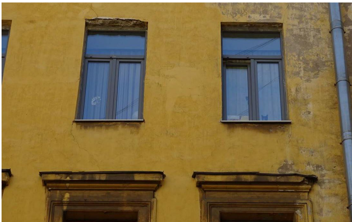
Фото 79. Здание по адресу: г. Санкт-Петербург, Коломенская ул., 14, литера Б. Фрагмент восточного фасада внутреннего двора. Окна 4-го этажа. Съемка 26.04.2021 г. Трушковский В.Э.
