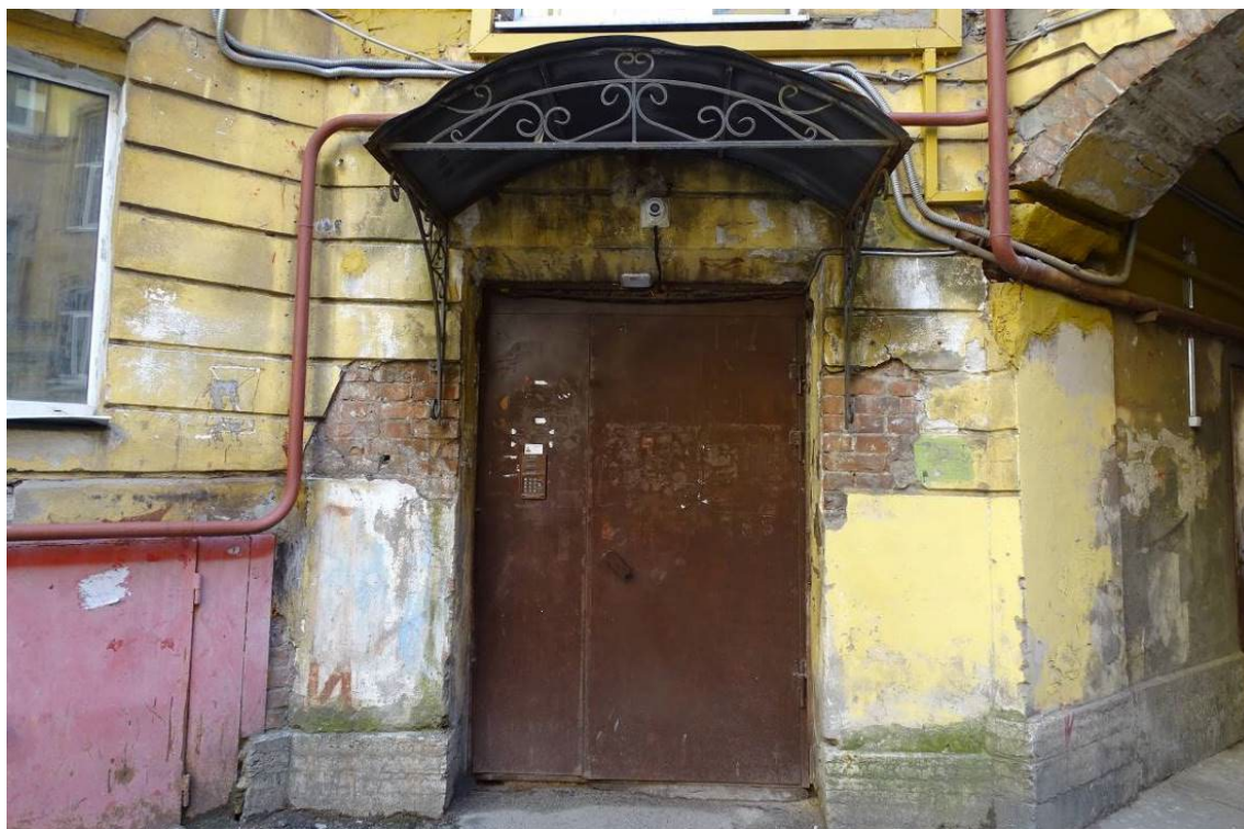
Фото 84. Здание по адресу: г. Санкт-Петербург, Коломенская ул., 14, литера Б. Фрагмент восточного фасада внутреннего двора. Дверной проем лестничной клетки №2. Съемка 26.04.2021 г. Трушковский В.Э.
