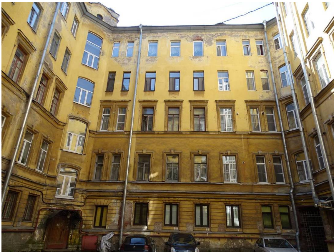
Фото 95. Здание по адресу: г. Санкт-Петербург, Коломенская ул., 14, литера Б. Южный фасад внутреннего двора. Съемка 26.04.2021 г. Трушковский В.Э.
