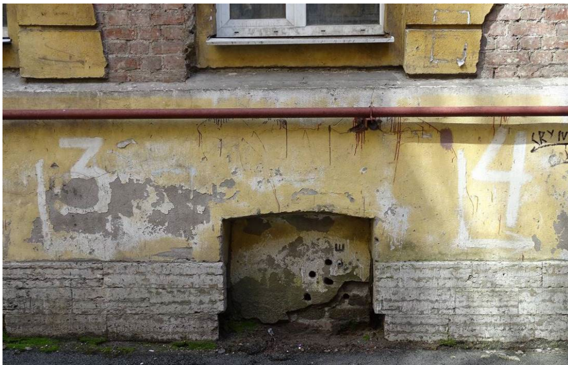
Фото 90. Здание по адресу: г. Санкт-Петербург, Коломенская ул., 14, литера Б. Фрагмент северного фасада внутреннего двора. Подвальный этаж. Съемка 26.04.2021 г. Трушковский В.Э.
