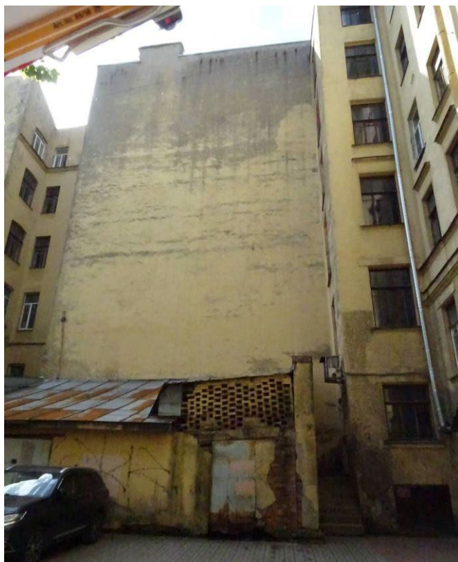
Фото 117. Здание по адресу: г. Санкт-Петербург, Коломенская ул., 14, литера Б. Фрагмент северного фасада. Съемка 26.04.2021 г. Трушковский В.Э.
