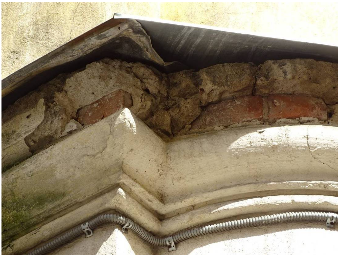
Фото 115. Здание по адресу: г. Санкт-Петербург, Коломенская ул., 14, литера Б. Фрагмент восточного фасада. Профилированная межэтажная тяга. Съемка 26.04.2021 г. Трушковский В.Э.
