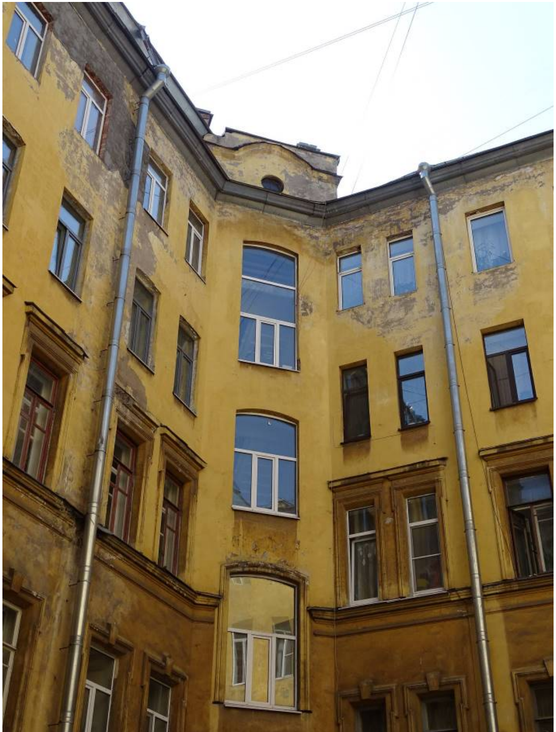
Фото 91. Здание по адресу: г. Санкт-Петербург, Коломенская ул., 14, литера Б. Фрагмент восточного и южного фасада внутреннего двора. Лестница №4. 3-й, 4-й, 5-й этажи. Съемка 26.04.2021 г. Трушковский В.Э.
