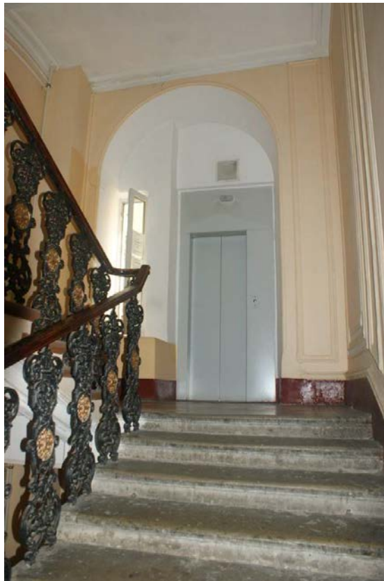
Фото 166. Лестница №1. Площадка между 2-м и 3-м этажом. Съемка 26.04.2021 г. Трушковский В.Э.
