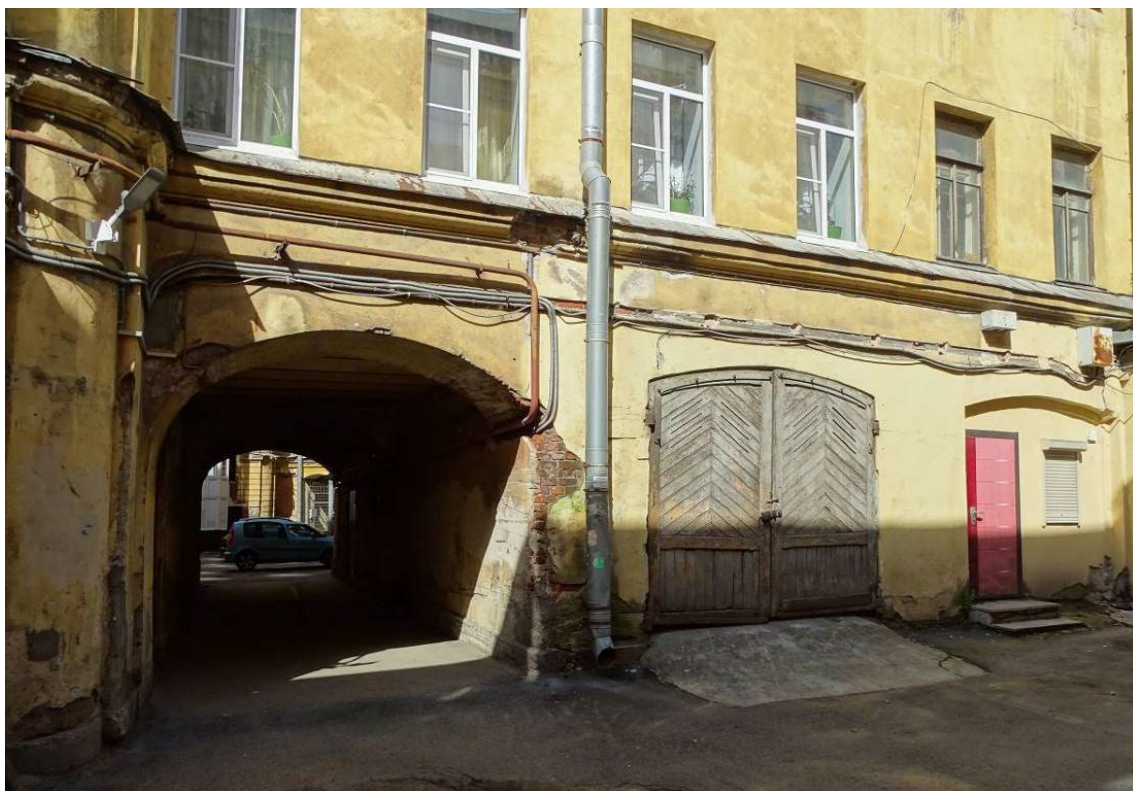
Фото 109. Здание по адресу: г. Санкт-Петербург, Коломенская ул., 14, литера Б. Фрагмент восточного фасада. Воротный проезд, 1-й и 2-й этажи. Съемка 26.04.2021 г. Трушковский В.Э.
