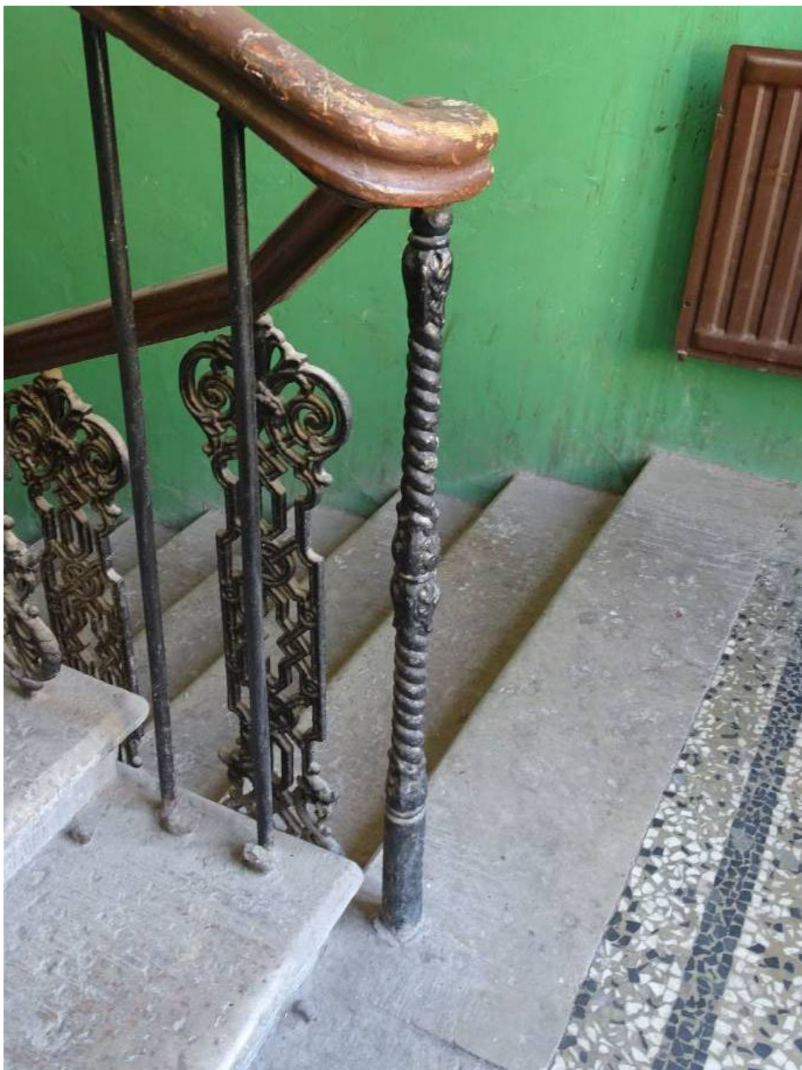
Фото 216. Лестница №2. Площадка между 3-м и 4-м этажом. Лестничное ограждение. Съемка 26.04.2021 г. Трушковский В.Э.
