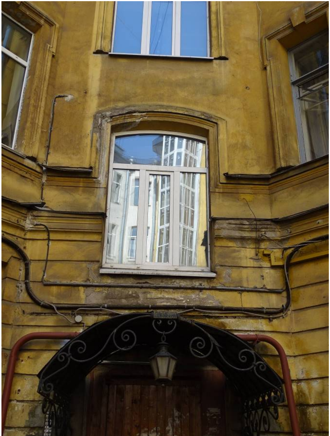
Фото 92. Здание по адресу: г. Санкт-Петербург, Коломенская ул., 14, литера Б. Фрагмент южного фасада внутреннего двора. Лестница №4. 2-й этаж Съемка 26.04.2021 г. Трушковский В.Э.
