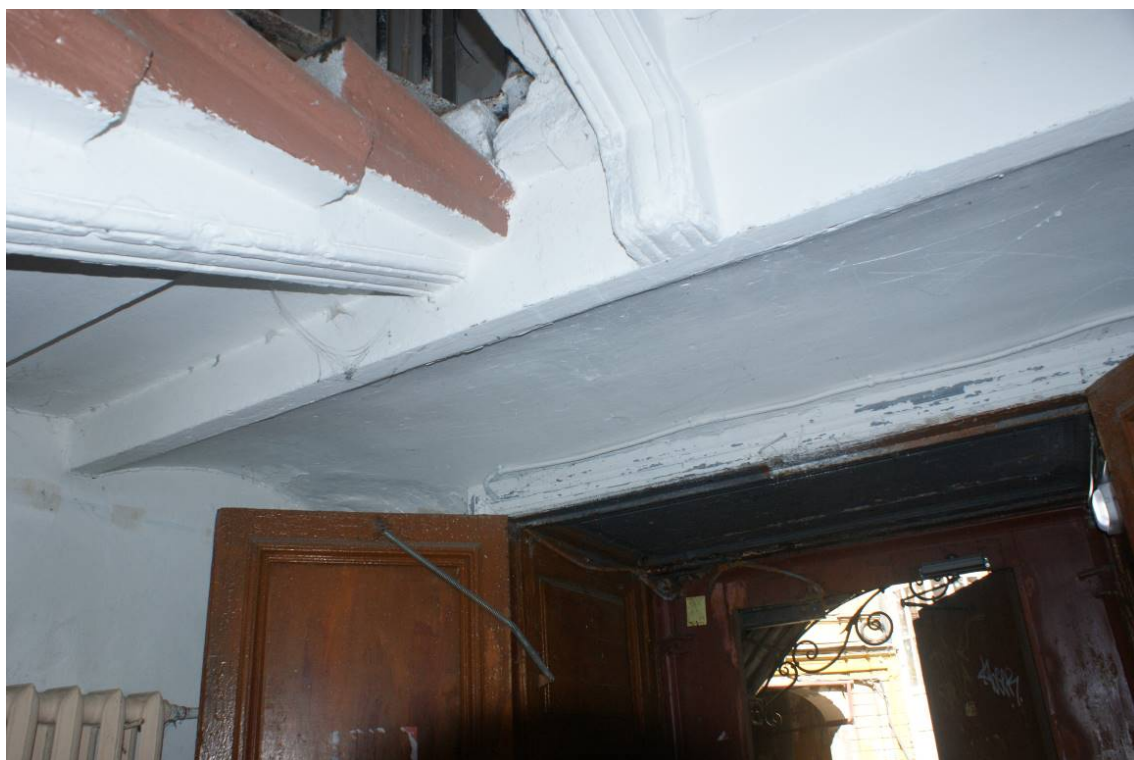
Фото 271. Лестница №4. 1 этаж. Межэтажное перекрытие между 1-м и 2-м этажом. Съемка 26.04.2021 г. Трушковский В.Э.
