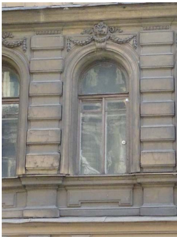
Фото 73. Здание по адресу: г. Санкт-Петербург, Коломенская ул., 14, литера Б. Фрагмент лицевого фасада. Оформление окна 2-го этажа. Съемка 26.04.2021 г. Трушковский В.Э.
