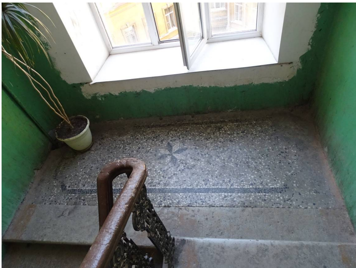
Фото 221. Лестница №2. Площадка между 4-м и 5-м этажом. Покрытие терраццо. Съемка 26.04.2021 г. Трушковский В.Э.
