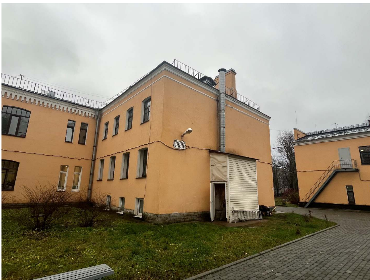
Фото №11. Северный фасад, фрагмент, поздние конструкции над приямок.
