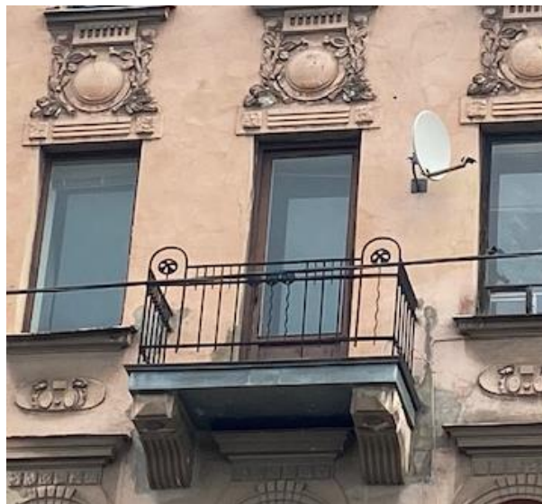
Фото.11,12 Выявленный объект культурного наследия «Дом К.И. Фасси и Л.А. Богусского» Вид на ограждения балконов 6-го 4 –ого этажа южной части лицевой фасада Сохранился исторический металлический декор.
