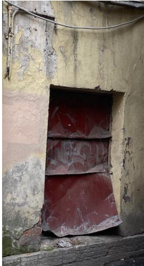
Фото 26. Выявленный объект культурного наследия «Дом К.И. Фасси и Л.А. Богусского» Вид на заполнения оконных проемов 1 этажа лестничной клетки №2 со стороны дворового фасада(МОП). Утрачены. Защиты металлическим листом.
