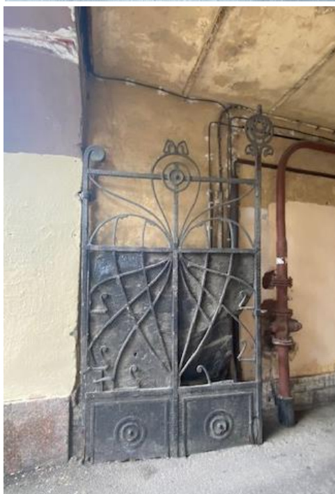
Фото 17,18 Выявленный объект культурного наследия «Дом К.И. Фасси и Л.А. Богусского» Вид на арочный проезд южной части лицевой фасада. Сохранился створ ворот кованого железа с орнаментом в стиле модерн. Один из створов утрачен. Наличие существования флагодержателей слева –справа от воротного проезда не подтверждается исторической иконографией.
