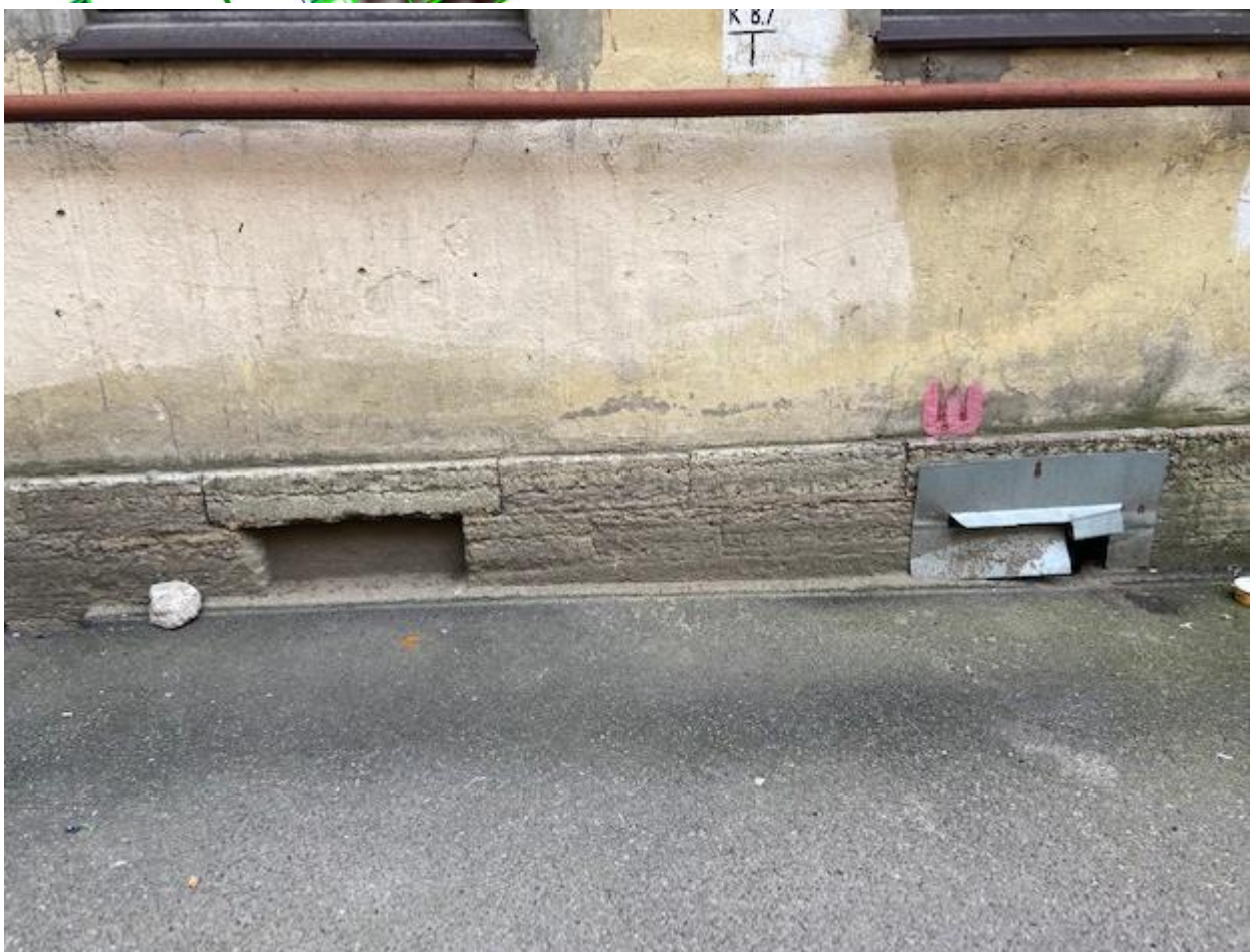
Фото 40. Выявленный объект культурного наследия «Дом К.И. Фасси и Л.А. Богусского» Отделка цоколя дворовых фасадов цоколя – известняковая плита; Оформление проемов подвальных окон разнородное. (заложены, защиты металлическим листом)
