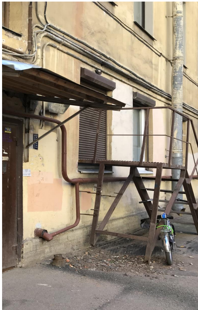
Фото 39. Выявленный объект культурного наследия «Дом К.И. Фасси и Л.А. Богусского» Справа от лестничной клетки 6 организована металлическая лестница. Отсутствует на планах ПИБ.
