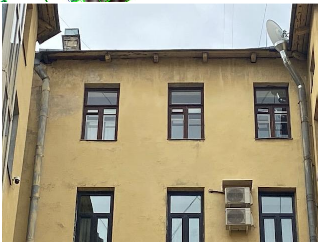
Фото 23 Выявленный объект культурного наследия «Дом К.И. Фасси и Л.А. Богусского» Вид на свесы крыши на деревянных «кобылках».
