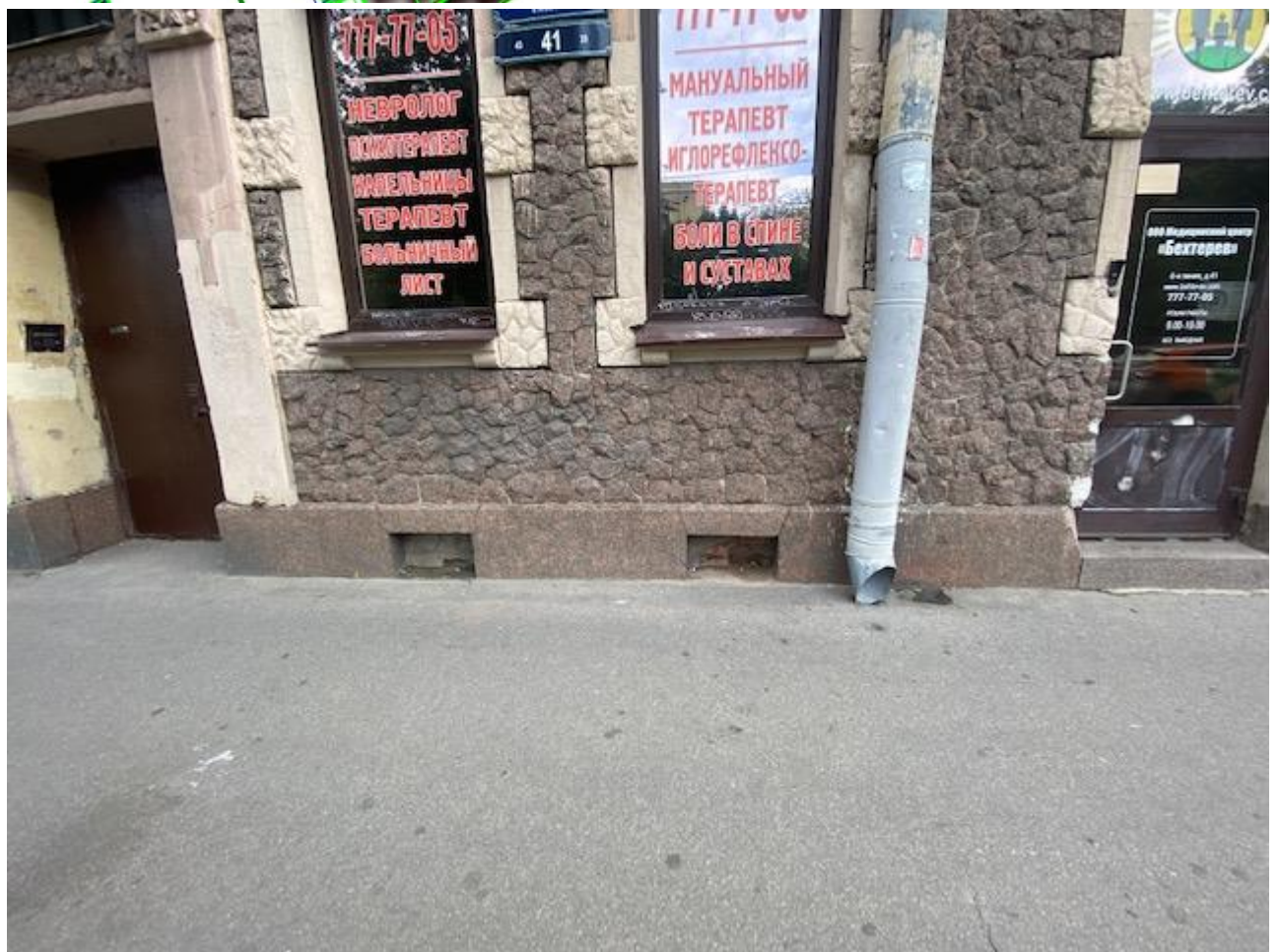
Фото 4. Выявленный объект культурного наследия «Дом К.И. Фасси и Л.А. Богусского» Вид на цоколь из тесаного красного гранита южной части лицевого фасада. Оконные проемы цокольного этажа заложены Облицовка 1-ого этажа выполнена колотым красным гранитом (щепой) – историческая. Заполнения оконных проемов 1 этажа утрачены (Материал, цвет и рисунок не соответствует предметам охраны).
