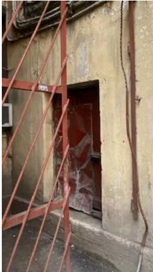
Фото 27. Выявленный объект культурного наследия «Дом К.И. Фасси и Л.А. Богусского» Вид на заполнения оконных проемов 1 этажа лестничной клетки №1 со стороны дворового фасада(МОП). Утрачены. Защиты металлическим листом.
