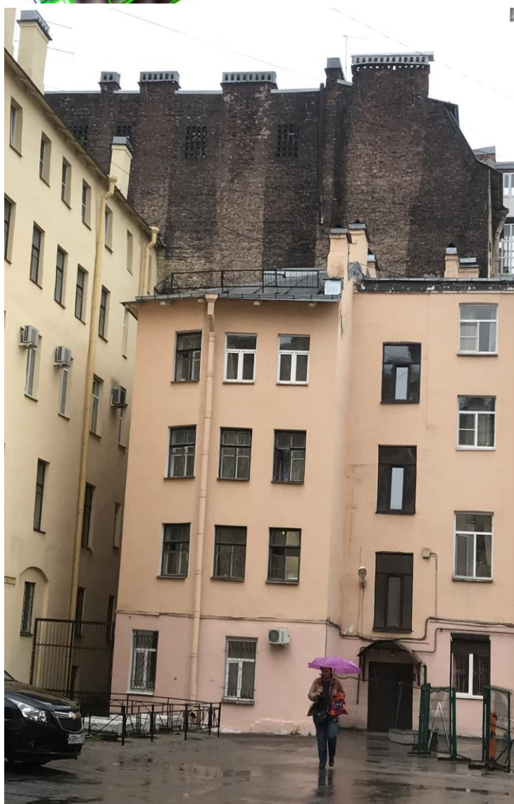
Фото 44 Выявленный объект культурного наследия «Дом К.И. Фасси и Л.А. Богусского» Общий вид внутреннего двора 3 со стороны дома №39 по 6-ой линии В.О.. Брандмауэрная стена из кирпича.
