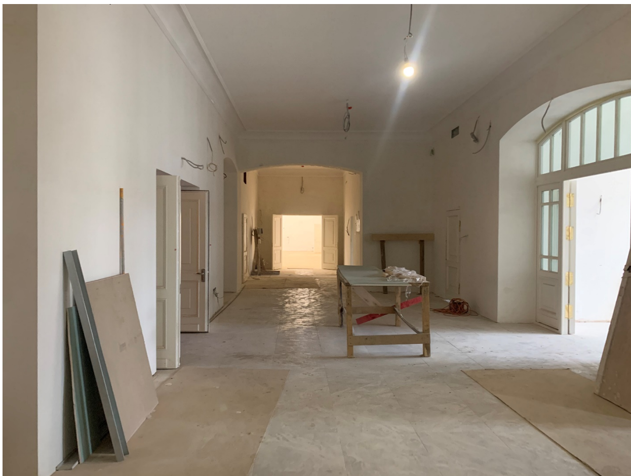
9. Помещения №9 и №3 в уровне 1-го этажа объекта культурного наследия регионального значения «Дом, где в 1917 г. начал работу VI съезд РСДРП(б)», расположенного по адресу: г. Санкт-Петербург, Большой Сампсониевский пр., д. 37, литера А. 12.04.2022
