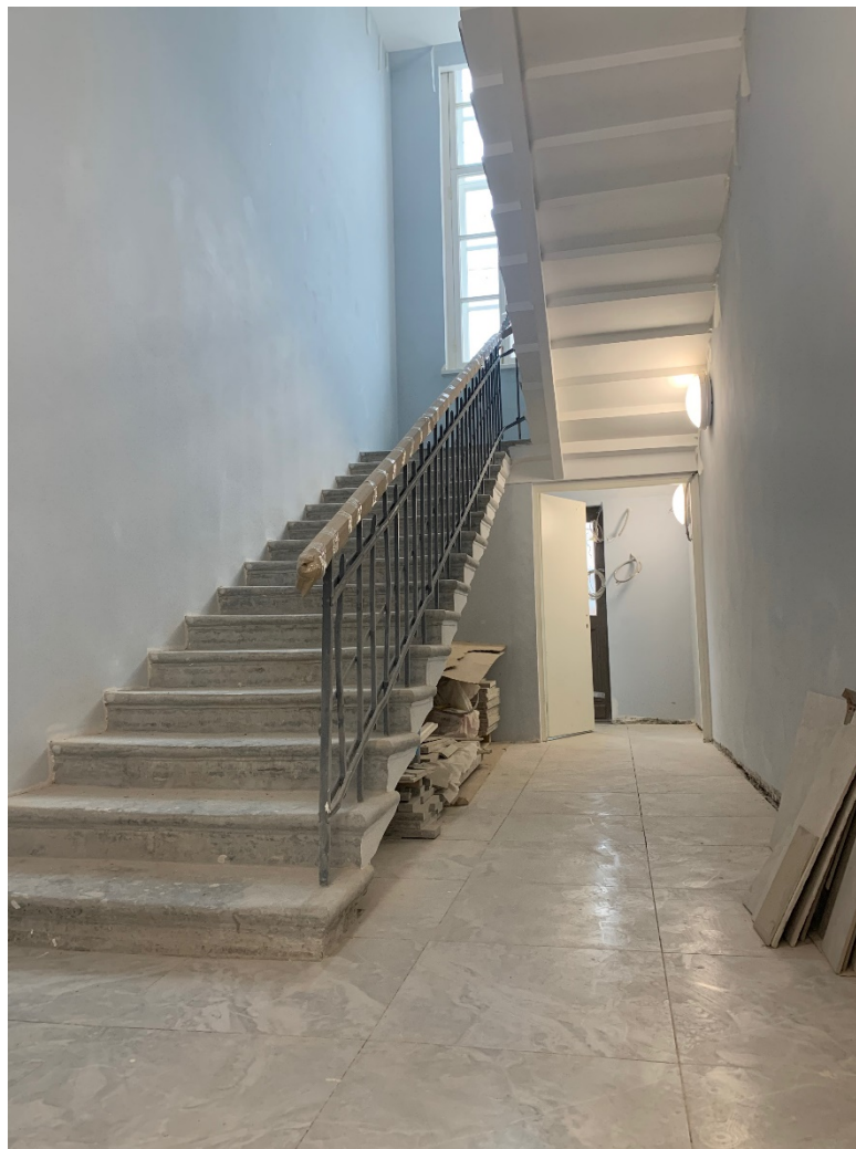
13. Лестничная клетка (пом. №36) в уровне 1-го этажа объекта культурного наследия регионального значения «Дом, где в 1917 г. начал работу VI съезд РСДРП(б)», расположенного по адресу: г. Санкт-Петербург, Большой Сампсониевский пр., д. 37, литера А. 12.04.2022
