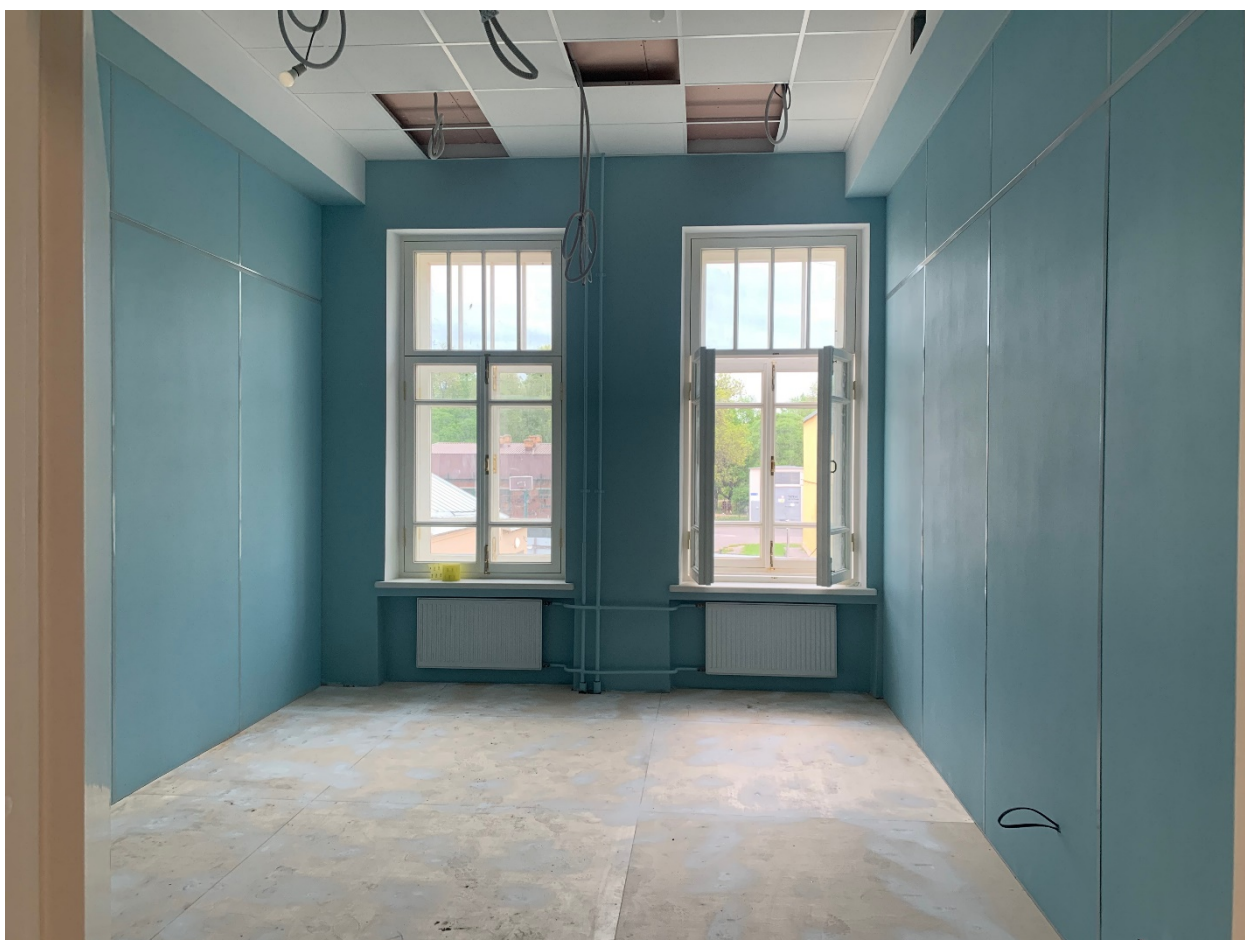
17. Помещение №52 в уровне 2-го этажа объекта культурного наследия регионального значения «Дом, где в 1917 г. начал работу VI съезд РСДРП(б)», расположенного по адресу: г. Санкт-Петербург, Большой Сампсониевский пр., д. 37, литера А. 12.04.2022
