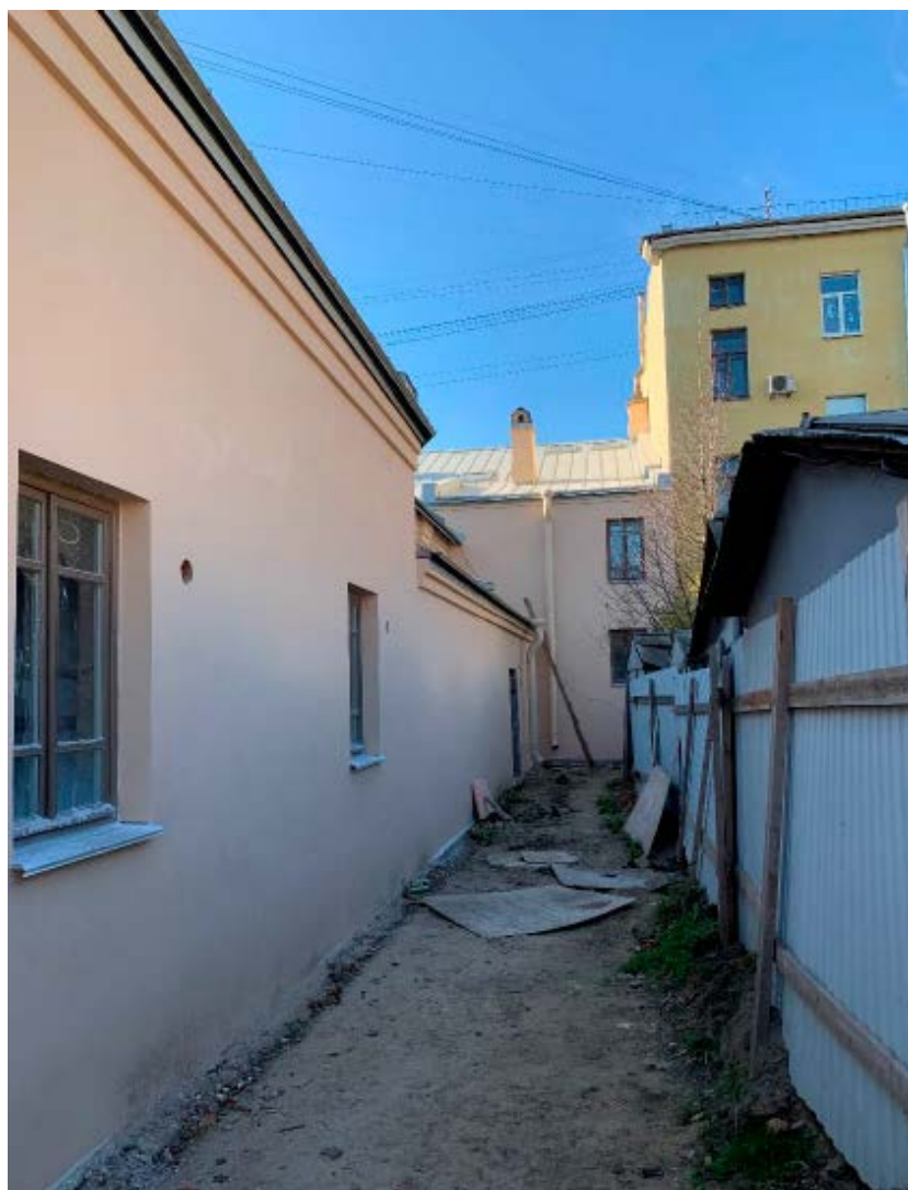
7. Северо-западный дворовый фасад объекта культурного наследия регионального значения «Дом, где в 1917 г. начал работу VI съезд РСДРП(б)», расположенного по адресу: г. Санкт-Петербург, Большой Сампсониевский пр., д. 37, литера А. 12.04.2022
