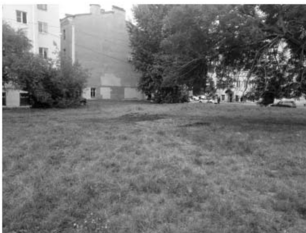
Илл. 16. Санкт-Петербург, Воронежская ул., уч. 45. Разведочный шурф после засыпки. Общий вид с юго-запада.
