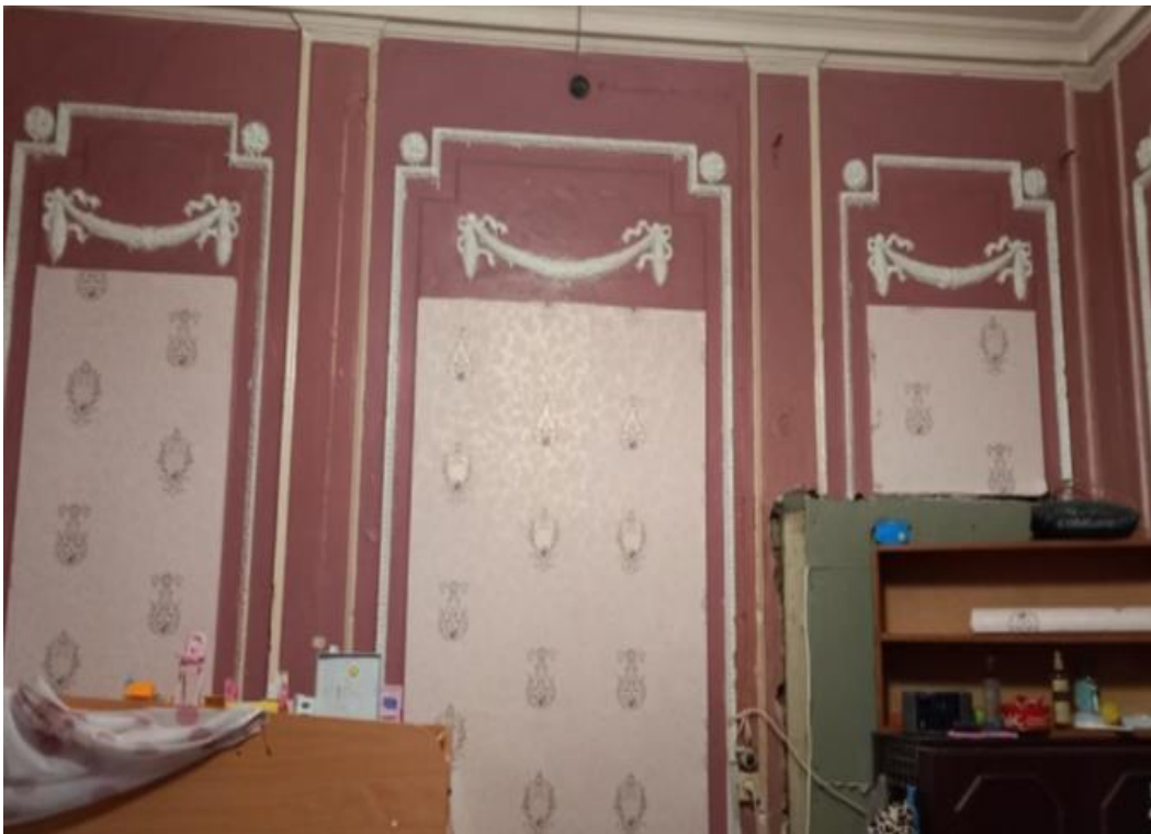
Фото 9. Выявленный объект культурного наследия «Дом Ф.П. Петрова (Д.Г. Лурье), расположенный по адресу: Санкт-Петербург, ул.Пионерская, дом 22, литера А. Квартира 4, помещение 8. Пилястры в обрамлении профилированных тяг, чередующиеся с фигурными филёнками, декорированными порезкой в виде иоников, с лепными вихревыми цветковыми розетками по углам и лепными провисающими лавровыми гирляндами с лентами; профилированный карниз в завершении стен.
