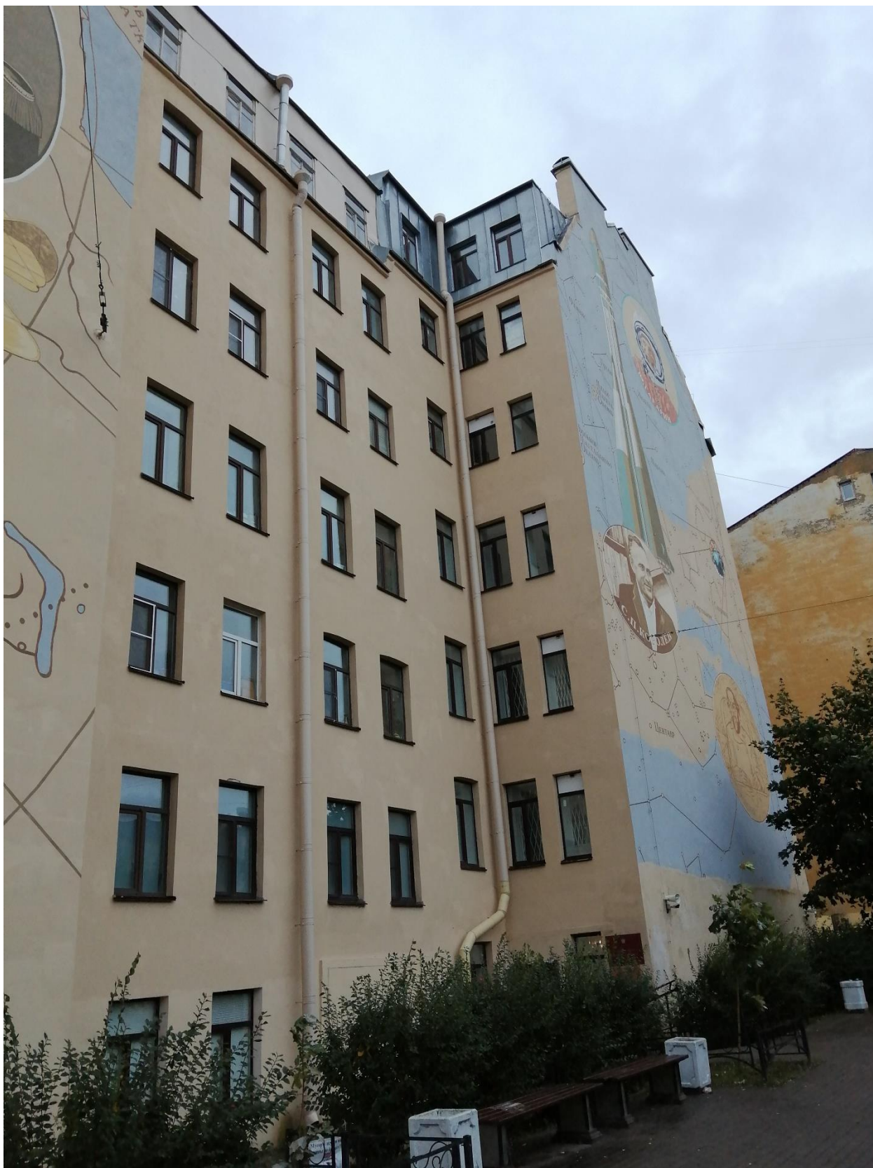
Фото 5 (экстерьер). Выявленный объект культурного наследия «Дом Ф.П. Петрова (Д.Г. Лурье)», расположенный по адресу: Санкт-Петербург, ул.Пионерская, дом 22, литера А. Брандмаурные глухие оштукатуренные стены северо-западного фасада, боковой северо-западный фасад. Материал и характер отделки фасадной поверхности - гладкая штукатурка.
