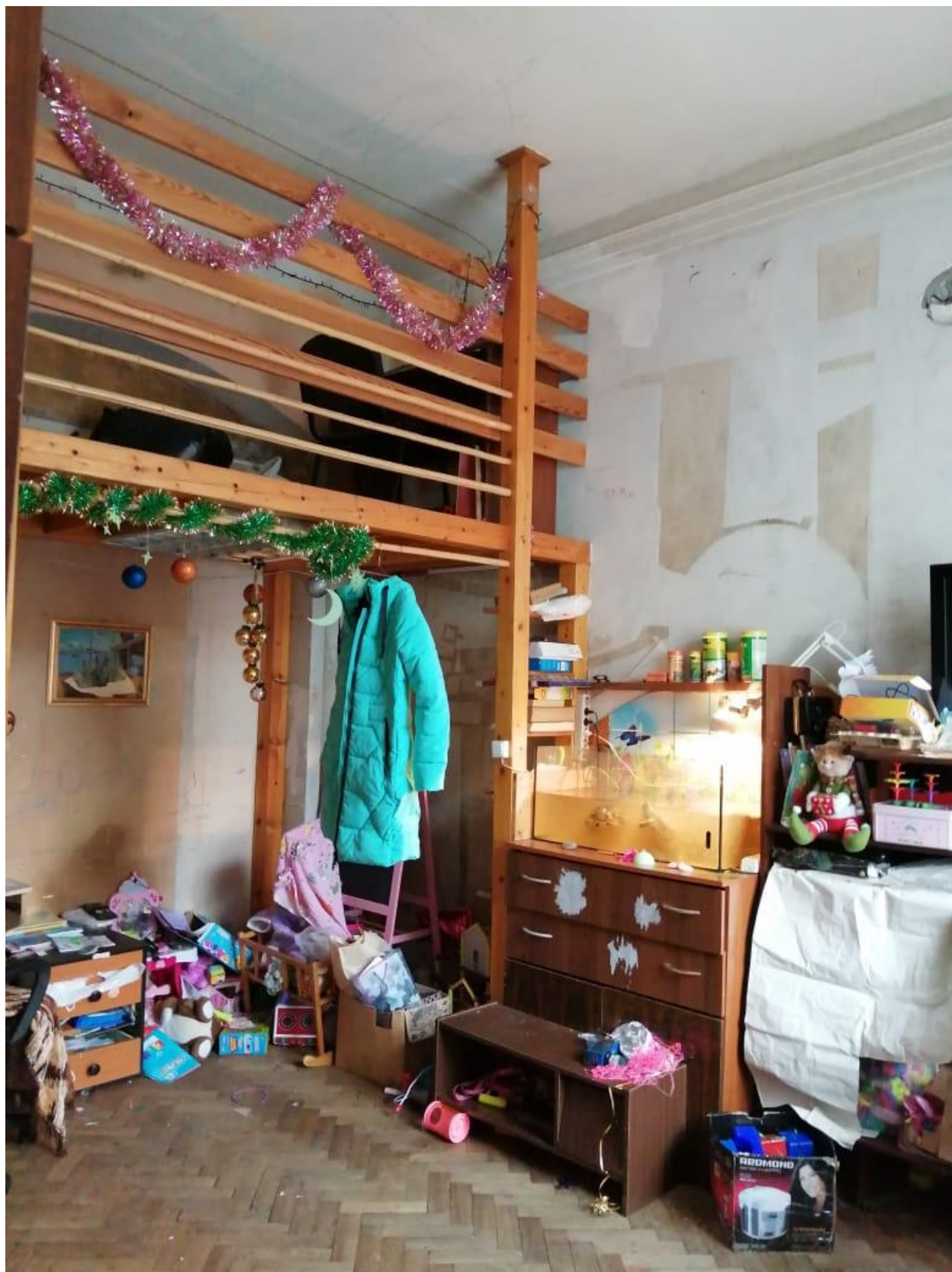
Фото 5. Выявленный объект культурного наследия «Дом Ф.П. Петрова (Д.Г. Лурье), расположенный по адресу: Санкт-Петербург, ул.Пионерская, дом 22, литера А. Квартира 4, помещение 7. Фрагмент 3.
