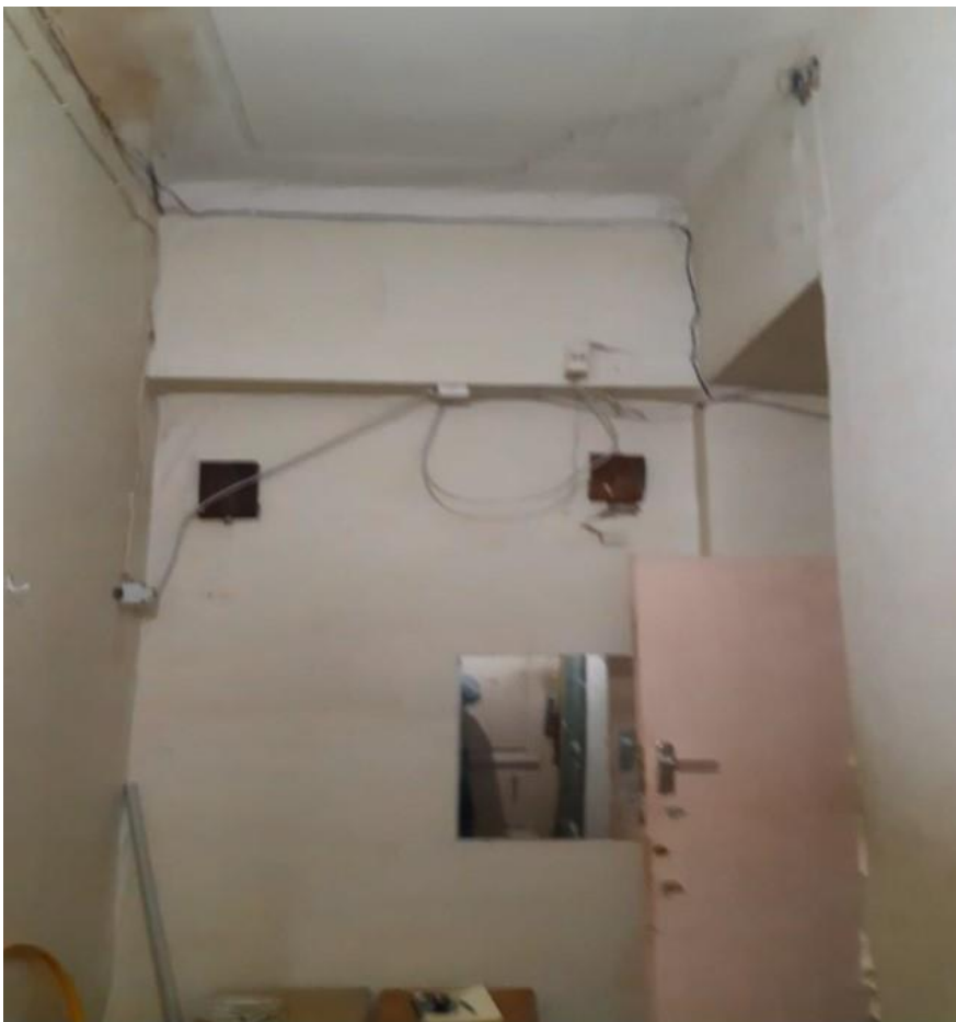
Фото 17. Выявленный объект культурного наследия «Дом Ф.П. Петрова (Д.Г. Лурье), расположенный по адресу: Санкт-Петербург, ул.Пионерская, дом 22, литера А. Квартира 4, помещение 11.
