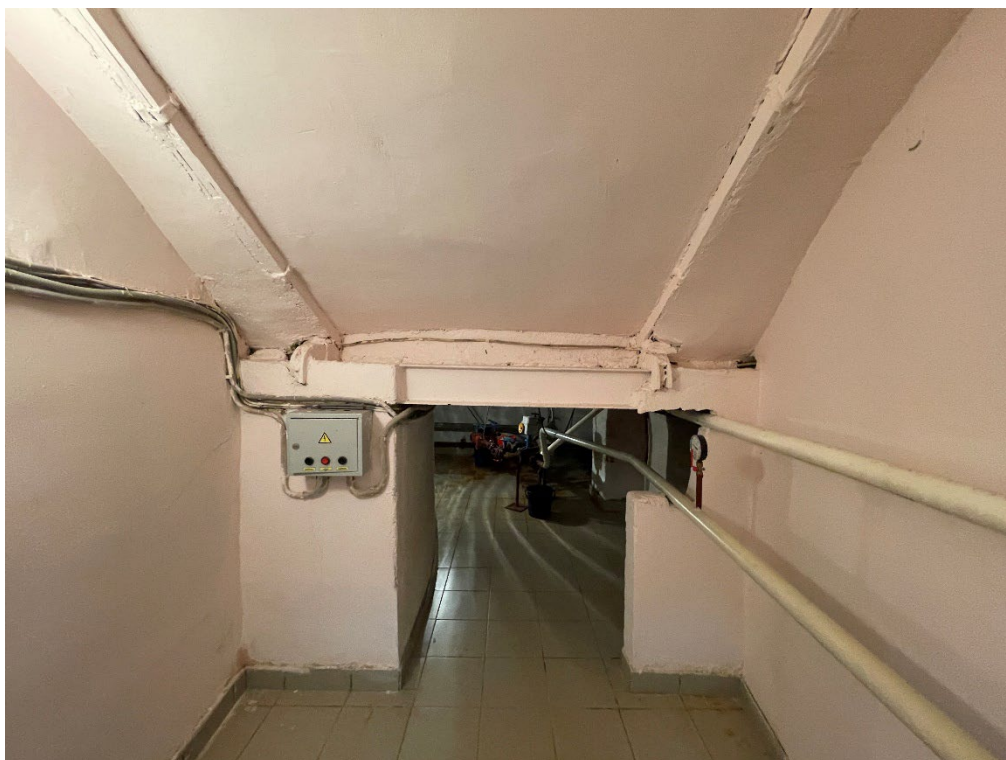
Фото №31. Подвал, помещение под парадной лестницей, лестничная площадка ж/б по металлическим балкам.
