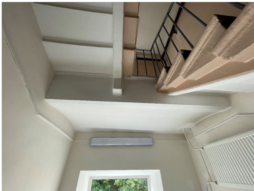
Фото №28. Службная известняковая лестница, примыкание лестничных маршей к междуэтажной площадке 2 и 3 этажа.
