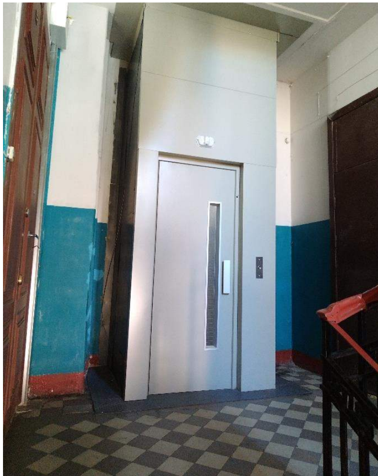
Фото №27. Парадная лестница №2. Лифт на четвертом этаже.
