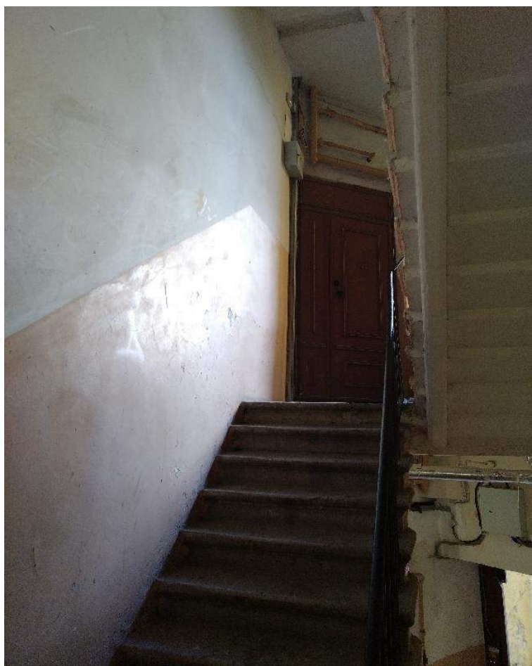
Фото №68. Парадная лестница №8. Лестничный марш, вид с междуэтажной площадки между 1 и 2 этажами.
