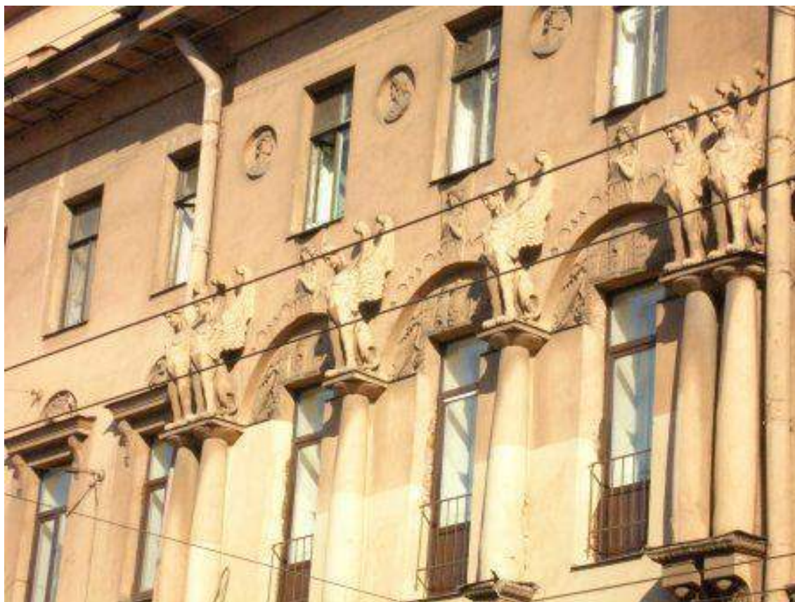
Илл.20. Фрагмент фасада – утрачены балконы. Фото – Shuba 2008 г. (Источник: https://p1.citywalls.ru/photo_5-5441.jpg?mt=1273625807 )
