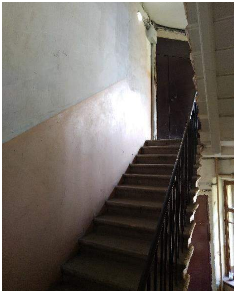
Фото №77. Парадная лестница №8. Вид на пятый этаж с междуэтажной площадки между 4 и 5 этажами.
