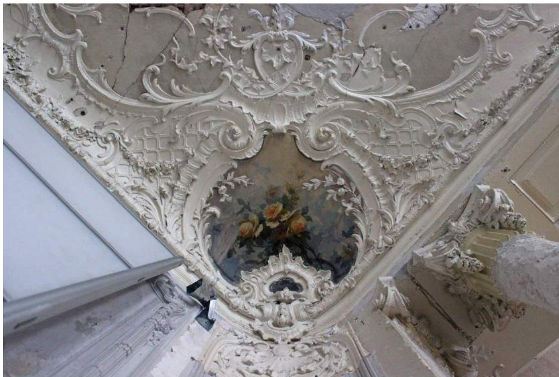
Илл.38. Левая парадная. Квартиры. На 3 этаже. Фото Олега Еверзова, 04.2017 (Источник: https://p1.citywalls.ru/photo_381-391157.jpg?mt=1555105952 )
