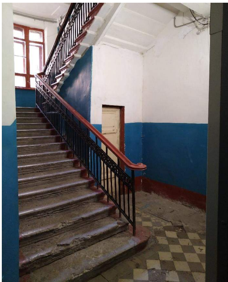
Фото №18. Парадная лестница №2. Лестничный марш и междуэтажная площадка, вид с первого этажа.
