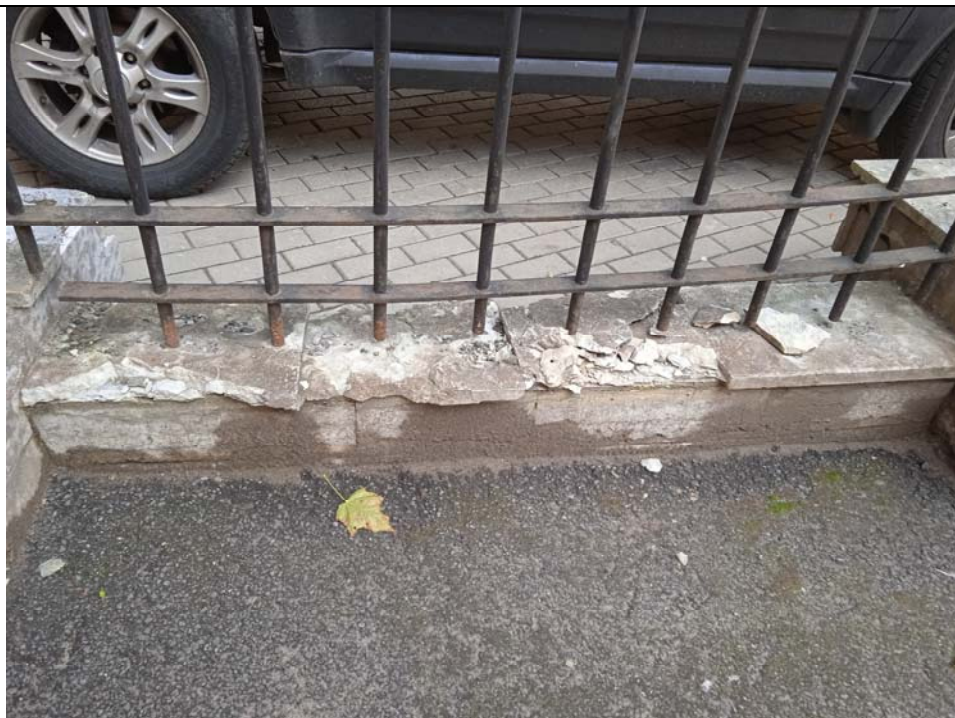
7. Особняк Горчакова К.А. Ограда по линии улицы. Фрагмент. Разрушение известняковой облицовки.
