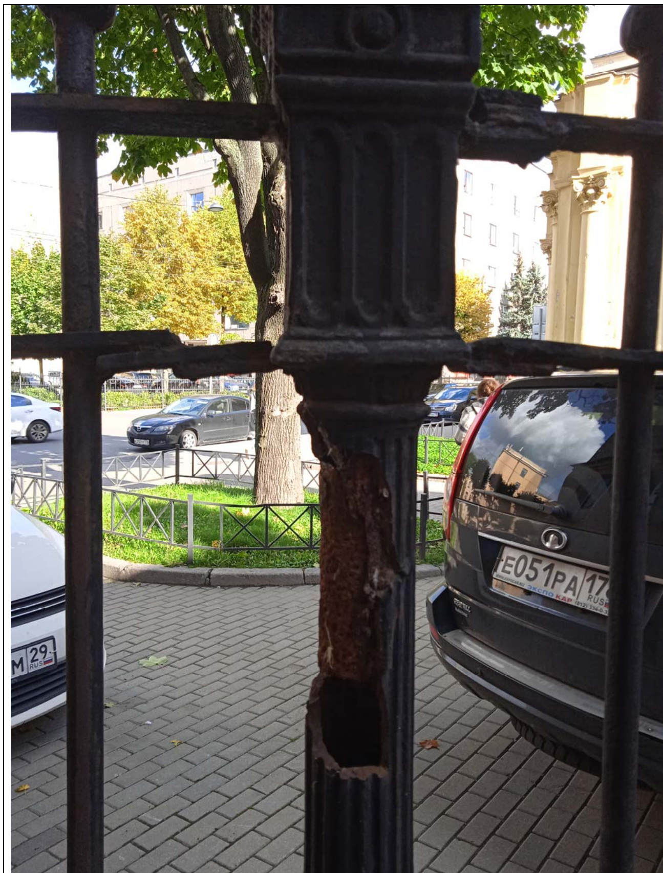
10. Особняк Горчакова К.А. Ограда по линии улицы. Фрагмент. Участок утраты металлического столбика.
