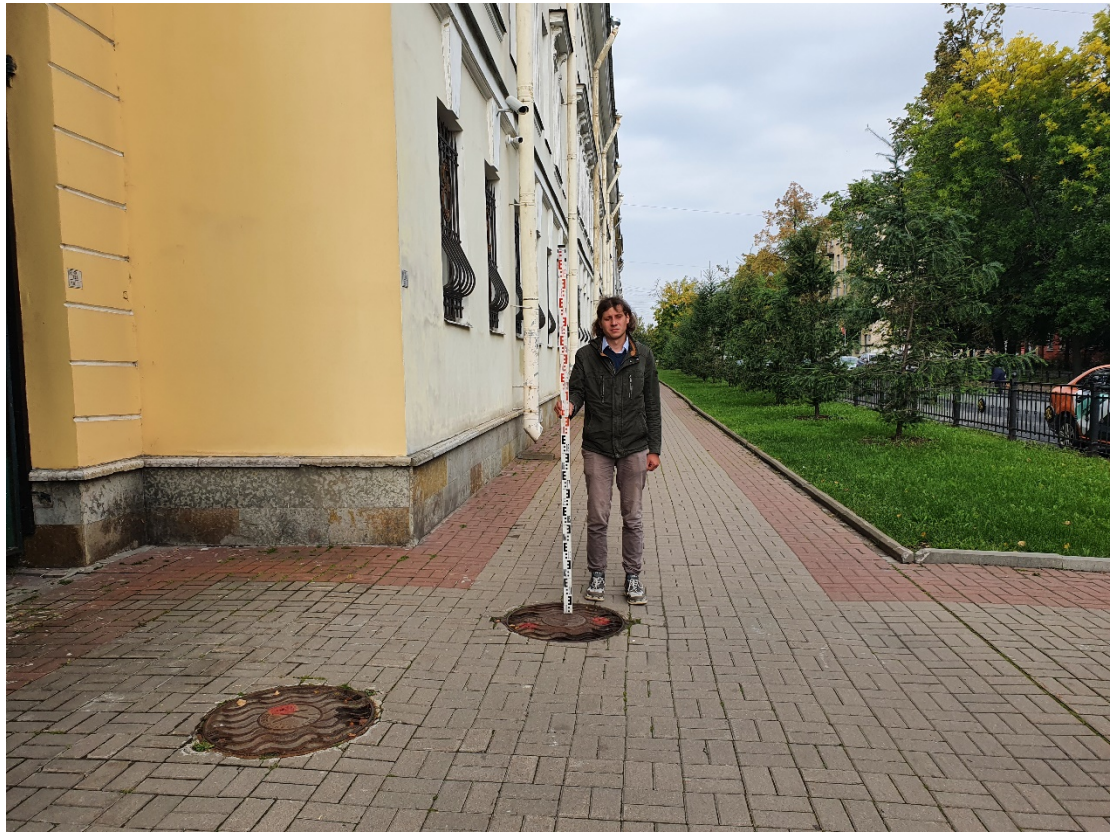
Рис. 20. СПб-2021. 20-я линия В.О. Общий вид трассы обследования. Точка фотофиксации 9. Направление проектируемой трассы по 21 линии. Вид с юга
