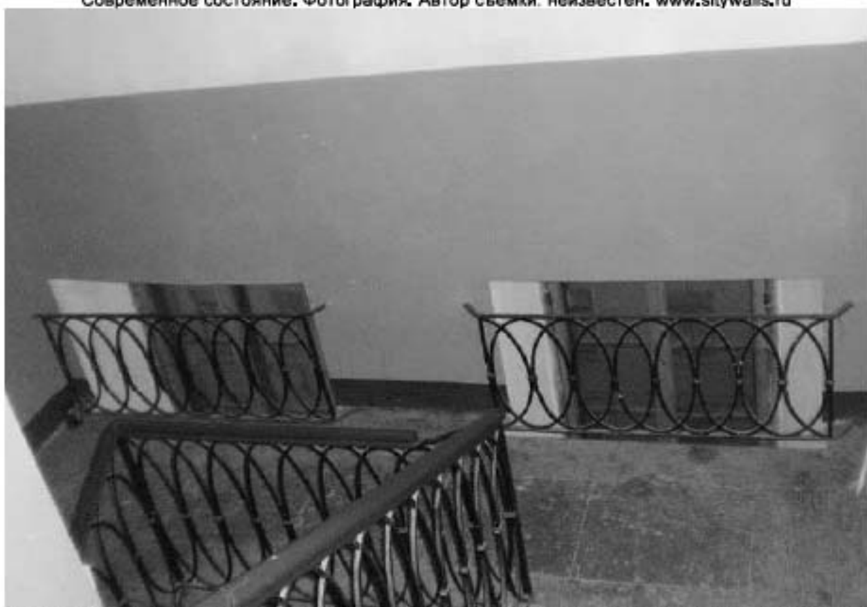
Дом Зверкова (И. С. Никитина). Лестница №9. СПб, Столярный пер., д. 18/69. 1827; 1910-1911 гг. Неоклассицизм. Арх. Зазерский А. И. Современное состояние. Фотография. Автор съемки: неизвестен. www.citywalls.ru
