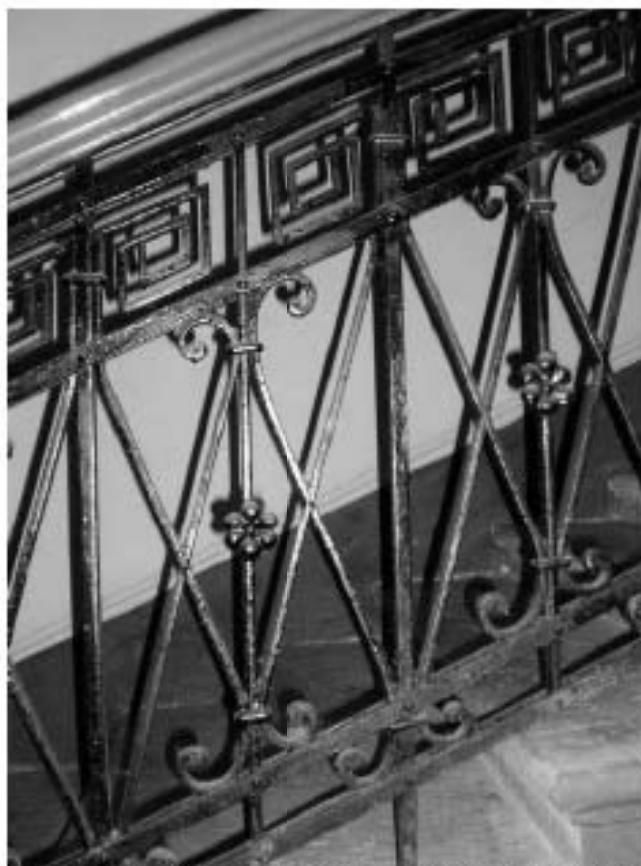
Доходный дом А. А. Галочкина, Фрагмент, СПб, Большая Монетная ул., д. 4. 1911-1912 гг. Неоклассицизм. Арх. Орлов В. М. Современное состояние. Фотография. Автор съемки: неизвестен. www.citywalls.ru
