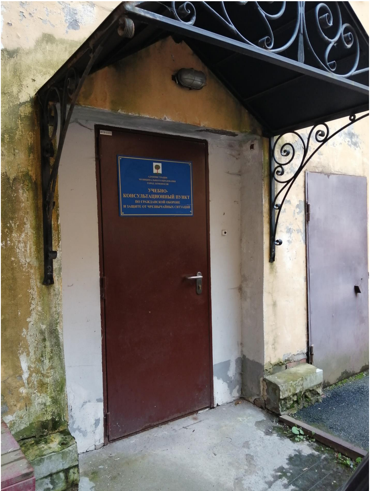
Фото 10. Объект культурного наследия регионального значения «Жилой дом», расположенный по адресу: Санкт-Петербург, город Ломоносов, Дворцовый проспект, д.40, лит.Б. Заполнение входного проема в помещении 20-Н.
