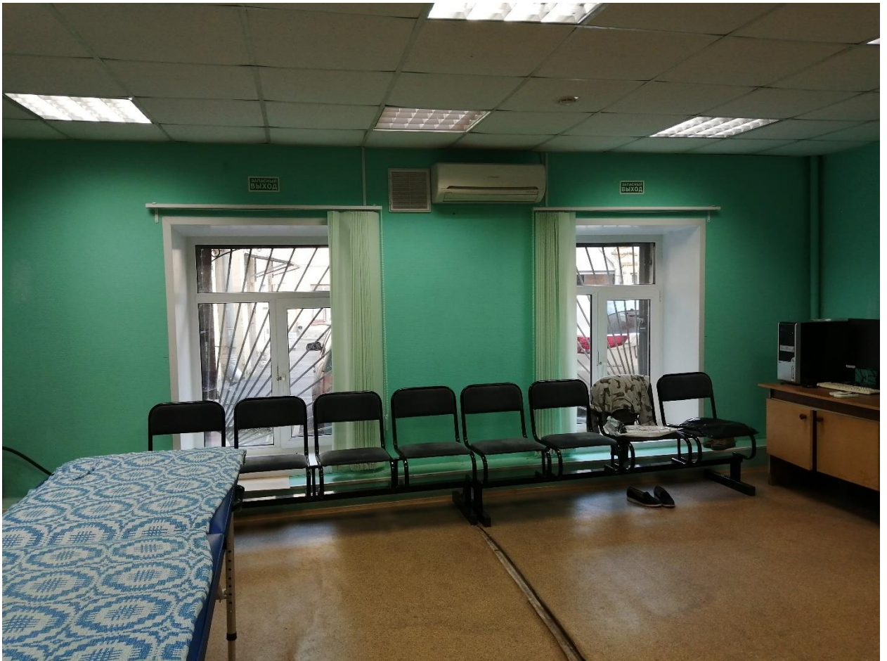
Фото 16. Объект культурного наследия регионального значения «Жилой дом», расположенный по адресу: Санкт-Петербург, город Ломоносов, Дворцовый проспект, д.40, лит.Б. Помещение 20-Н (5). Слева- вновь устроенный оконный проем в капитальной стене. Дефект покрытия пола.
