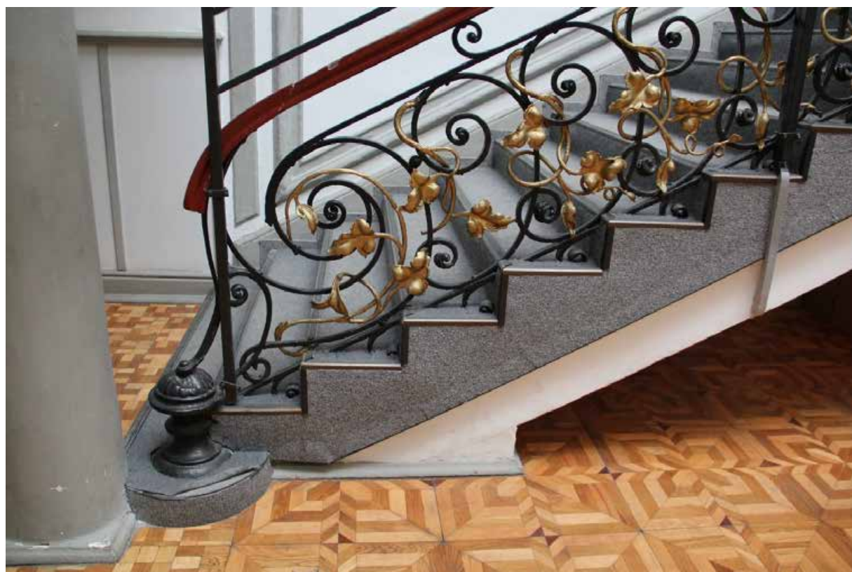
Фото 31. Ограждение лестницы в атриумном зале.
