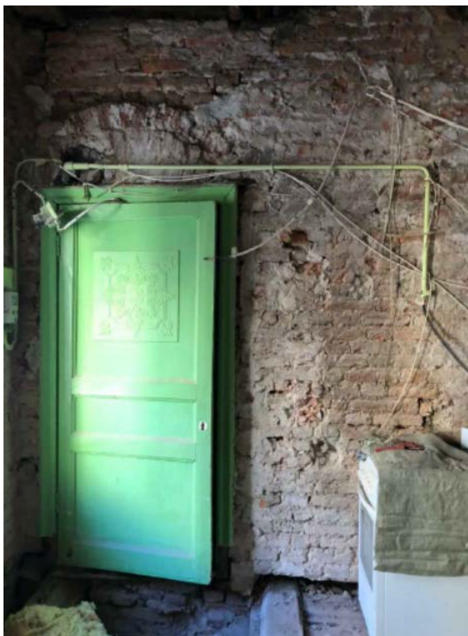
4. Входное заполнение кв. №18 в уровне 2-го этажа объекта культурного наследия регионального значения «Дом Г. Радинга (А.Ф. Пистолькорс)», расположенного по адресу: г. Санкт-Петербург, Галерная ул., д 50, литера А. 16.05.2022
