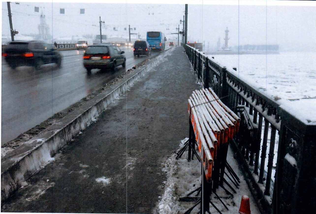
15. Вид на правый тротуар от опоры 1.
