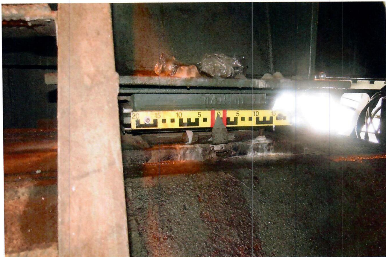
50. Вид на опорную часть, установленную на опоре 4 под фермой Ф4'. Вода и грязь через зазоры деформационных швов попадают на опорные части.
