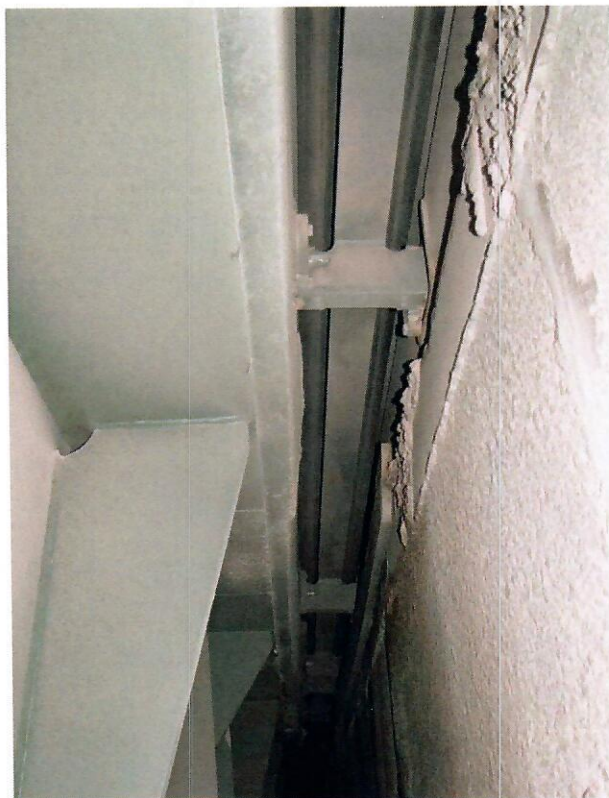
28. Вид снизу на деформационный шов Mauger D160 GO над опорой 1
