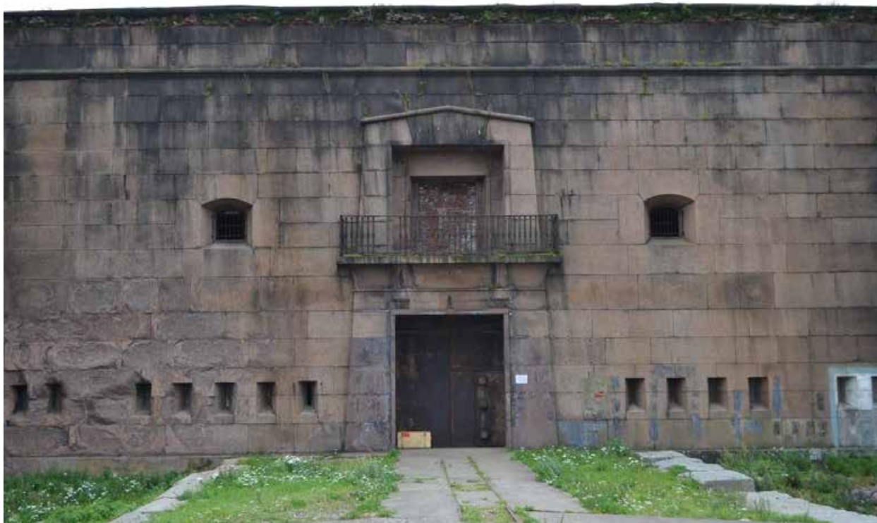
Фото 7. Форт Александр I. Центральная часть северного фасада (лицевого). Входная группа. Вид с севера.
