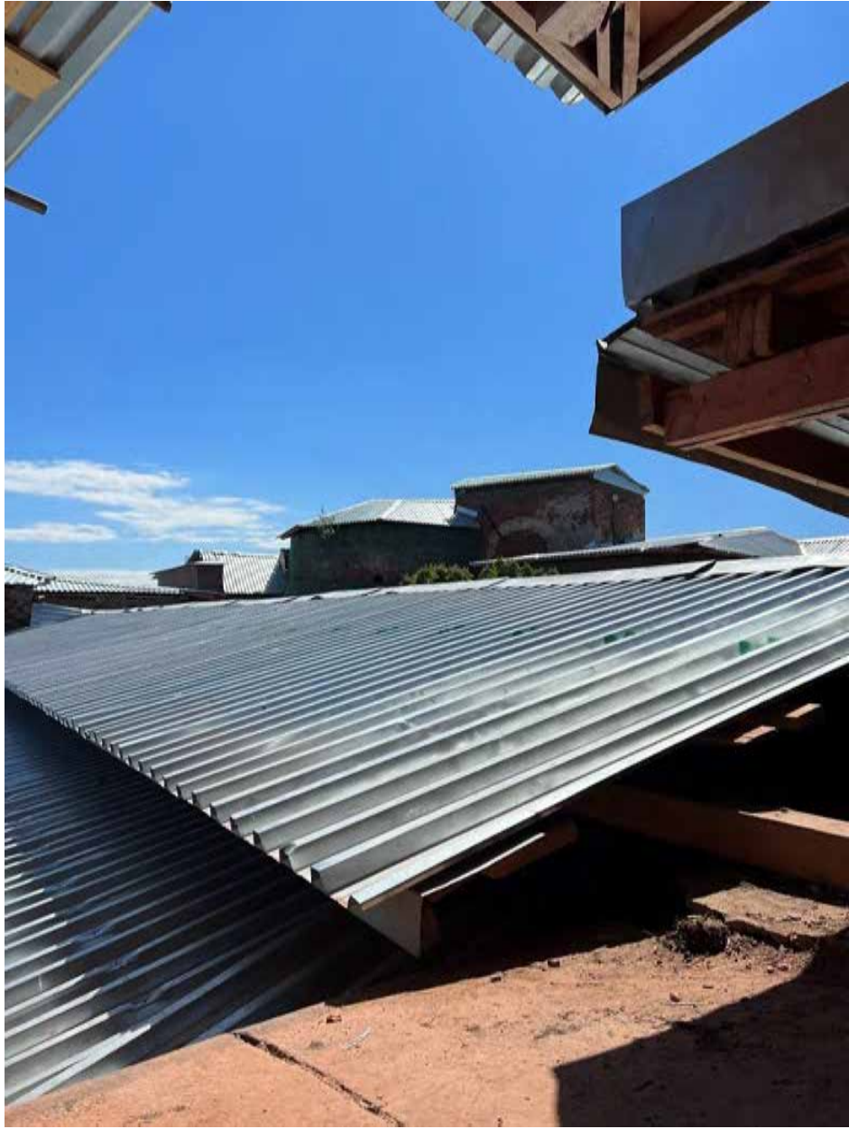
Фото 10. Вид на временную кровлю в юго-восточной части.
