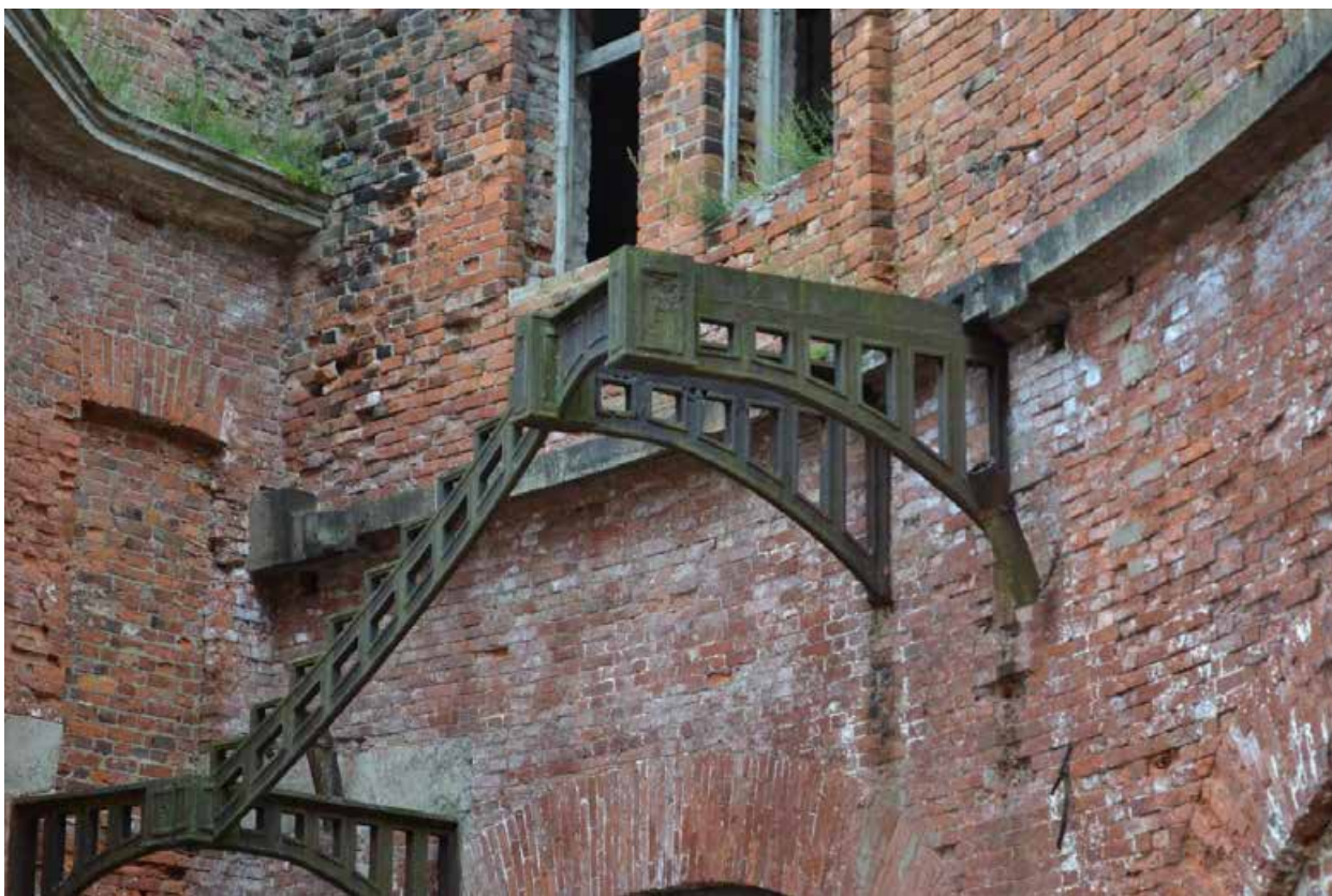
Фото 12. Форт Александр I. Сохранившиеся металлические конструкции наружной лестницы со второго на третий этаж. Вид с северо-запада.
