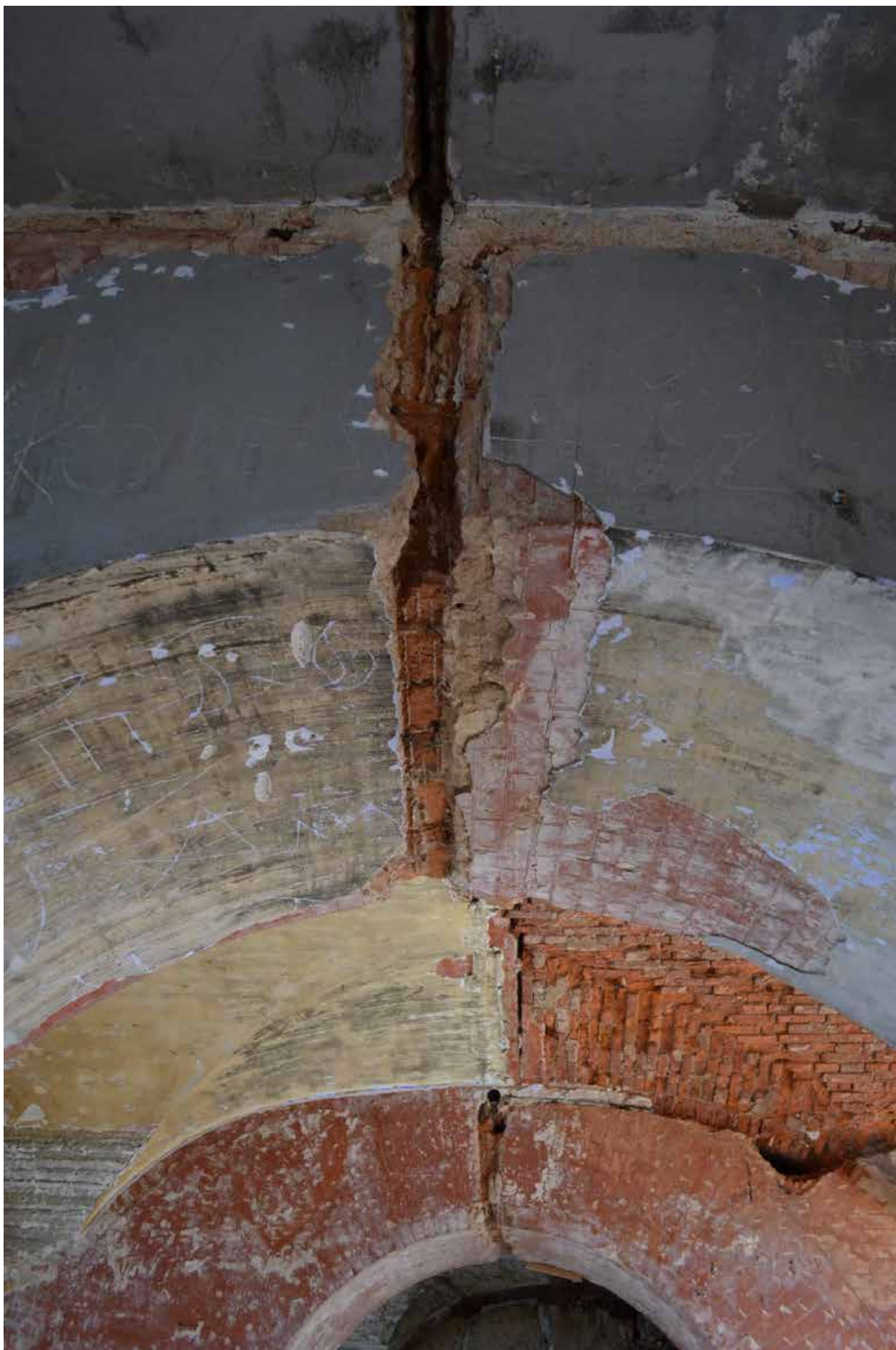
Фото 11. Второй этаж. Казематы. Вид на повреждение сводов.
