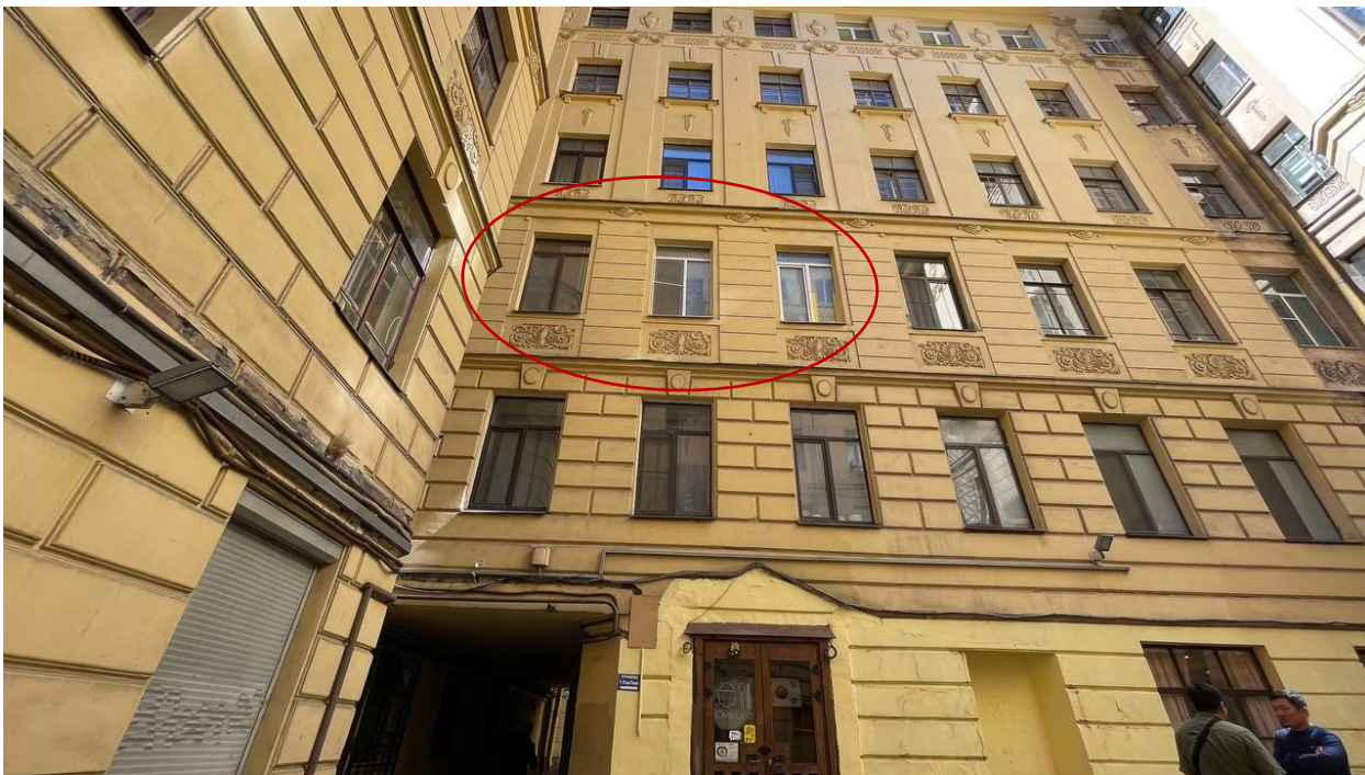
1. Вид на западный дворовой фасад здания на Гороховой ул. 3 и окна квартиры №46;
