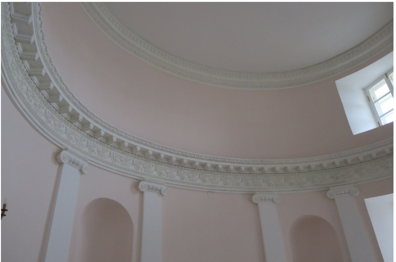
8. Помещение № 10 (2-Н) в уровне 1-го этажа объекта культурного наследия федерального значения «Дача Чернышева И.Г. «Александрино», расположенного по адресу: г. Санкт-Петербург, пр. Стачек, д. 226, литера А. 11.03.2022
