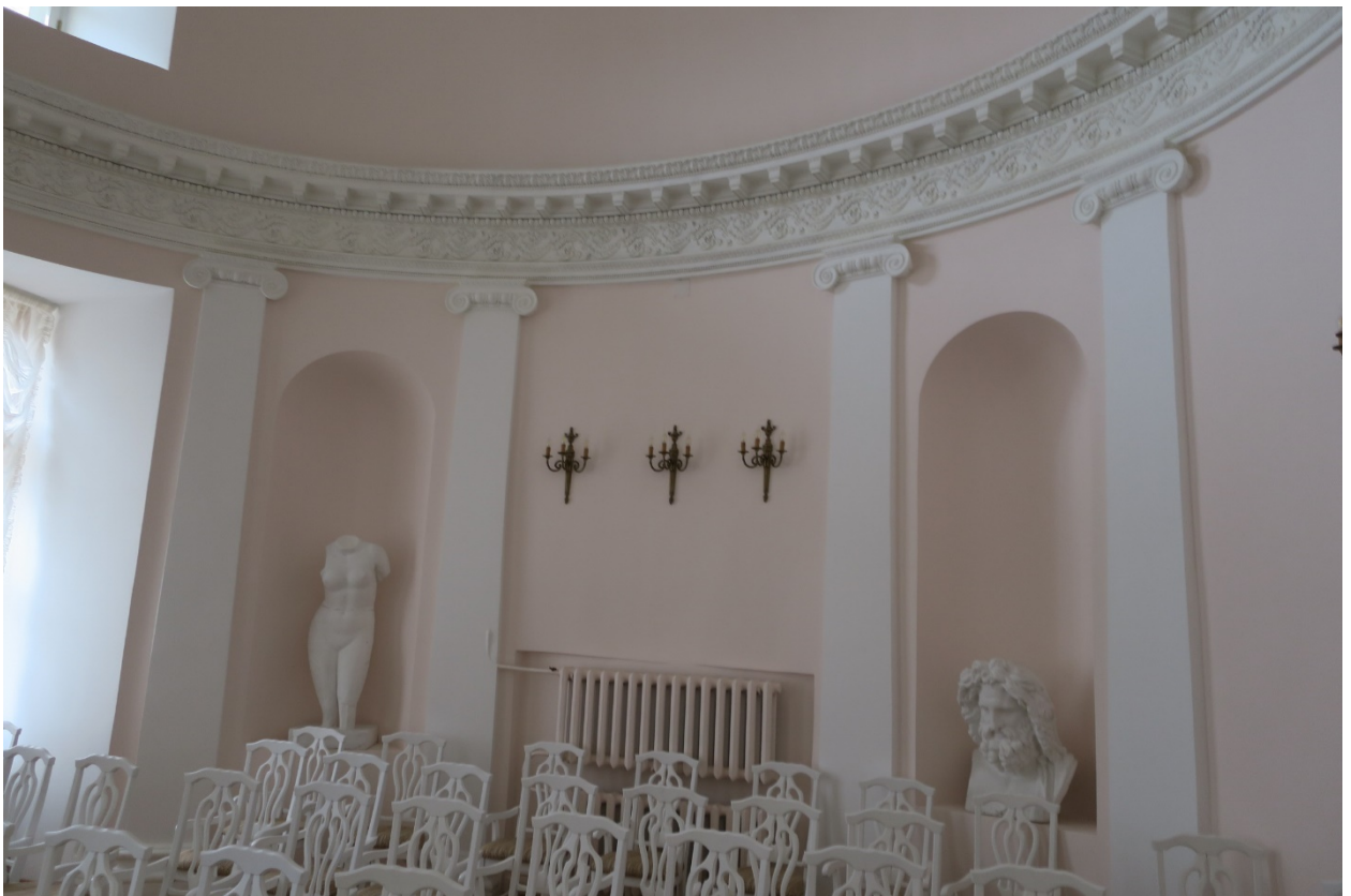
7. Помещение № 10 (2-Н) в уровне 1-го этажа объекта культурного наследия федерального значения «Дача Чернышева И.Г. «Александрино», расположенного по адресу: г. Санкт-Петербург, пр. Стачек, д. 226, литера А. 11.03.2022
