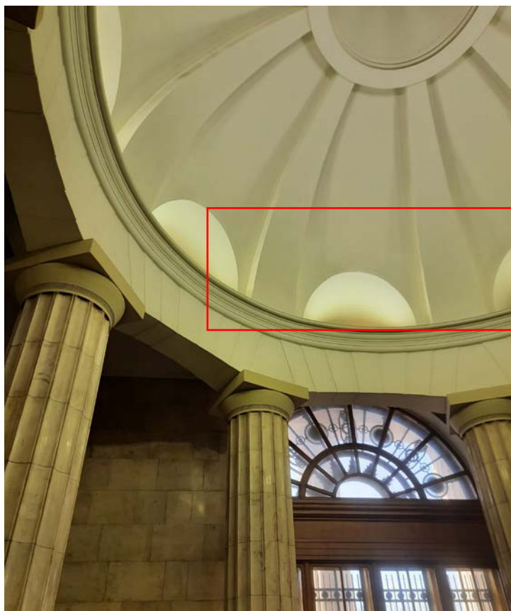
Фото 25 Фрагмент интерьера объекта культурного наследия регионального значения «Станция метро «Кировский завод», г. Санкт-Петербург, пр. Стачек, д. 70, литера А. (кассовый зал, места установки радиоканального оборудования)
