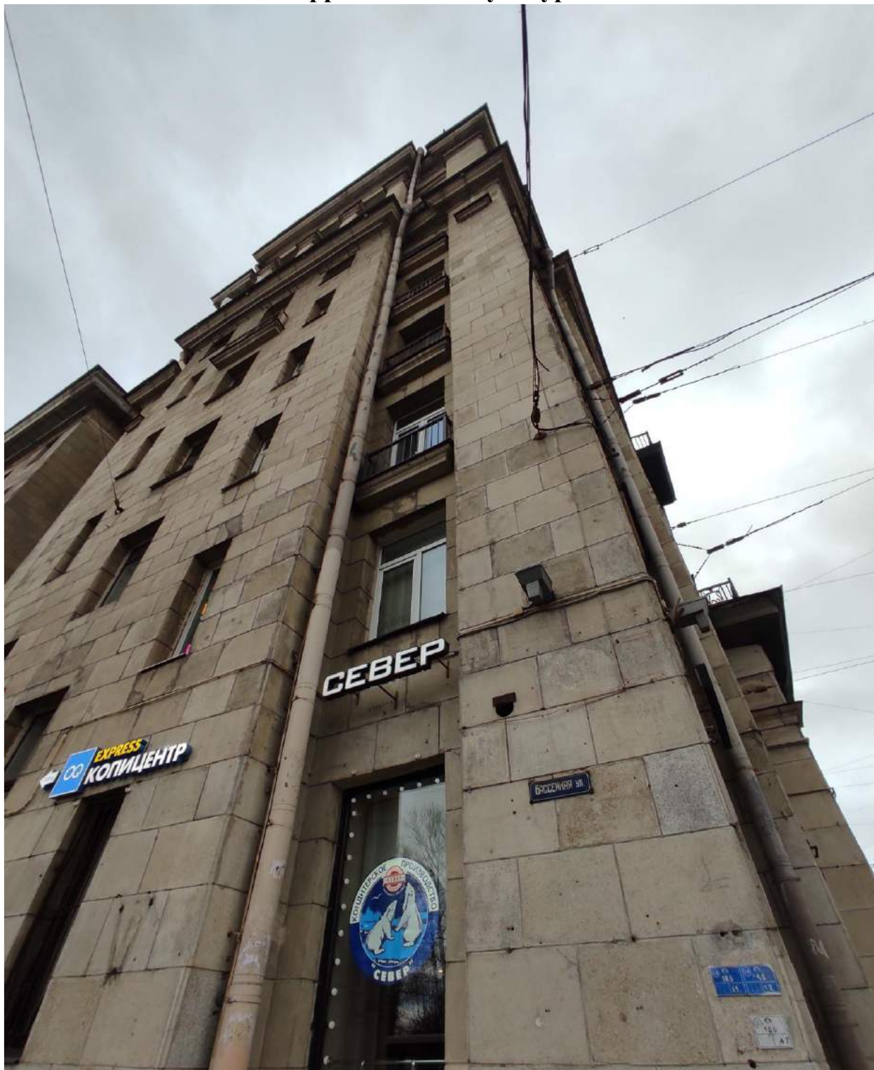
Фото 8. Фасад Г-А. Выветривания раствора цоколя, биопоражения, деструкция терразитовой штукатурки, выветривание раствора между швами, трещины, замокания, загрязнения, следы многочисленных цементных вставок, следы выветривания известкового слоя терразитовой штукатурки
