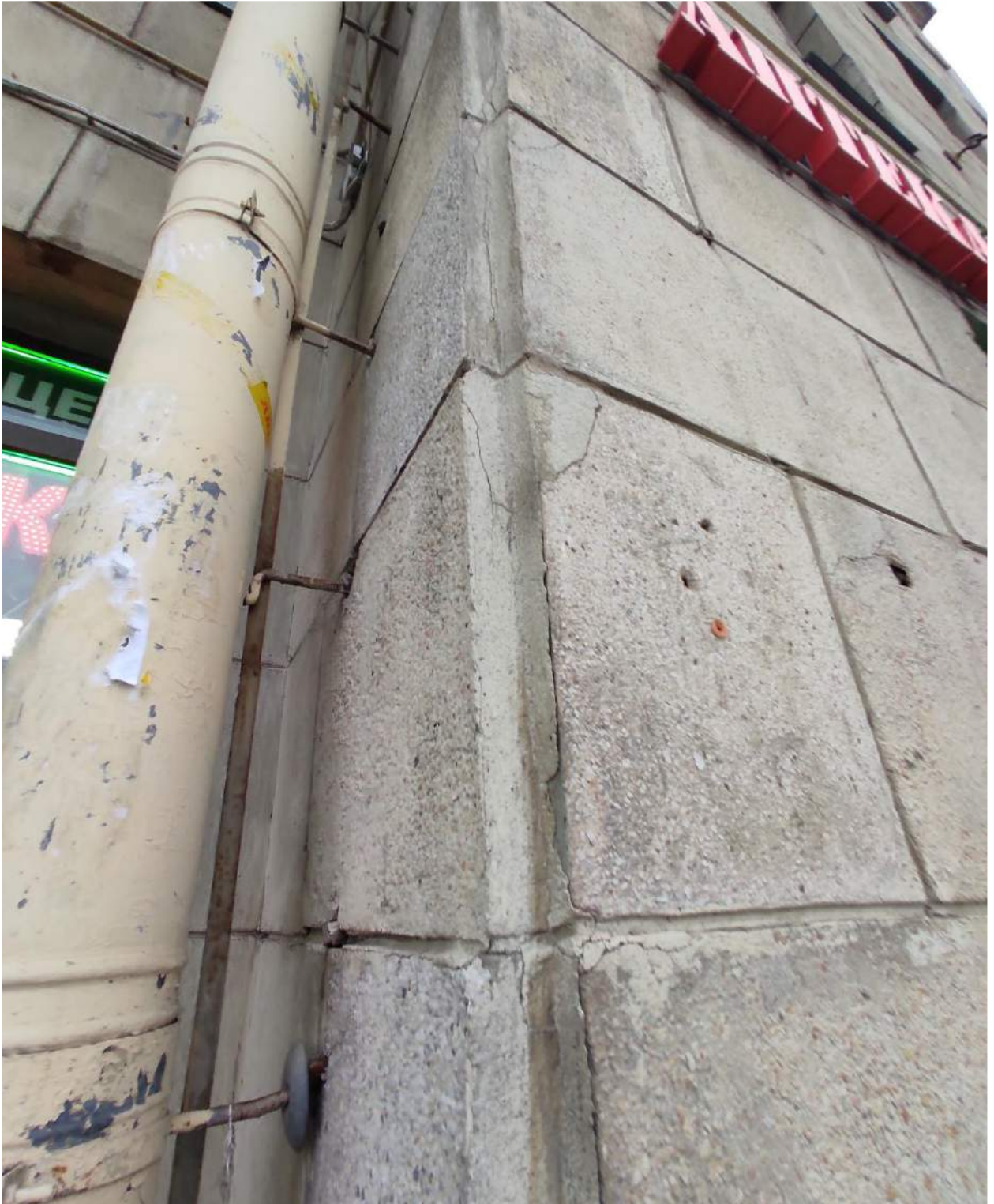
Фото 11. Фасад Г-А. Следы выветривания известкового слоя терразитовой штукатурки, трещины, биопоражения, выветривание и трещины шовного раствора, поздние цементные вставки, ржавчина от креплений водосточной трубы на фасаде, коррозия креплений водосточной трубы
