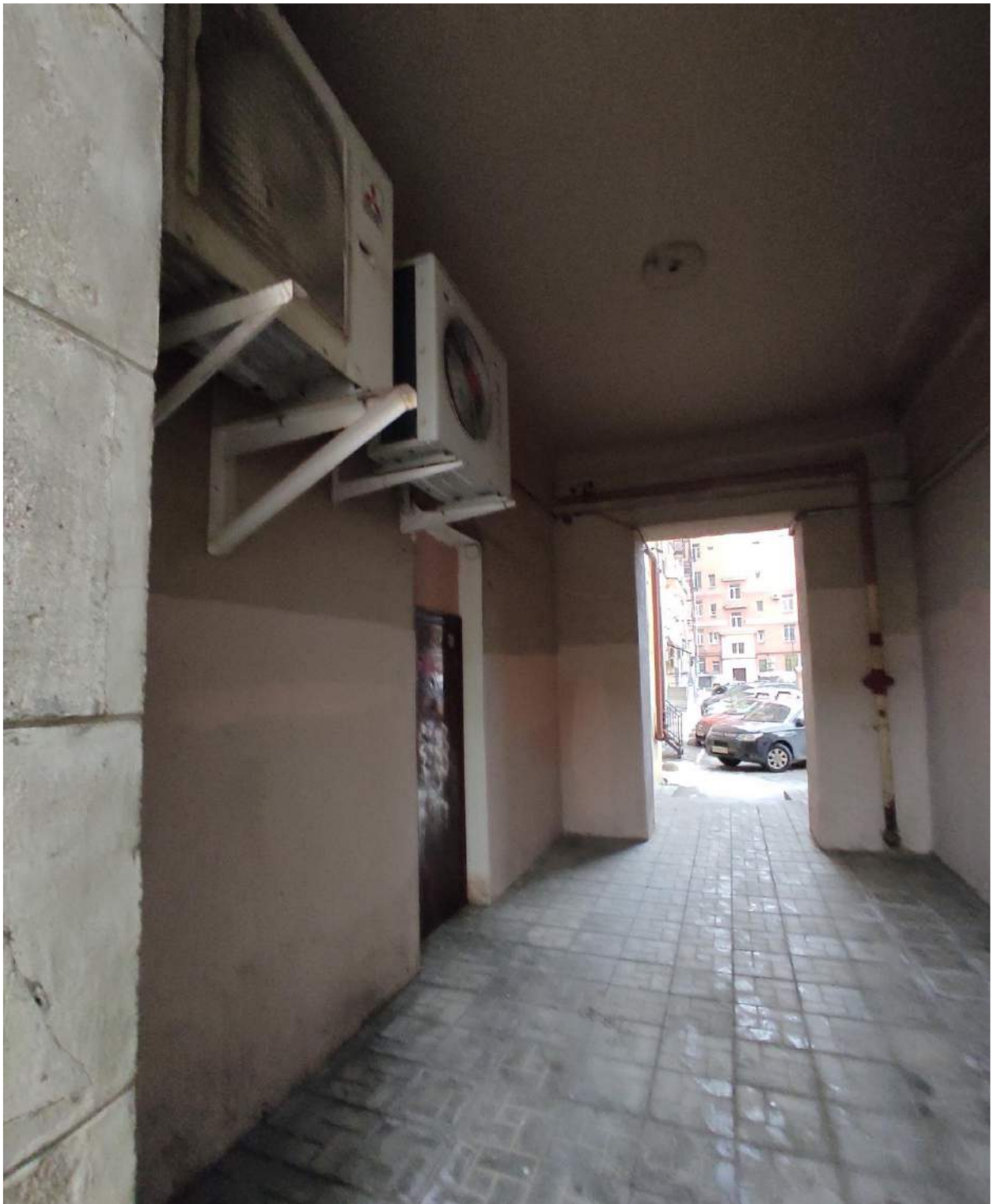
Фото 22. Проходная арка вид с Московского проспекта. Трещины, утрата штукатурного слоя, деструкция штукатурного слоя, поздние цементные вставки, докомпоновки
