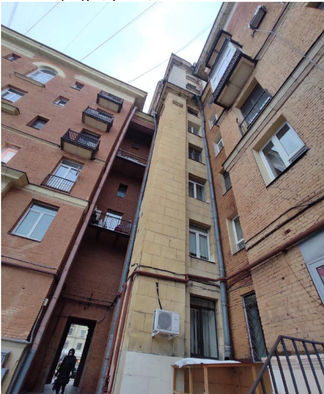
Фото 23. Фасад 4-1. Следы многочисленных покрасок терразитовой штукатурки, трещины, поздние цементные вставки
