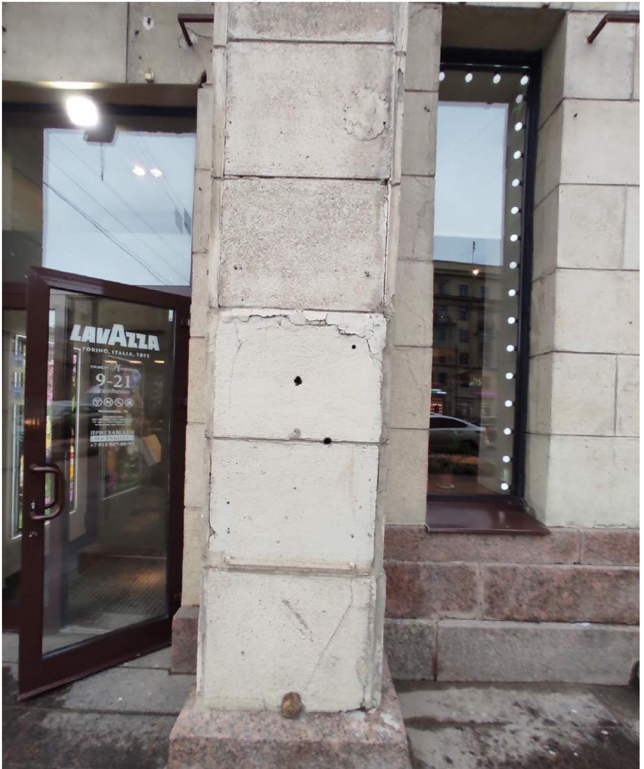
Фото № 16. Фасад 1-4. Колонна. Поздние цементные вставки, утрата шовного раствора между терразитовыми плитами, трещины в слое терразитовой штукатурки. Биопоражения цоколя, выветривание шовного раствора между гранитными плитами
