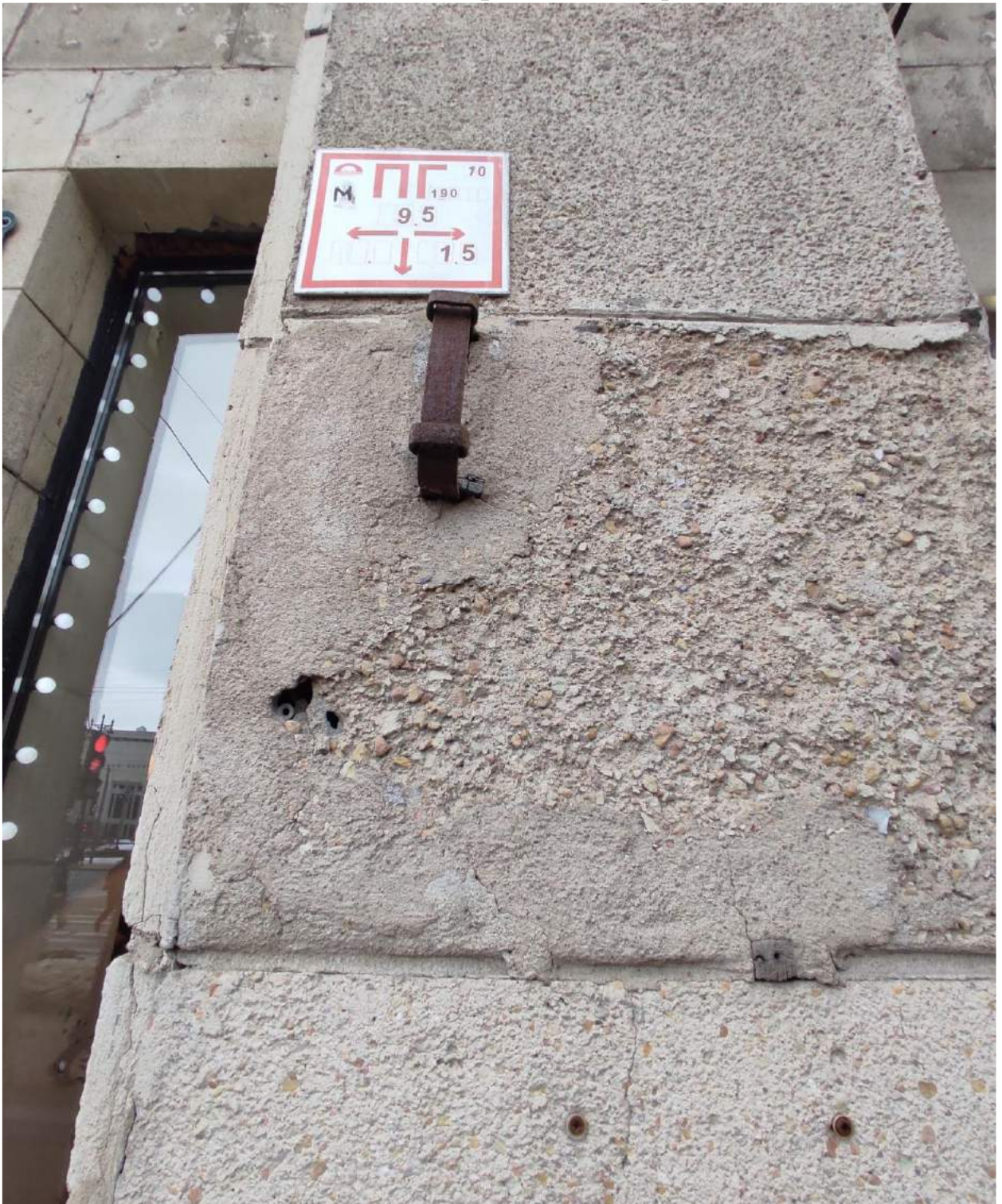
Фото № 14. Фасад 1-4. Следы выветривания известкового слоя терразитовой штукатурки, трещины, биопоражения, выветривание и трещины шовного раствора, поздние цементные вставки, коррозионные металлические крепления на фасаде
