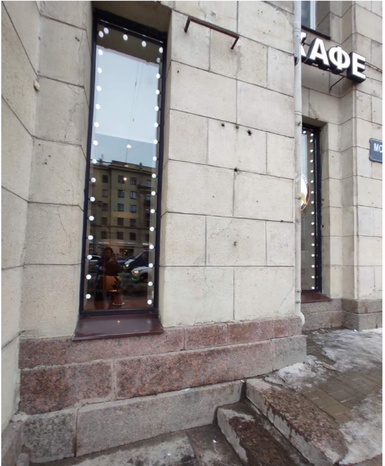
Фото 17. Фасад 1-4. Загрязнения, биопоражения, высолы цоколя и гранитных ступеней. Утрата шовного раствора, трещины в, загрязнения терразитовой штукатурки, поздние цементные вставки
