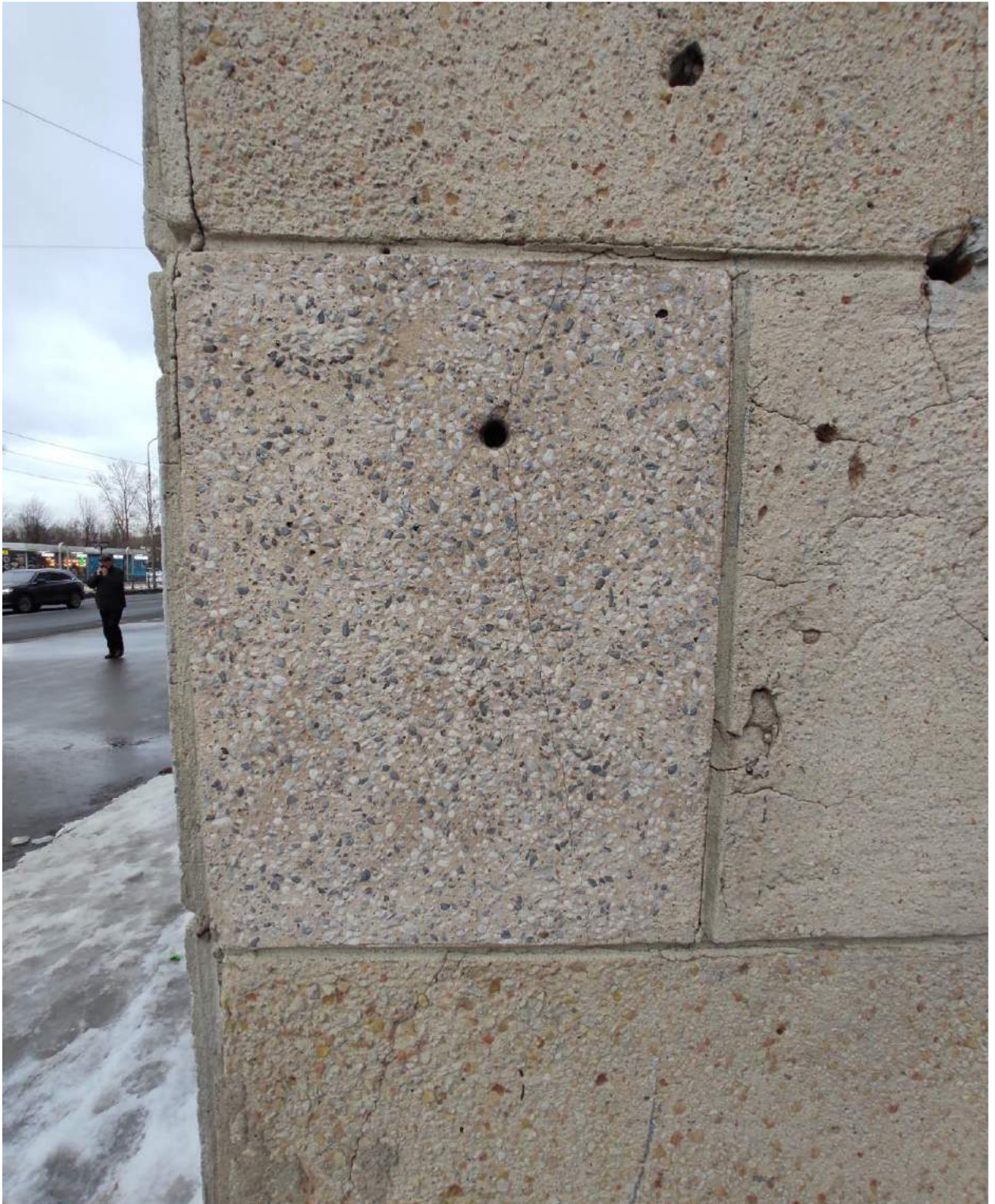
Фото 9. Фасад 1-4. Следы выветривания известкового слоя терразитовой штукатурки, трещины, биопоражения, выветривание и трещины шовного раствора, поздние цементные вставки
