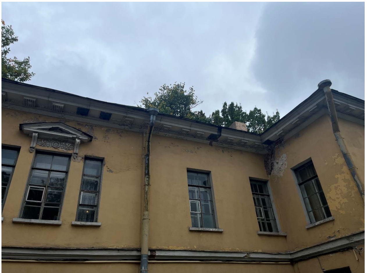
Фото №3. Северный фасад, дефекты в зоне карниза.
