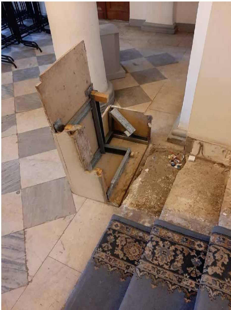
Фото 17. СПбГИК. Лестница. Короб, прикрывающий дефекты ступеней (открытый).
