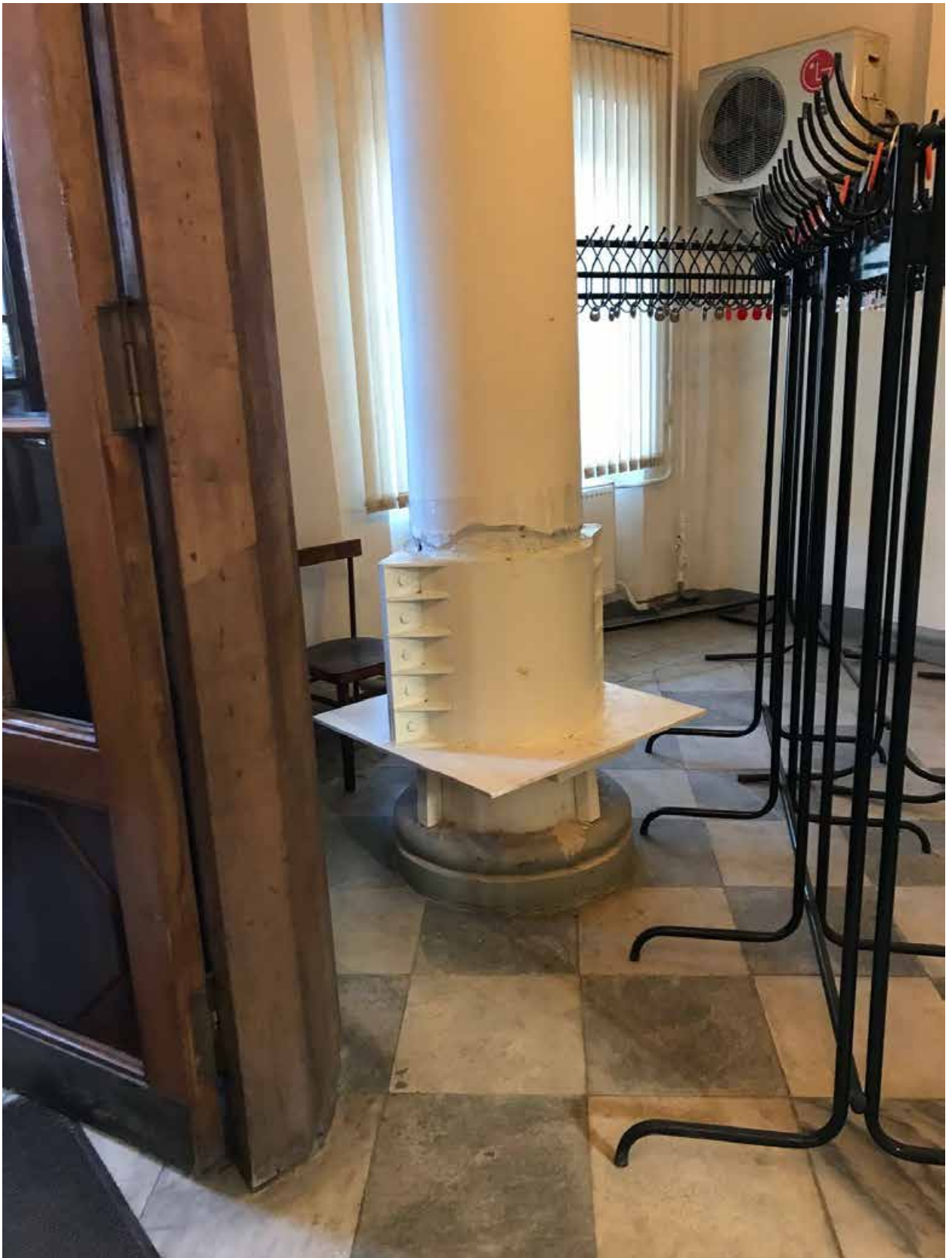
Фото 20. СПбГИК. Входной вестибюль. Деформация колонн.
