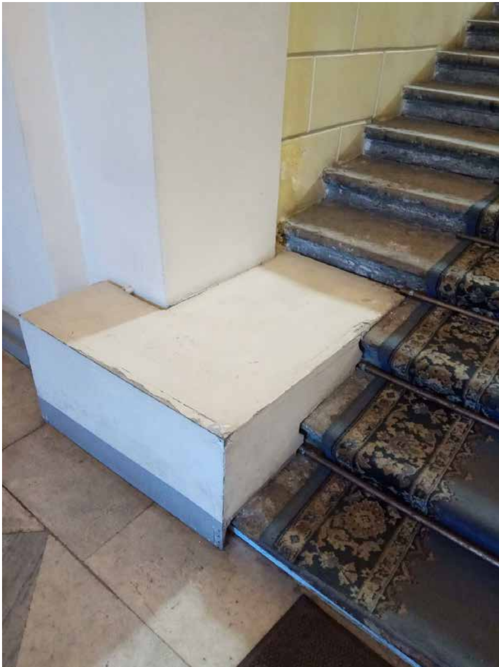
Фото 18. СПбГИК. Лестница. Короб, прикрывающий дефекты ступеней (закрытый).
