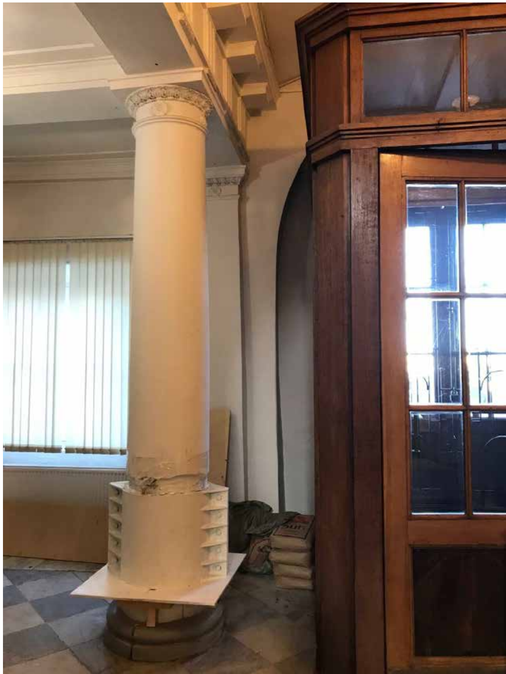
Фото 19. СПбГИК. Входной вестибюль. Деформация колонн.
