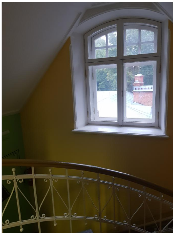
Фото 33. Интерьер объекта культурного наследия регионального значения «Дом Гудовича В.В. со служебным флигелем, садом и оградой», мансардный этаж
