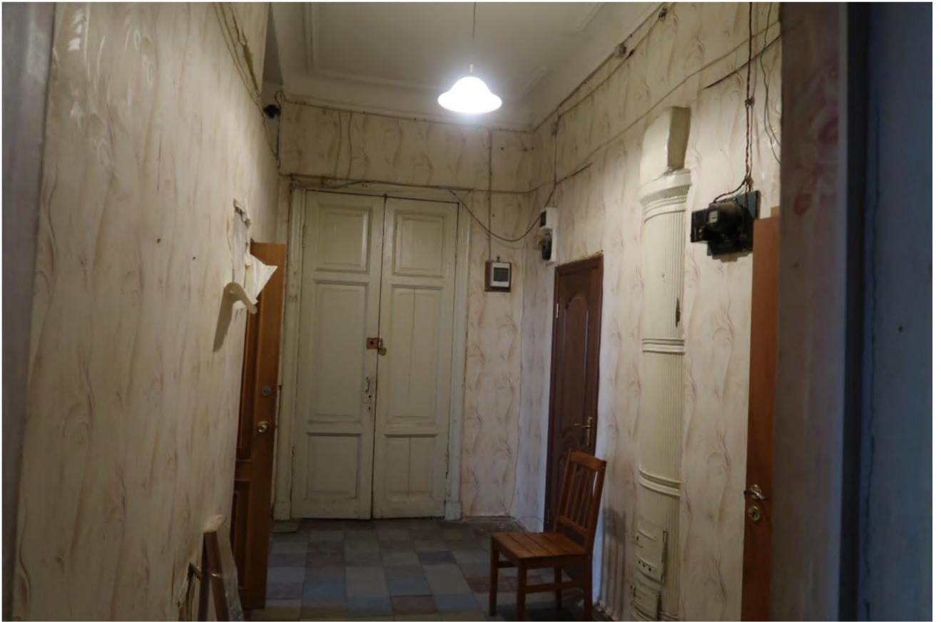
12. Вид на входную дверь в помещение квартиры № 16 со стороны коридора № 8 (нумерация в соответствии с планом ПИБ).
