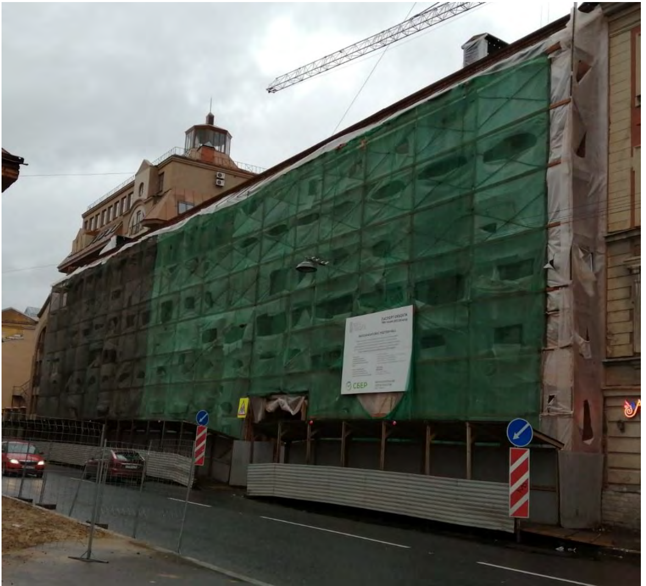
Фото 1. Объект «Производственный корпус» в составе ансамбля, объекта культурного наследия регионального значения «Постройки мебельно-столярной фабрики Ф.А.Мельцера», расположенного по адресу: Санкт-Петербург, наб. реки Карповки, дом 27, литера Б (Б4). Лицевой фасад по ул.Профессора Попова.
