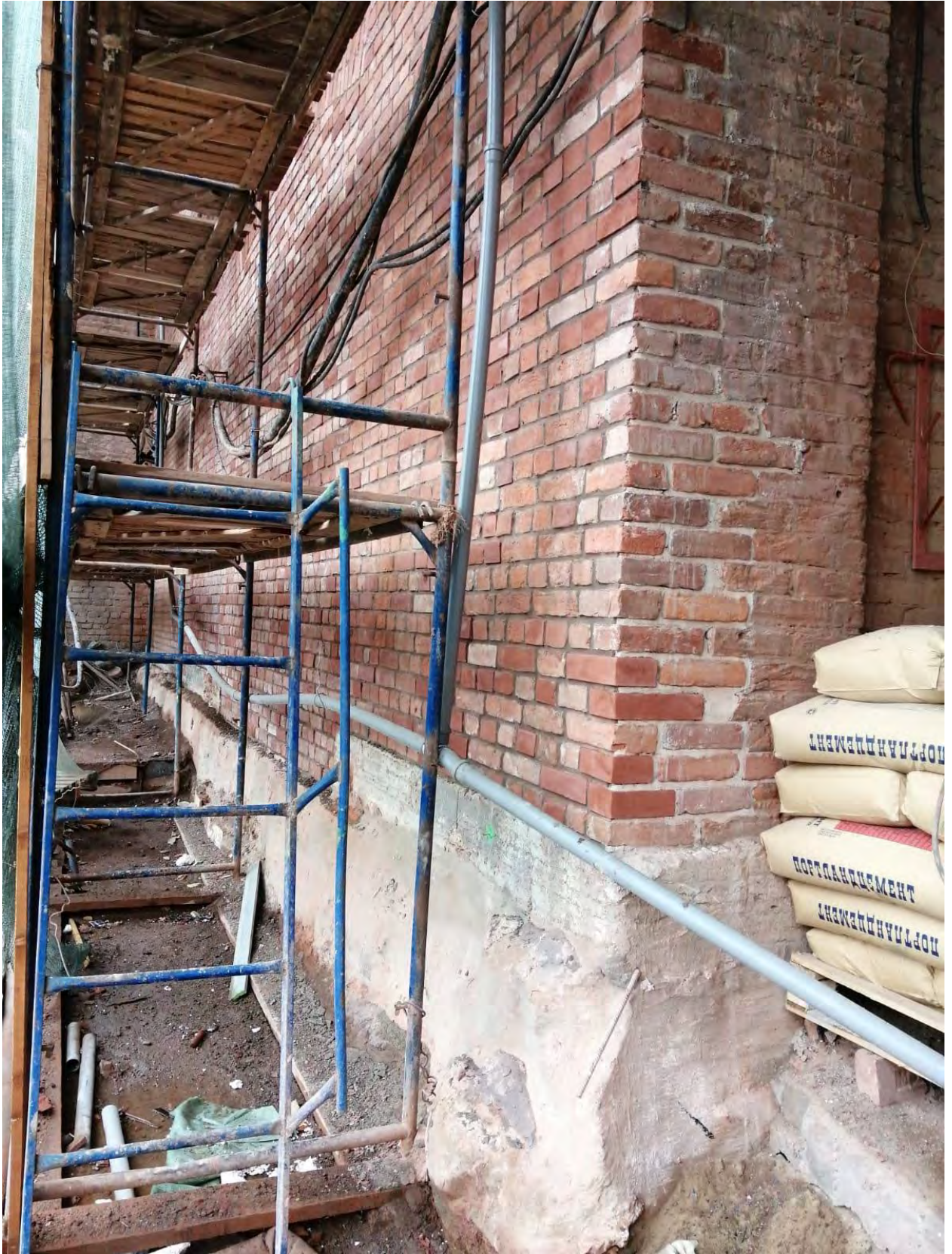
Фото 7. Объект «Производственный корпус» в составе ансамбля, объекта культурного наследия регионального значения «Постройки мебельно-столярной фабрики Ф.А.Мельцера», расположенного по адресу: Санкт-Петербург, наб. реки Карповки, дом 27, литера Б (Б4). Дворовый фасад, фрагмент, слева от арки.
