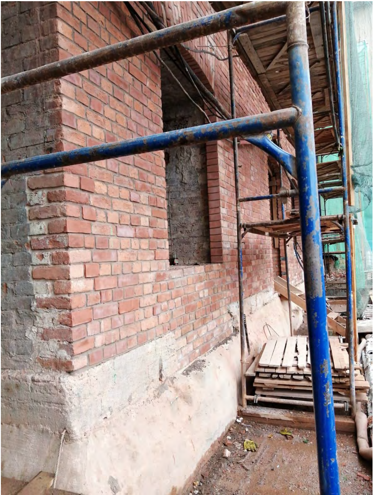
Фото 6. Объект «Производственный корпус» в составе ансамбля, объекта культурного наследия регионального значения «Постройки мебельно-столярной фабрики Ф.А.Мельцера», расположенного по адресу: Санкт-Петербург, наб. реки Карповки, дом 27, литера Б (Б4). Дворовый фасад, фрагмент, справа от арки.
