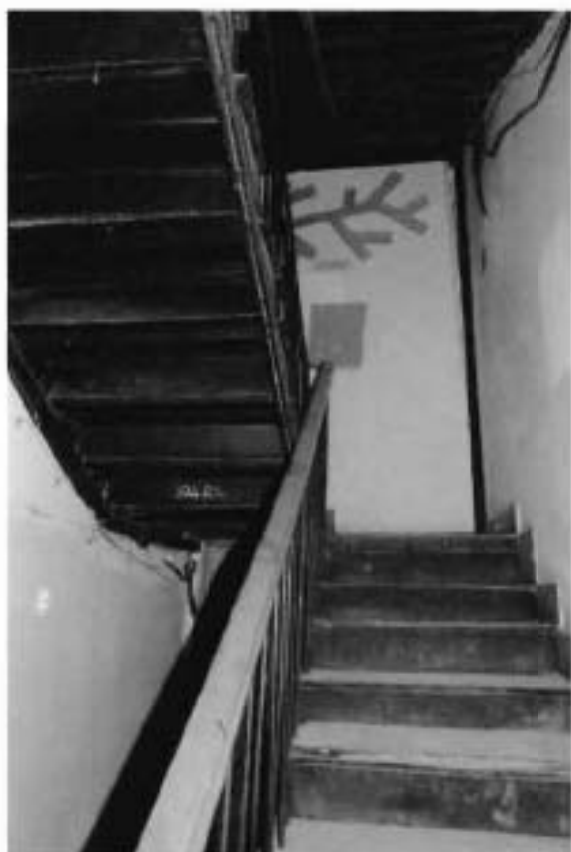
24. Интерьер объекта культурного наследия. Фрагмент. Северная металлическая служебная лестница лицевого корпуса. Пом. 3Н(40) (фото от 11.05.2022).
