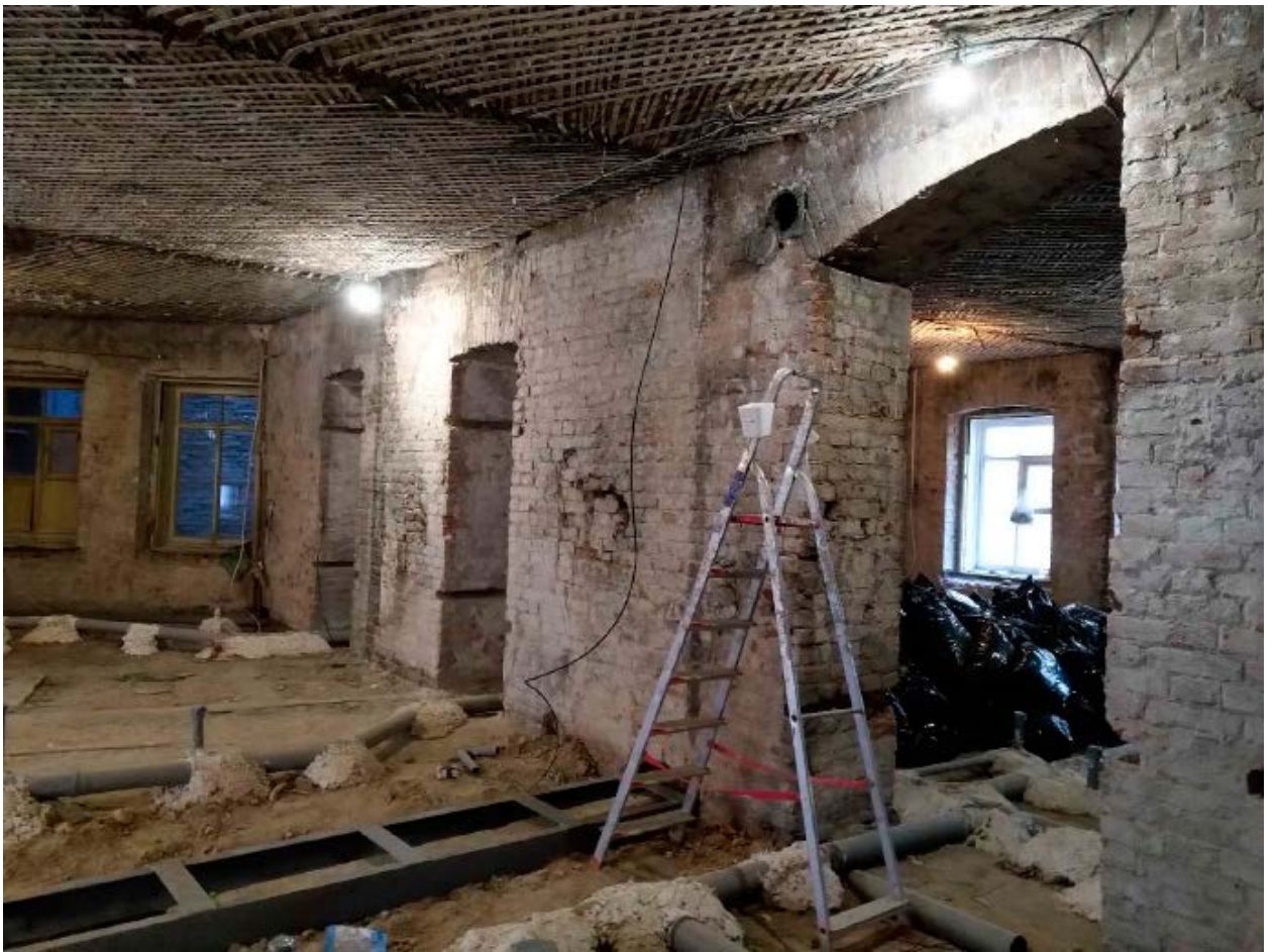
5. Помещение №11 квартиры №21 в уровне 3-го этажа выявленного объекта культурного наследия «Дом И.И. Антонова», расположенного по адресу: г. Санкт-Петербург, Литейный пр., д. 61, лит. А. 20.12.2020.
