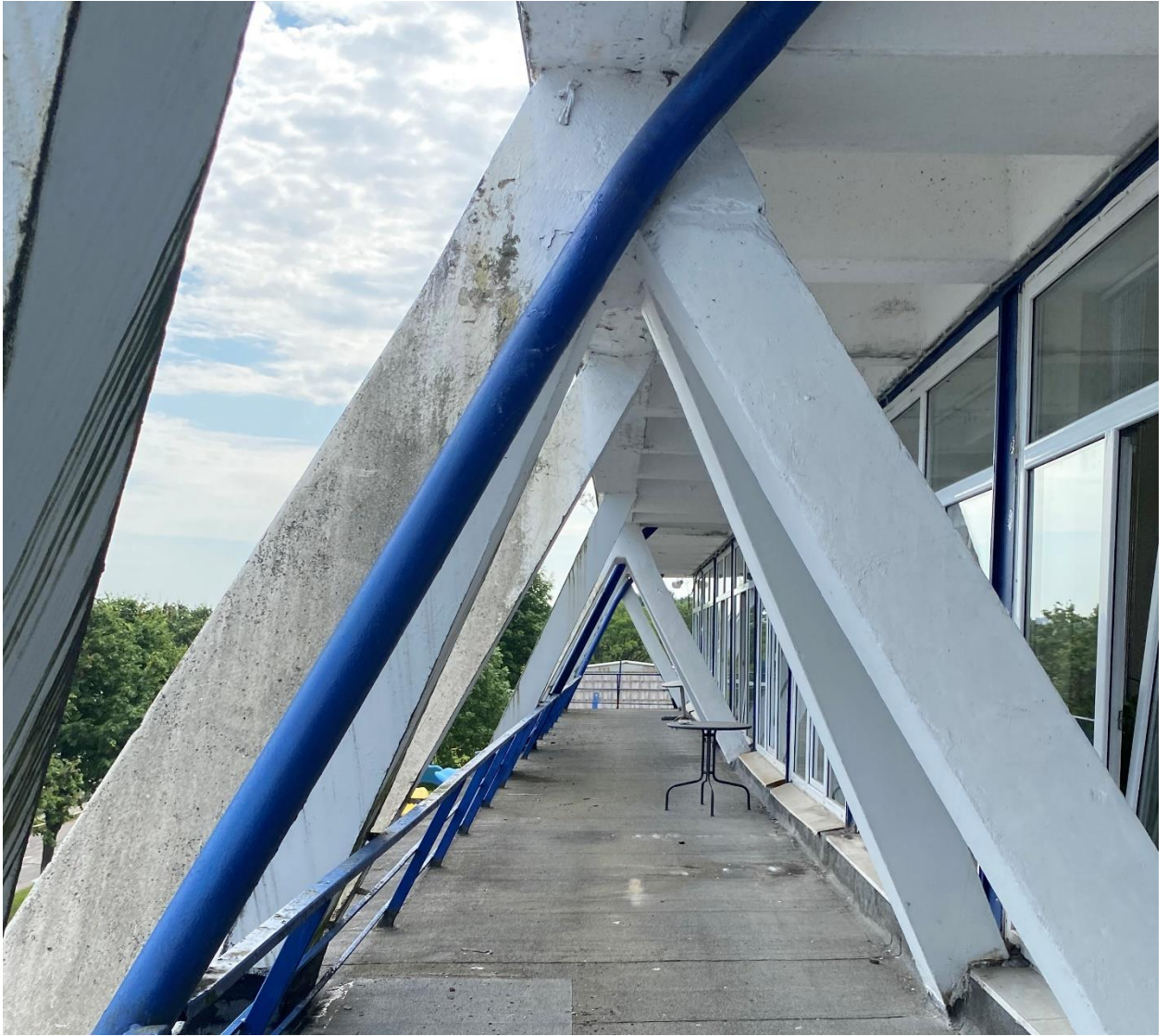
Фото 4. Фрагмент периметрального балкона 2-го этажа. Пространственный каркас из сборных железобетонных пирамидальных элементов. Деструкция бетона стержней пирамидальных элементов и плиты кессонированного перекрытия, значительные загрязнения и утраты красочного слоя конструкций.
