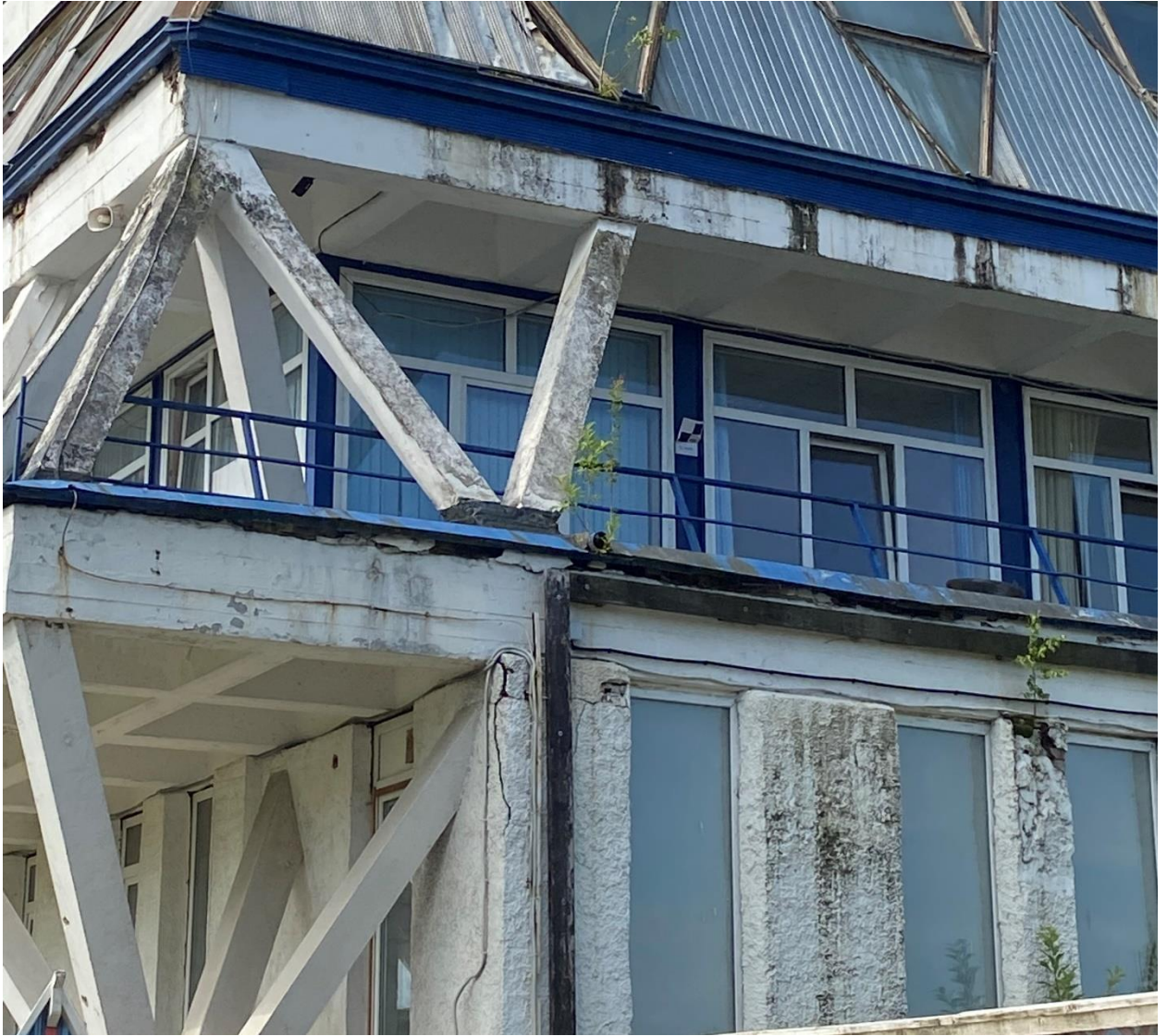
Фото 7. Северный фасад. Фрагмент. Сборные железобетонные пирамидальные элементы 1-го и 2-го этажей. Деструкция бетона стержней пирамидальных элементов и плиты кессонированного перекрытия, значительные загрязнения и утраты красочного слоя конструкций. Наружные ограждающие конструкции в виде легких навесных и металлических витражей. Металлические рамы панелей и треугольных витражей подвержены коррозии, утраты и повреждения обшивки панелей. Ограждающая кирпичная стена части фасада, трещины, сколы и значительные загрязнения.
