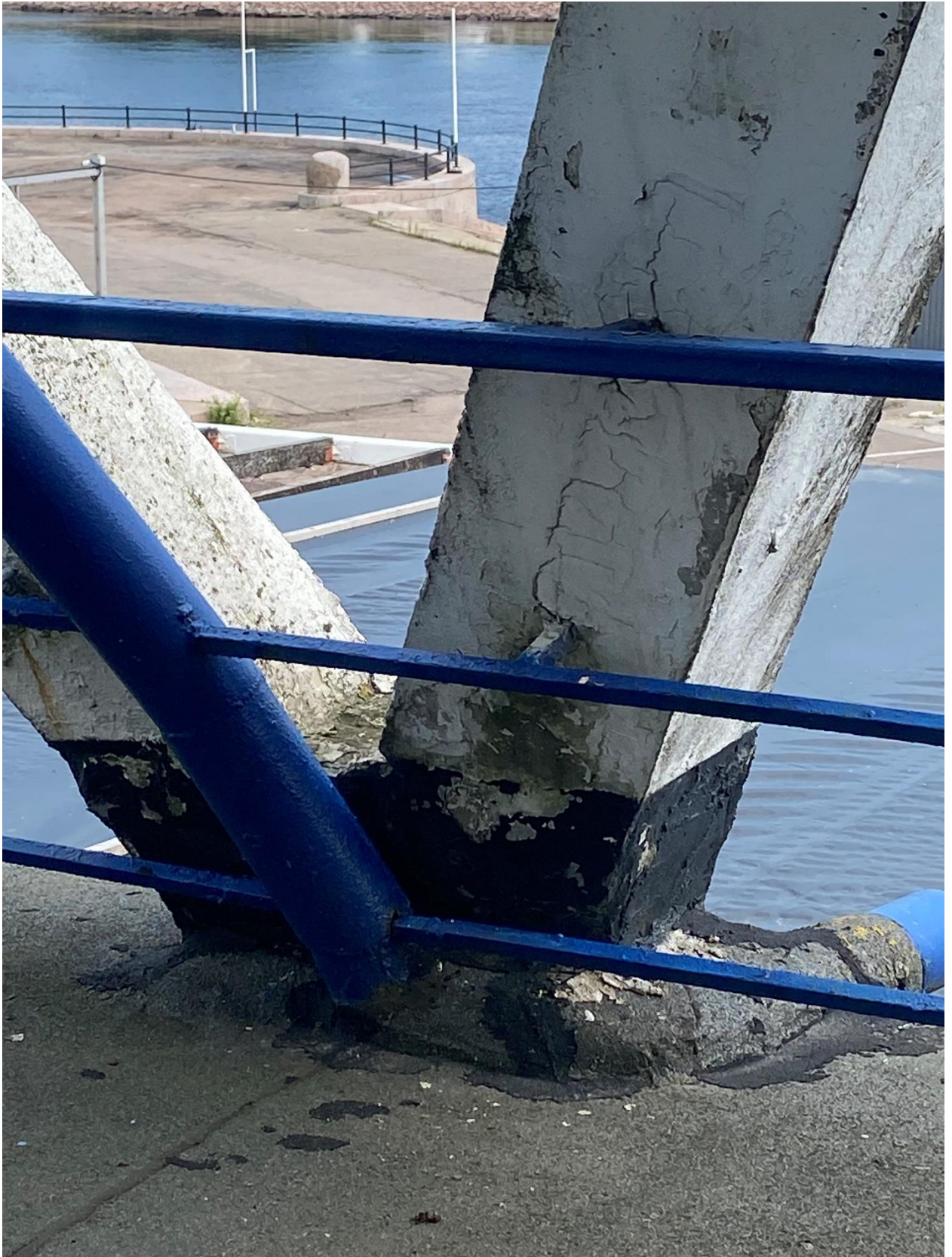
Фото 6. Фрагмент балкона 2-го этажа. Пространственный каркас из сборных железобетонных пирамидальных элементов. Деструкция бетона стержней пирамидальных элементов и плиты кессонированного перекрытия, значительные загрязнения и утраты красочного слоя конструкций.
