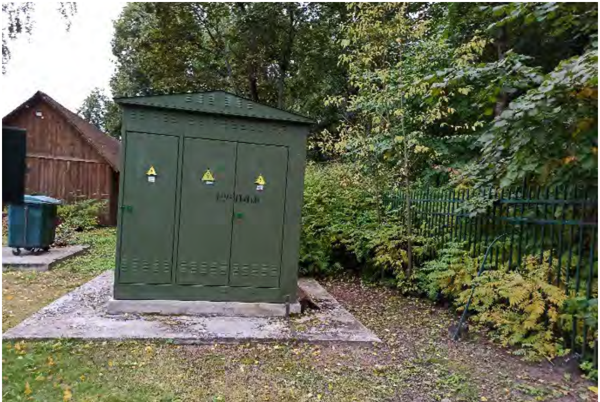
Фото 16. Вид на ТП к которому подключается проектируемый эл.кабель.
