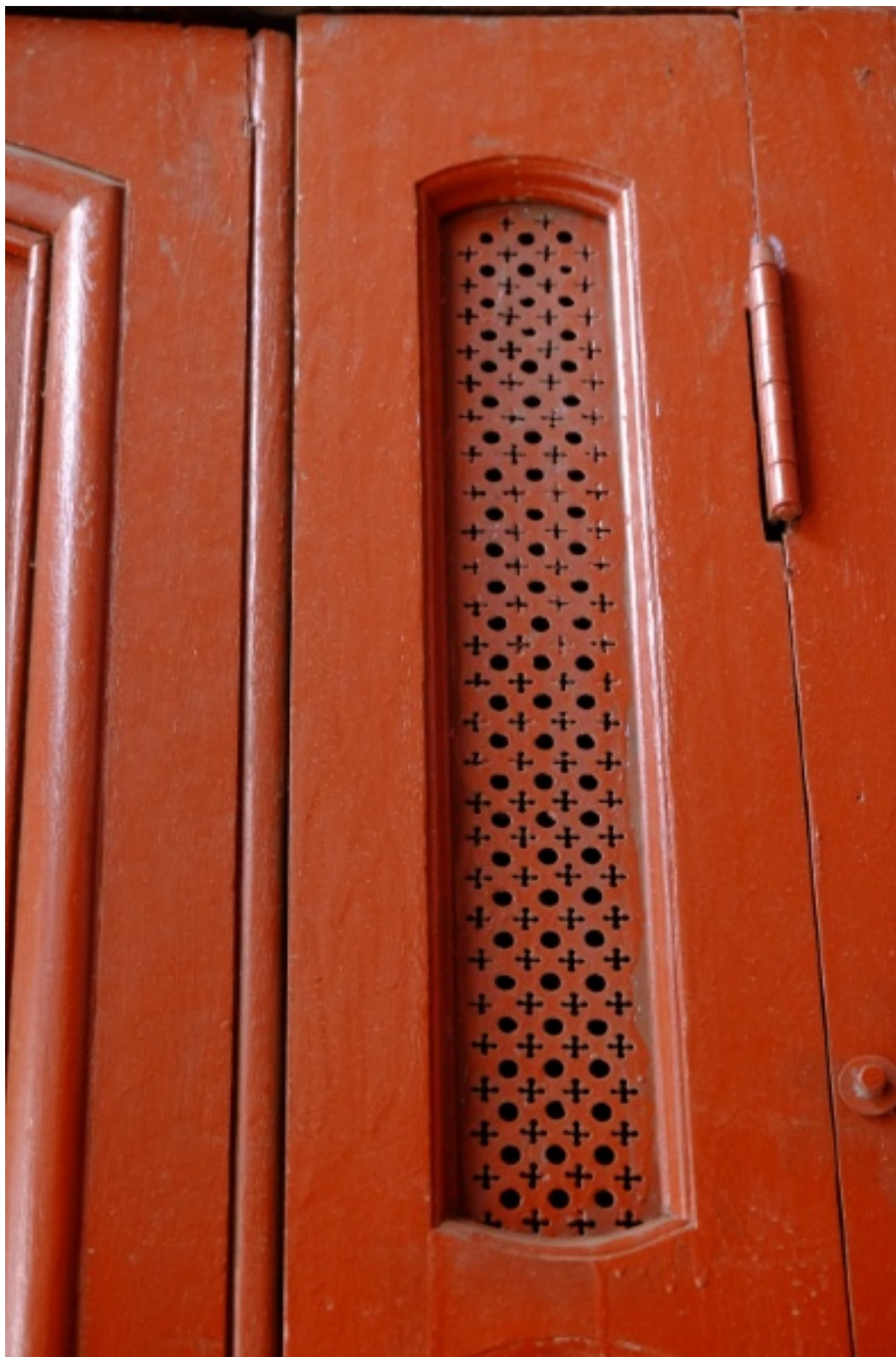
44. Кирочная улица, дом 24, литера А. «Дом Ю.Бака». Парадная лестница № 2. Тамбур. Продухи в боковой панели.
