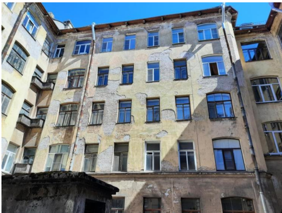
Фото 9 Фрагмент дворового фасада выявленного объекта культурного наследия «Дом Ф.Ф. Шпринга» расположенного по адресу: Санкт-Петербург, пер. Тучков, дом 11/5, литера А (Тучков пер., 11; Волховский пер., 5)
