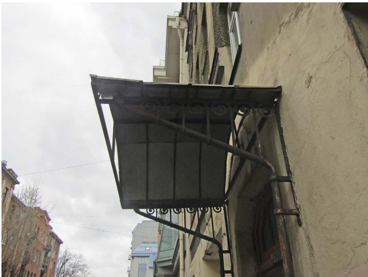
Фото 5. Вид на козырек Л-2.
