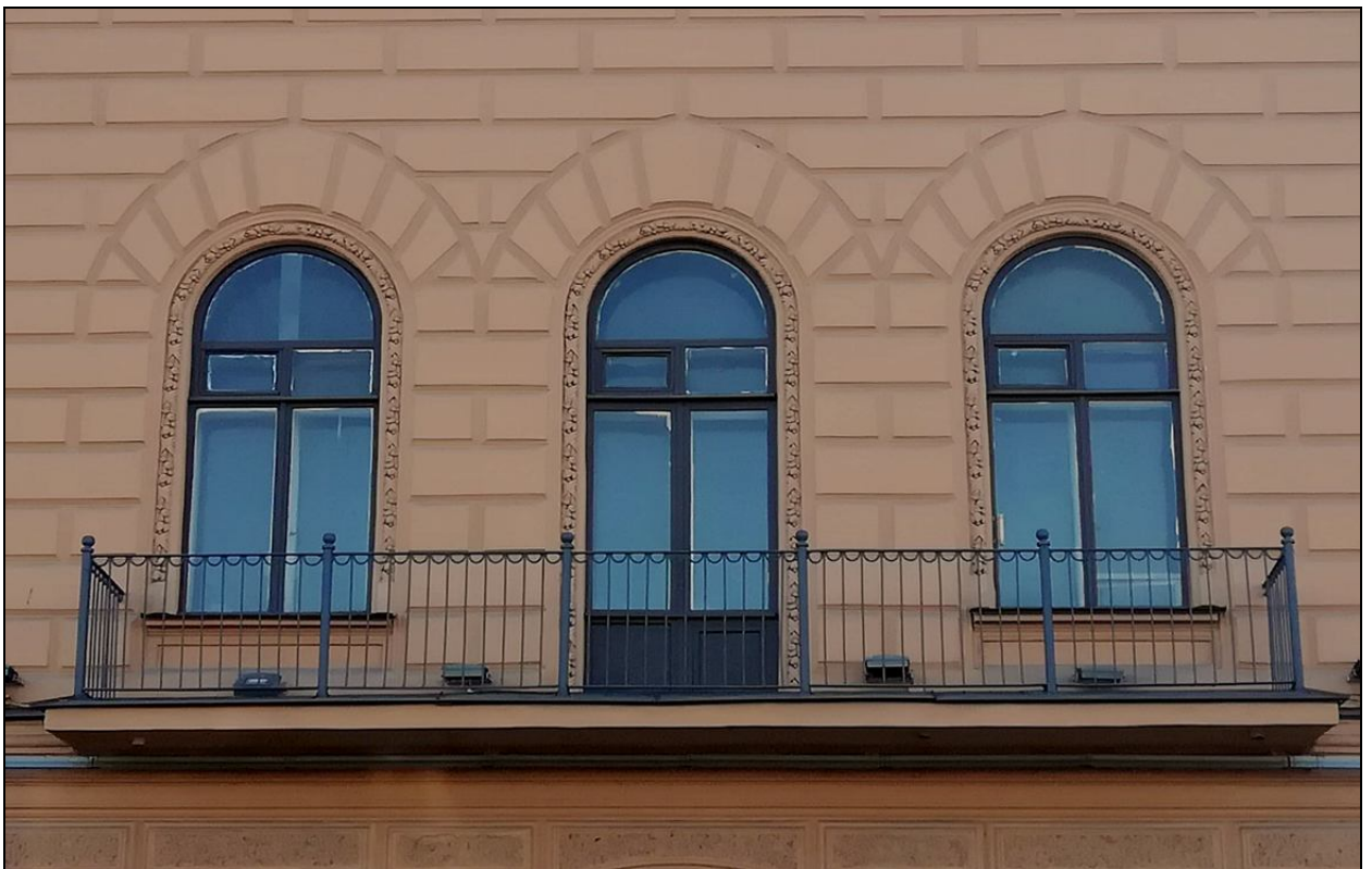
7. Балкон в уровне 2-го этажа лицевого фасада по Английской набережной. Дата съемки: 20 октября 2020 г. Фотограф: В. П. Орлов.
