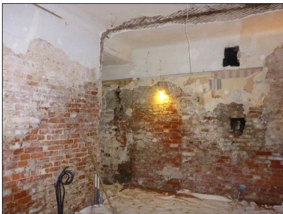
26. Квартира № 28. Вид из пом. 5/10,9 на коридор (пом. 1/9,8) после демонтажа перегородки. Дата съёмки: 20 октября 2020 г. Фотограф: В. П. Орлов.
