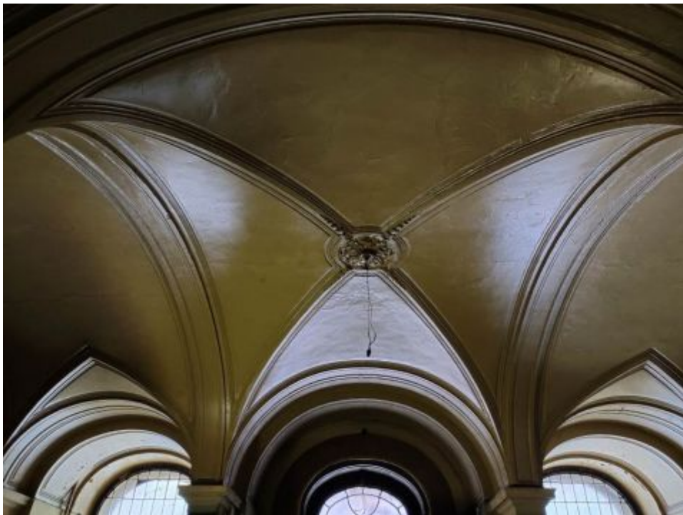
12. ОКН регионального значения «Жилой дом страхового общества “Россия” с садом и оградой» (г. Санкт-Петербург, Моховая ул., 27-29) №17 ЛК. Вестибюль. 1 Этаж.
