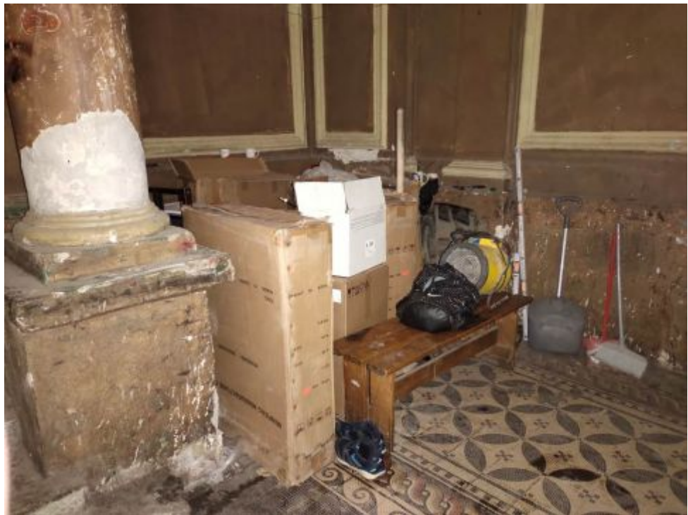
15. ОКН регионального значения «Жилой дом страхового общества «Россия» с садом и оградой» (г. Санкт-Петербург, Моховая ул., 27-29) №17 ЛК. Вестибюль. 1 Этаж.
