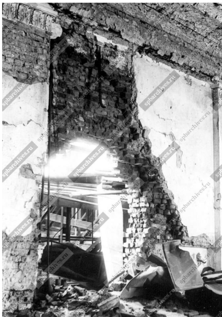
Илл. 63. Вид разрушенной стены Дома Советов. Дата съёмки: 1942 г. // ЦГАКФФД СПб. Архивный шифр: Ар 95950
