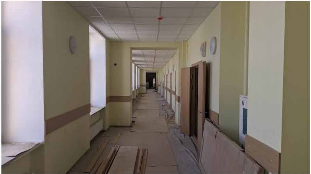
195. Вид в интерьере коридора зоны «Консерватория» в уровне 4-го этажа западного корпуса.
