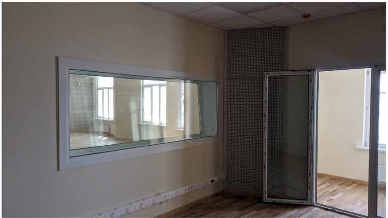
300. Вид в интерьере студии звукозаписи зоны «Консерватория» в уровне 5-го этажа западного корпуса.
