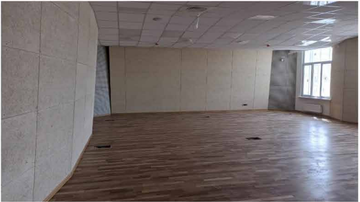
298. Вид в интерьере студии звукозаписи зоны «Консерватория» в уровне 5-го этажа западного корпуса.
