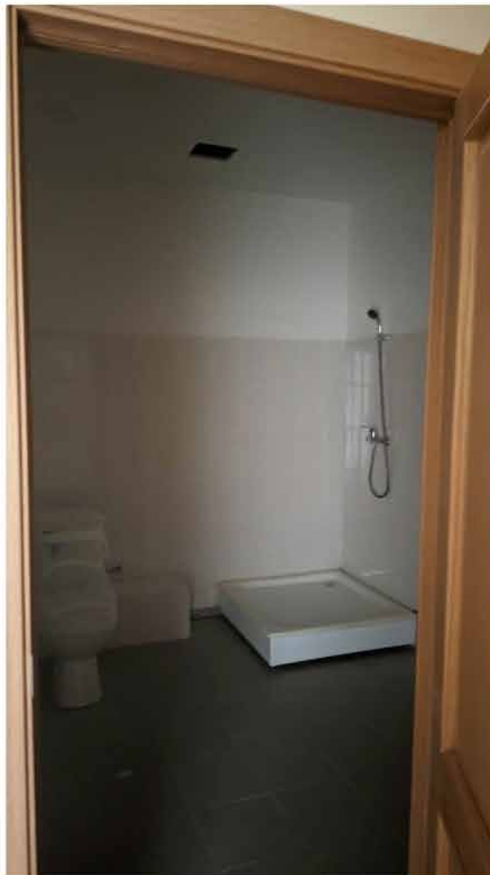
266. Вид в интерьере санузла зоны «Консерватория» в уровне 5-го этажа южного корпуса.
