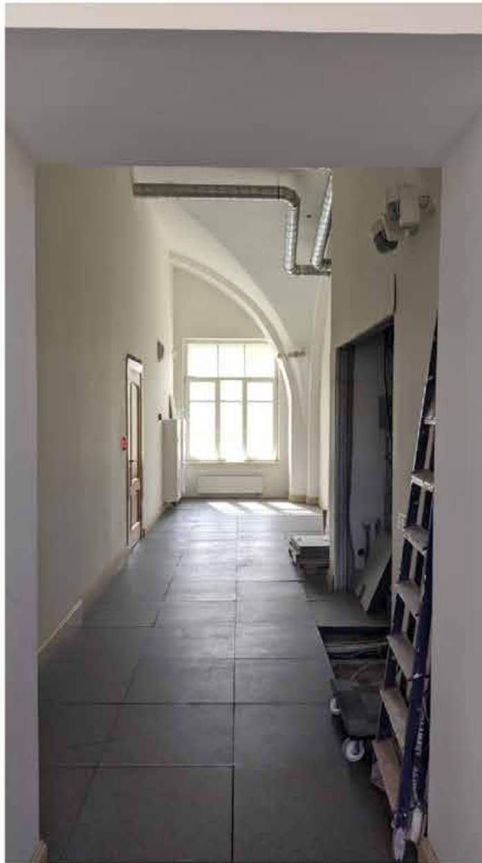
62. Вид в интерьере коридора зоны «СЗД» в уровне 3-го этажа южного корпуса.
