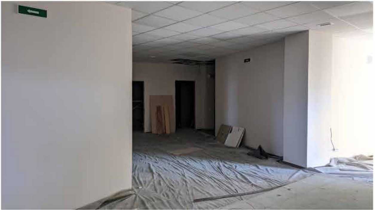
100. Вид в интерьере коридора зоны «РВИО» в уровне 4-го этажа северного корпуса.
