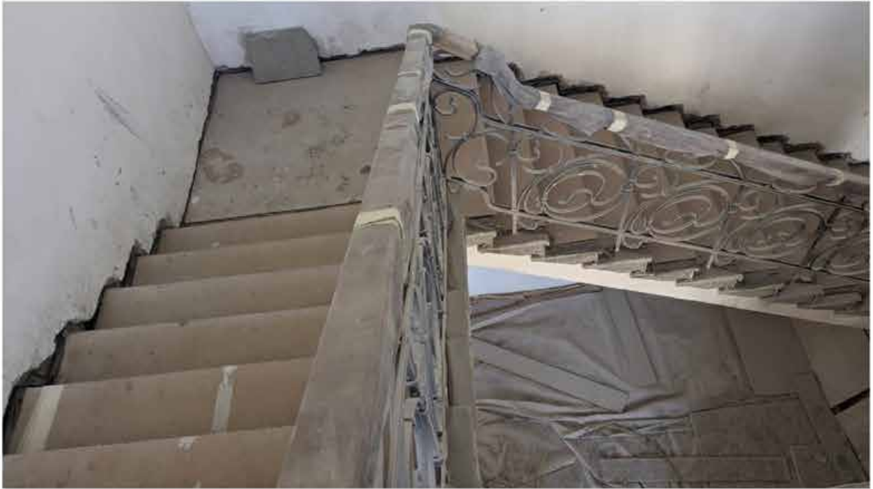
288.3. Вид в интерьере лестничной клетки зоны «Консерватория» в уровне 5-го этажа южного корпуса.
