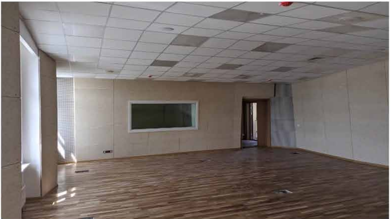
299. Вид в интерьере студии звукозаписи зоны «Консерватория» в уровне 5-го этажа западного корпуса.
