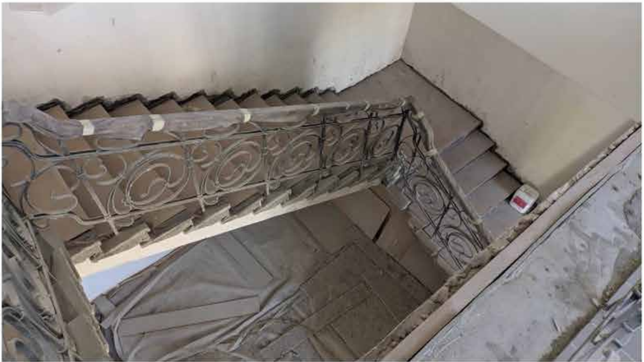
289. Вид в интерьере лестничной клетки зоны «Консерватория» в уровне 5-го этажа южного корпуса.
