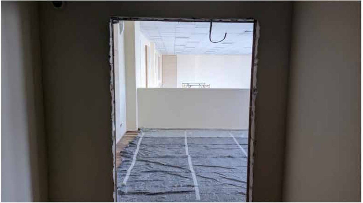
254. Вид в интерьере балкона репетиционного зала зоны «Консерватория» в уровне 5-го этажа южного корпуса.
