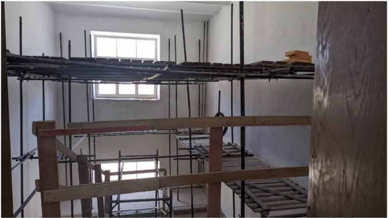
316. Вид в интерьере лестничной клетки зоны «Консерватория» в уровне 5-го этажа западного корпуса.
