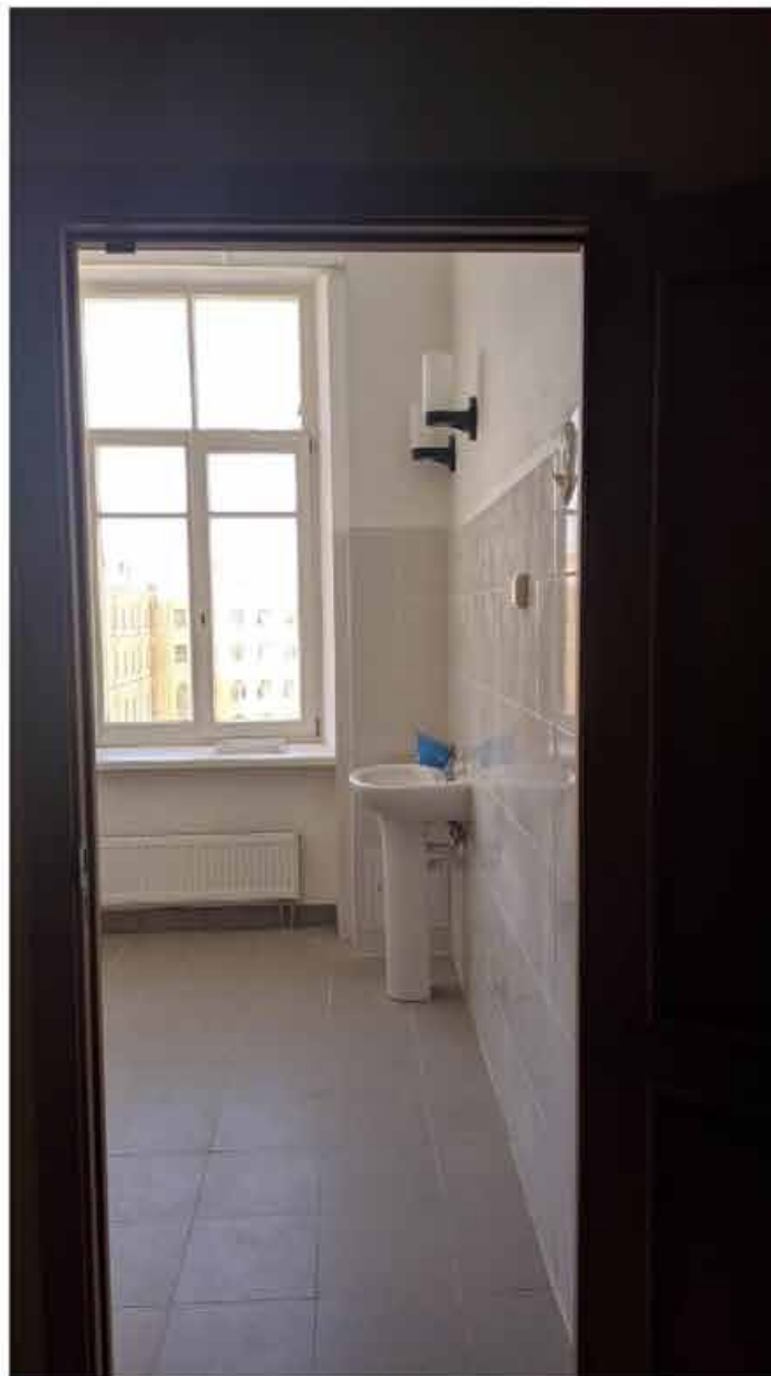
277. Вид в интерьере санузла зоны «Консерватория» в уровне 5-го этажа южного корпуса.
