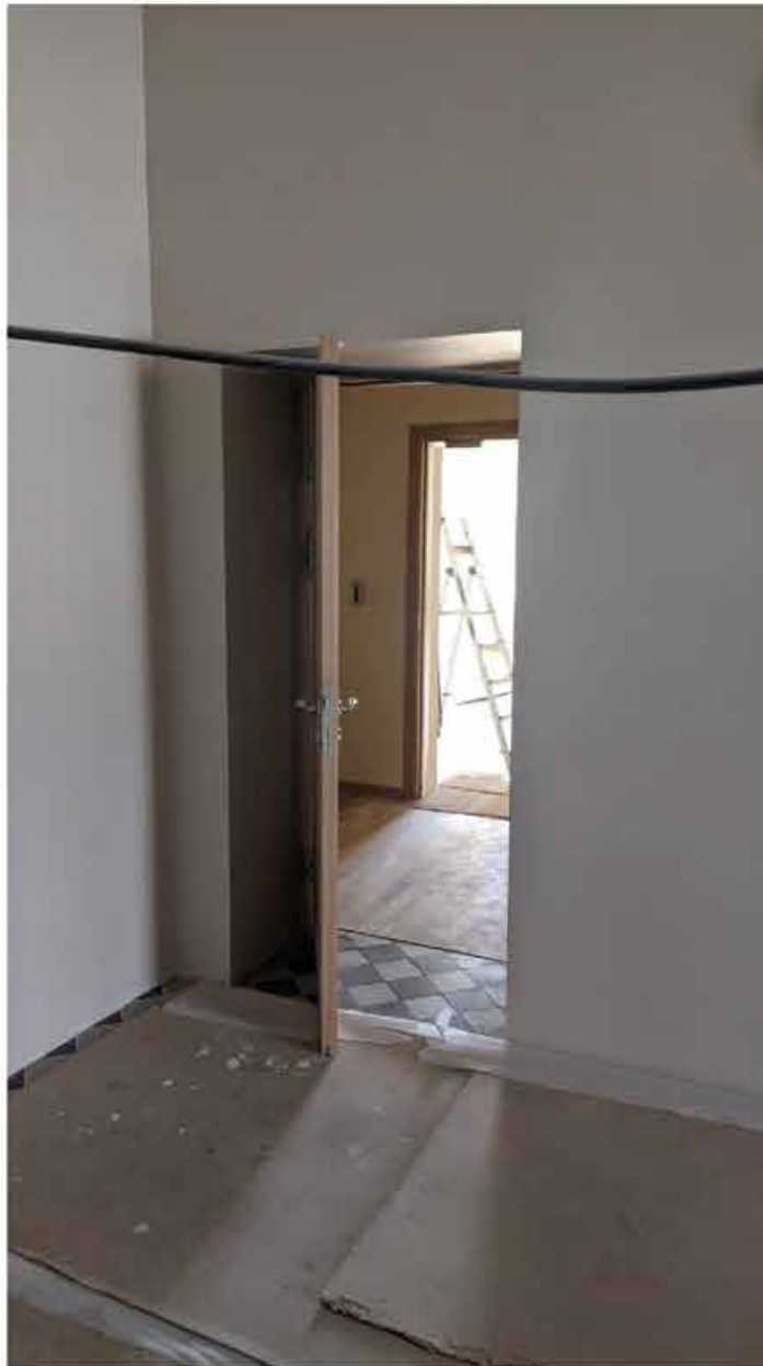
260. Вид в интерьере коридора зоны «Консерватория» в уровне 5-го этажа южного корпуса.
