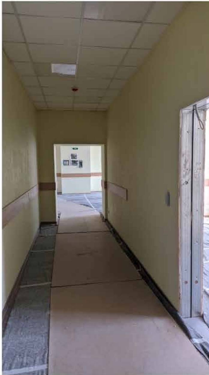
233. Вид в интерьере коридора зоны «Консерватория» в уровне 4-го этажа южного корпуса.
