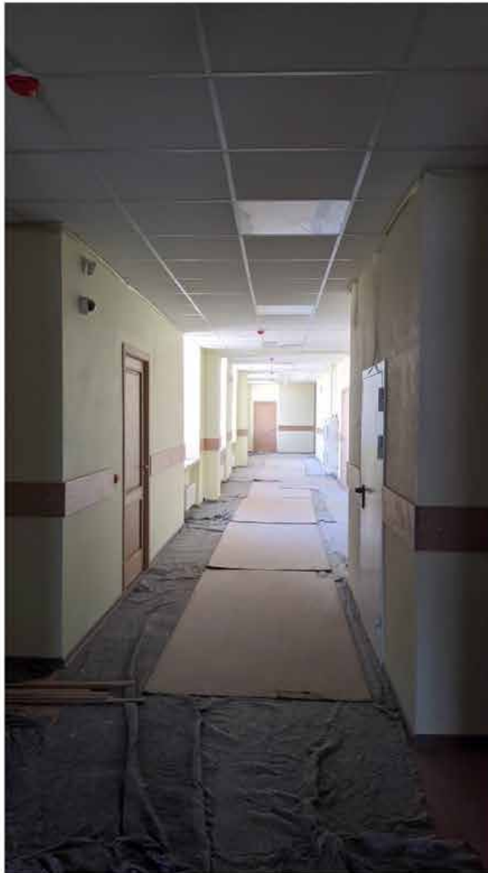
269. Вид в интерьере коридора зоны «Консерватория» в уровне 5-го этажа южного корпуса.
