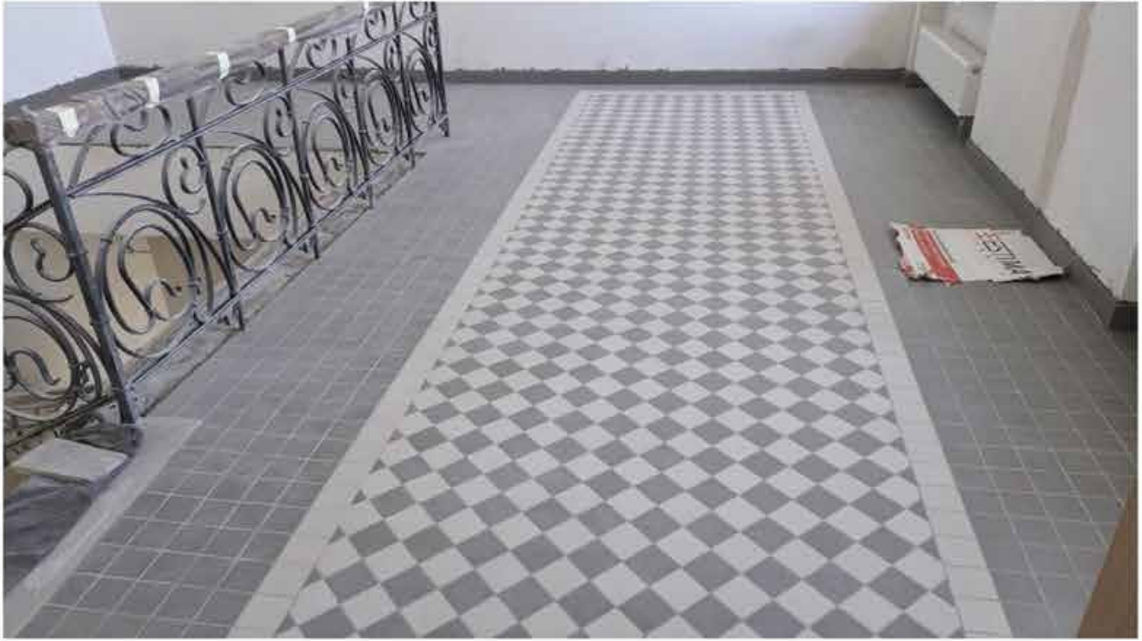
288.1. Вид в интерьере лестничной клетки зоны «Консерватория» в уровне 5-го этажа южного корпуса.
