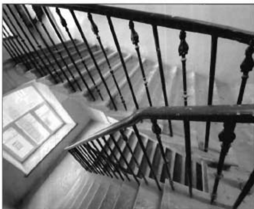
37. Двухмаршевые служебные лестницы (11ЛК). Сколы ступеней, истертости в ходовых местах, утраты металлических стоек ограждений. Фото от 16.11.2021 г.
