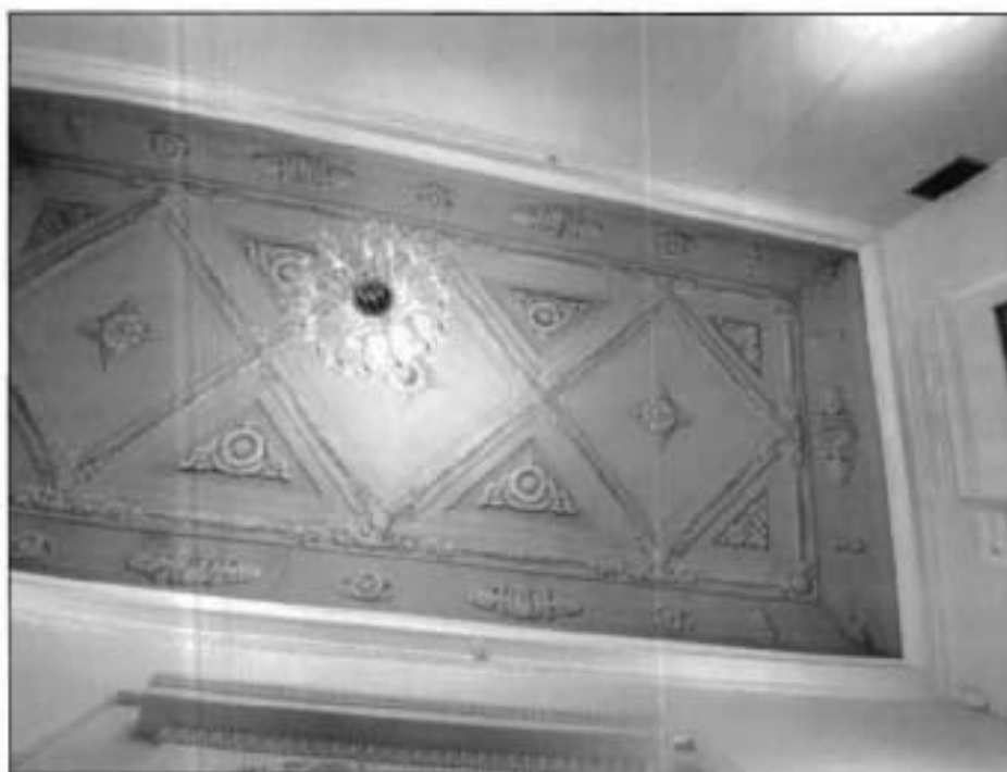
43. Декоративно художественная отделка помещений в уровне 3-го этажа (пом. 27-Н (12)). Живописный плафон. Фото от 19.11.2021 г.
