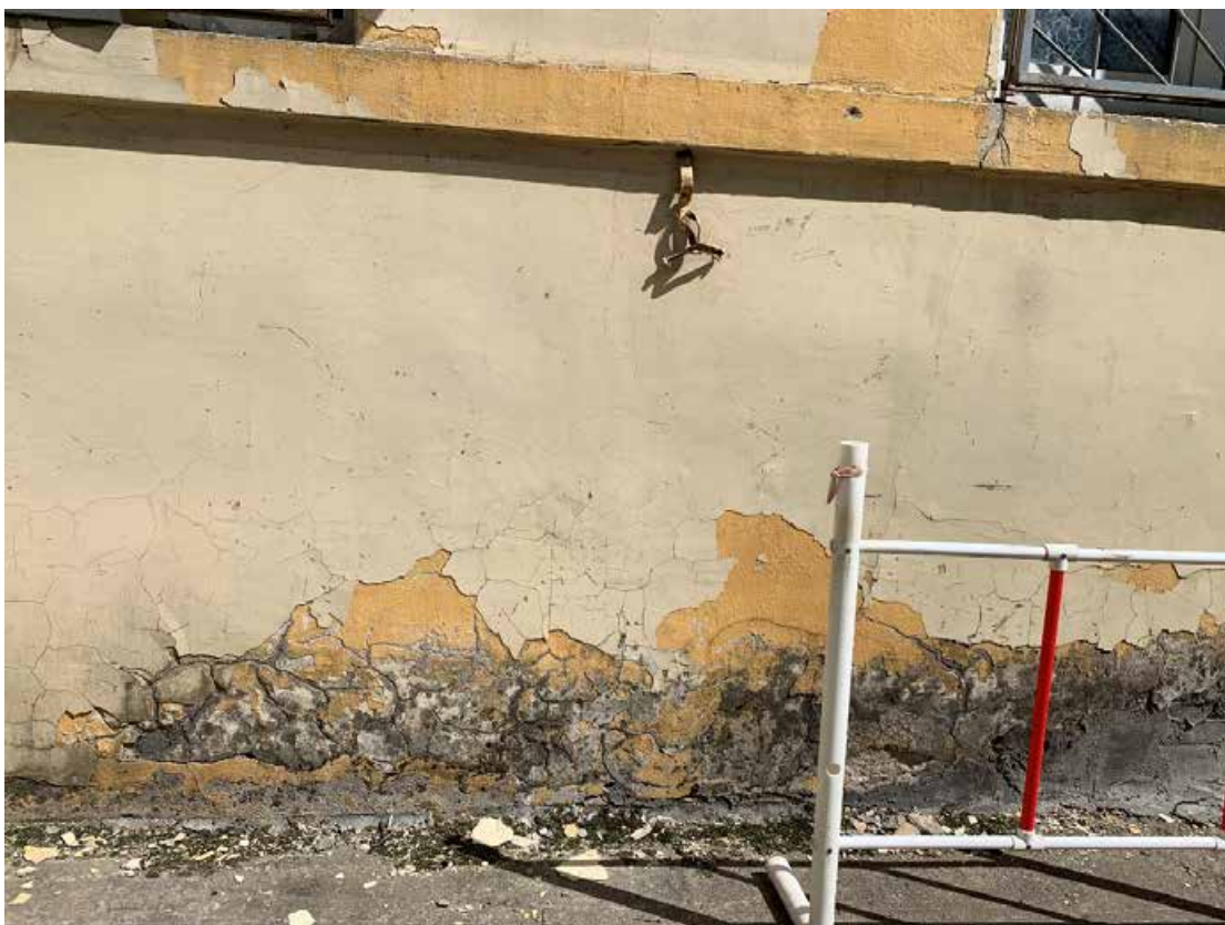
Фото №70. Фрагмент оконных проемов. Наблюдается деструкция красочного и штукатурного слоя, многочисленные волосяные трещины по красочному слою, общая загрязненность фасада.
