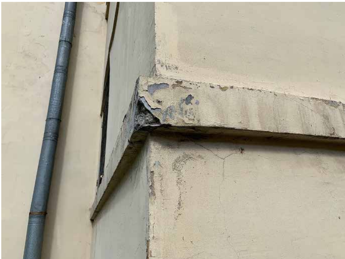
Фото №139. Фрагмент фасада. Наблюдаются деструкция красочного и штукатурного слоя, сколы, общая загрязненность.
