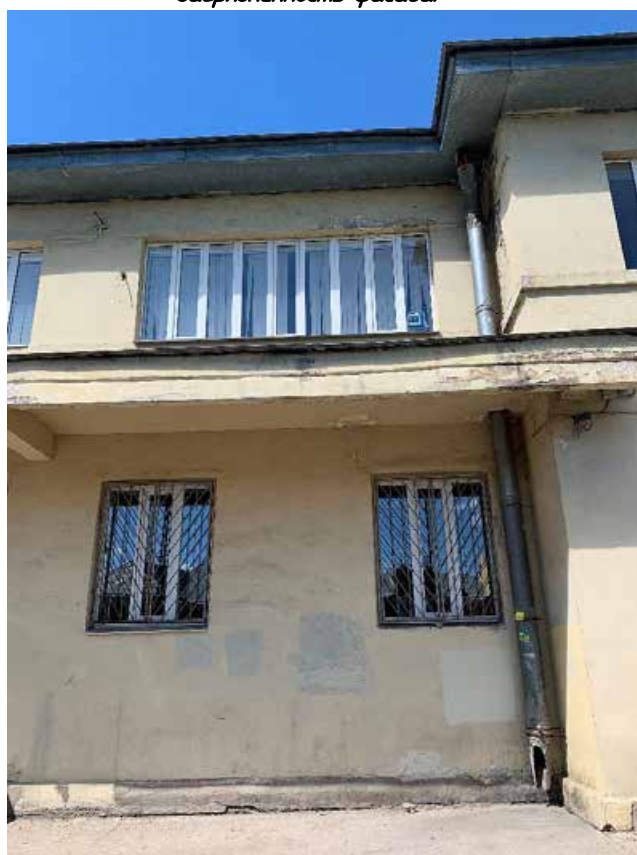
Фото №156. Фрагмент бокового фасада с козырьком. Наблюдается деструкция красочного слоя, сколы, сеть волосяных трещин, поздние ремонтные вмешательства, общая загрязненность фасада.
