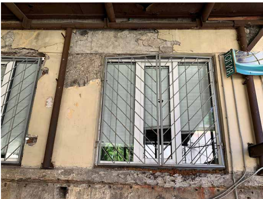
Фото №100. Фрагмент оконного проема. Наблюдается общая деструкция красочного и штукатурного слоя, сколы, сеть волосяных трещин, общая загрязненность.
