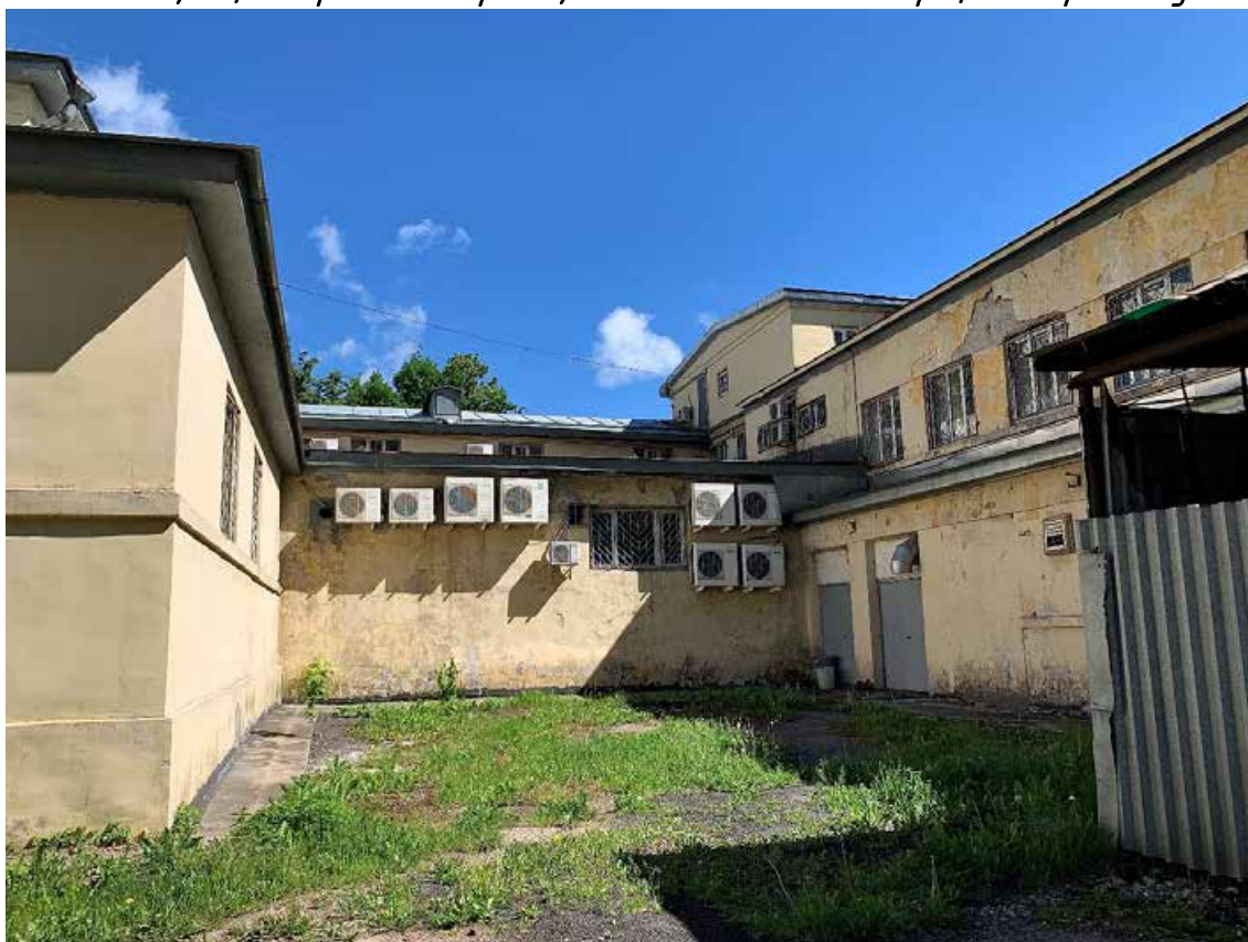
Фото №53. Общий вид дворового фасада. Наблюдается деградация красочного и штукатурного слоя, современные стеклопакеты, общая загрязненность фасада, многочисленные волосяные трещины по красочному слою.
