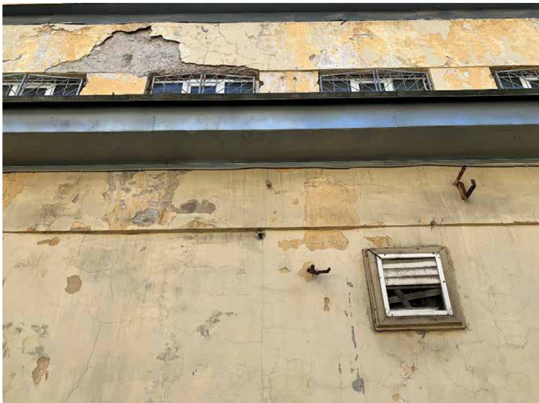
Фото №107. Фрагмент фасада. Наблюдаются деградация красочного и штукатурного слоя, общая загрязненность.
