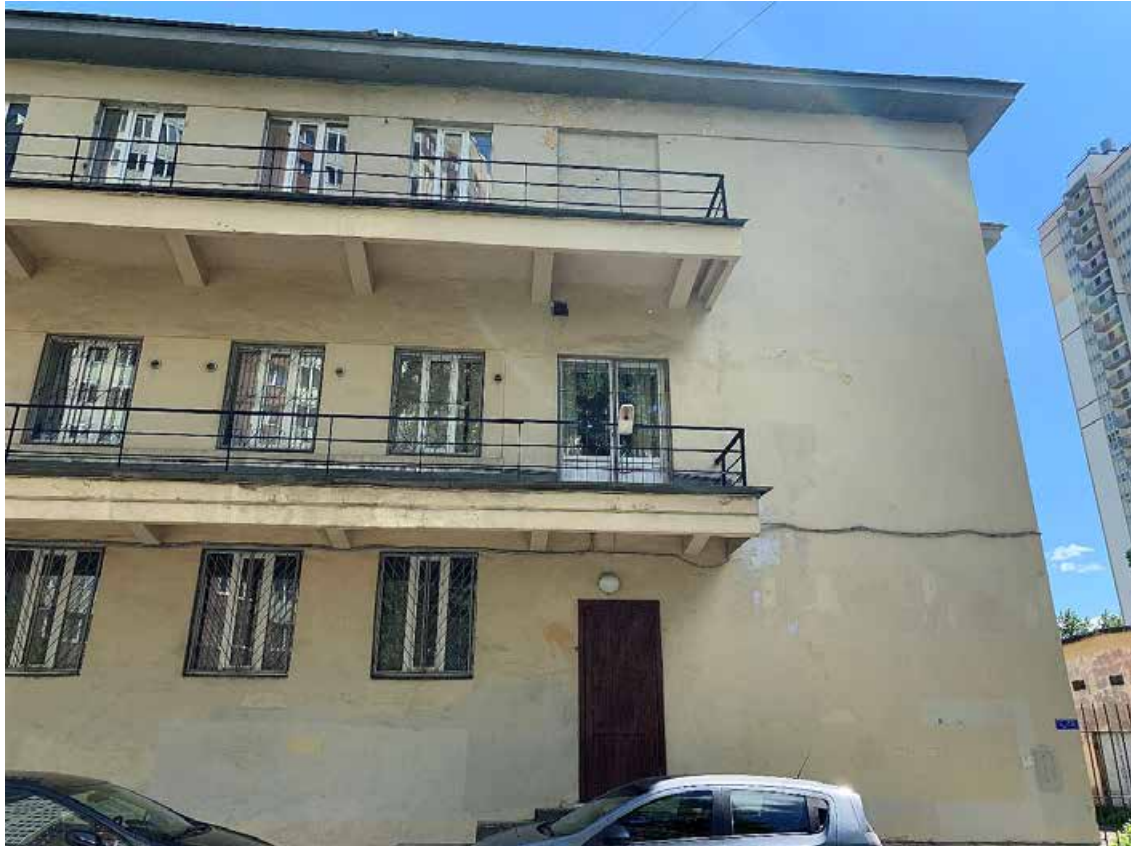
Фото №36. Фрагмент докового фасада с балконом. Наблюдается деградация красочного и штукатурного слоя, современные стеклопакеты, общая загрязненность фасада, трещины и поздние ремонтные вмешательства.
