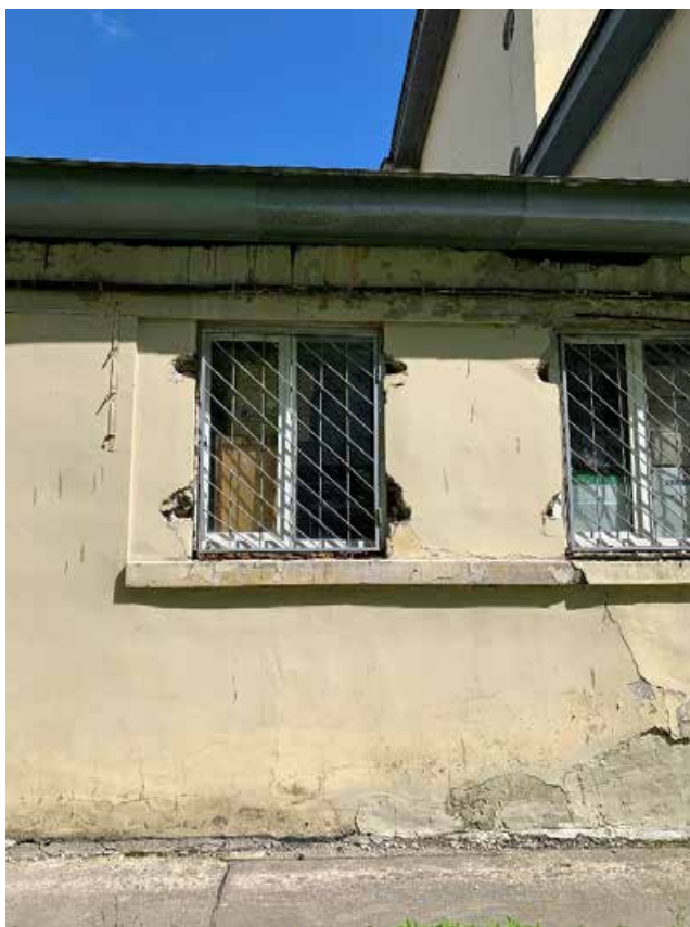
Фото №87. Фрагмент оконных проемов. Наблюдается деструкция красочного и штукатурного слоя, сеть волосяных трещин, общая загрязненность.
