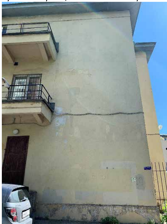
Фото №4.2. Фрагмент бокового фасада. Наблюдается деградация красочного и штукатурного слоя, общая загрязненность фасада, поздние ремонтные вмешательства.
