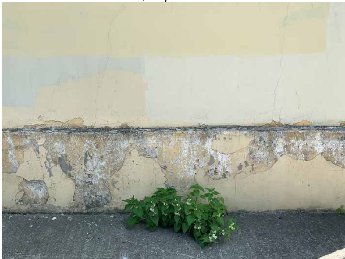
Фото №44. Фрагмент цоколя докового фасада. Фрагмент докового фасада. Наблюдается деградация красочного слоя, общая загрязненность.
