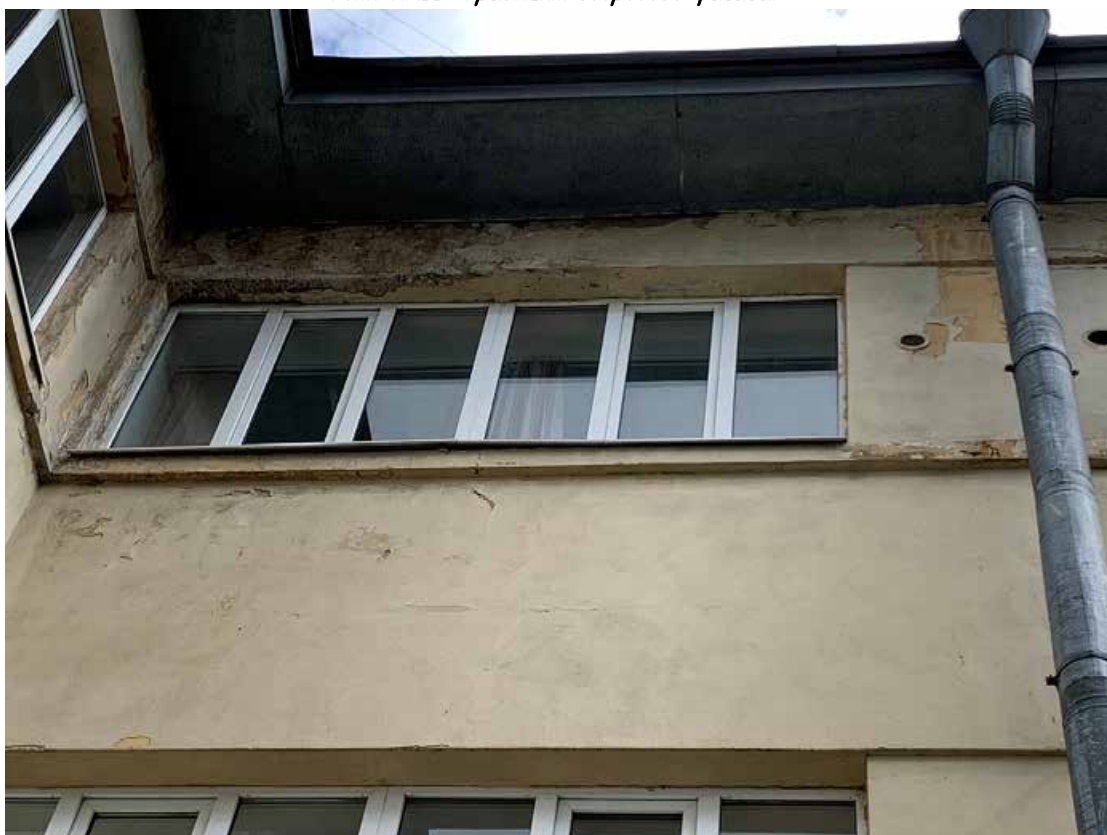
Фото №134. Фрагмент фасада. Наблюдаются деструкция красочного и штукатурного слоя, потеки, волосяные трещины, общая загрязненность.
