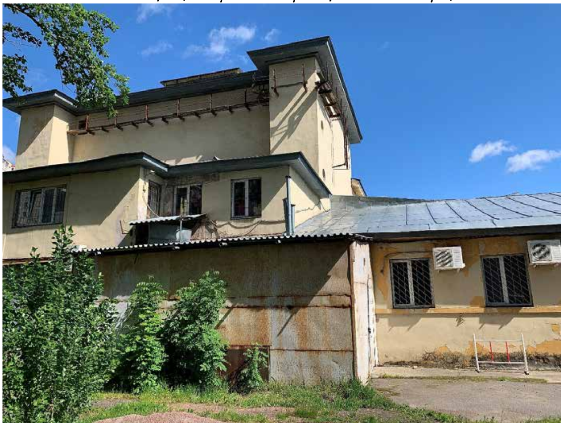
Фото №61. Общий вид оборотного фасада. Наблюдается деструкция красочного и штукатурного слоя, современные стеклопакеты, общая загрязненность фасада, многочисленные волосяные трещины по красочному слою.
