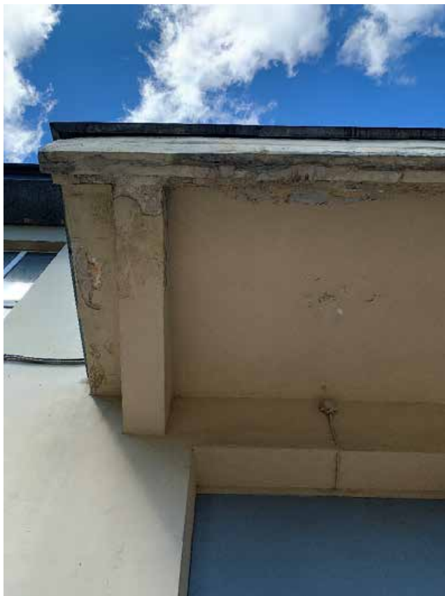
Фото №161. Фрагмент козырька докового фасада. Наблюдается деградация красочного и штукатурного слоя, сколы, сеть волосяных трещин, общая загрязненность.
