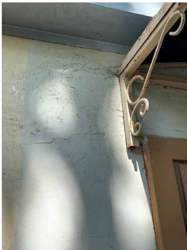
Фото №173. Фрагмент бокового фасада. Наблюдается сеть волосяных трещин, поздние ремонтные вмешательства, общая загрязненность.
