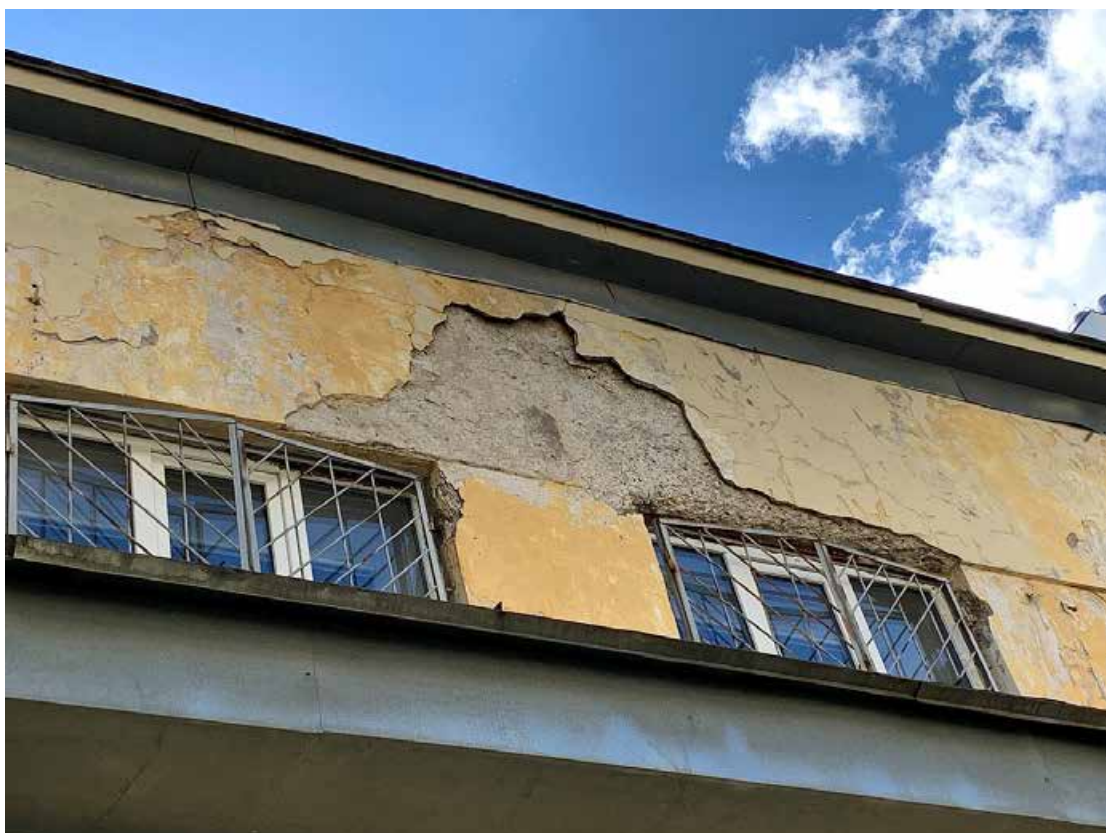
Фото №88. Фрагмент фасада. Наблюдаются деградация красочного и штукатурного слоя, сколы, общая загрязненность.
