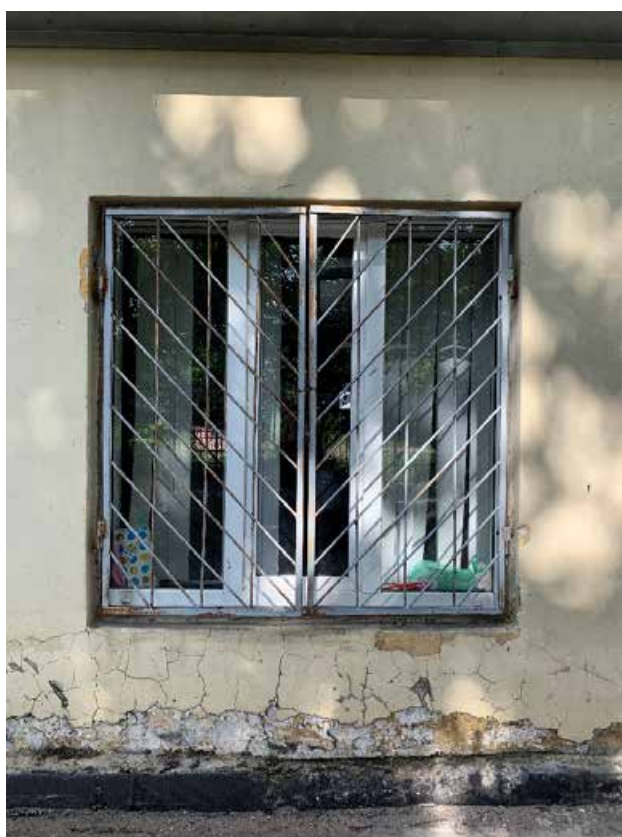
Фото №178. Фрагмент оконного проема. Наблюдается деструкция красочного и штукатурного слоя, волосяных трещин, сколы, общая загрязненность.
