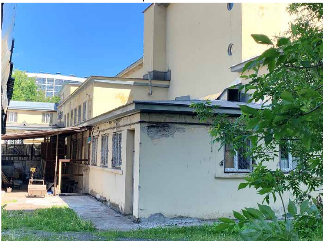
Фото №90. Фрагмент фасада. Наблюдается деструкция красочного и штукатурного слоя, сеть волосяных трещин, общая загрязненность.
