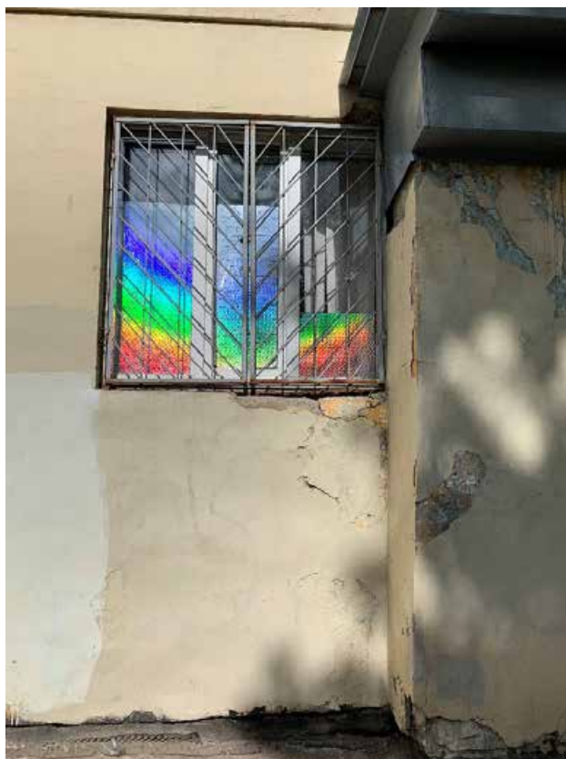
Фото №181. Фрагмент оконного проема. Наблюдается деструкция красочного и штукатурного слоя, волосяных трещин, сколы, поздние ремонтные вмешательства, общая загрязненность.
