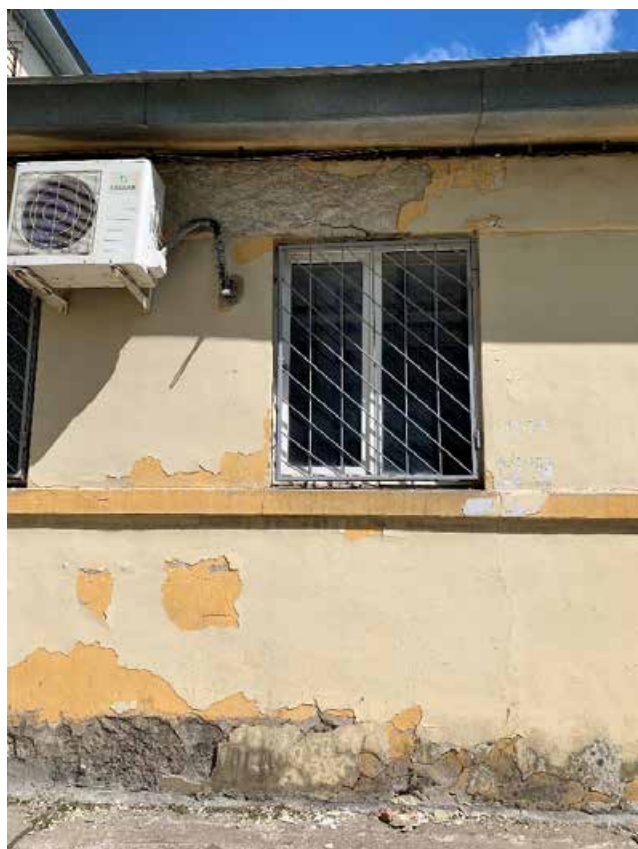
Фото №69. Фрагмент дворового фасада. Наблюдается деструкция красочного и штукатурного слоя сеть волосяных трещин, общая загрязненность фасада.
