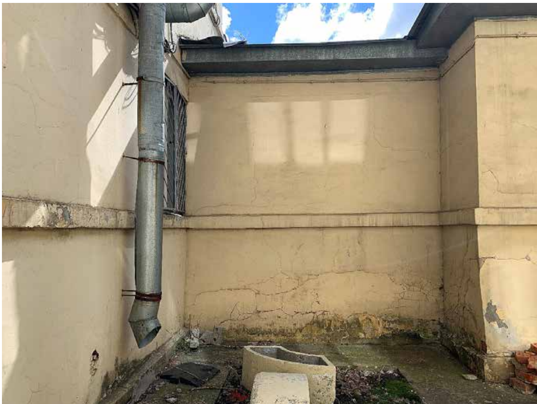
Фото №131. Фрагмент фасада. Наблюдаются деструкция красочного и штукатурного слоя, биопоражения, сеть волосяных трещин, трещины, общая загрязненность.
