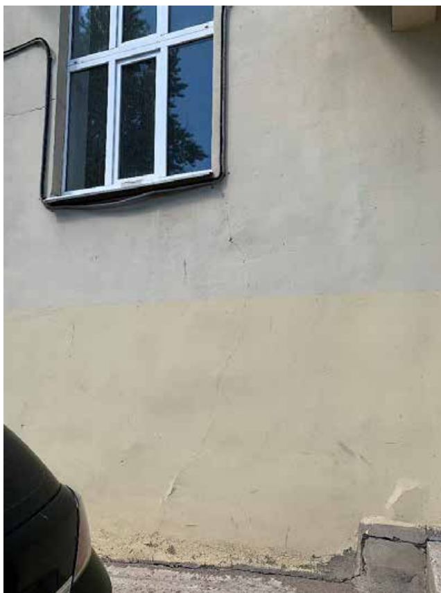
Фото №163. Фрагмент бокового фасада. Наблюдается деградация красочного слоя, сеть волосяных трещин, поздние ремонтные вмешательства, общая загрязненность.
