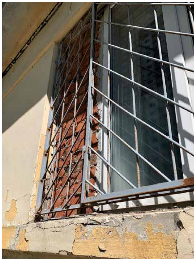
Фото №68. Фрагмент оконного проема. Наблюдается частичное заложение проема кирпичом.
