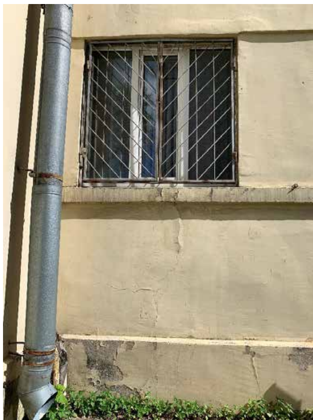
Фото №145. Фрагмент оконного проема. Наблюдается деструкция красочного слоя, общая загрязненность, сеть волосяных трещин.
