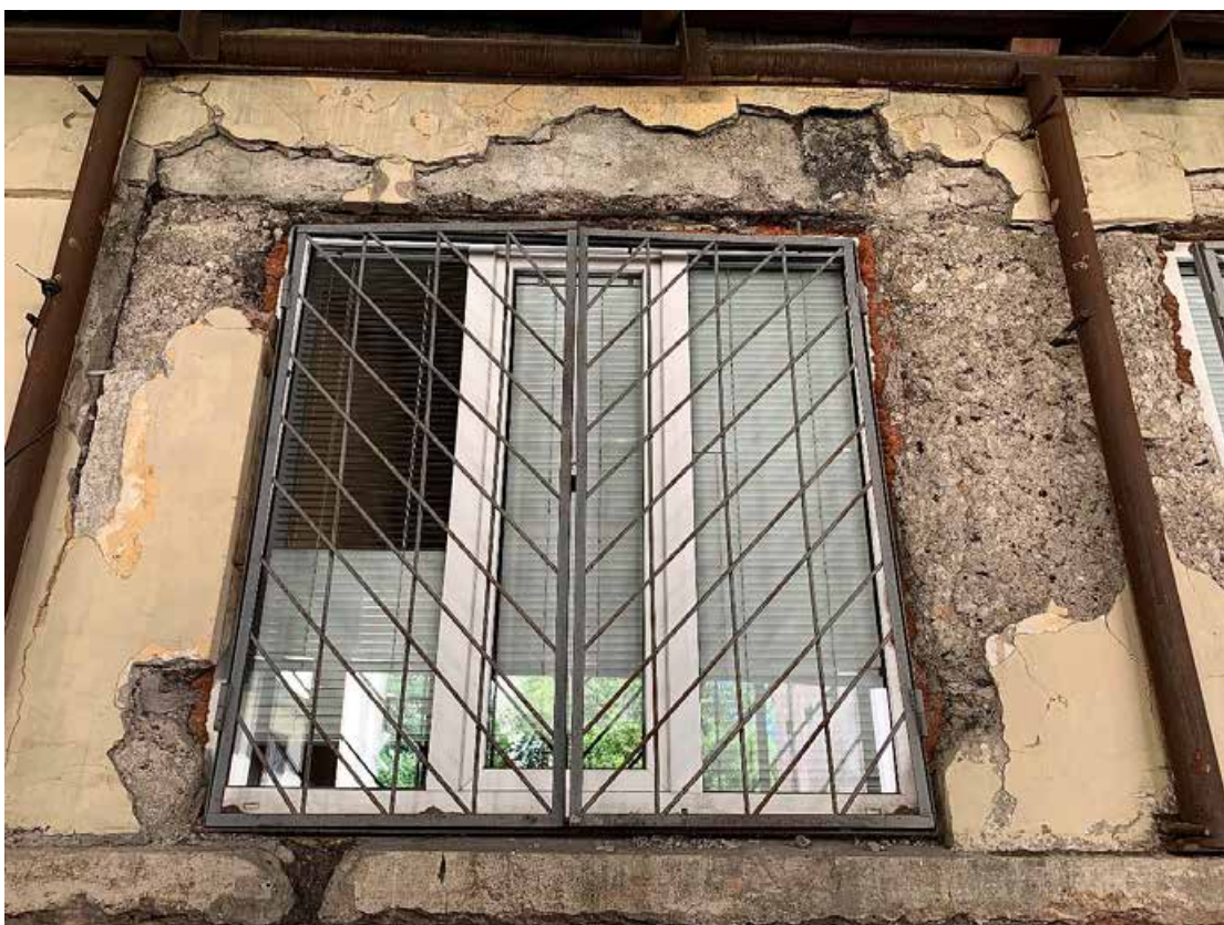
Фото №102. Фрагмент оконного проема. Наблюдаются деструкция красочного и штукатурного слоя, сколы, трещины, общая загрязненность.
