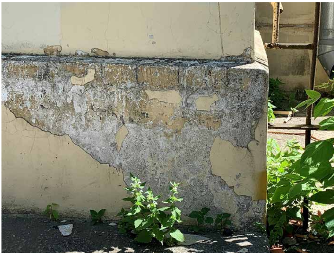
Фото №43. Фрагмент цоколя докового фасада. Фрагмент докового фасада. Наблюдается деградация красочного слоя, общая загрязненность.
