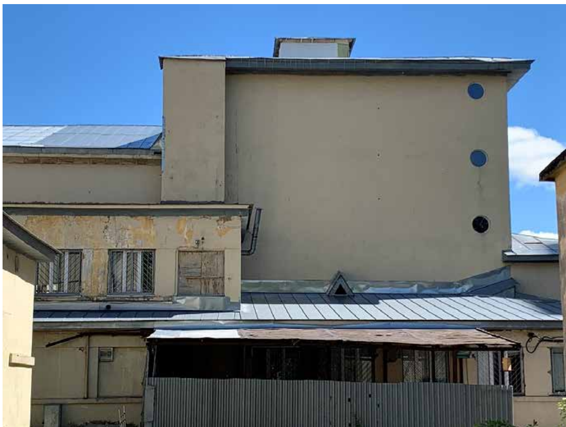
Фото №105. Фрагмент фасада. Наблюдаются деструкция красочного и штукатурного слоя, трещины, общая загрязненность.
