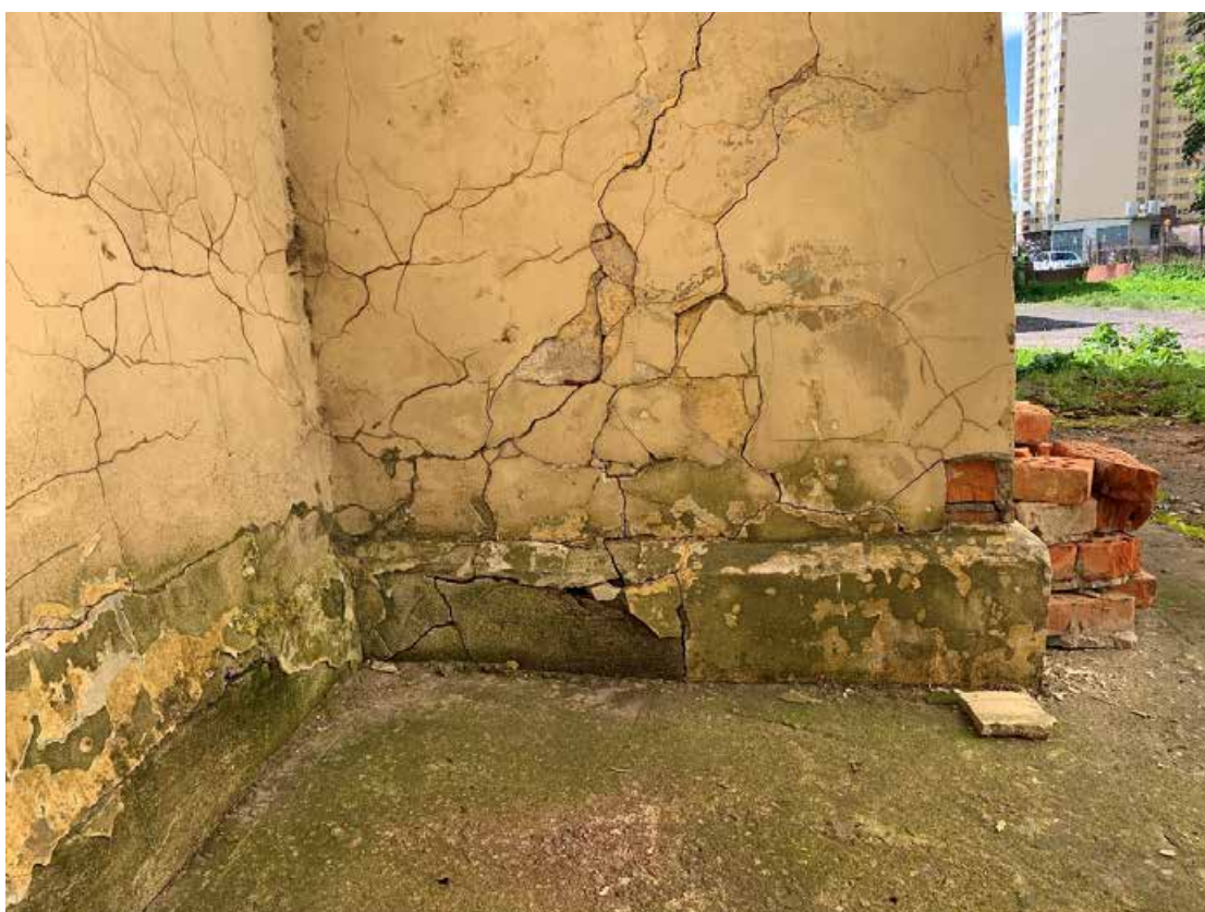
Фото №130. Фрагмент цоколя. Наблюдаются деградация красочного и штукатурного слоя, биопоражения, сеть волосяных трещин, трещины, общая загрязненность.
