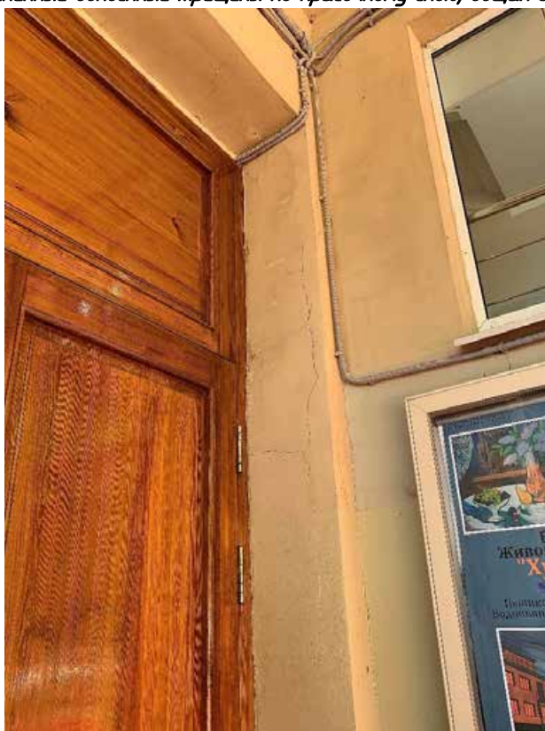
Фото №22. Фрагмент входной группы главного фасада с козырьком. Наблюдаются трещины, деструкция штукатурного слоя, многочисленные волосяные трещины по красочному слою, поздние ремонтные вмешательства, общая загрязненность.
