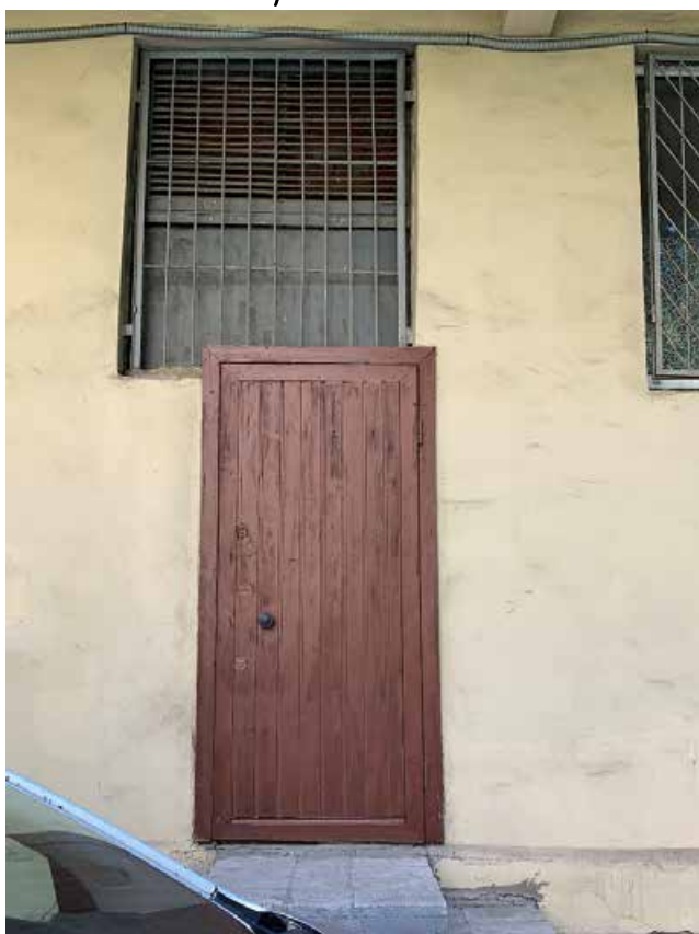
Фото №4.8. Фрагмент входной деревянной двери докового фасада. Наблюдается деструкция красочного слоя, общая загрязненность.
