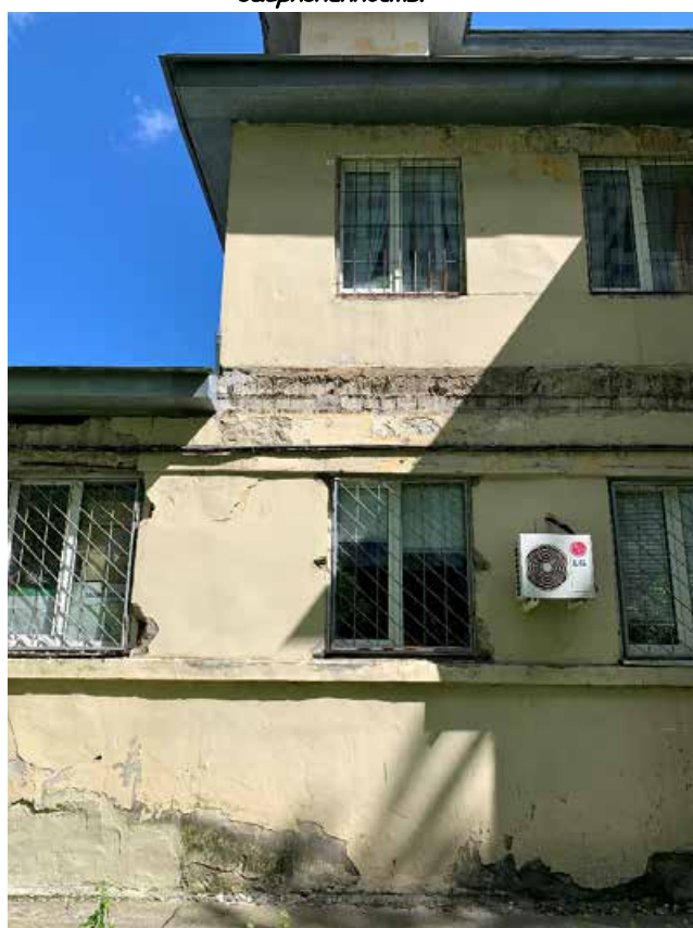
Фото №86. Фрагмент фасада. Наблюдается деструкция красочного и штукатурного слоя, сеть волосяных трещин, общая загрязненность.
