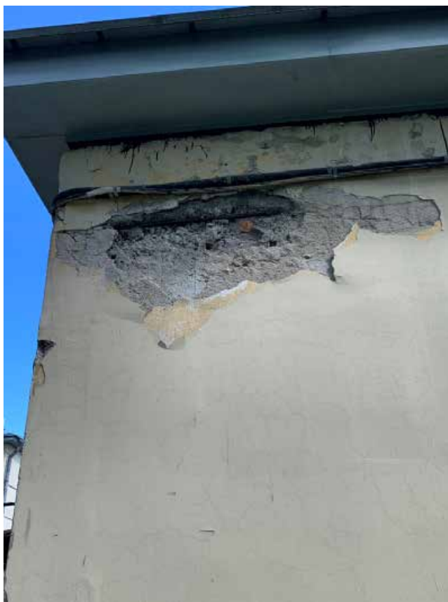
Фото №91. Фрагмент фасада. Наблюдается деструкция красочного и штукатурного слоя, сеть волосяных трещин, общая загрязненность.
