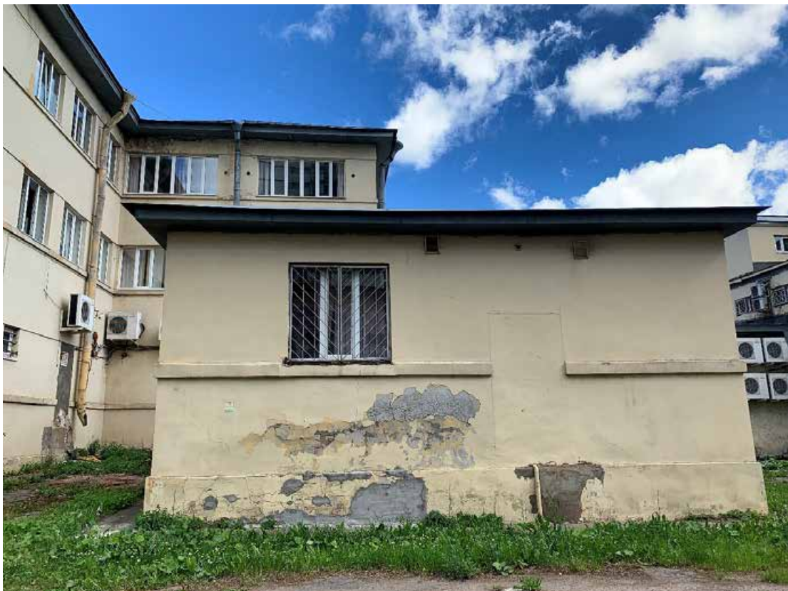
Фото №123. Фрагмент фасада. Наблюдаются деструкция красочного и штукатурного слоя, сеть волосяных трещин, поздние ремонтные вмешательства, общая загрязненность.
