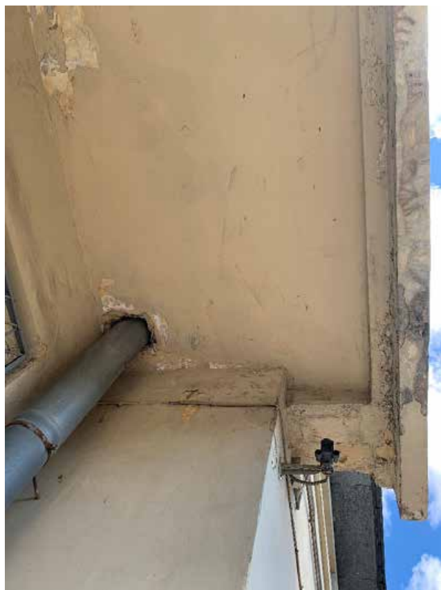
Фото №157. Фрагмент козырька бокового фасада. Наблюдается деструкция красочного и штукатурного слоя, сколы, сеть волосяных трещин, общая загрязненность.
