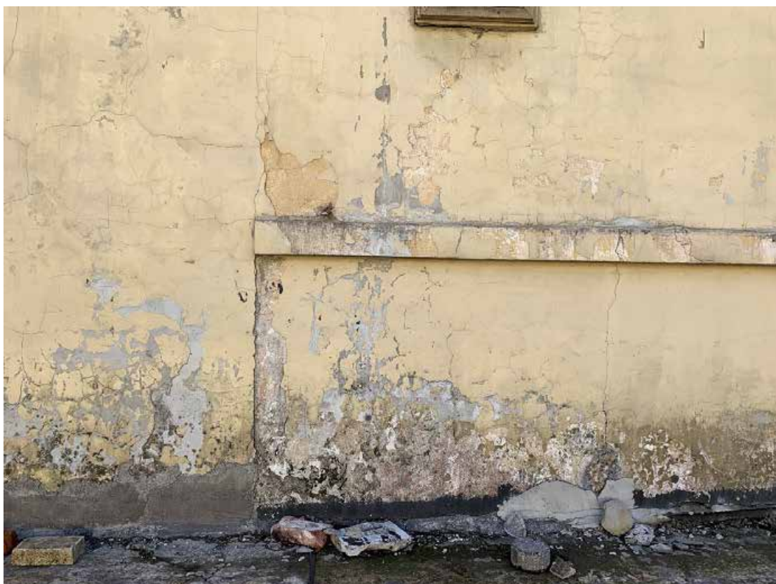
Фото №108. Фрагмент фасада. Наблюдаются деградация красочного и штукатурного слоя, биопоражения, общая загрязненность.
