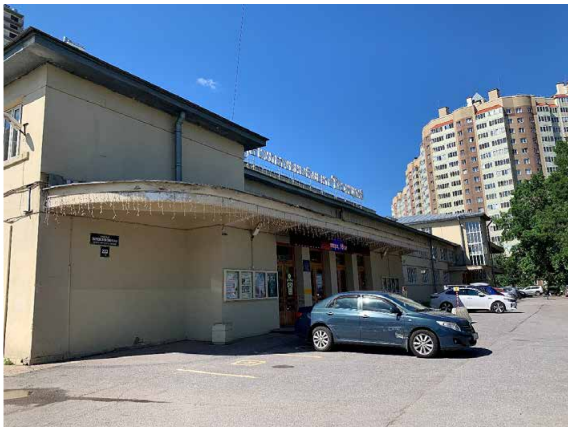
Фото №5. Фрагмент главного фасада со стороны проспекта Обуховской Обороны. Наблюдается деградация штукатурного слоя, общая загрязненность фасада, трещины.
