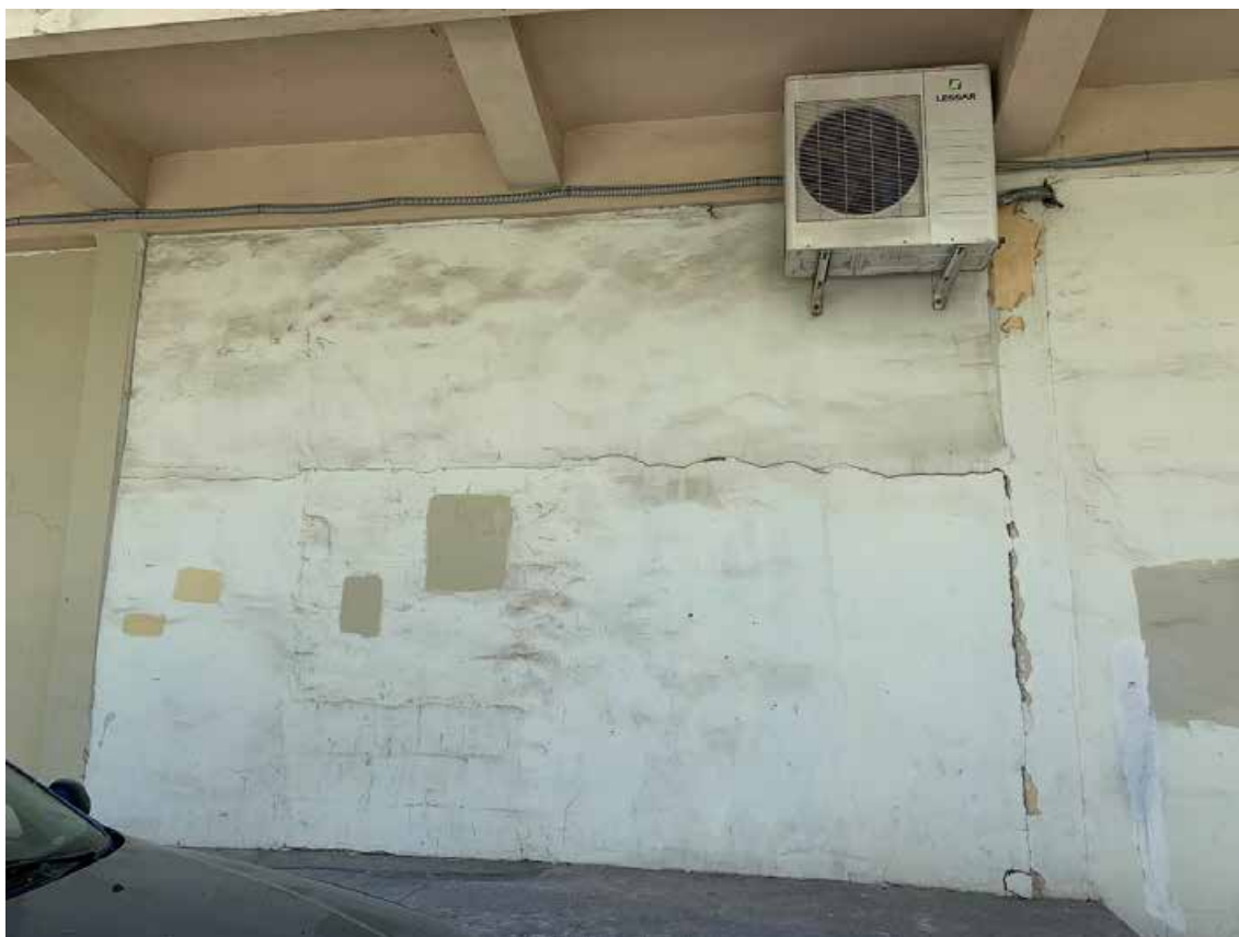
Фото №4.1. Фрагмент бокового фасада. Наблюдается деградация красочного и штукатурного слоя, трещины, общая загрязненность фасада, следы некачественного ремонта.
