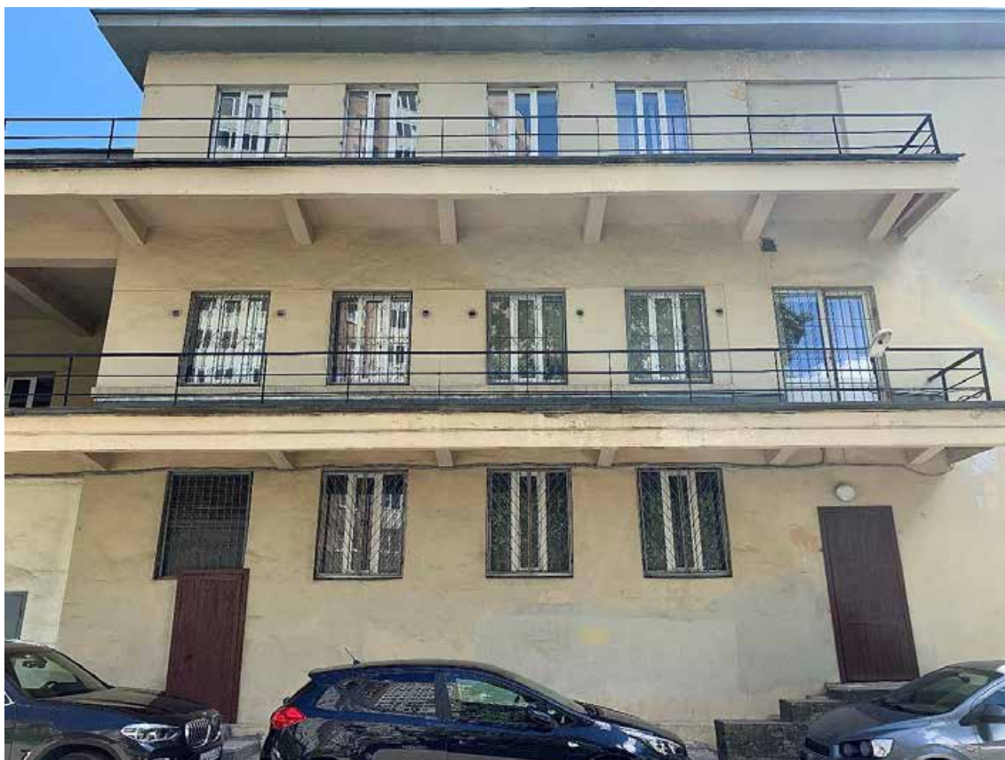
Фото №35. Фрагмент докового фасада с балконом. Наблюдается деградация красочного и штукатурного слоя, современные стеклопакеты, общая загрязненность фасада, трещины и поздние ремонтные вмешательства.
