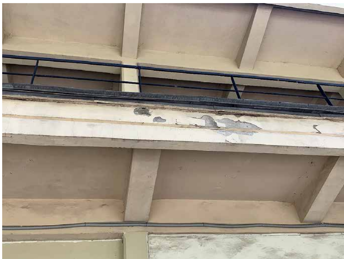
Фото №40. Фрагмент балкона бокового фасада. Наблюдается деградация красочного и штукатурного слоя, многочисленные волосяные трещины по красочному слою, общая загрязненность.
