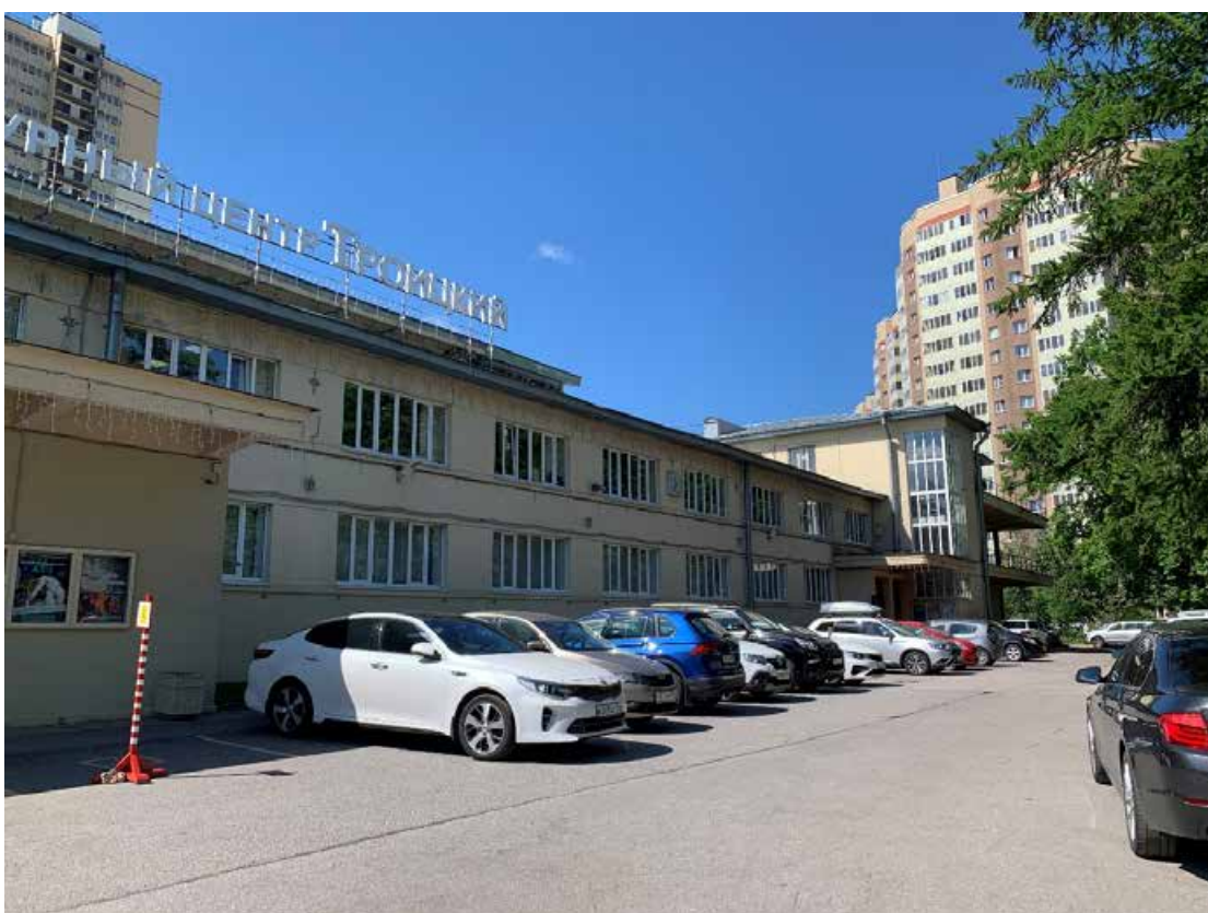
Фото №2. Главный фасад со стороны проспекта Обуховской Обороны. Наблюдается деструкция штукатурного слоя, современные стеклопакеты, общая загрязненность фасада, трещины.
