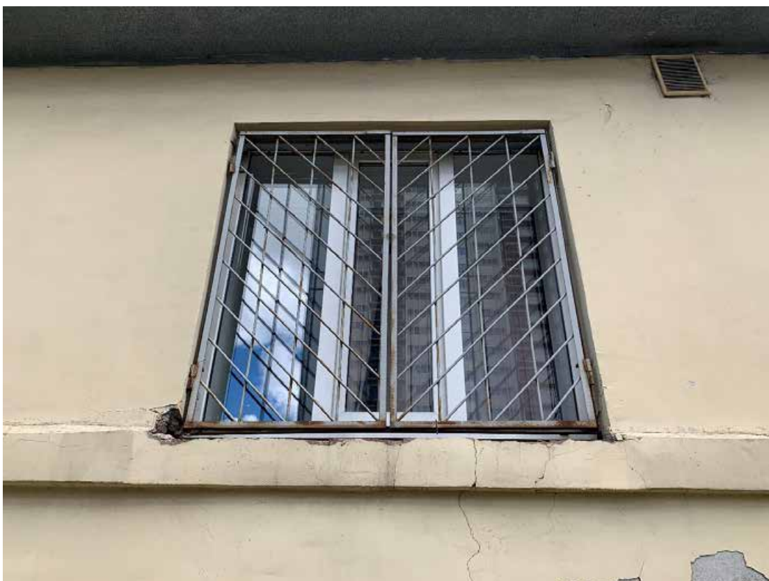
Фото №126. Фрагмент оконного проема. Наблюдаются деструкция красочного слоя, сколы, трещины, по красочному слою, общая загрязненность.
