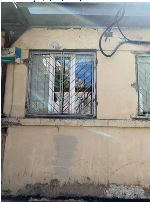
Фото №96. Фрагмент оконных проемов. Наблюдается общая деструкция красочного и штукатурного слоя, сеть волосяных трещин, общая загрязненность.
