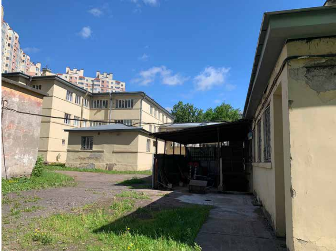
Фото №57. Общий вид дворового фасада. Наблюдается деградация красочного и штукатурного слоя, современные стеклопакеты, общая загрязненность фасада, многочисленные волосяные трещины по красочному слою.
