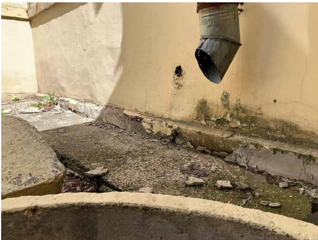
Фото №135. Фрагмент цоколя. Наблюдаются деструкция красочного и штукатурного слоя, сколы, волосяные трещины, биопоражения, общая загрязненность.
