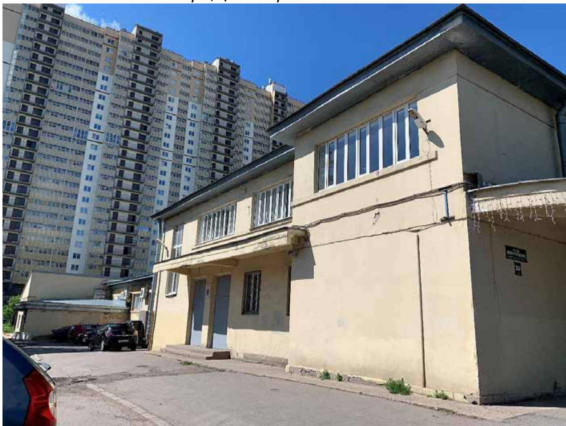
Фото №14.8. Общий вид докового фасада. Наблюдается деструкция красочного слоя, общая загрязненность фасада, сеть волосяных трещин, поздние ремонтные вмешательства.
