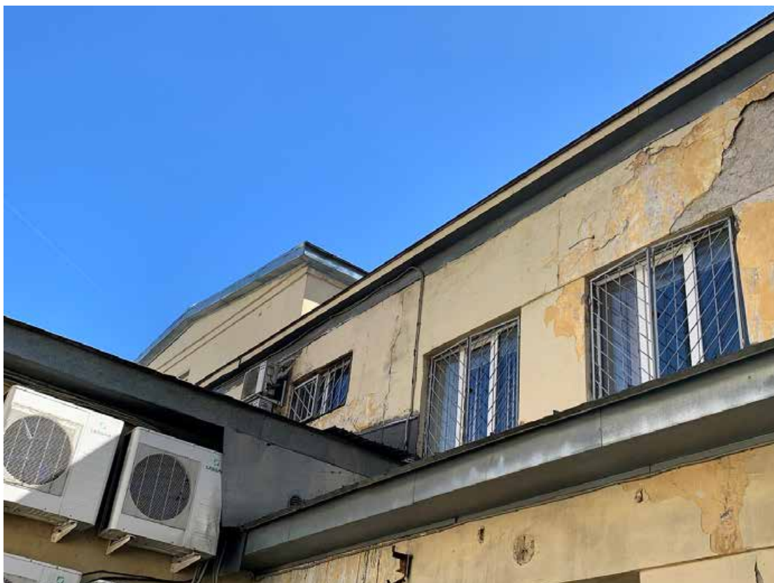
Фото №109. Фрагмент фасада. Наблюдаются деградация красочного и штукатурного слоя, трещины, общая загрязненность.
