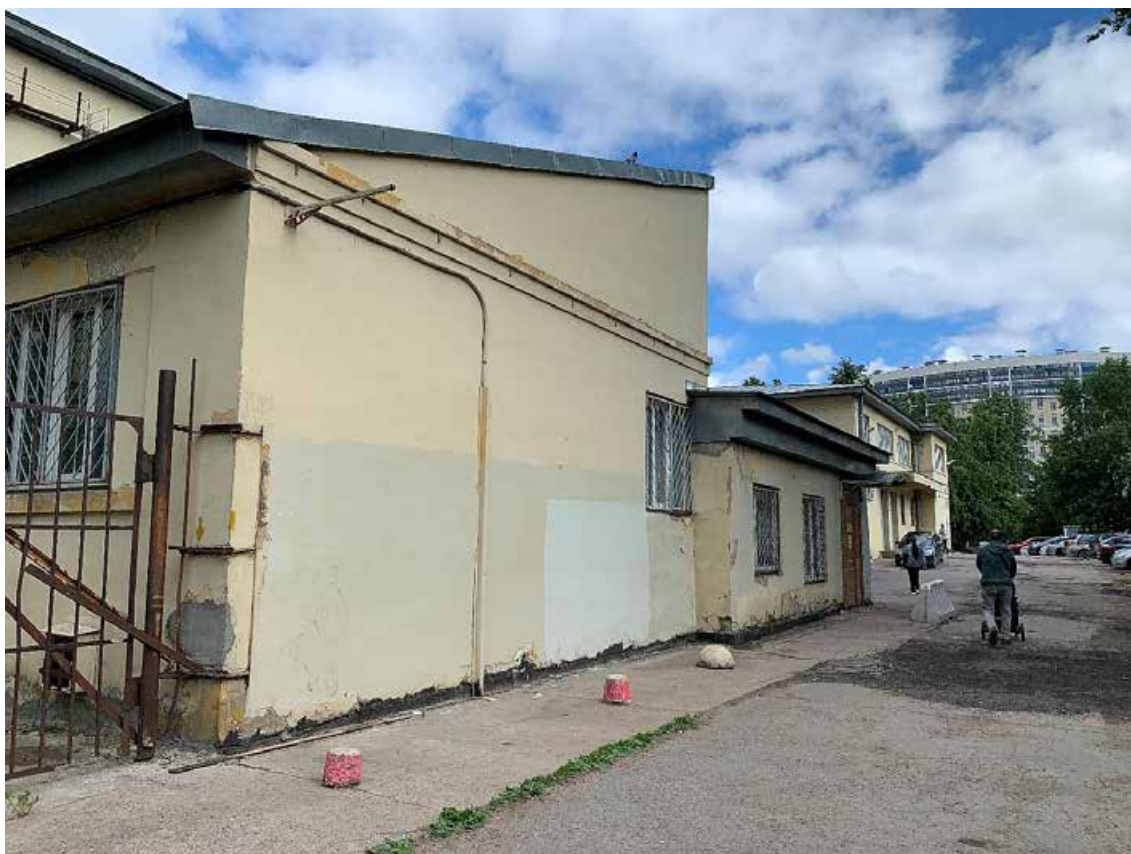
Фото №14.7. Общий вид докового фасада. Наблюдается деструкция красочного слоя, общая загрязненность, сеть волосяных трещин, поздние ремонтные вмешательства.
