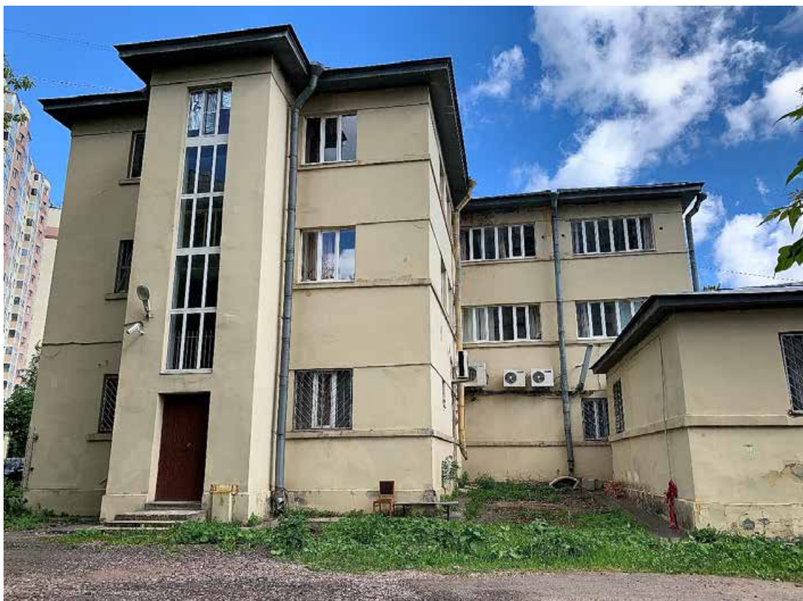
Фото №50. Общий вид дворового фасада. Наблюдается деградация красочного и штукатурного слоя, современные стеклопакеты, общая загрязненность фасада, многочисленные волосяные трещины по красочному слою.
