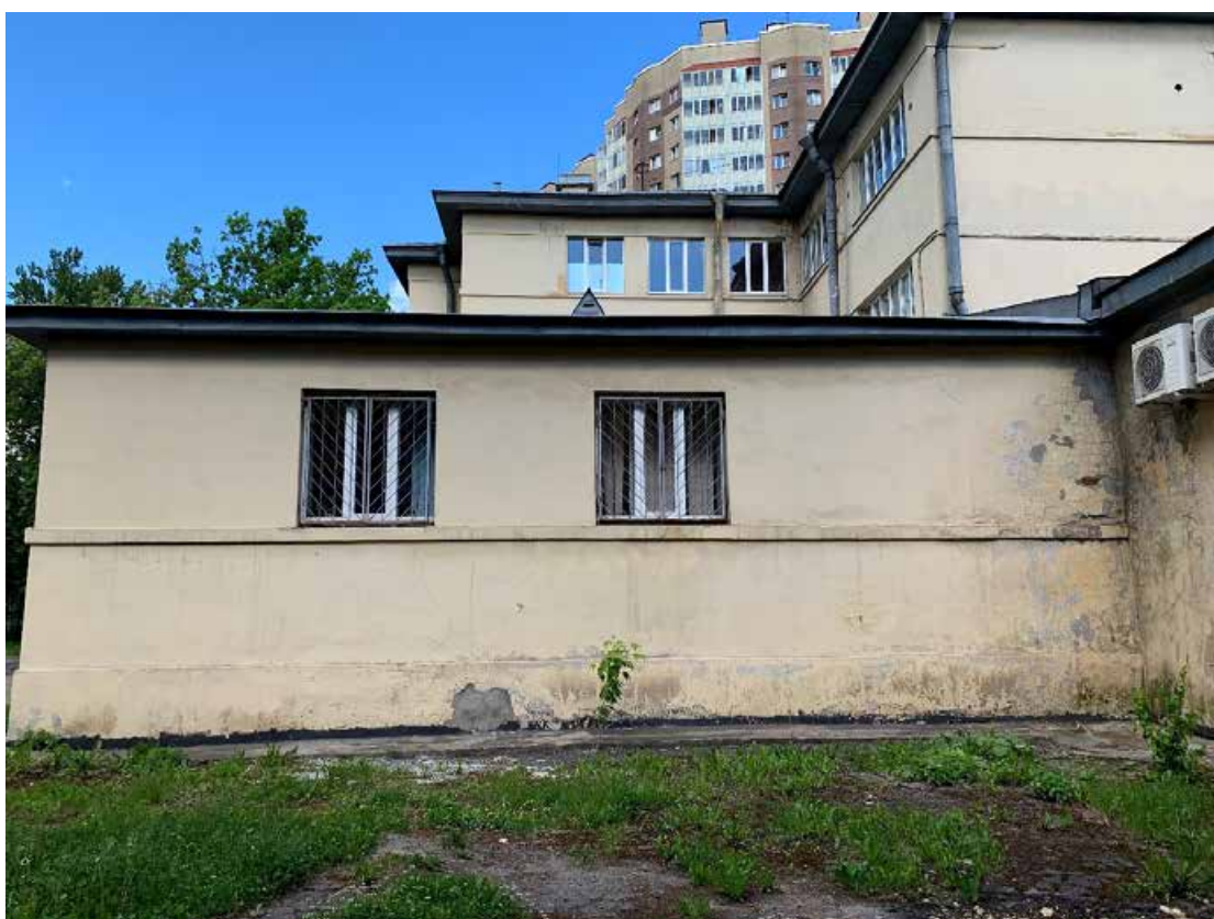
Фото №120. Фрагмент фасада. Наблюдаются деструкция красочного и штукатурного слоя, сеть волосяных трещин, биопоражения, общая загрязненность.
