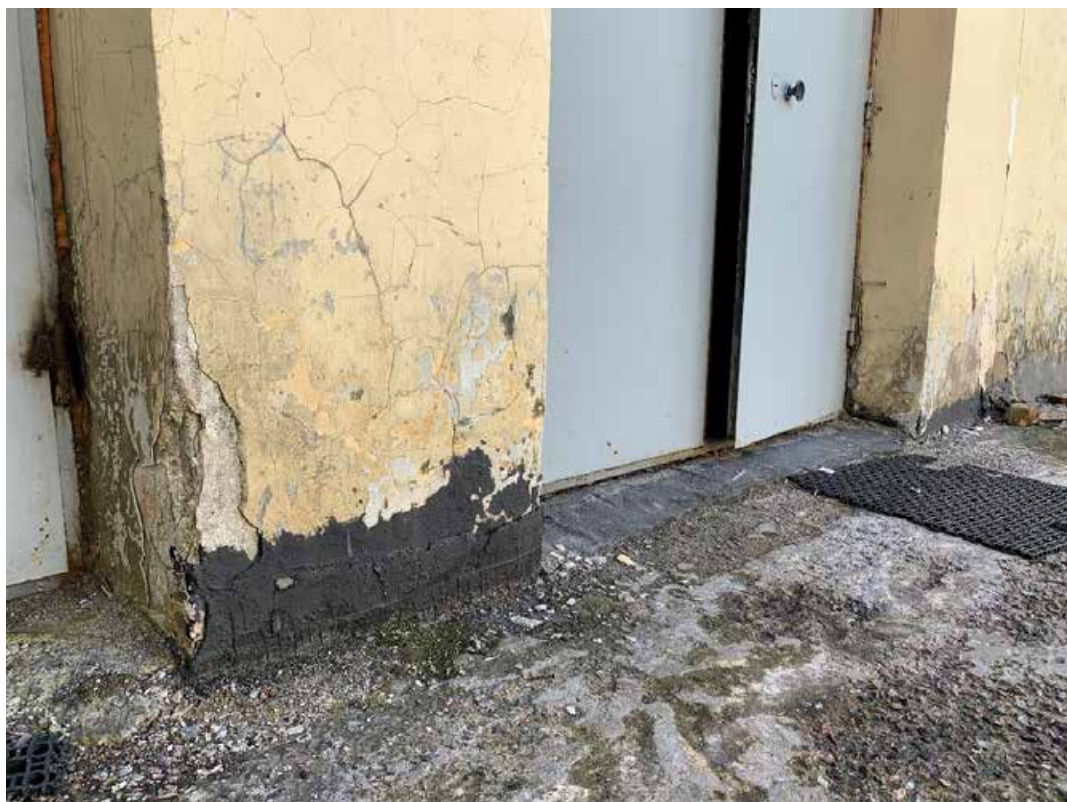
Фото №113. Фрагмент оборотного фасада. Наблюдаются деструкция красочного и штукатурного слоя, сеть волосяных трещин, биопоражения, общая загрязненность.
