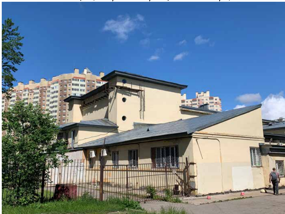
Фото №63. Общий вид оборотного фасада. Наблюдается деградация красочного и штукатурного слоя, общая загрязненность фасада, сеть волосяных трещин, следы некачественного ремонта.
