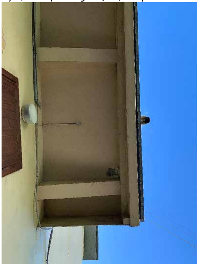
Фото №38. Фрагмент балкона докового фасада. Наблюдается деструкция красочного слоя, многочисленные волосяные трещины по красочному слою, общая загрязненность.
