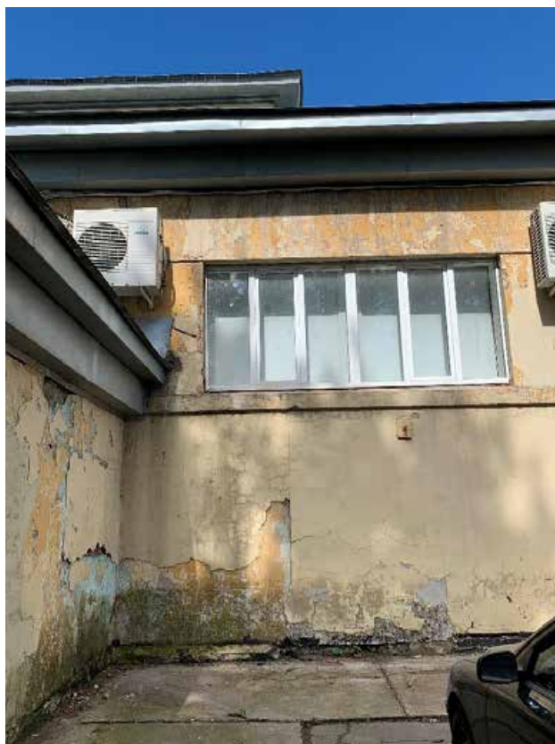
Фото №169. Фрагмент бокового фасада. Наблюдается деградация красочного и штукатурного слоя, биопоражение, сеть волосяных трещин, сколы, общая загрязненность.
