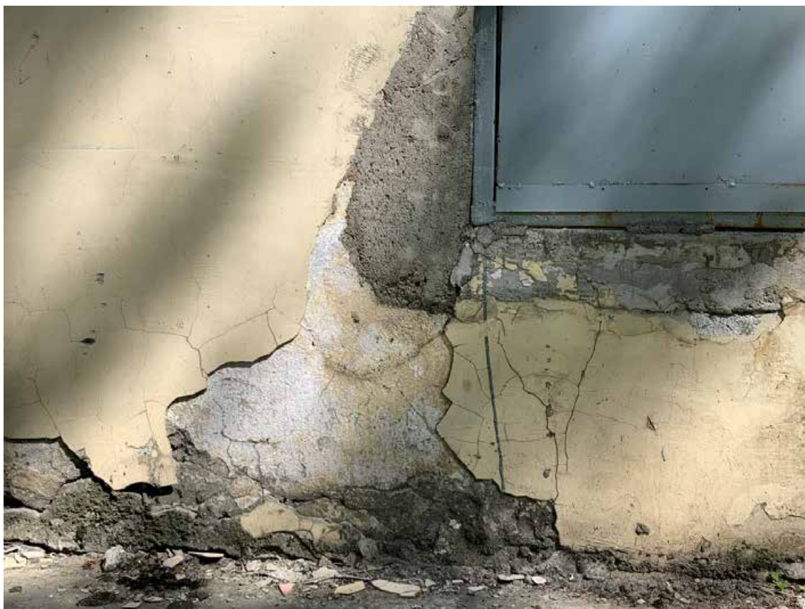
Фото №79. Фрагмент металлических ворот. Наблюдается отслоение красочного, деструкция штукатурного слоя, общая загрязненность.
