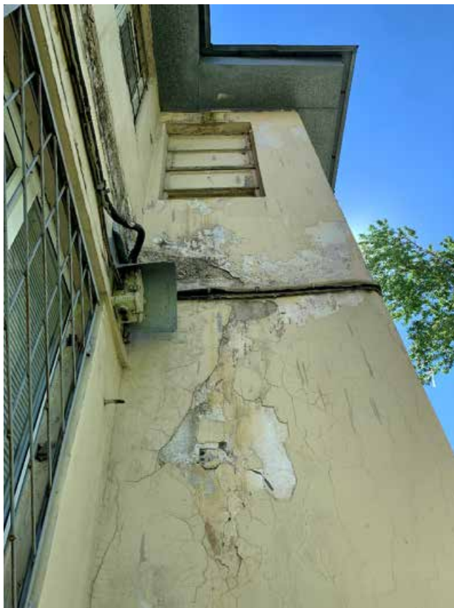
Фото №83. Фрагмент дворового фасада. Наблюдается деградация красочного и штукатурного слоя, сеть волосяных трещин, общая загрязненность.
