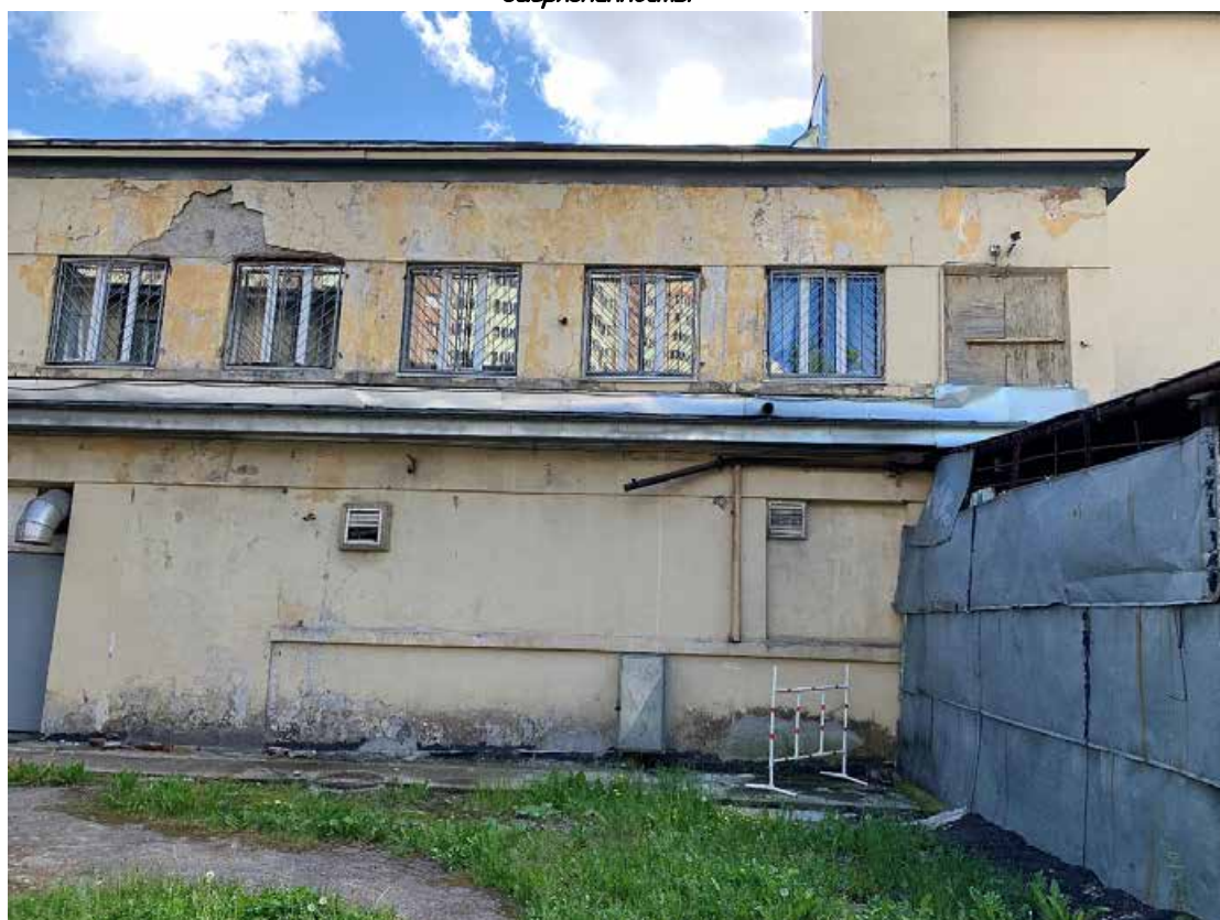
Фото №106. Фрагмент фасада. Наблюдаются деструкция красочного и штукатурного слоя, биопоражения, общая загрязненность.
