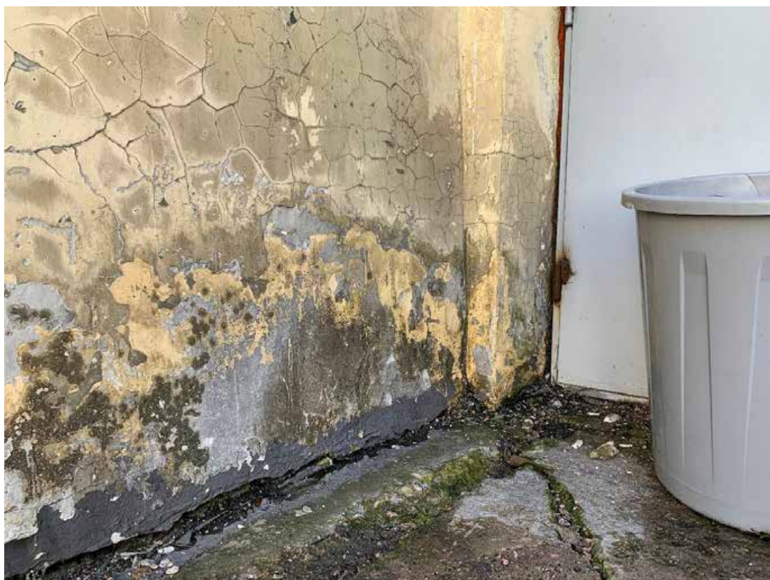
Фото №114. Фрагмент фасада. Наблюдаются деструкция красочного и штукатурного слоя, сеть волосяных трещин, потеки, биопоражения, общая загрязненность.
