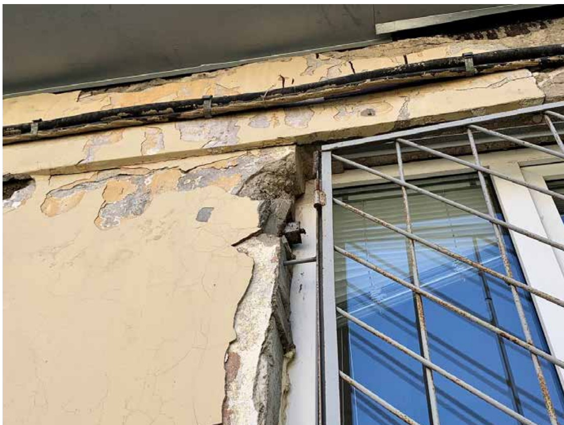
Фото №97. Фрагмент оконного проема. Наблюдаются деструкция красочного и штукатурного слоя, сколы, общая загрязненность.
