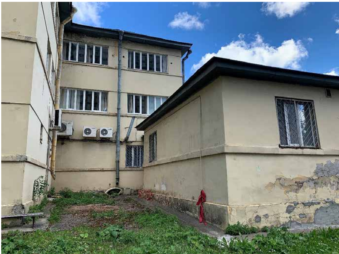
Фото №52. Общий вид дворового фасада. Наблюдается деградация красочного и штукатурного слоя, современные стеклопакеты, общая загрязненность фасада, многочисленные волосяные трещины по красочному слою.
