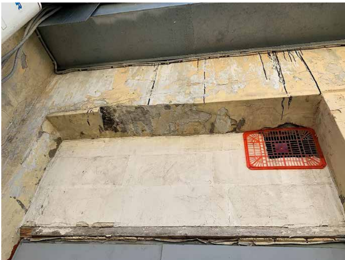
Фото №111. Фрагмент фасада. Наблюдаются деструкция красочного и штукатурного слоя, сколы, общая загрязненность.
