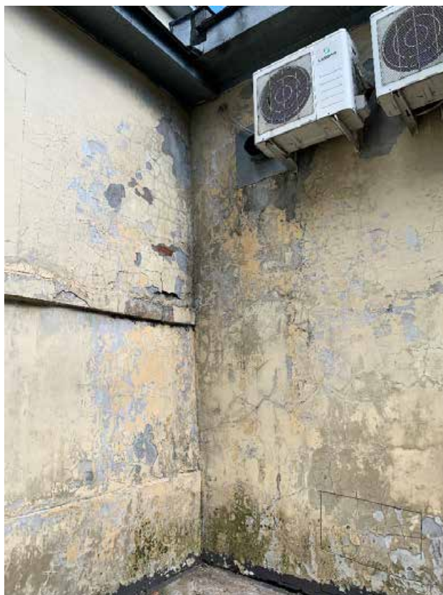
Фото №119. Фрагмент фасада. Наблюдаются деструкция красочного и штукатурного слоя, сеть волосяных трещин, биопоражения, общая загрязненность.
