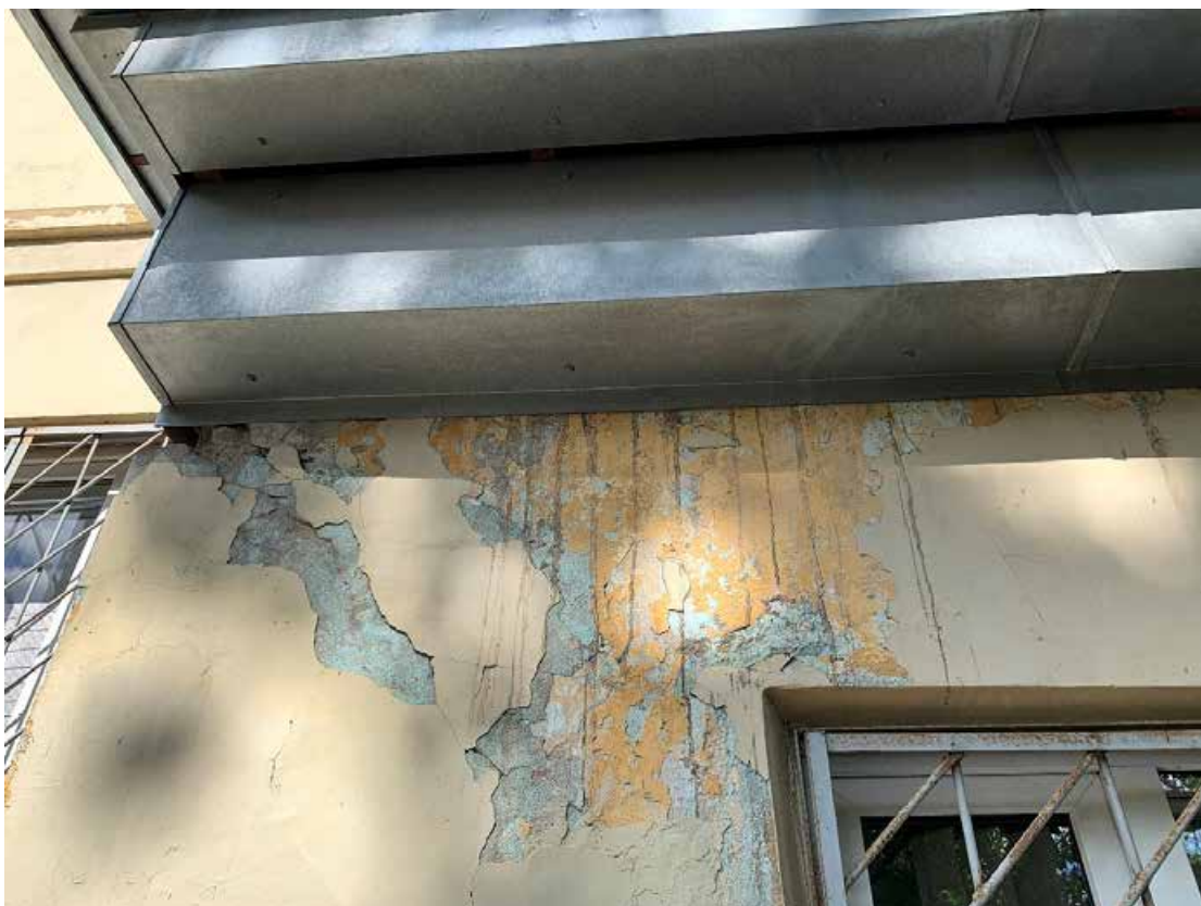
Фото №179. Фрагмент бокового фасада. Наблюдается деградация красочного и штукатурного слоя, волосяных трещин, общая загрязненность.
