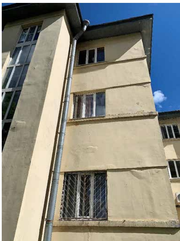
Фото №144. Фрагмент фасада. Наблюдаются деградация красочного и штукатурного слоя, общая загрязненность.
