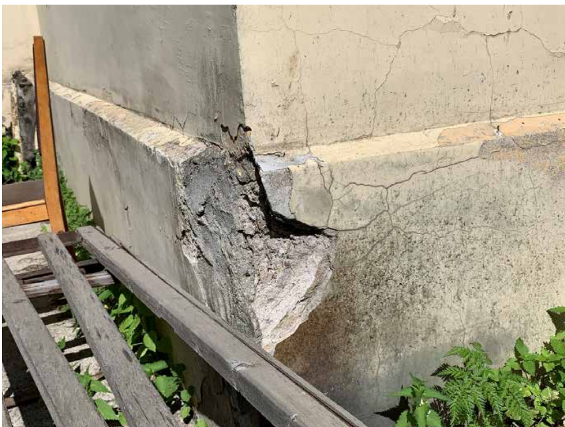
Фото №140. Фрагмент цоколя. Наблюдаются деструкция красочного и штукатурного слоя, сколы, волосяные трещины, общая загрязненность.
