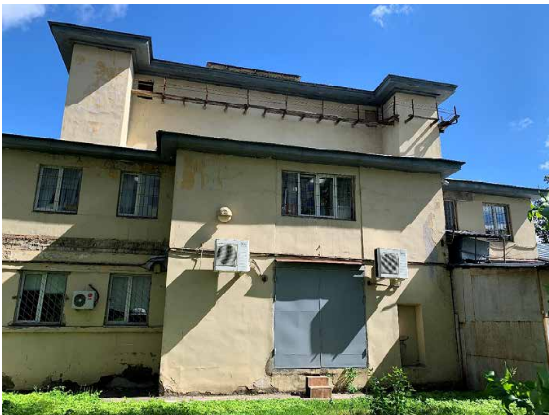
Фото №60. Общий вид оборотного фасада. Наблюдается деструкция красочного и штукатурного слоя, современные стеклопакеты, общая загрязненность фасада, сеть волосяных трещин.
