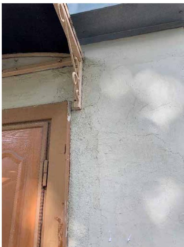
Фото №174. Фрагмент бокового фасада. Наблюдается сеть волосяных трещин, поздние ремонтные вмешательства, общая загрязненность.
