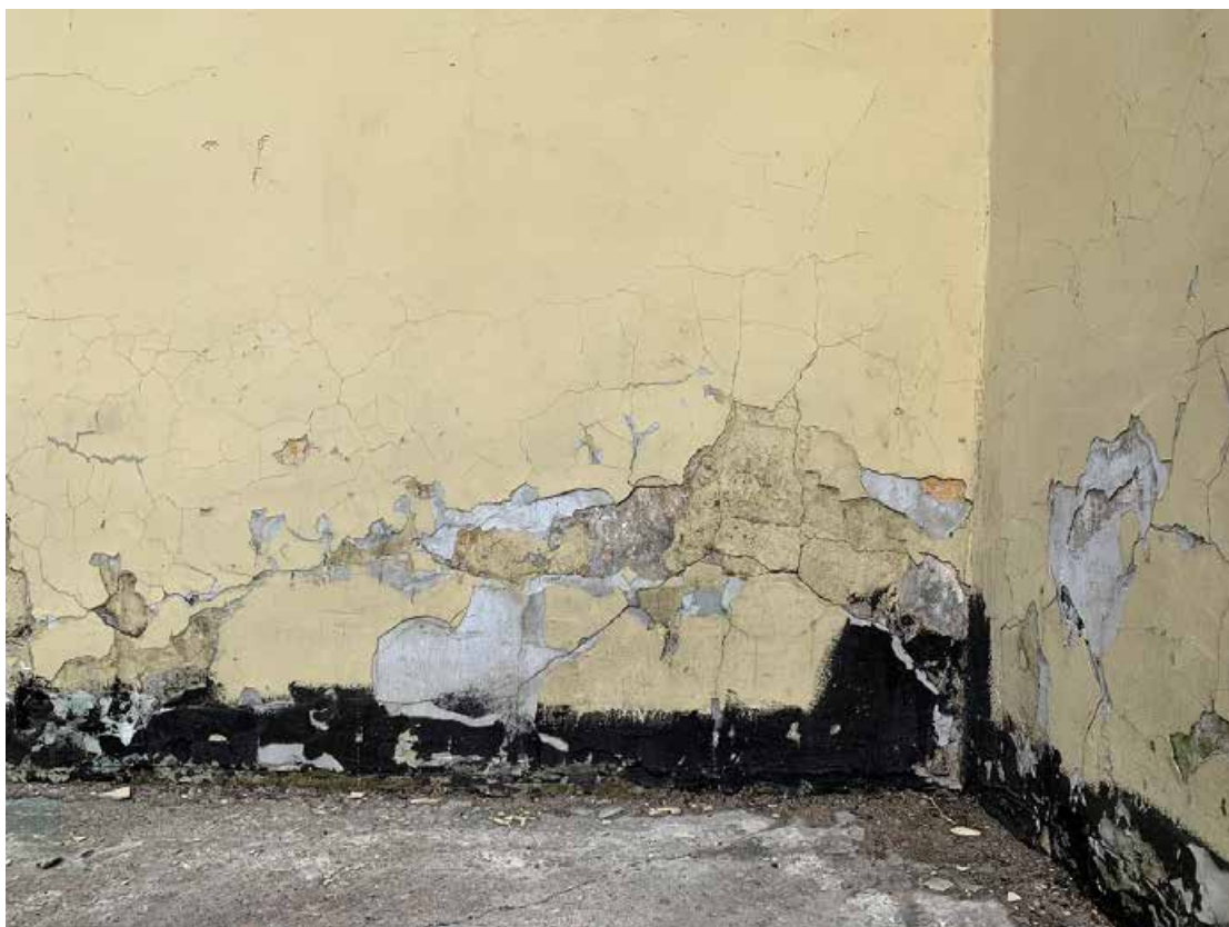
Фото №165. Фрагмент докового фасада. Наблюдается деградация красочного и штукатурного слоя, сеть волосяных трещин, общая загрязненность.
