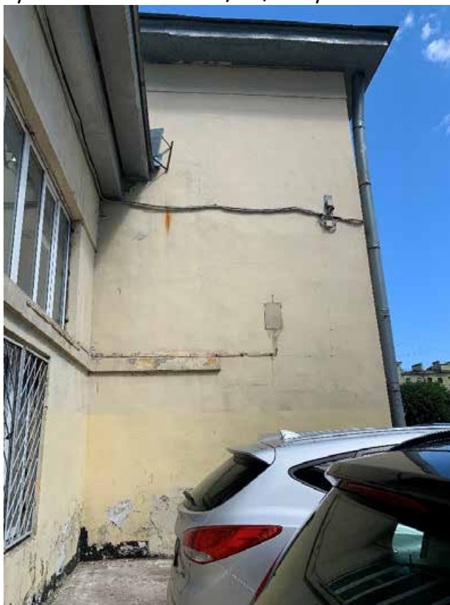
Фото №164. Фрагмент бокового фасада. Наблюдается деградация красочного и штукатурного слоя, сеть волосяных трещин, поздние ремонтные вмешательства, общая загрязненность.
