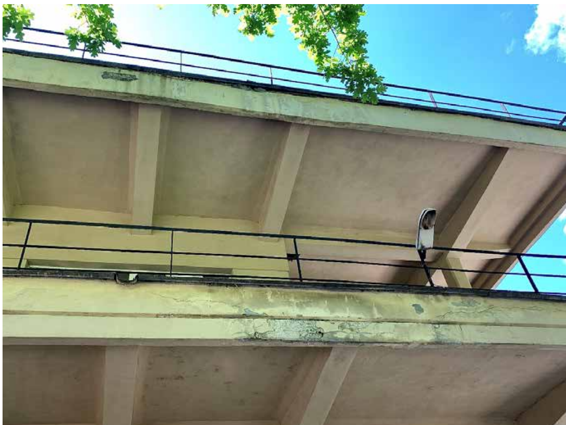
Фото №15. Фрагмент балкона. Наблюдается деструкция красочного и штукатурного слоя, потеки и общая загрязненность.
