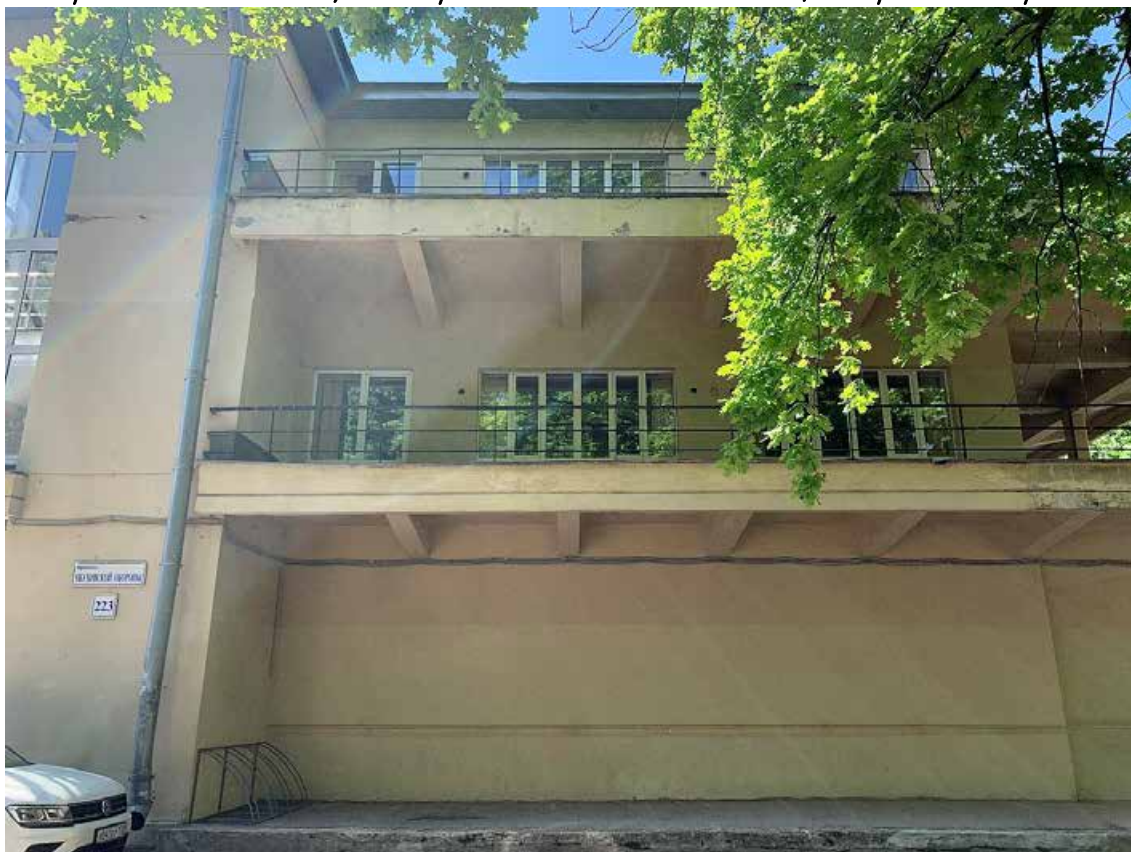
Фото №12. Фрагмент главного фасада с балконом. Наблюдается деградация красочного и штукатурного слоя, современные стеклопакеты, поздние ремонтные вмешательства и общая загрязненность фасада.
