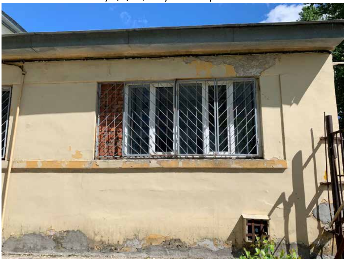
Фото №67. Фрагмент дворового фасада. Наблюдается деструкция красочного и штукатурного слоя, сеть волосяных трещин, общая загрязненность фасада.
