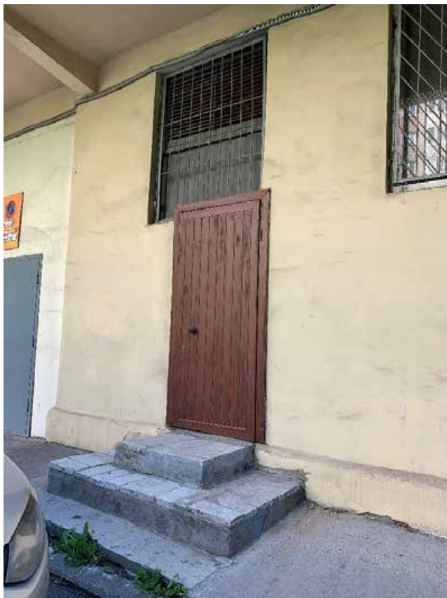
Фото №4.7. Фрагмент входной деревянной двери докового фасада. Наблюдается деструкция красочного слоя, общая загрязненность.
