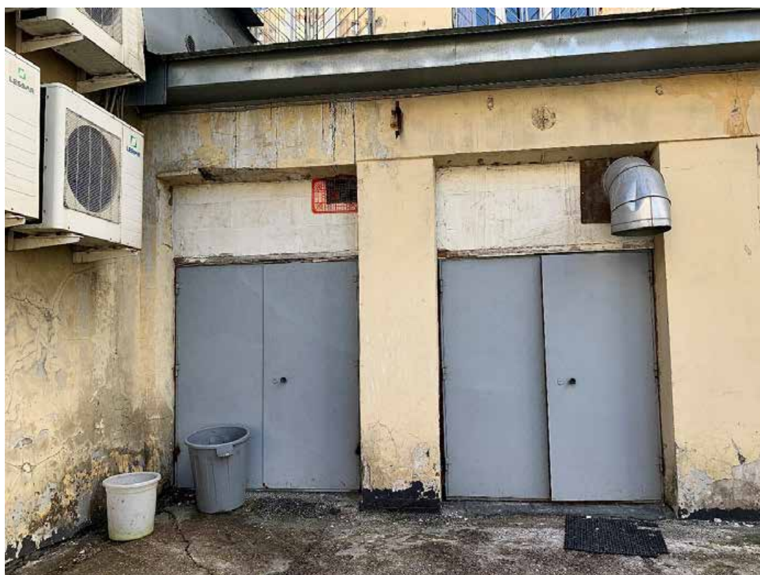
Фото №110. Фрагмент входных металлических дверей дворового фасада. Наблюдаются деградация красочного и штукатурного слоя, биопоражения, сколы, общая загрязненность.
