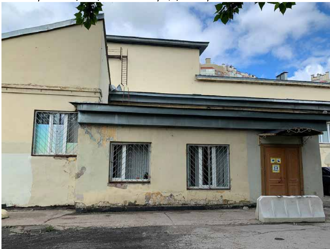
Фото №150. Фрагмент докового фасада. Наблюдается деградация красочного и штукатурного слоя, общая загрязненность, сколы, сеть волосяных трещин, поздние ремонтные вмешательства.
