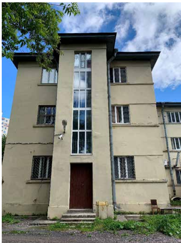
Фото №141. Фрагмент дворового фасада. Наблюдаются деградация красочного и штукатурного слоя, сеть волосяных трещин, общая загрязненность.
