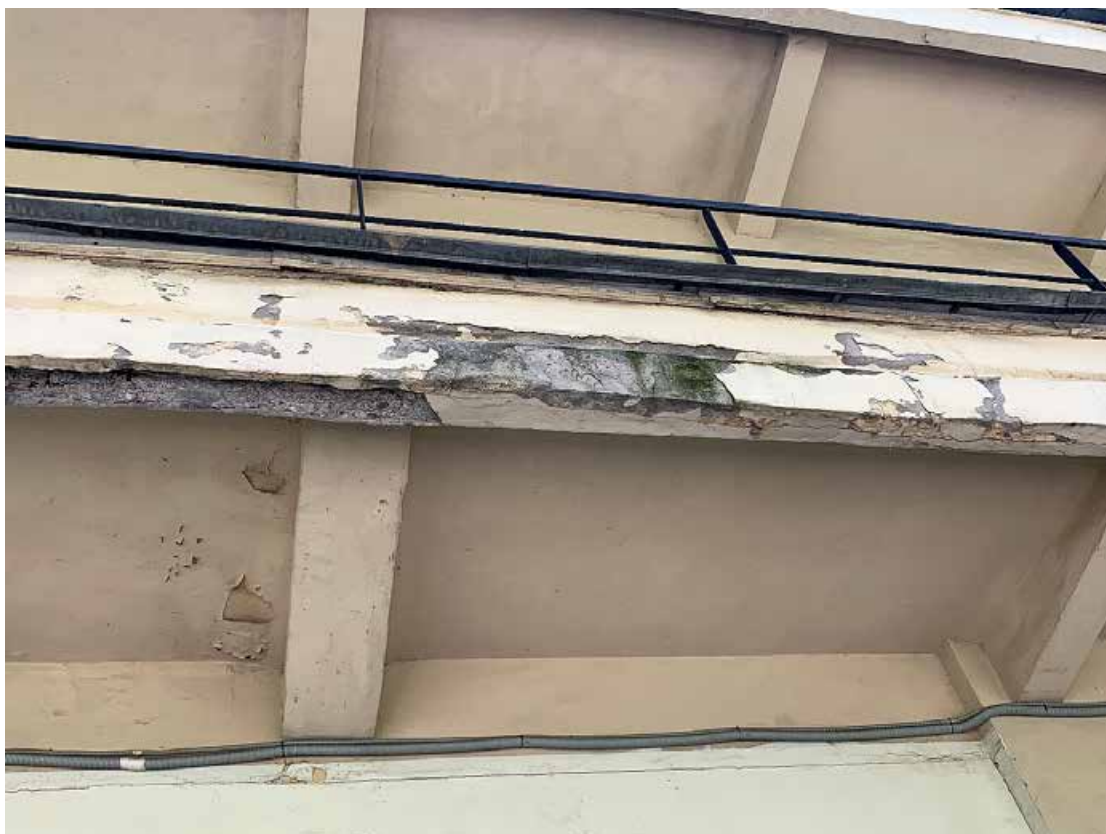
Фото №39. Фрагмент балкона бокового фасада. Наблюдается деградация красочного и штукатурного слоя, биопоражения, общая загрязненность.
