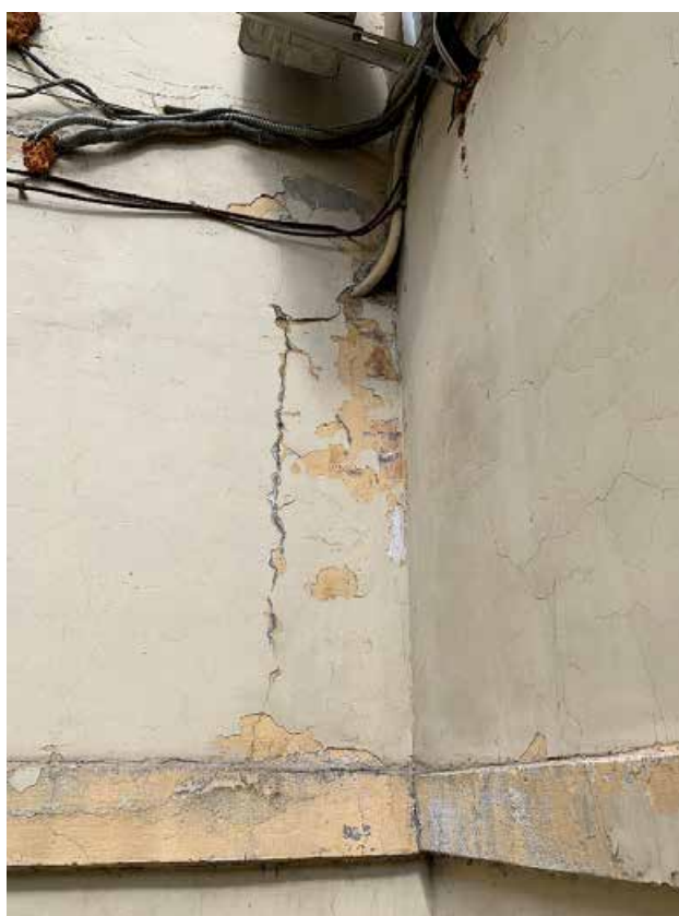
Фото №136. Фрагмент фасада. Наблюдаются деструкция красочного и штукатурного слоя, волосяные трещины, общая загрязненность.
