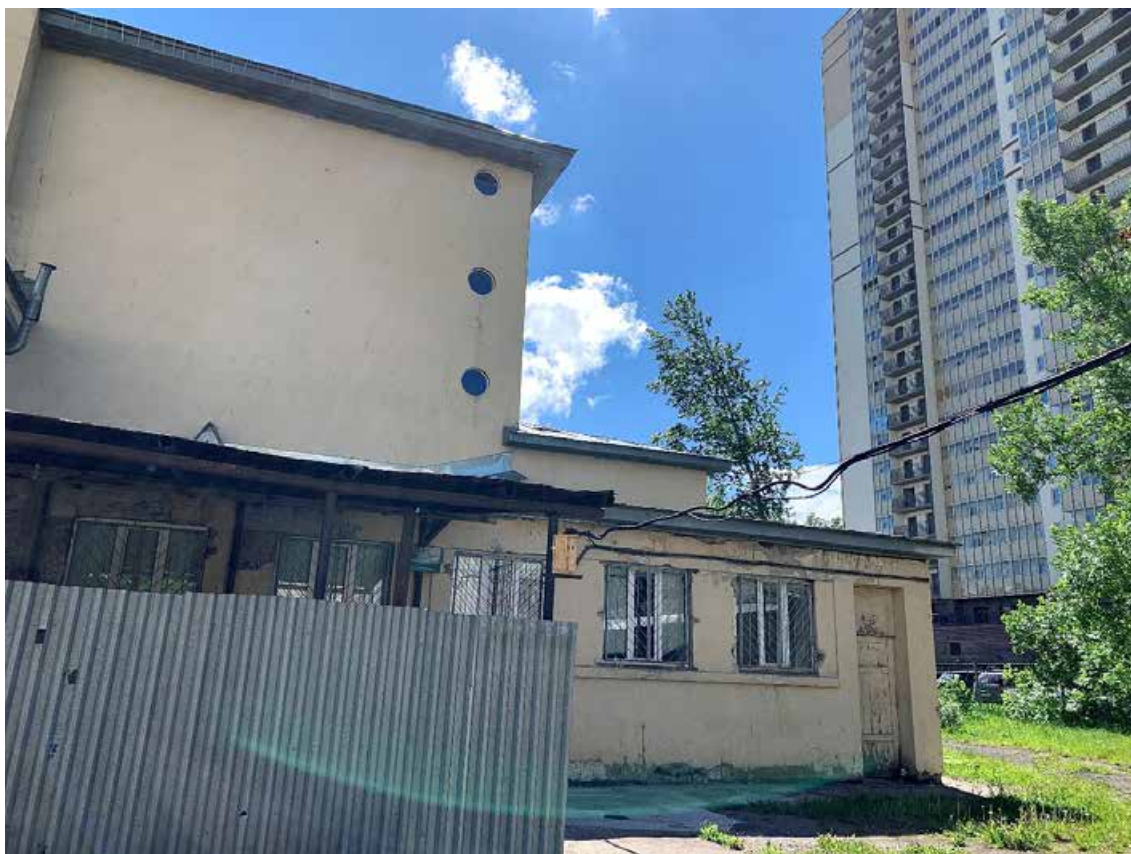
Фото №56. Общий вид дворового фасада. Наблюдается деградация красочного и штукатурного слоя, современные стеклопакеты, общая загрязненность фасада, многочисленные волосяные трещины по красочному слою.
