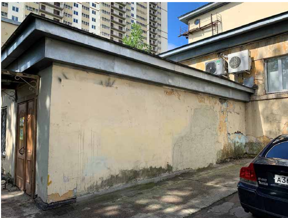
Фото №151 Фрагмент бокового фасада. Наблюдается деструкция красочного и штукатурного слоя, потеки, биопоражения, сколы, сеть волосяных трещин, общая загрязненность.
