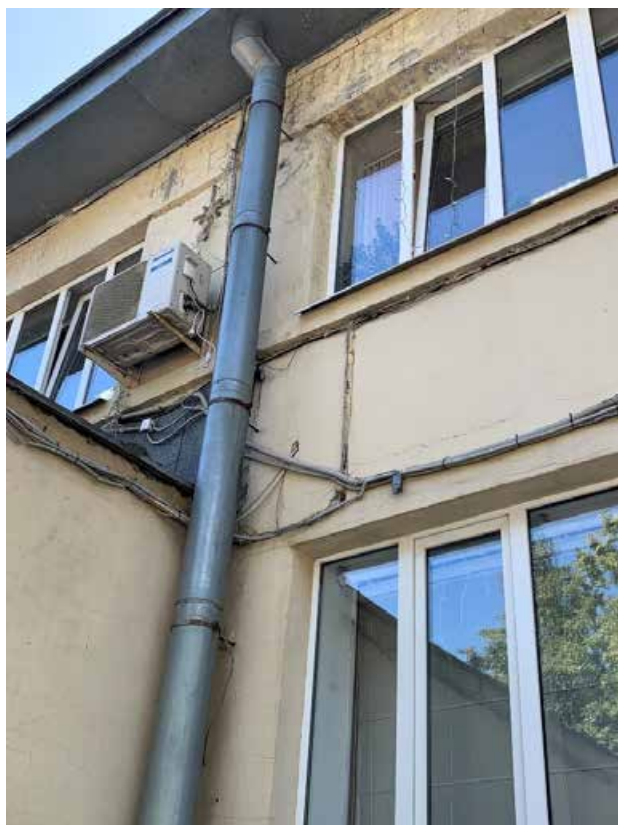
Фото №27. Фрагмент главного фасада. Наблюдается деградация красочного и штукатурного слоя, потеки, трещины, многочисленные волосяные трещины по красочному слою и общая загрязненность фасада.
