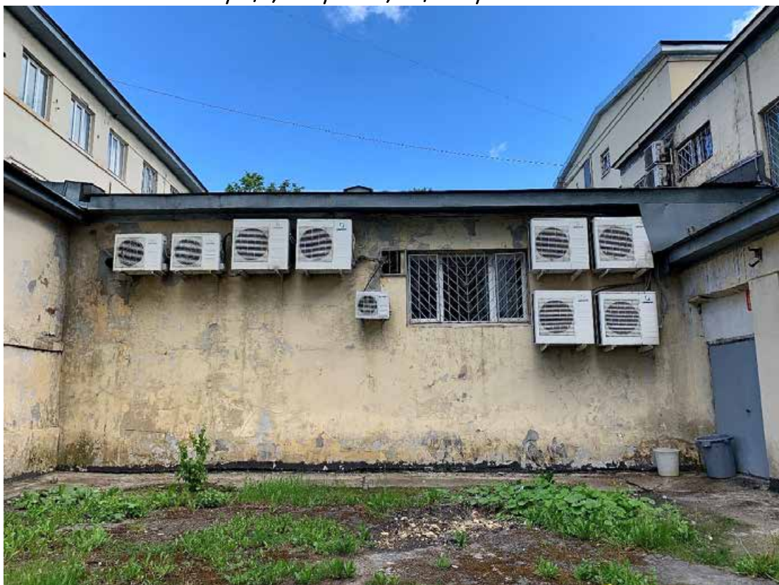
Фото №16. Фрагмент фасада. Фрагмент фасада. Наблюдаются деструкция красочного и штукатурного слоя, сеть волосяных трещин, потеки, биопоражения, общая загрязненность.
