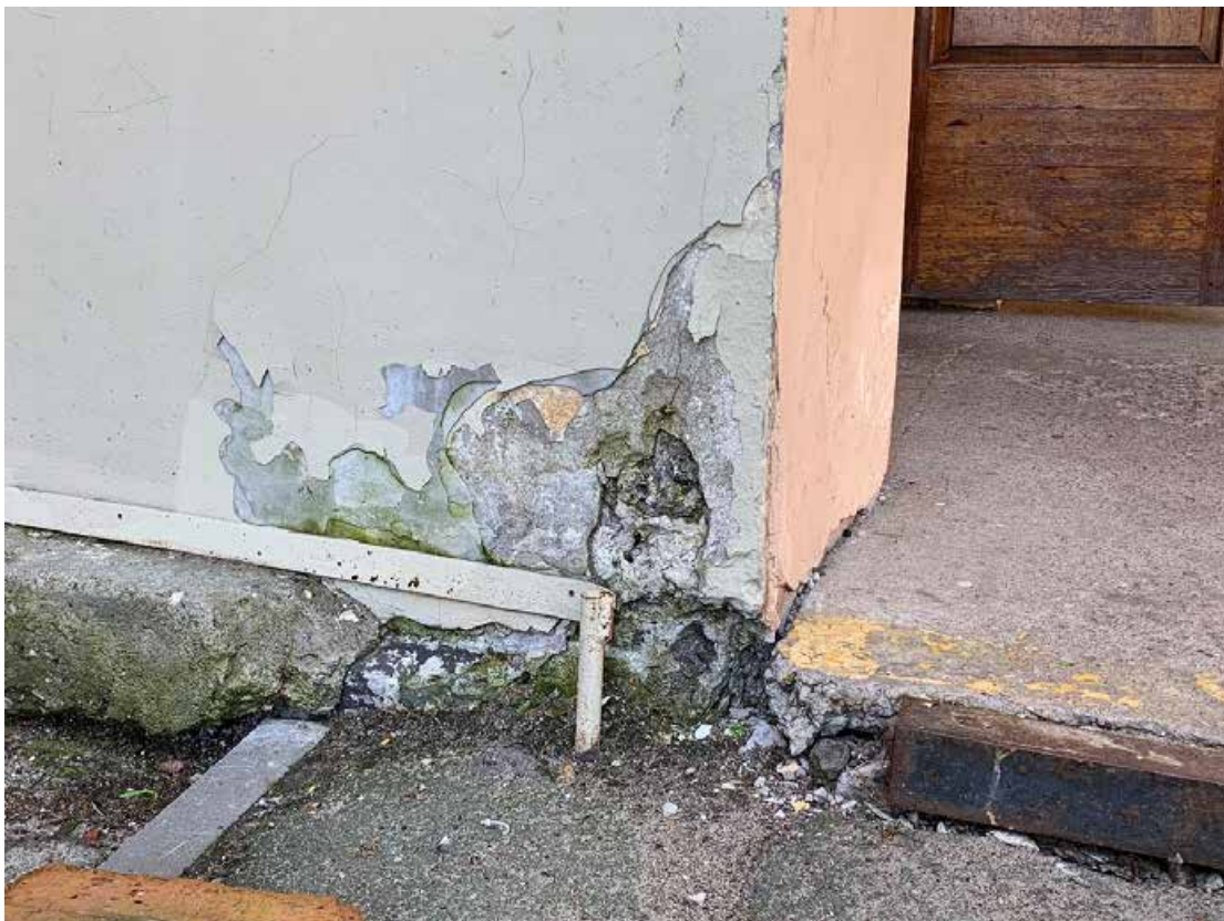
Фото №25. Фрагмент входной группы главного фасада с козырьком. Наблюдается деградация красочного и штукатурного слоя, биопоражения, сколы и многочисленные волосяные трещины по красочному слою.
