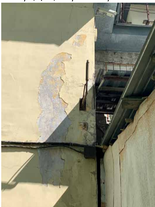
Фото №76. Фрагмент фасада. Наблюдается деструкция красочного и штукатурного слоя, сеть волосяных трещин, общая загрязненность фасада.
