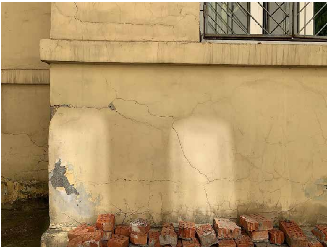
Фото №129. Фрагмент фасада. Наблюдаются деградация красочного и штукатурного слоя, сеть волосяных трещин, трещины, общая загрязненность.
