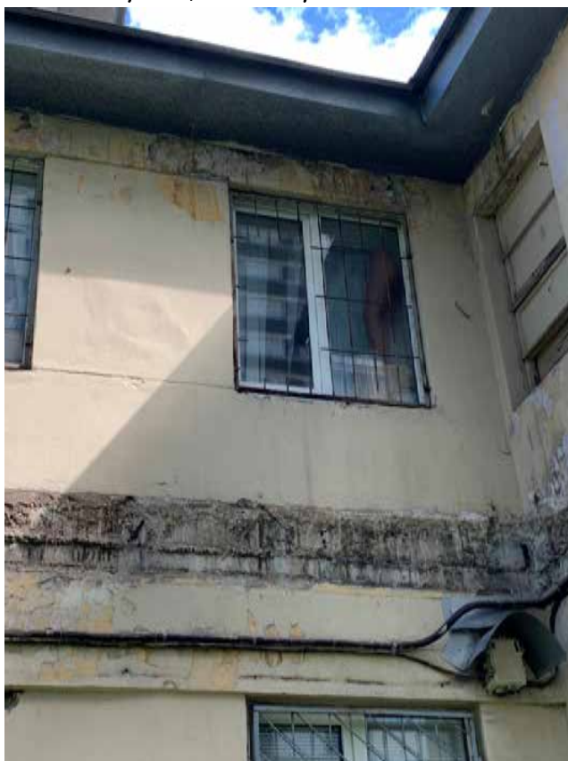
Фото №84. Фрагмент фасада. Наблюдается деградация красочного и штукатурного слоя, сеть волосяных трещин, общая загрязненность.
