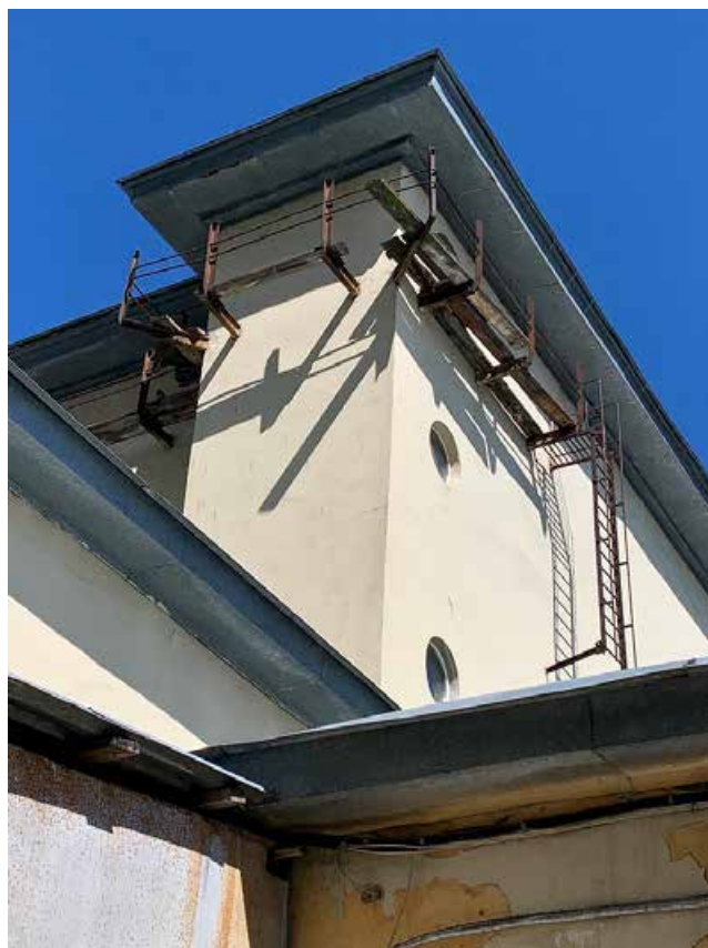
Фото №73. Фрагмент дворового фасада. Наблюдается деградация красочного и штукатурного слоя, сеть волосяных трещин, общая загрязненность фасада.
