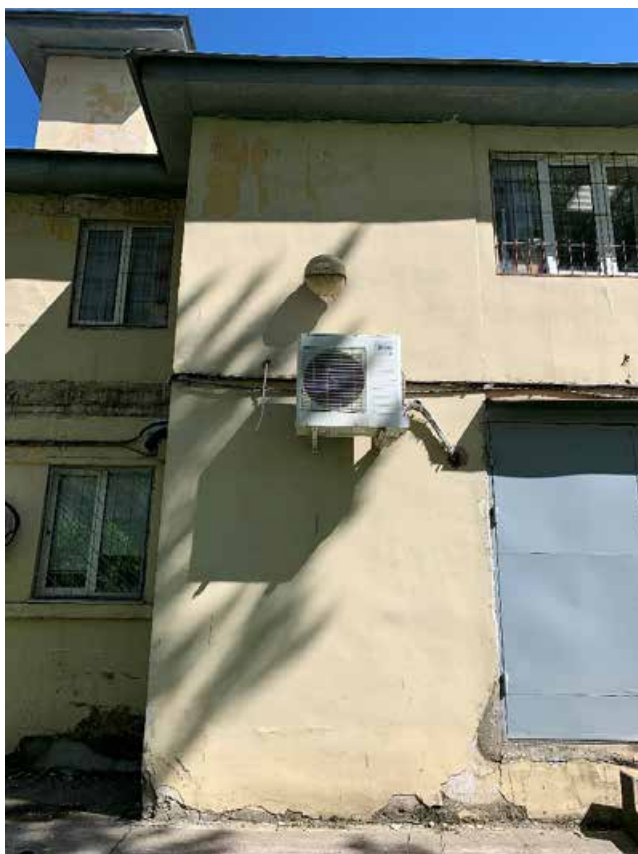
Фото №81. Фрагмент дворового фасада. Наблюдается деструкция красочного и штукатурного слоя, общая загрязненность фасада.
