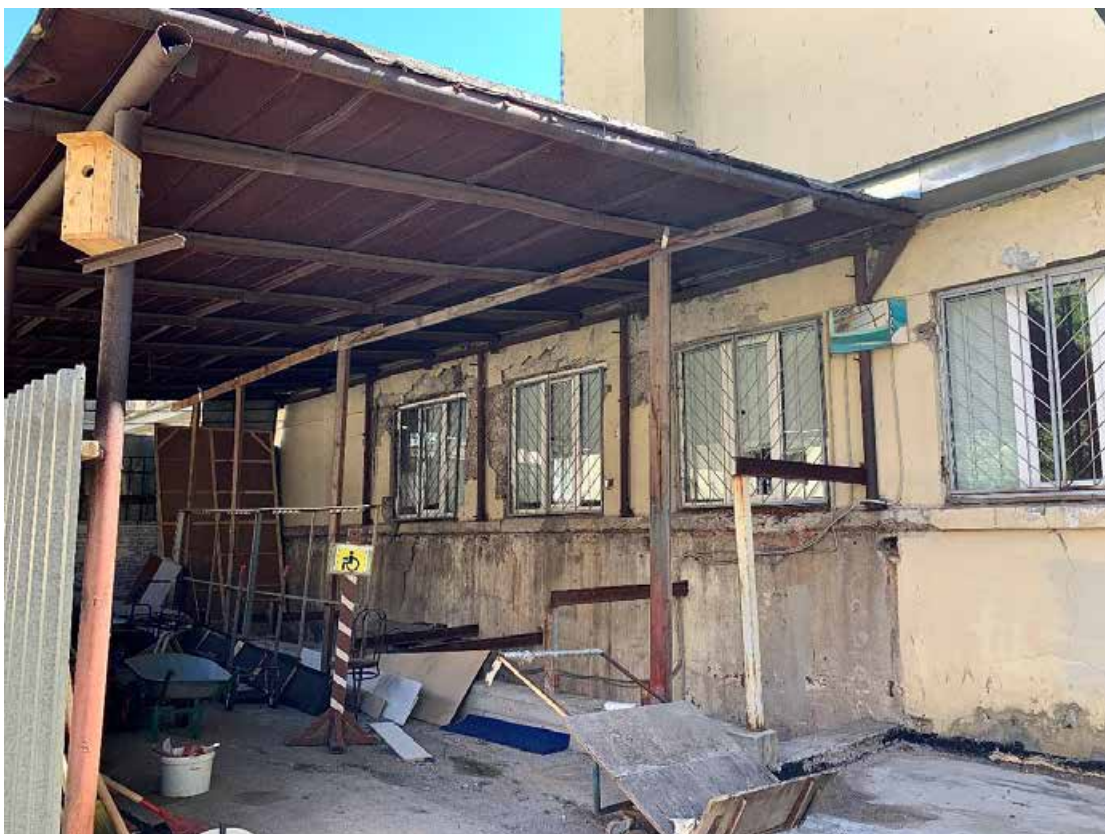
Фото №99. Фрагмент фасада. Наблюдается общая деструкция красочного и штукатурного слоя, волосяные трещины по красочному слою, общая загрязненность.
