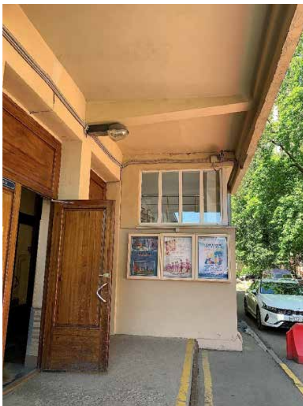
Фото №21. Фрагмент входной группы главного фасада с козырьком. Наблюдаются трещины, деструкция штукатурного слоя, многочисленные волосяные трещины по красочному слою, общая загрязненность.
