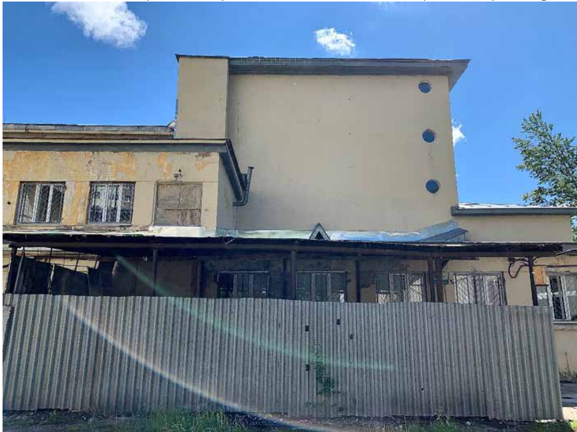
Фото №55. Общий вид дворового фасада. Наблюдается деградация красочного и штукатурного слоя, современные стеклопакеты, общая загрязненность фасада, многочисленные волосяные трещины по красочному слою.
