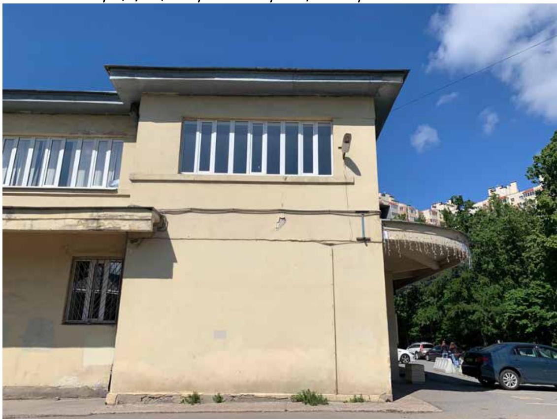
Фото №154. Фрагмент докового фасада. Наблюдается деградация красочного слоя, сеть волосяных трещин, общая загрязненность фасада, поздние ремонтные вмешательства.
