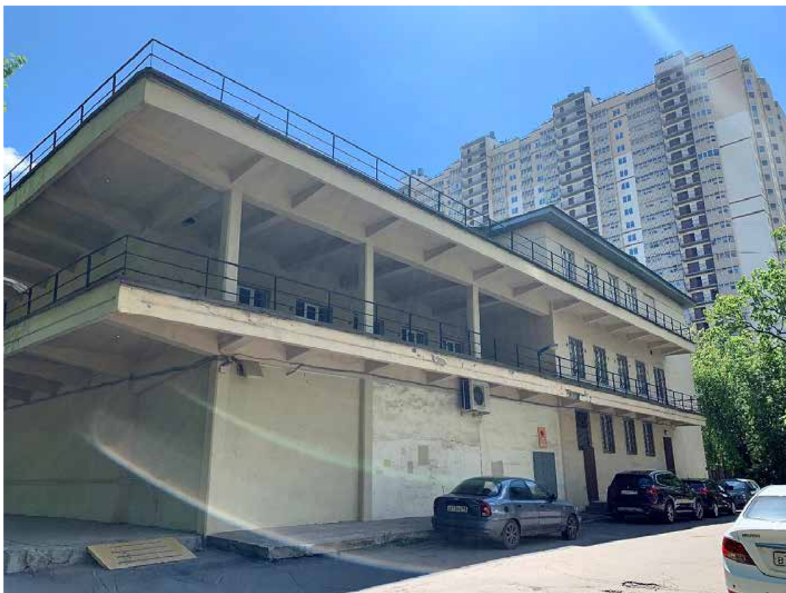
Фото №31. Общий вид докового фасада с балконом. Наблюдается деградация штукатурного слоя, современные стеклопакеты, общая загрязненность фасада, трещины и поздние ремонтные вмешательства.
