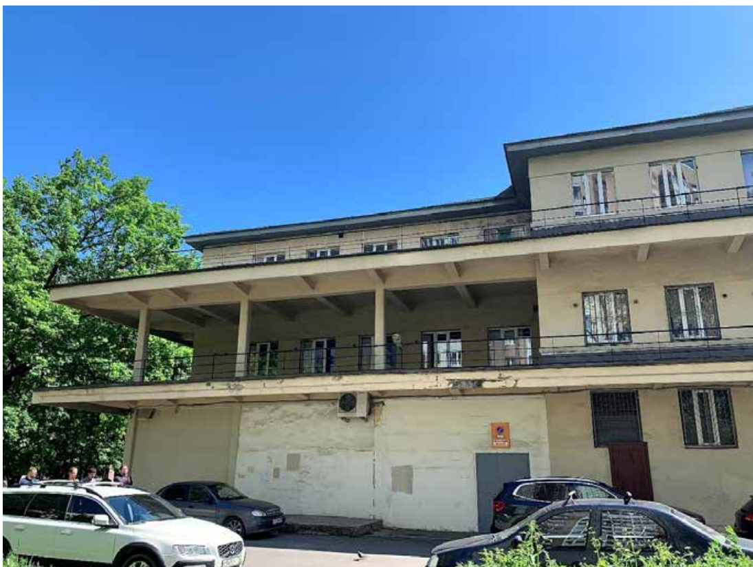
Фото №33. Фрагмент бокового фасада с балконом. Наблюдается деструкция штукатурного слоя, современные стеклопакеты, общая загрязненность фасада, трещины и следы некачественного ремонта.
