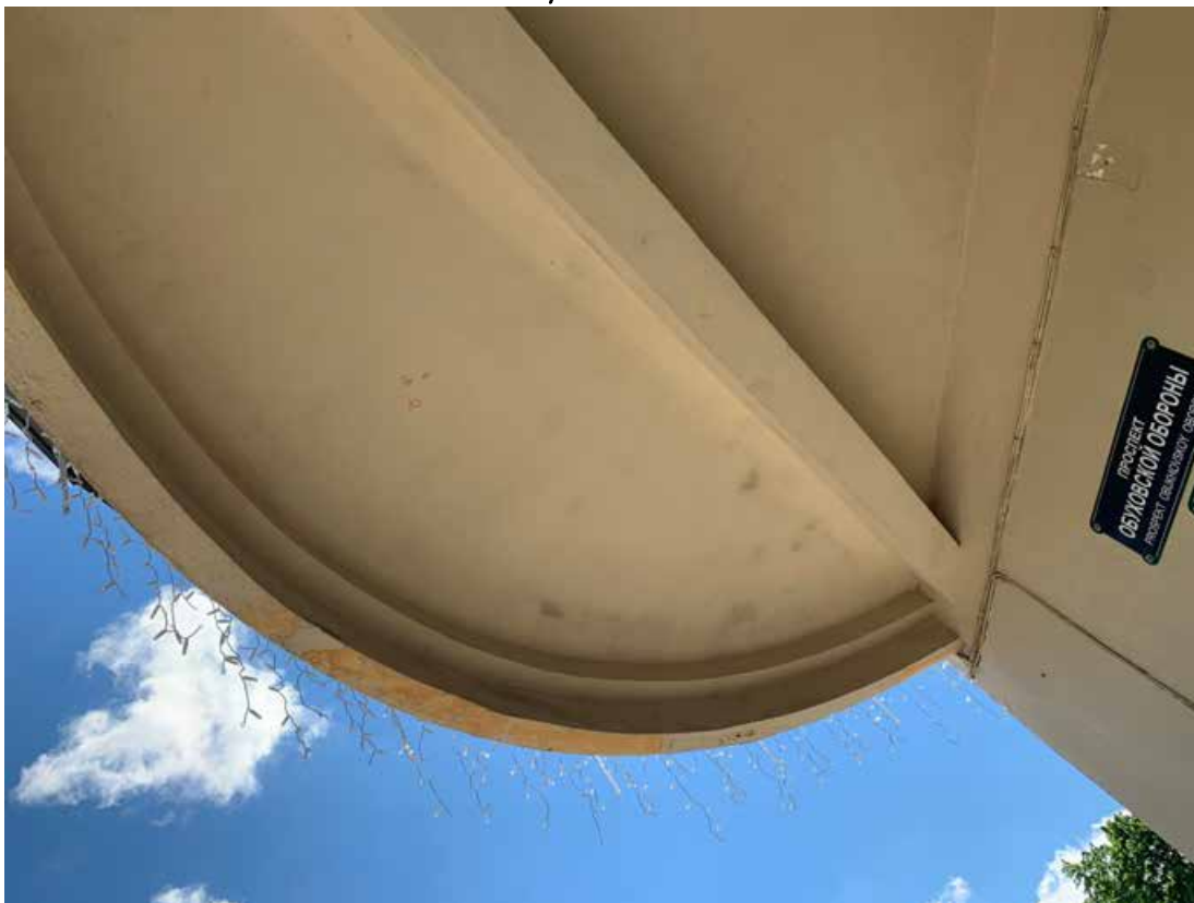
Фото №30. Фрагмент козырька центральной входной группы лицевого фасада с козырьком. Наблюдается деструкция красочного и штукатурного слоя, многочисленные волосяные трещины по красочному слою, общая загрязненность.
