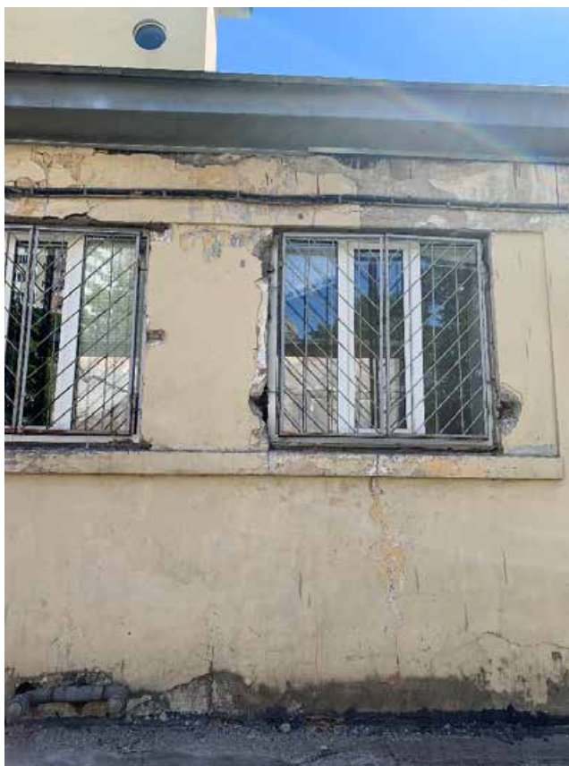
Фото №95. Фрагмент оконных проемов. Наблюдается общая деструкция красочного и штукатурного слоя, сеть волосяных трещин, общая загрязненность.
