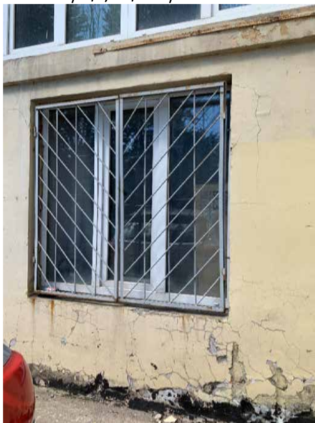
Фото №166. Фрагмент оконного проема. Наблюдается деградация красочного и штукатурного слоя, сеть волосяных трещин, сколы, общая загрязненность.
