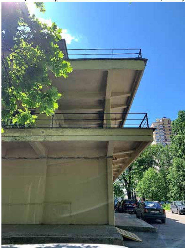
Фото №14. Фрагмент главного фасада с балконом. Наблюдается деградация красочного и штукатурного слоя, поздние ремонтные вмешательства и общая загрязненность фасада.
