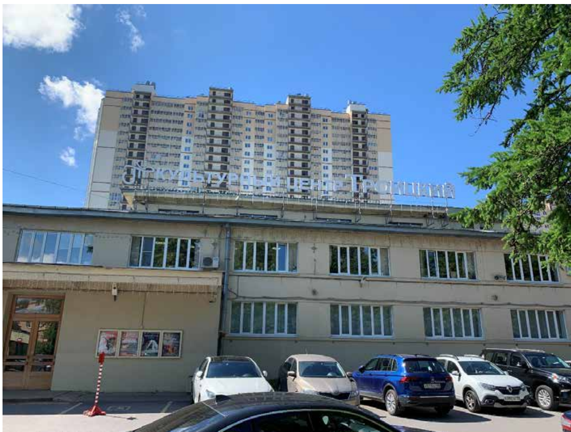
Фото №7. Фрагмент главного фасада. Наблюдается деструкция штукатурного слоя, современные стеклопакеты, общая загрязненность фасада, трещины.
