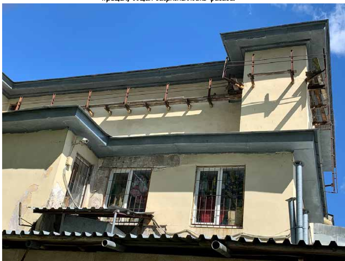
Фото №74. Фрагмент дворового фасада. Наблюдается деградация красочного и штукатурного слоя, сеть волосяных трещин, общая загрязненность фасада.
