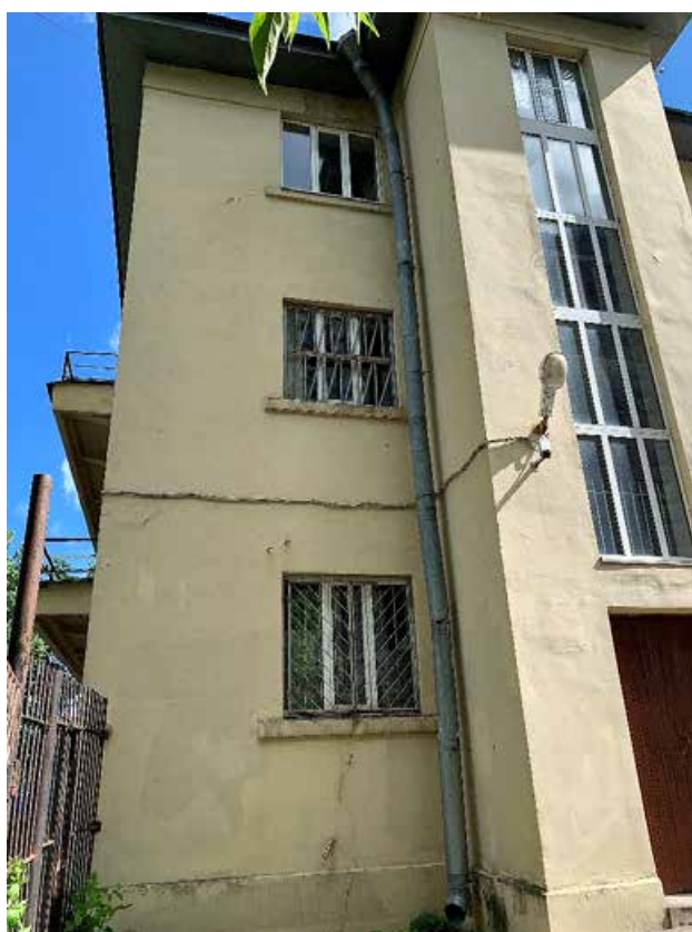
Фото №142. Фрагмент дворового фасада. Наблюдаются деградация красочного и штукатурного слоя, сеть волосяных трещин, общая загрязненность, трещины, позднее ремонтные вмешательства.
