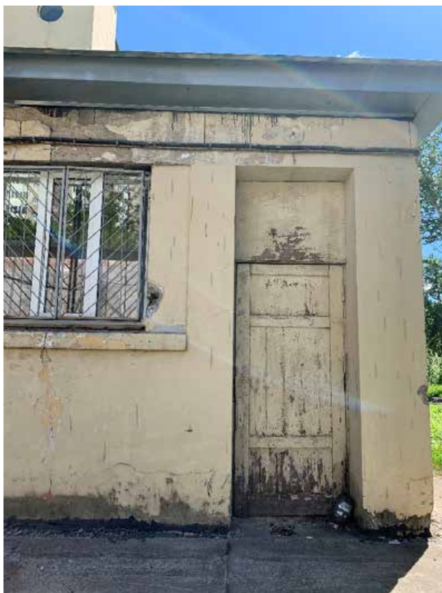
Фото №93. Фрагмент дворового фасада. Наблюдается общая деструкция красочного и штукатурного слоя, сеть волосяных трещин, общая загрязненность.
