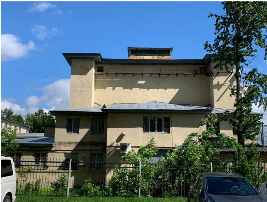
Фото №64. Общий вид оборотного фасада. Наблюдается деградация красочного и штукатурного слоя, современные стеклопакеты, общая загрязненность фасада, сеть волосяных трещин.
