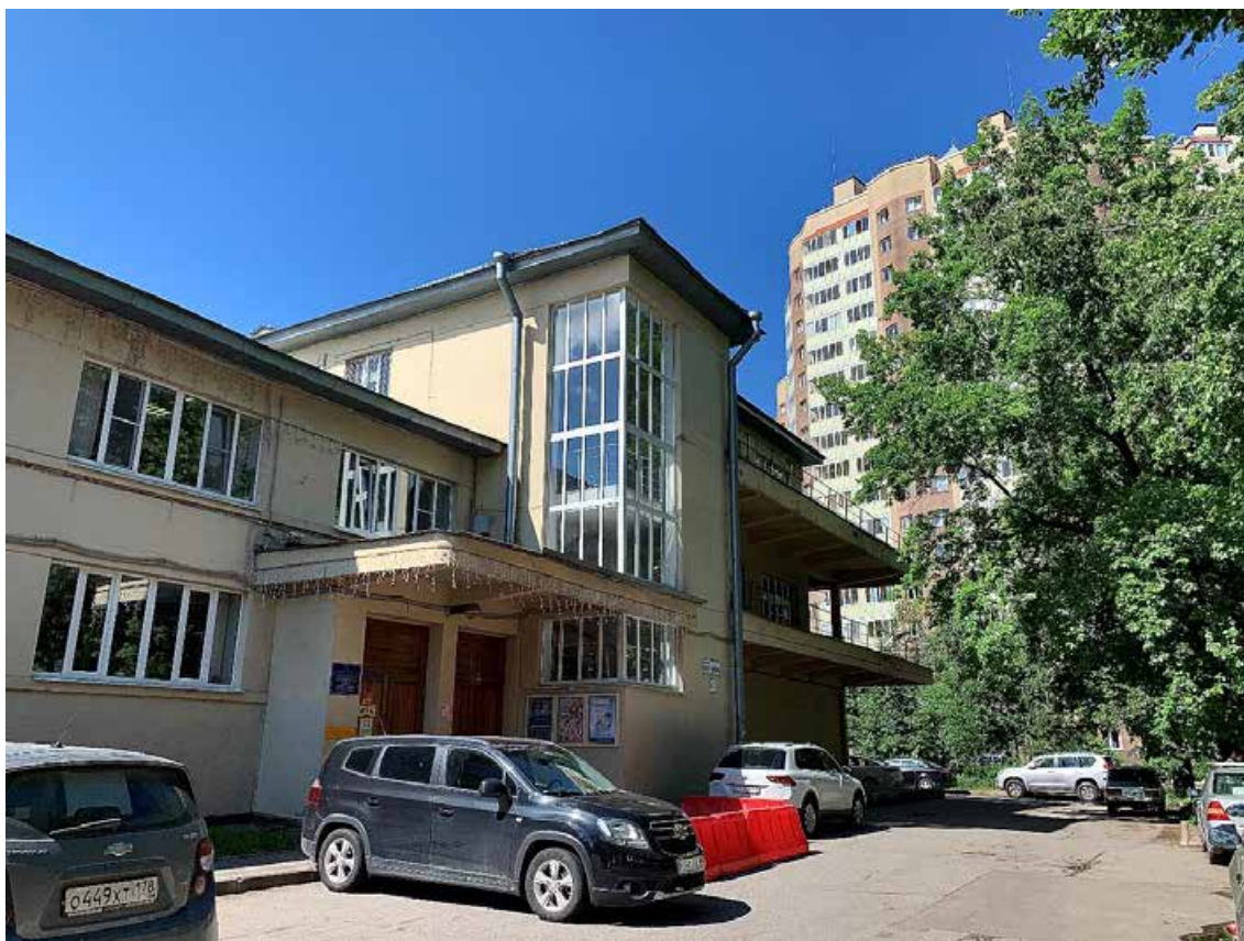
Фото №9. Фрагмент главного фасада. Наблюдается деструкция штукатурного слоя, современные стеклопакеты, общая загрязненность фасада, трещины.
