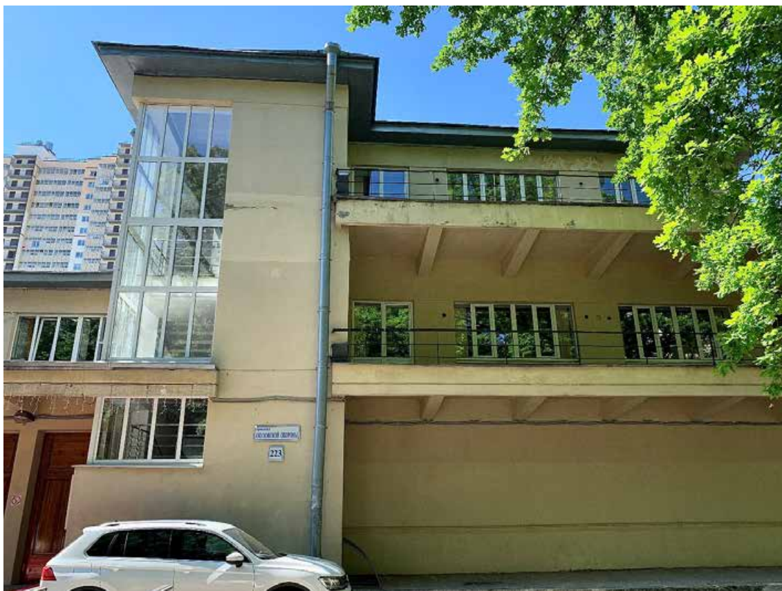
Фото №11. Фрагмент главного фасада с балконом. Наблюдается деградация красочного и штукатурного слоя, современные стеклопакеты, поздние ремонтные вмешательства и общая загрязненность фасада.
