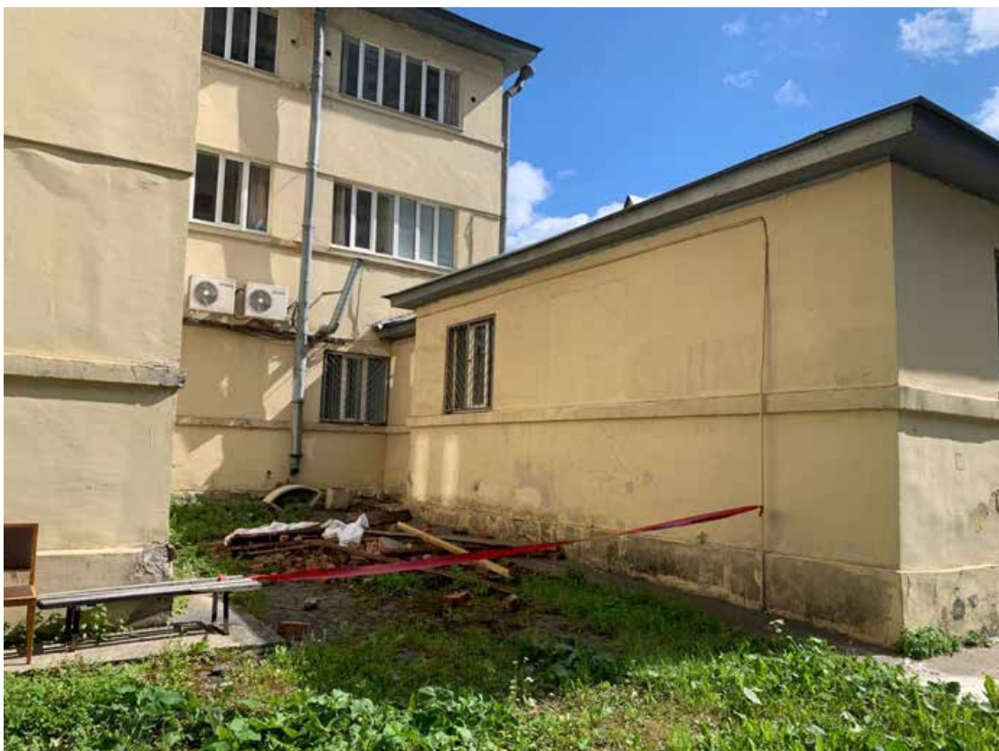
Фото №127. Фрагмент дворового фасада. Наблюдаются деструкция красочного слоя, сеть волосяных трещин, общая загрязненность.
