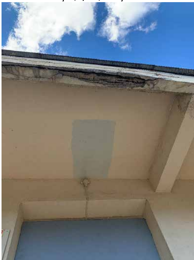
Фото №162. Фрагмент козырька докового фасада. Наблюдается деградация красочного и штукатурного слоя, сколы, сеть волосяных трещин, поздние ремонтные вмешательства, общая загрязненность.
