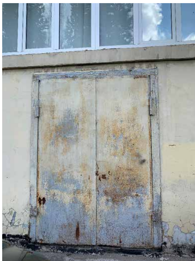
Фото №168. Фрагмент металлической двери. Наблюдается деградация красочного и штукатурного слоя, коррозия металла, сеть волосяных трещин, потеки, общая загрязненность.
