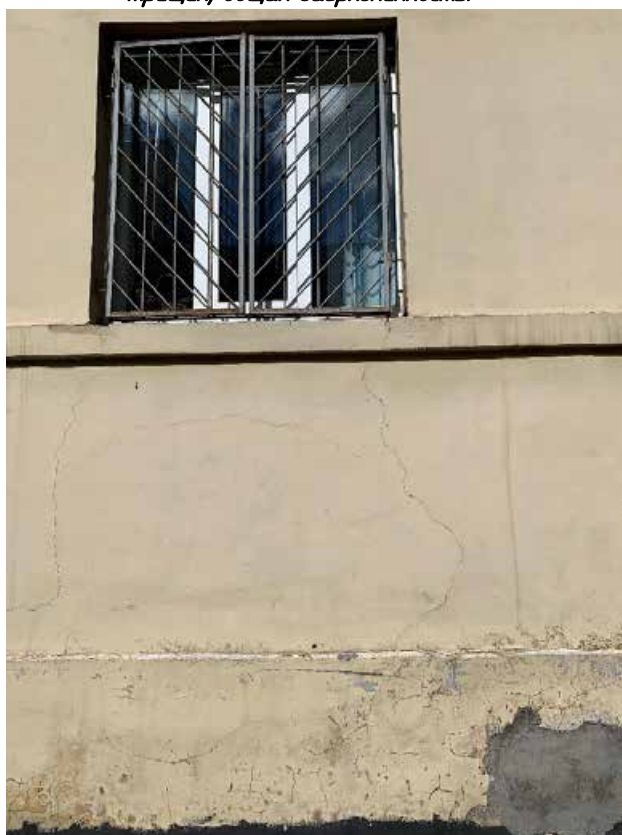
Фото №122. Фрагмент фасада. Наблюдаются деградация красочного и штукатурного слоя, сеть волосяных трещин, трещины по красочному слою, поздние ремонтные вмешательства, общая загрязненность.
