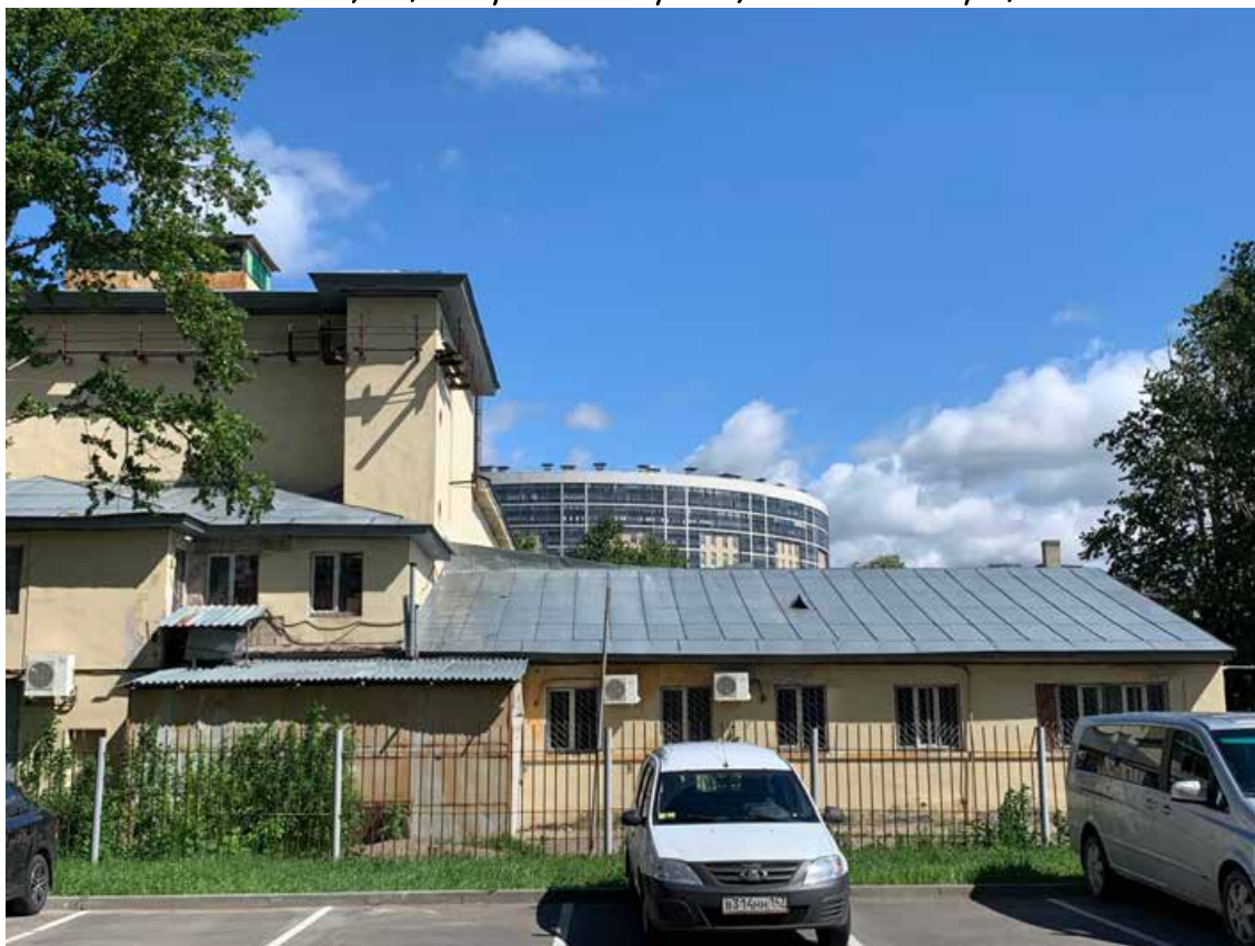
Фото №65. Общий вид оборотного фасада. Наблюдается деградация красочного и штукатурного слоя, современные стеклопакеты, общая загрязненность фасада, сеть волосяных трещин.
