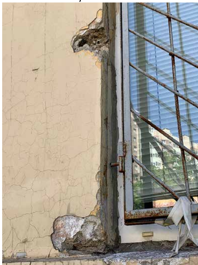
Фото №98. Фрагмент оконного проема. Наблюдаются деструкция красочного и штукатурного слоя, сколы, сеть волосяных трещин, общая загрязненность.
