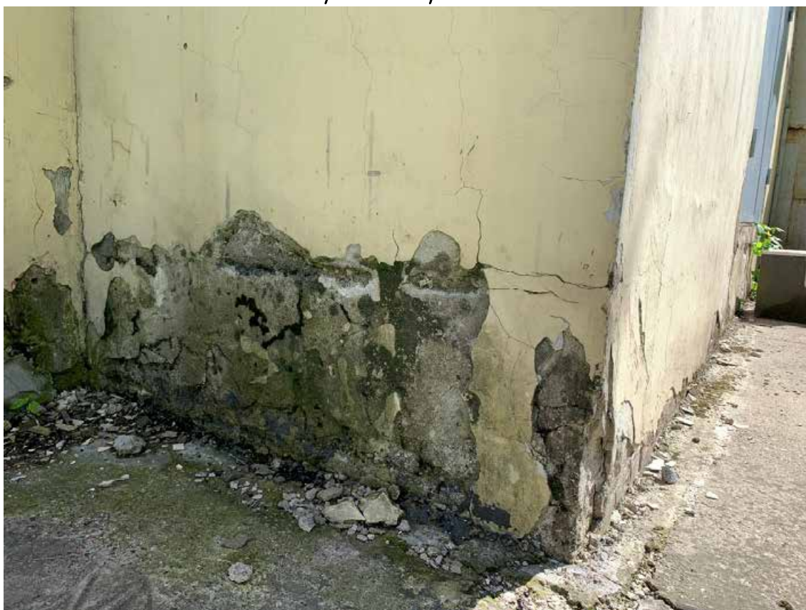
Фото №82. Фрагмент цоколя фасада. Наблюдается деструкция красочного и штукатурного слоя, биопоражения, общая загрязненность.
