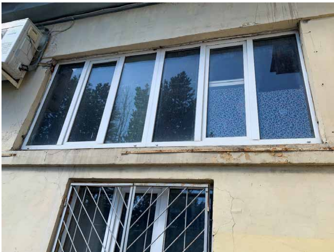
Фото №167. Фрагмент оконного проема. Наблюдается деградация красочного, сеть волосяных трещин, общая загрязненность.
