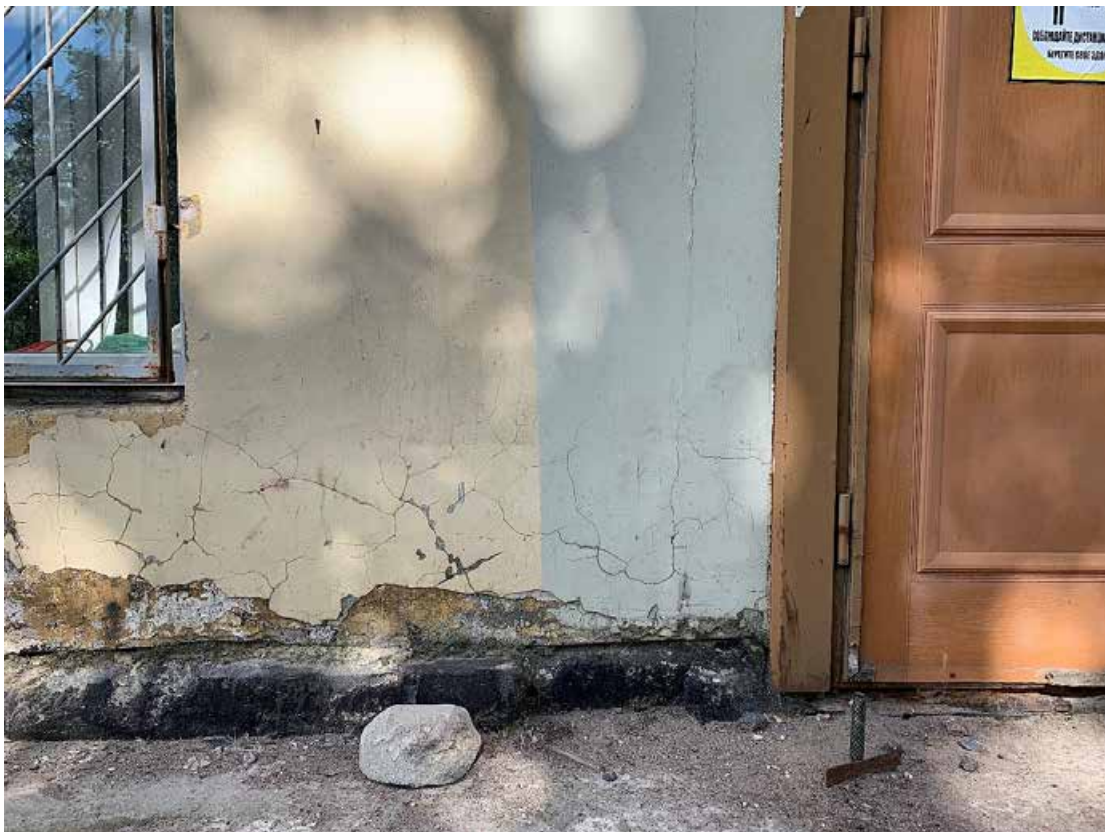
Фото №177. Фрагмент докового фасада. Наблюдается деструкция красочного и штукатурного слоя, поздние ремонтные вмешательства, сеть волосяных трещин, сколы, общая загрязненность.
