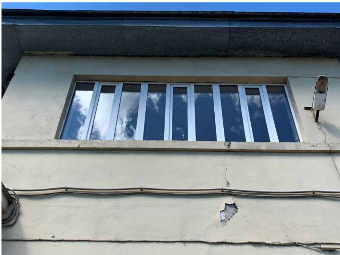
Фото №155. Фрагмент оконного проема. Наблюдается деструкция красочного слоя, сеть волосяных трещин, общая загрязненность фасада.
