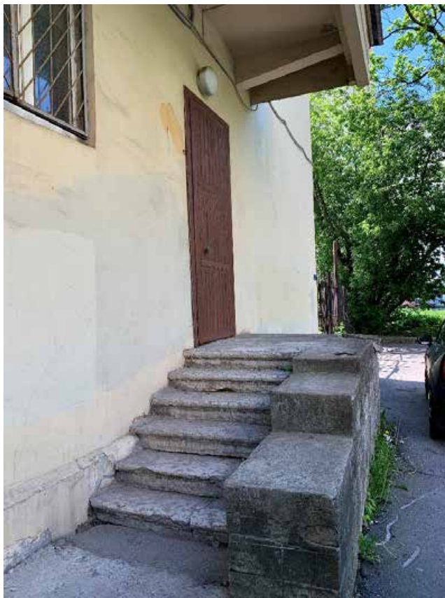
Фото №45. Фрагмент входной деревянной двери докового фасада. Наблюдается деградация красочного слоя, общая загрязненность, поздние ремонтные вмешательства
