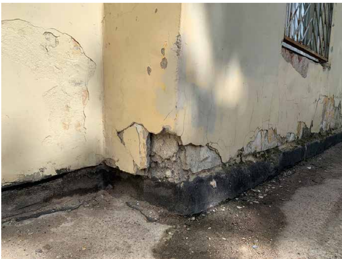
Фото №180. Фрагмент бокового фасада. Наблюдается деградация красочного и штукатурного слоя, поздние ремонтные вмешательства, сеть волосяных трещин, сколы, общая загрязненность.
