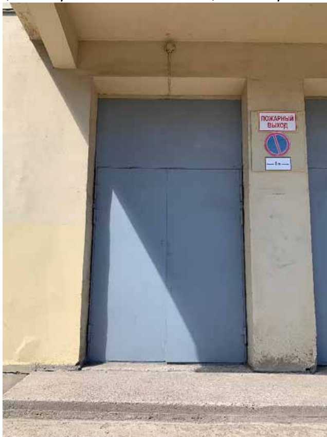
Фото №160. Фрагмент металлической входной двери. Наблюдается деградация красочного слоя, сколы, сеть волосяных трещин, поздние ремонтные вмешательства, общая загрязненность.
