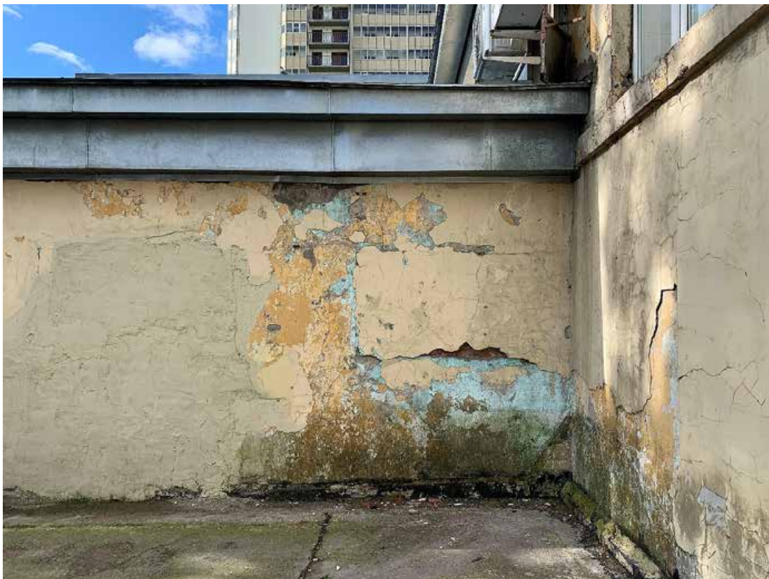
Фото №171. Фрагмент докового фасада. Наблюдается деградация красочного и штукатурного слоя, биопоражение, сеть волосяных трещин, поздние ремонтные вмешательства, сколы, общая загрязненность.
