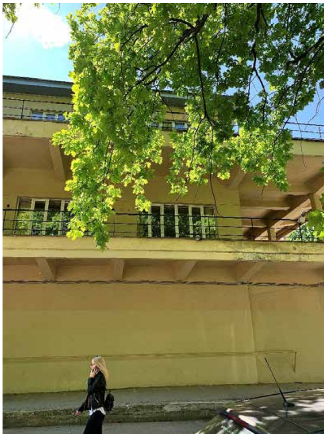
Фото №13. Фрагмент главного фасада с балконом. Наблюдается деградация красочного и штукатурного слоя, современные стеклопакеты, поздние ремонтные вмешательства и общая загрязненность фасада.
