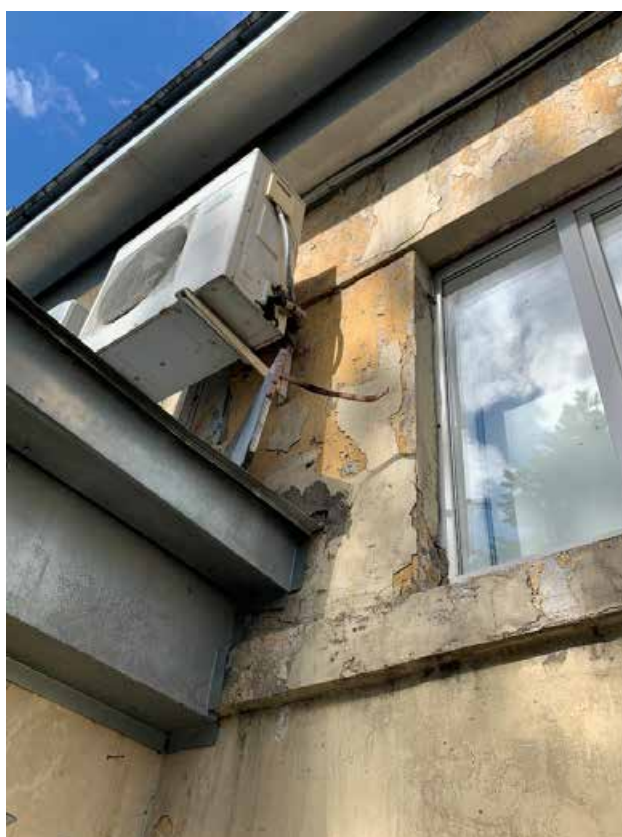
Фото №170. Фрагмент бокового фасада. Наблюдается деградация красочного и штукатурного слоя, сеть волосяных трещин, сколы, общая загрязненность.
