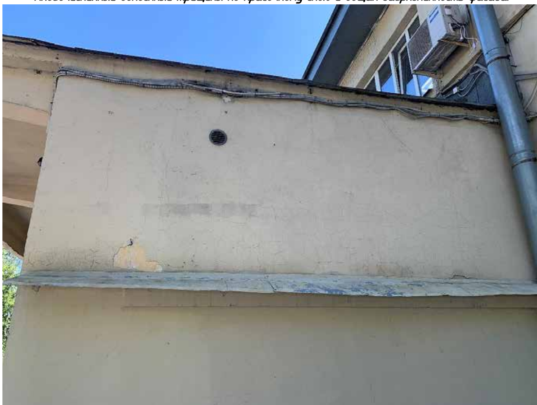
Фото №28. Фрагмент декоративной части центральной входной группы главного фасада с козырьком. Наблюдается деградация красочного и штукатурного слоя, многочисленные волосяные трещины по красочному слою, общая загрязненность.
