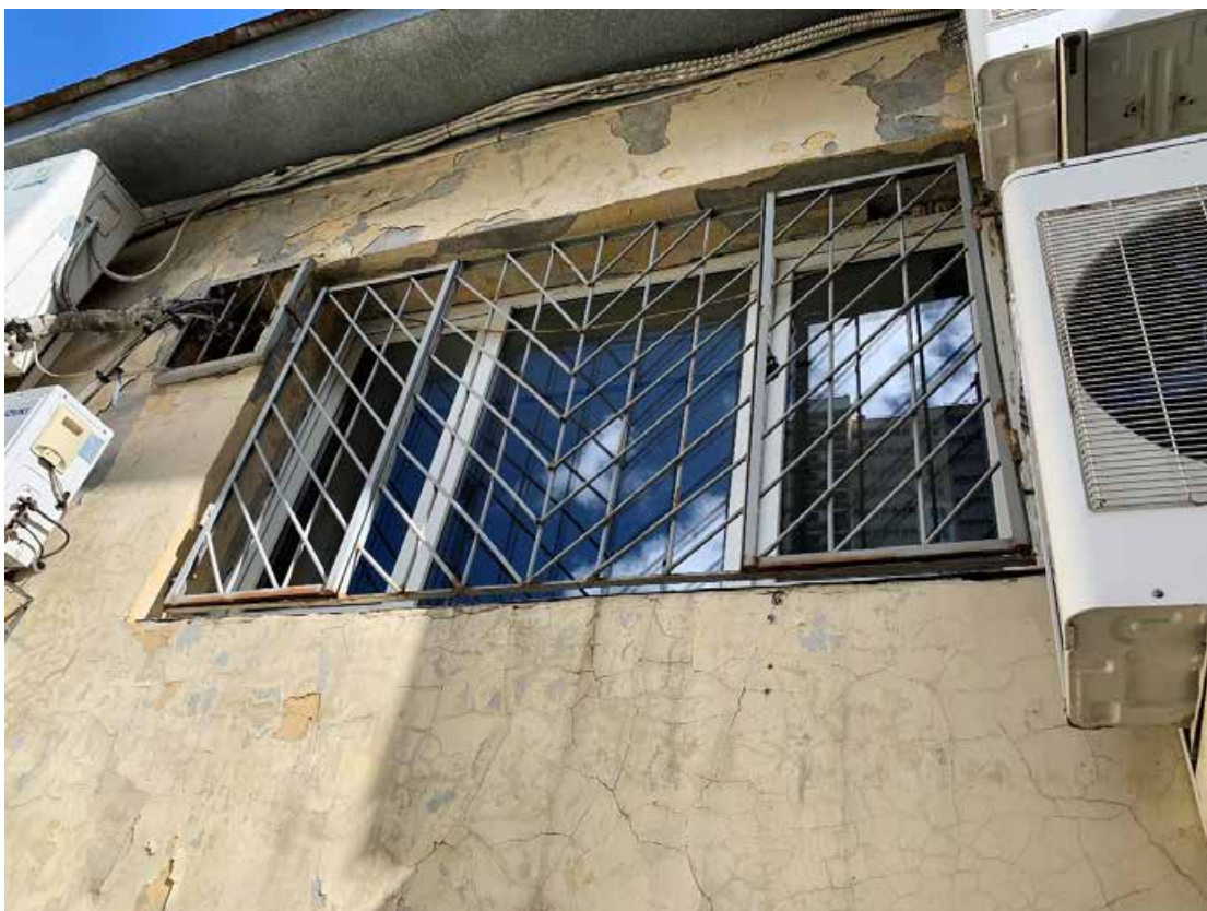
Фото №117. Фрагмент оконного проема. Наблюдаются деструкция красочного и штукатурного слоя, общая загрязненность.
