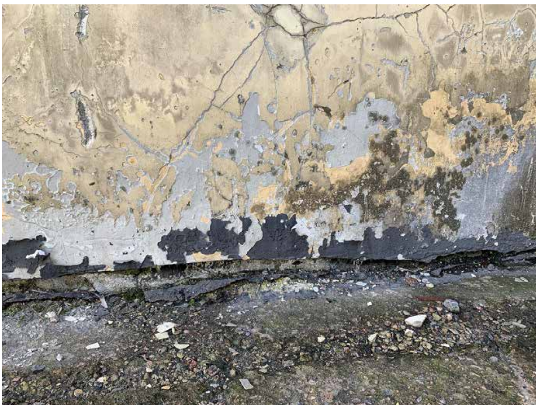
Фото №118. Фрагмент фасада. Наблюдаются деструкция красочного и штукатурного слоя, диспоразения, общая загрязненность.
