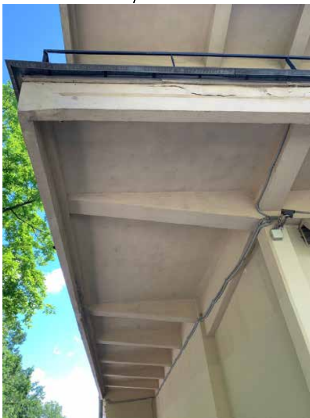
Фото №16. Фрагмент балкона. Наблюдается деструкция красочного и штукатурного слоя, общая загрязненность, трещины.
