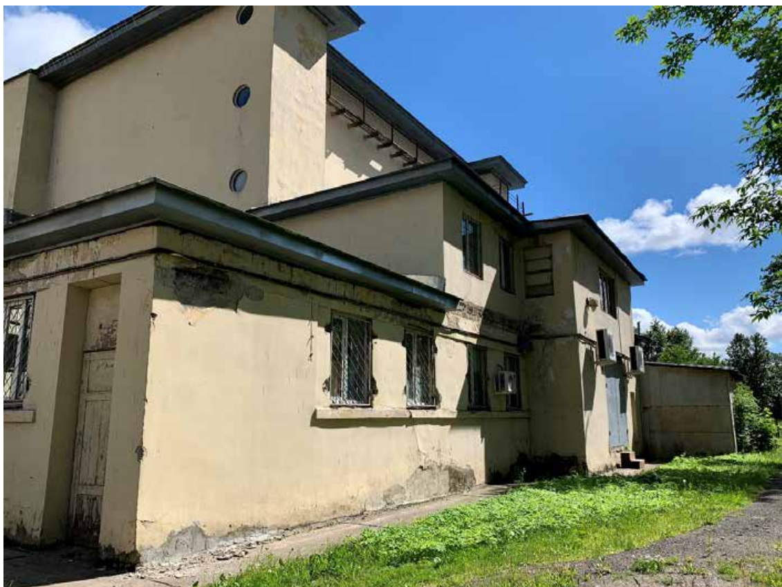
Фото №58. Общий вид оборотного фасада. Наблюдается деградация красочного и штукатурного слоя, современные стеклопакеты, общая загрязненность фасада, многочисленные волосяные трещины по красочному слою.
