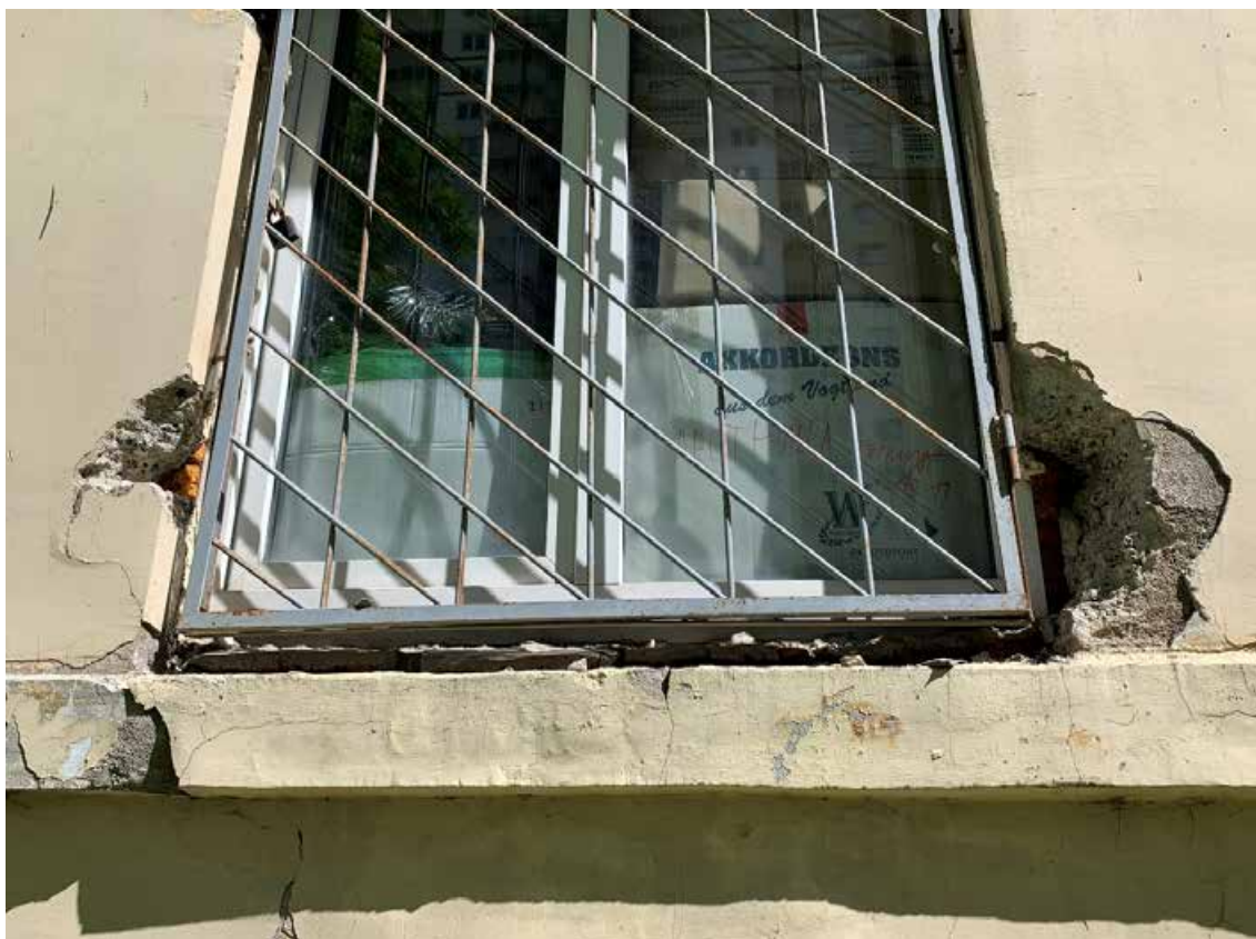
Фото №89. Фрагмент оконного проема. Наблюдается деструкция красочного и штукатурного слоя, сколы, общая загрязненность.
