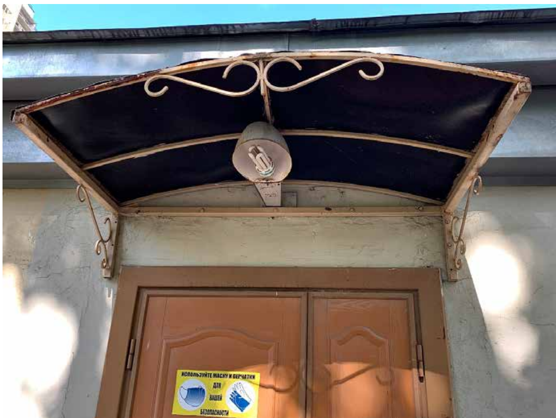
Фото №175. Фрагмент бокового фасада. Наблюдается сеть волосяных трещин, поздние ремонтные вмешательства, коррозия металла, общая загрязненность.
