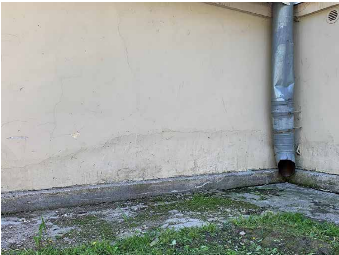
Фото №29. Фрагмент боковой части центральной входной группы главного фасада с козырьком. Наблюдается деструкция штукатурного слоя, многочисленные волосяные трещины по красочному слою, потки и общая загрязненность.
