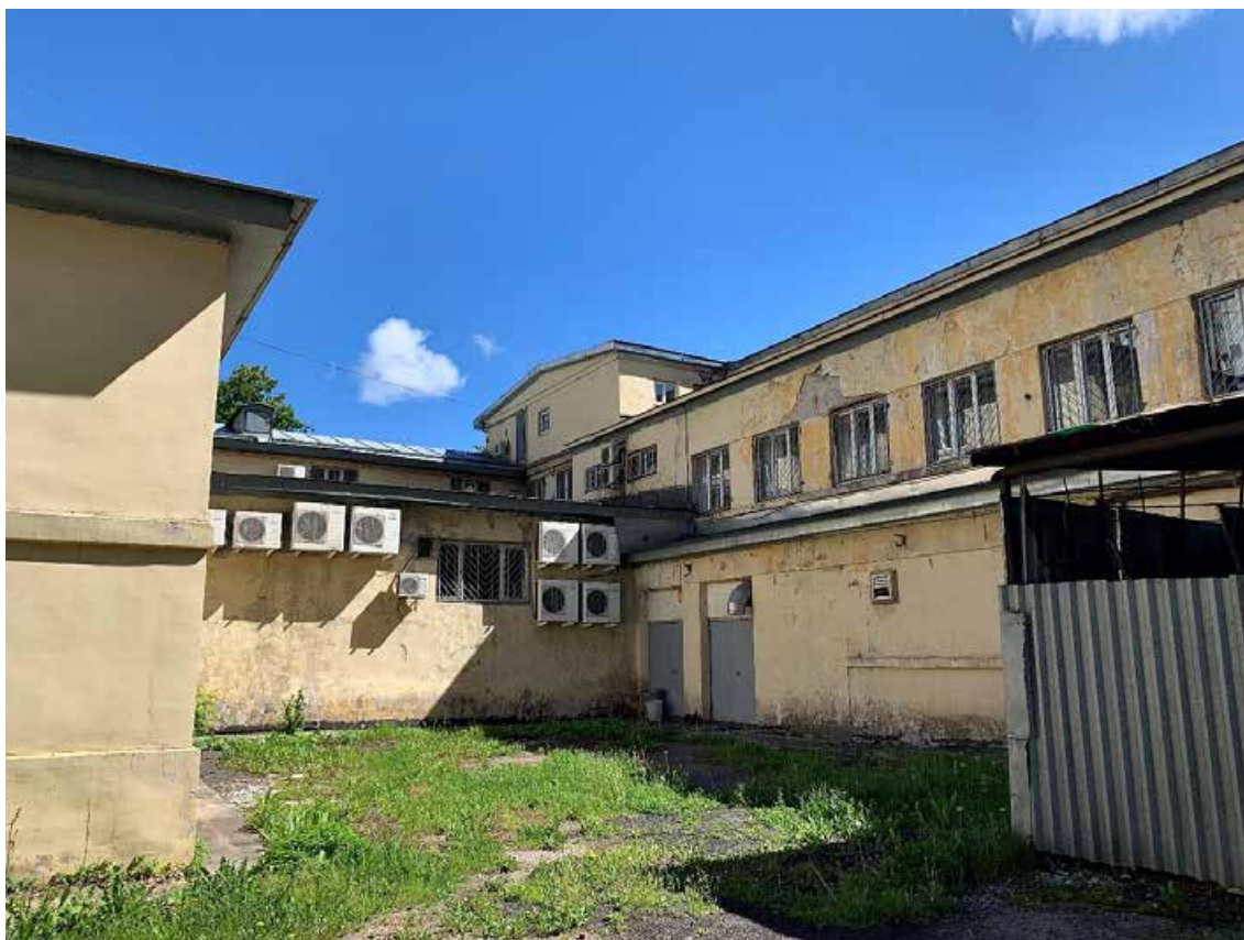
Фото №54. Общий вид дворового фасада. Наблюдается деградация красочного и штукатурного слоя, современные стеклопакеты, общая загрязненность фасада, многочисленные волосяные трещины по красочному слою
