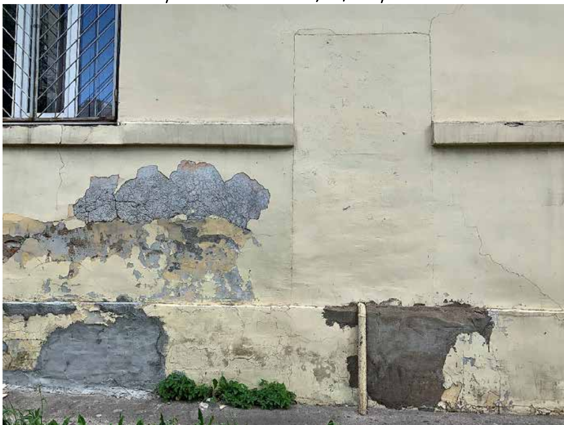
Фото №124. Фрагмент фасада. Наблюдаются деструкция красочного и штукатурного слоя, сеть волосяных трещин, трещины, поздние ремонтные вмешательства, общая загрязненность. Заложённый проем.
