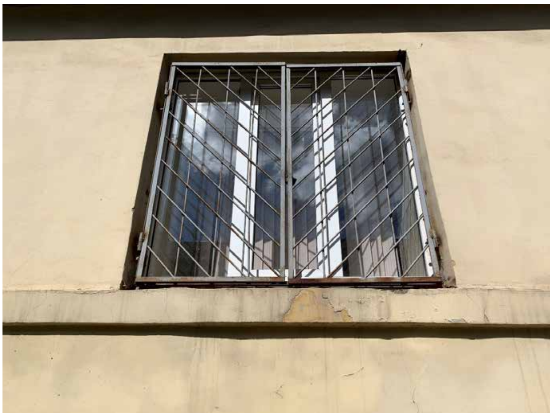
Фото №121. Фрагмент оконного проема. Наблюдаются деградация красочного и штукатурного слоя, сеть волосяных трещин, общая загрязненность.
