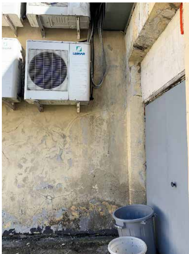
Фото №15. Фрагмент фасада. Наблюдаются деструкция красочного и штукатурного слоя, потеки, сеть волосяных трещин, биопоражения, общая загрязненность.
