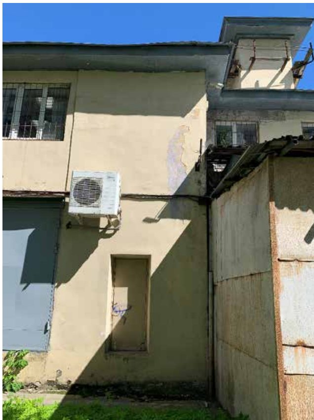
Фото №75. Фрагмент дворового фасада. Наблюдается деструкция красочного и штукатурного слоя, сеть волосяных трещин, общая загрязненность фасада.
