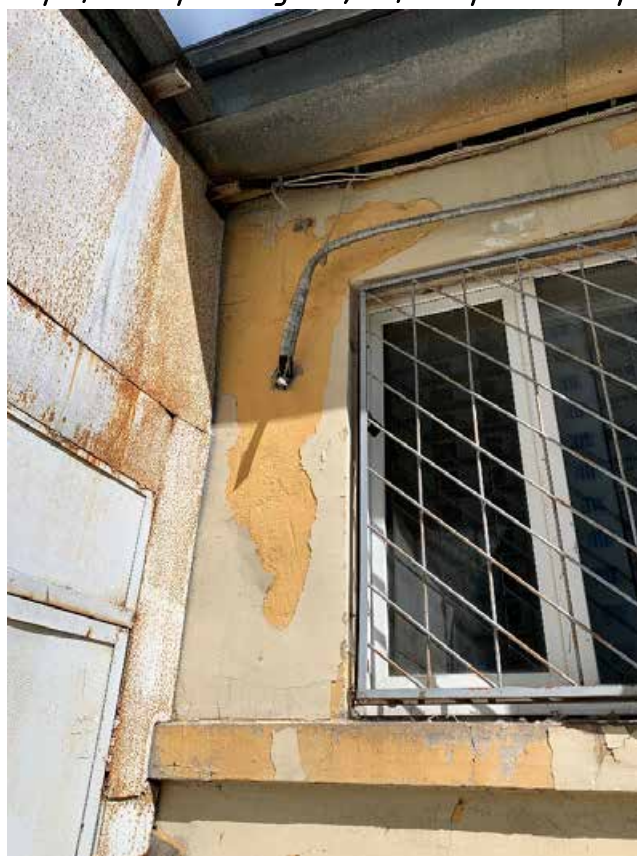
Фото №71. Фрагмент оконного проема. Наблюдается деструкция красочного и штукатурного слоя, многочисленные волосяные трещины по красочному слою, общая загрязненность фасада.
