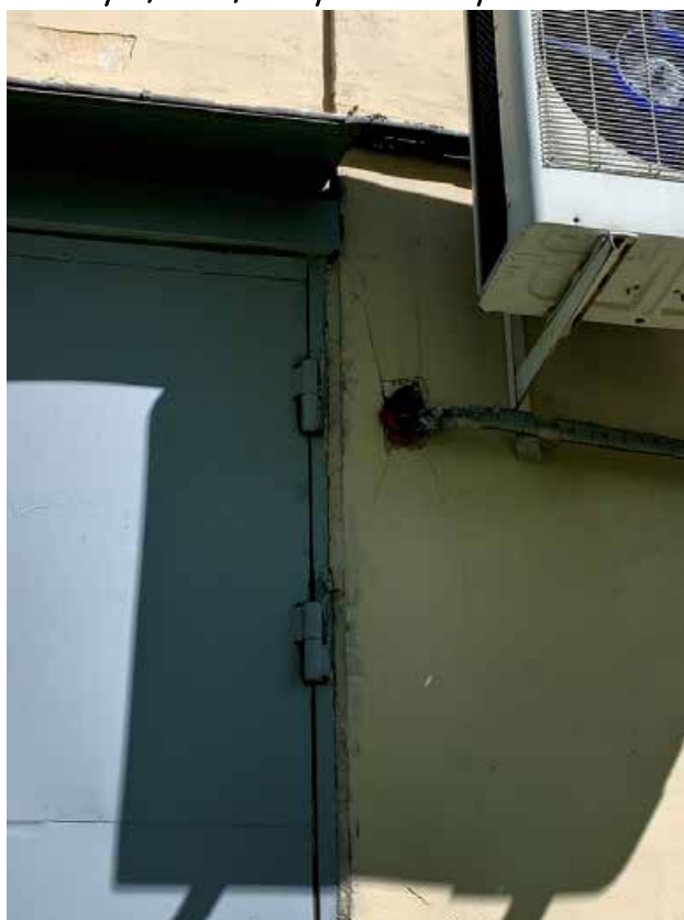
Фото №78. Фрагмент металлический ворот. Фрагмент дворового фасада. Наблюдается деструкция штукатурного слоя, сеть волосяных трещин, общая загрязненность.
