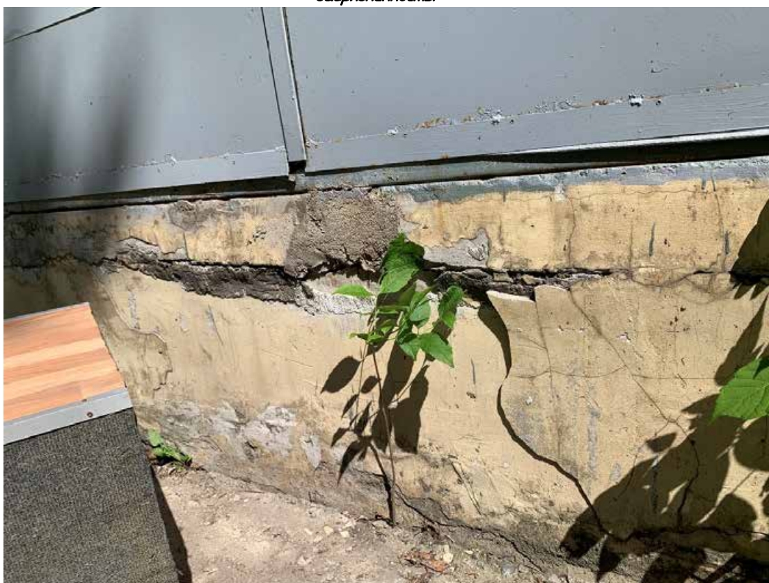
Фото №80. Фрагмент металлических ворот. Наблюдается отслоение красочного, деструкция штукатурного слоя, общая загрязненность.
