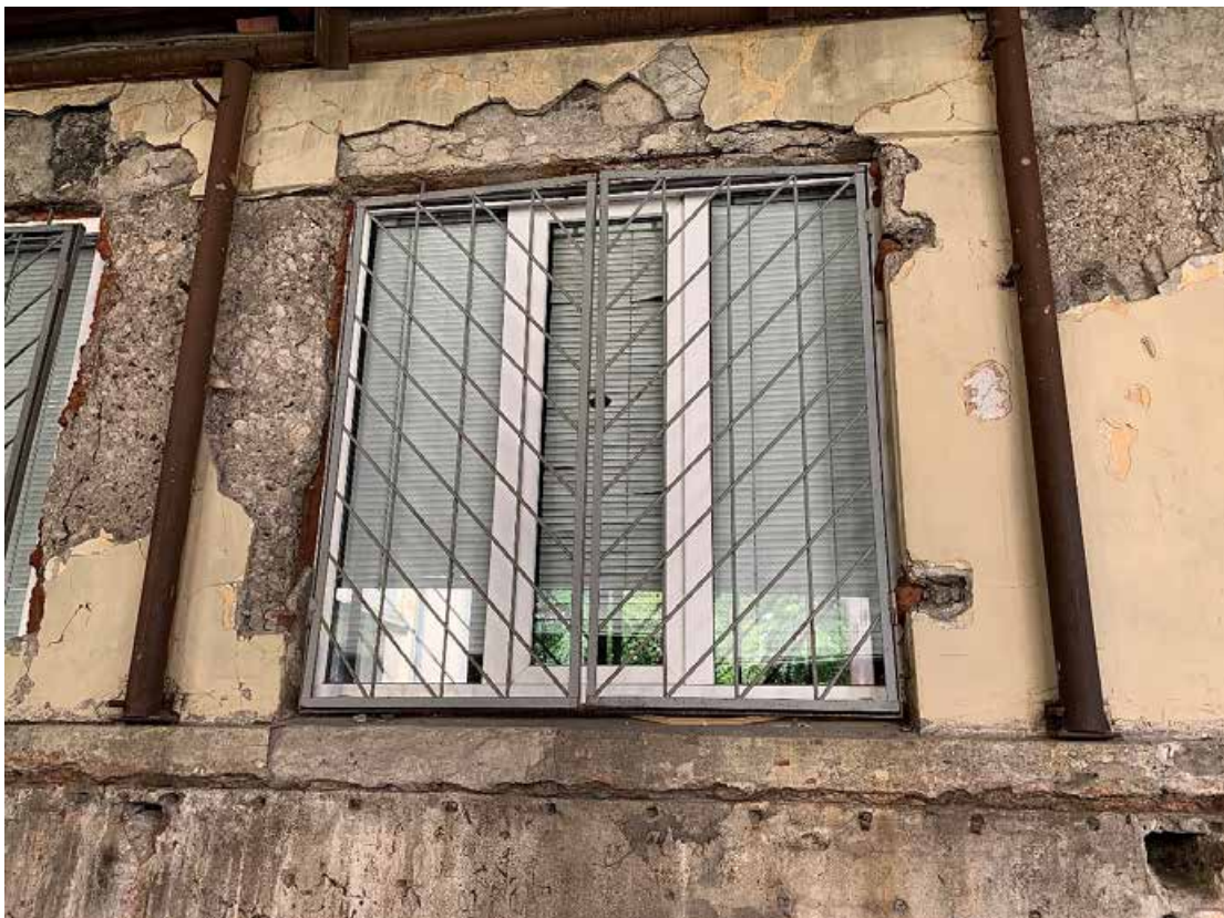
Фото №101. Фрагмент оконного проема. Наблюдаются деструкция красочного и штукатурного слоя, сколы, трещины, общая загрязненность.
