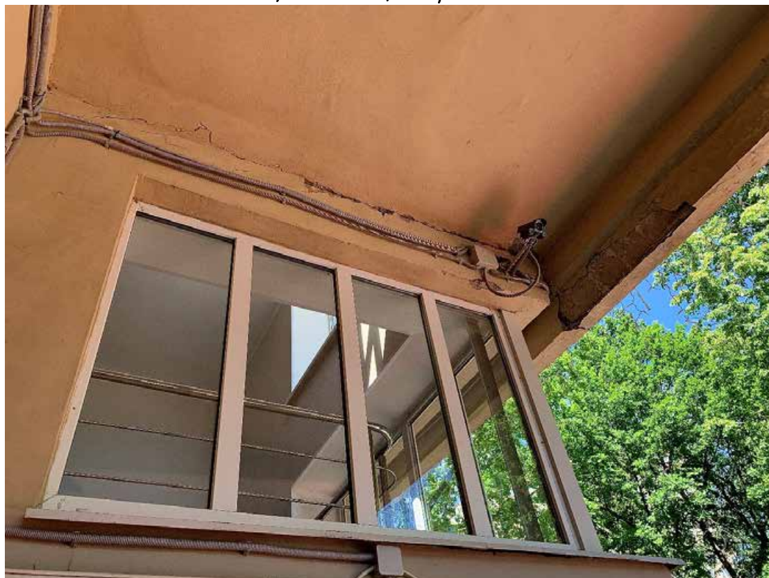
Фото №20. Фрагмент входной группы главного фасада с угловым окном. Наблюдаются трещины, деструкция штукатурного слоя, многочисленные волосяные трещины по красочному слою, общая загрязненность.
