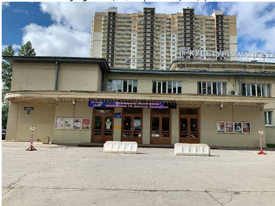
Фото №6. Фрагмент главного фасада. Наблюдается деградация штукатурного слоя, современные стеклопакеты, общая загрязненность фасада, трещины.
