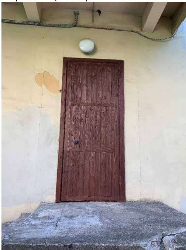
Фото №46. Фрагмент входной деревянной двери докового фасада. Наблюдается деградация красочного слоя, общая загрязненность, поздние ремонтные вмешательства
