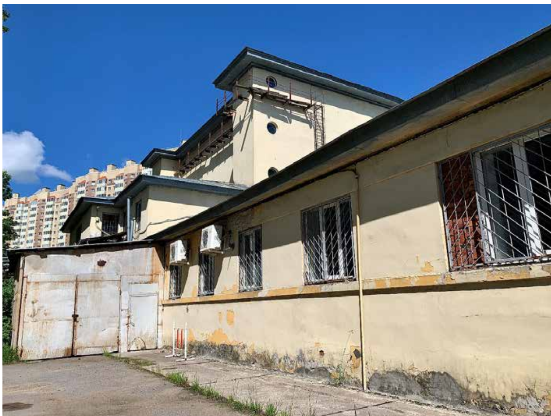
Фото №66. Фрагмент дворового фасада. Наблюдается деструкция красочного и штукатурного слоя, сеть волосяных трещин, общая загрязненность фасада.
