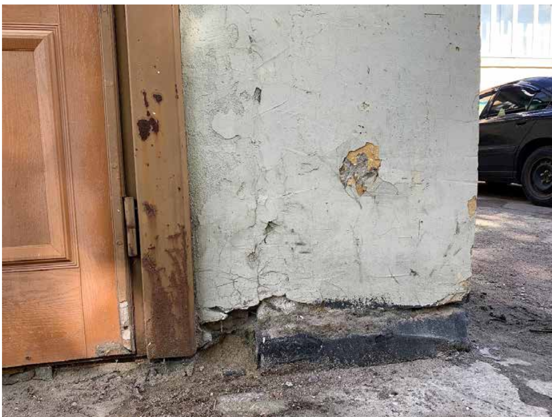
Фото №172. Фрагмент докового фасада. Наблюдается деградация красочного и штукатурного слоя, сеть волосяных трещин, сколы, общая загрязненность.
