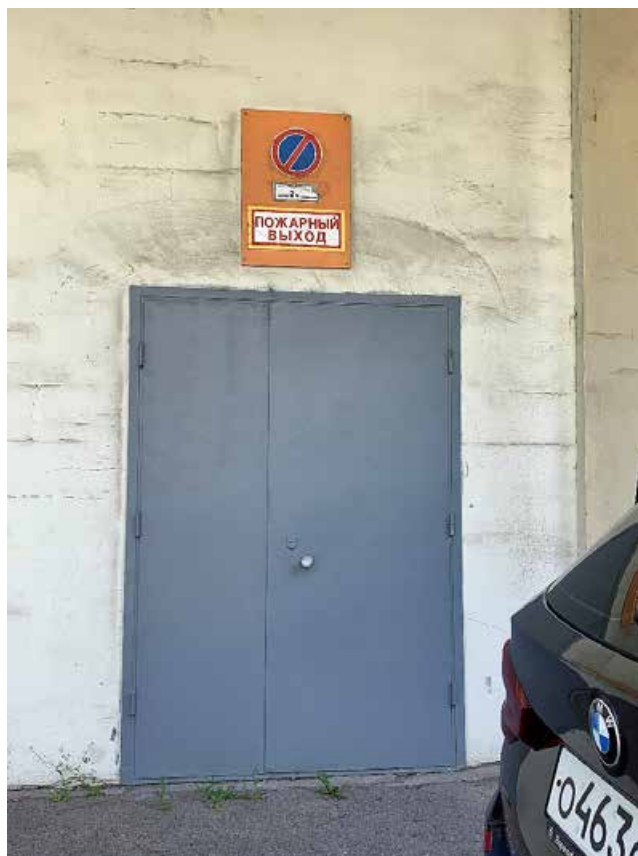
Фото №49. Фрагмент входной металлической двери докового фасада. Наблюдается деградация красочного слоя, общая загрязненность.
