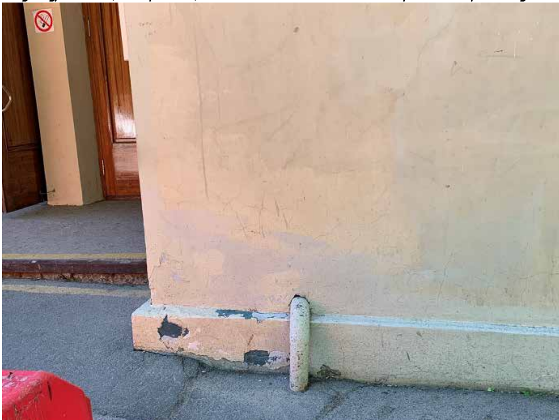
Фото №26. Фрагмент входной группы главного фасада с козырьком. Наблюдается деградация красочного слоя, многочисленные волосяные трещины по красочному слою, поздние ремонтные вмешательства, общая загрязненность.
