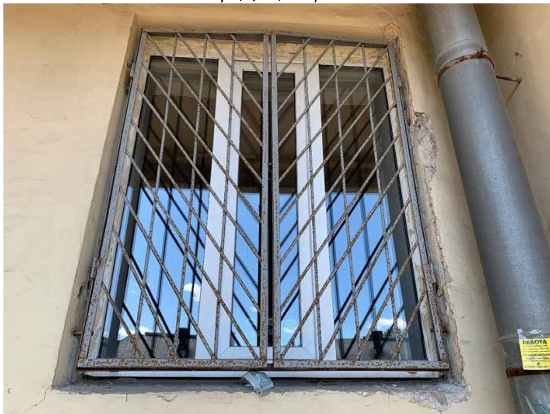
Фото №158. Фрагмент оконного проема. Наблюдается деструкция красочного и штукатурного слоя, сколы, сеть волосяных трещин, общая загрязненность.
