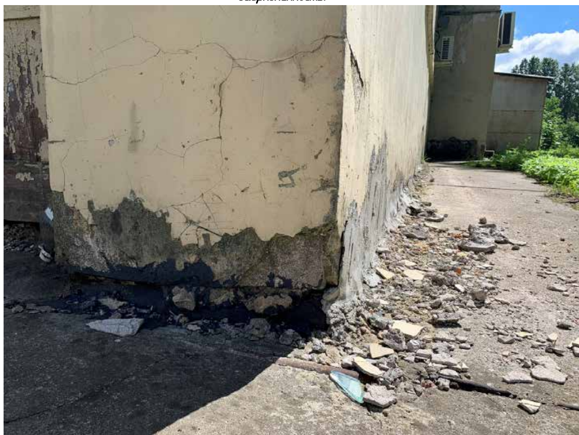
Фото №92. Фрагмент цоколя фасада. Наблюдается деструкция красочного и штукатурного слоя, сколы, сеть волосяных трещин, общая загрязненность.
