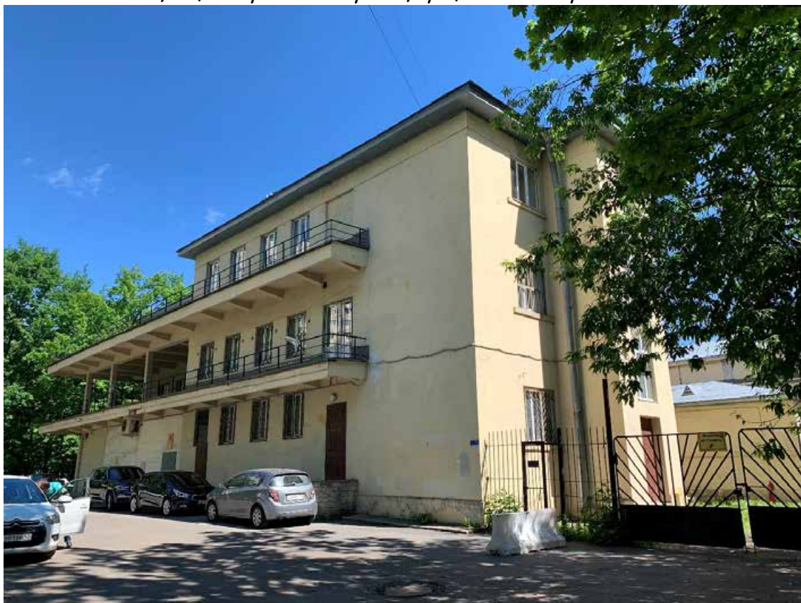
Фото №32. Общий вид докового фасада с балконом. Наблюдается деградация штукатурного слоя, современные стеклопакеты, общая загрязненность фасада, трещины и поздние ремонтные вмешательства.
