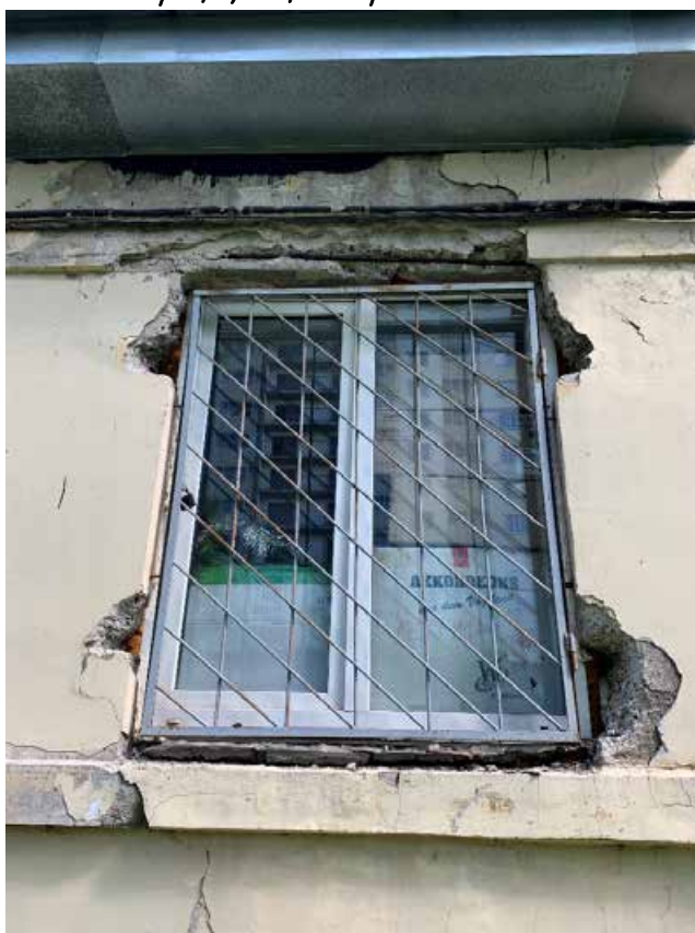
Фото №88. Фрагмент оконного проема. Наблюдается деструкция красочного и штукатурного слоя, сколы, трещины, общая загрязненность.
