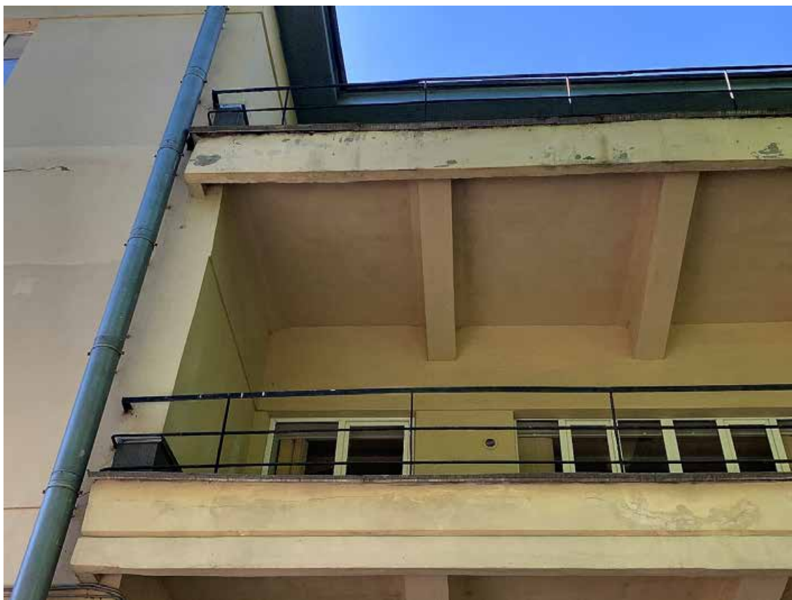
Фото №17. Фрагмент балкона. Наблюдаются трещины, разрушения штукатурного и красочного слоя, потеки, многочисленные волосяные трещины по красочному, поздние ремонтные вмешательства и общая загрязненность.
