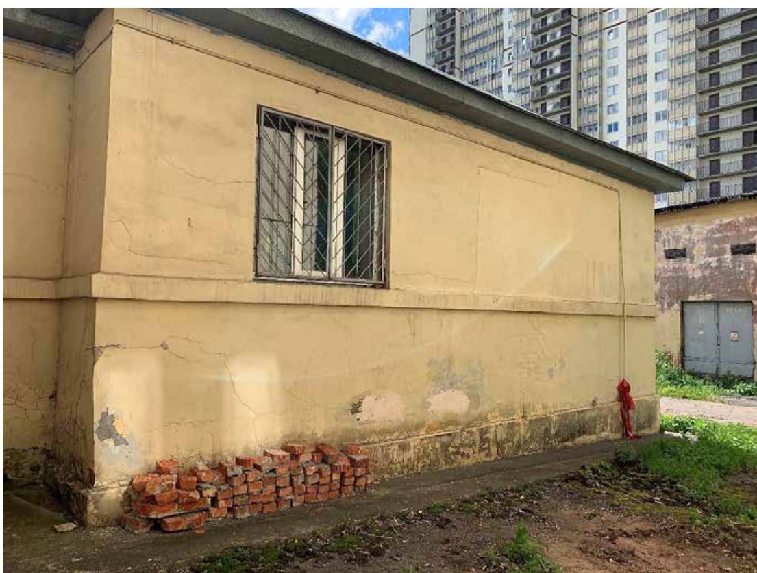
Фото №128. Фрагмент дворового фасада. Наблюдаются деструкция красочного и штукатурного слоя, сеть волосяных трещин, трещины, поздние ремонтные вмешательства, общая загрязненность.
