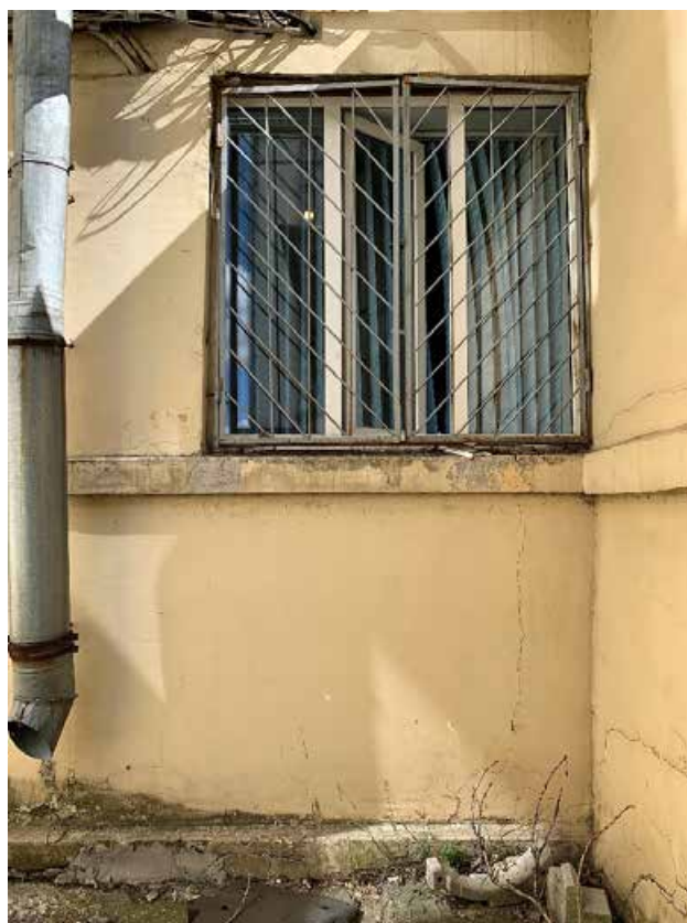
Фото №132. Фрагмент фасада. Наблюдаются деструкция красочного и штукатурного слоя, биопоражения, сеть волосяных трещин, трещины, общая загрязненность.
