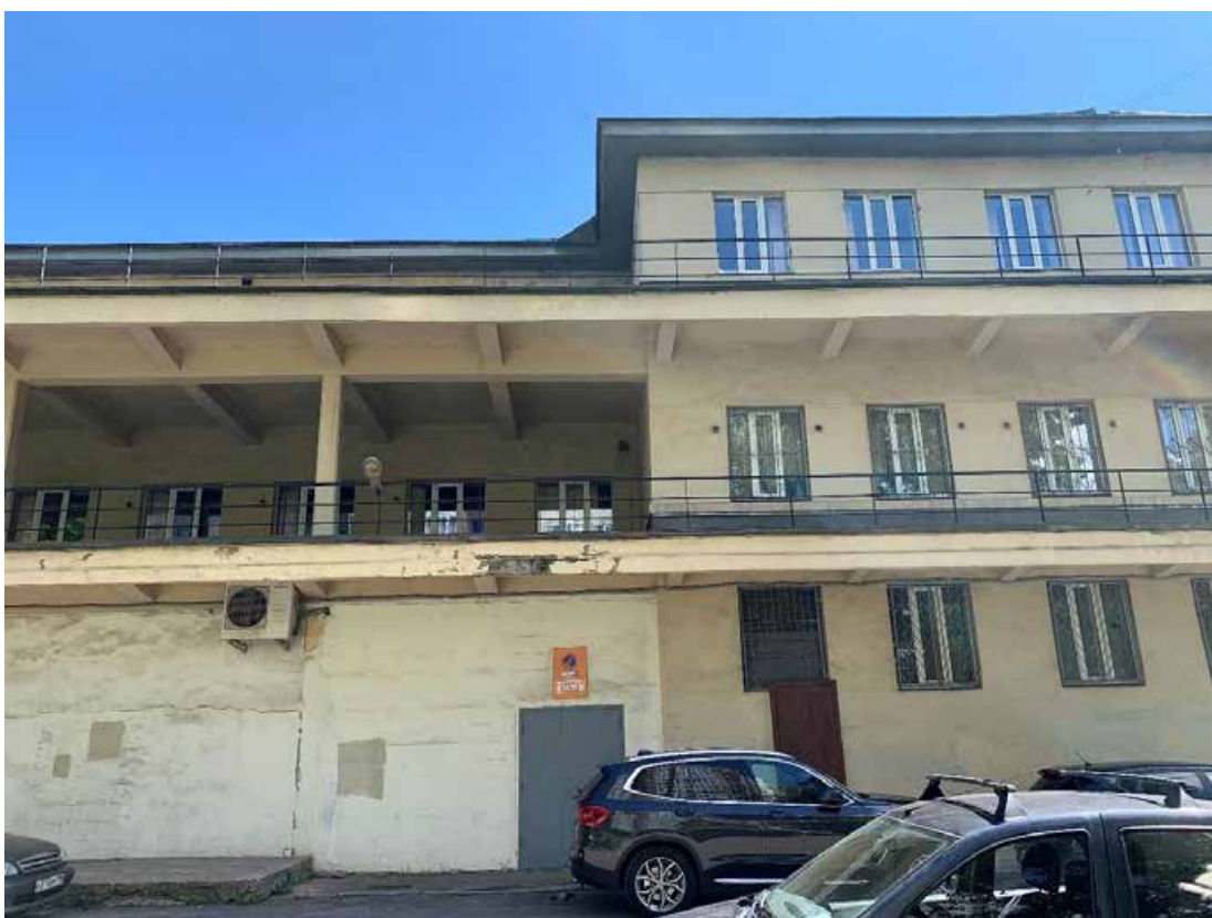
Фото №34. Фрагмент бокового фасада с балконом. Наблюдается деструкция штукатурного слоя, современные стеклопакеты, общая загрязненность фасада, трещины и поздние ремонтные вмешательства.
