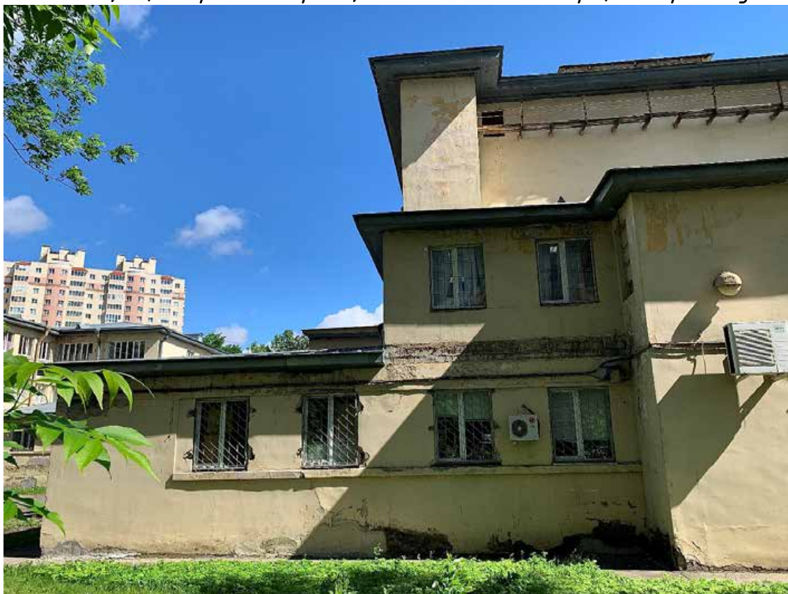
Фото №59. Общий вид оборотного фасада. Наблюдается деградация красочного и штукатурного слоя, общая загрязненность фасада, трещины по красочному слою, сеть волосяных трещин.
