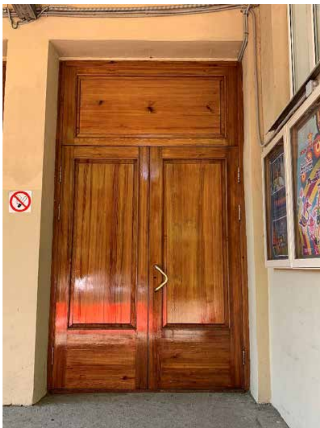
Фото №23. Фрагмент входной группы главного фасада с козырьком. Вид на входную деревянную дверь. Наблюдаются деструкция красочного слоя, поздние ремонтные вмешательства, общая загрязненность.
