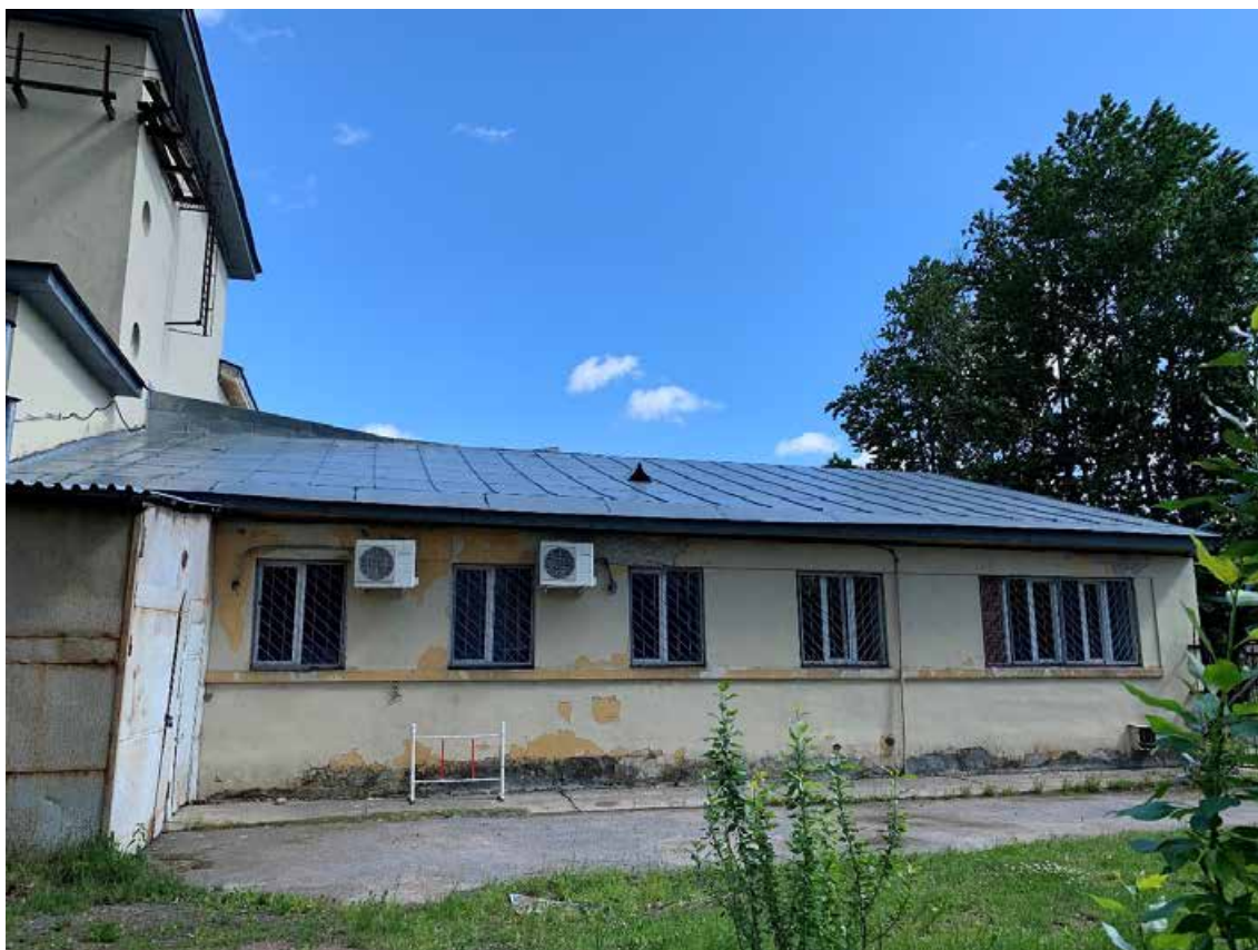
Фото №62. Общий вид оборотного фасада. Наблюдается деградация красочного и штукатурного слоя, современные стеклопакеты, общая загрязненность фасада, сеть волосяных трещин.
