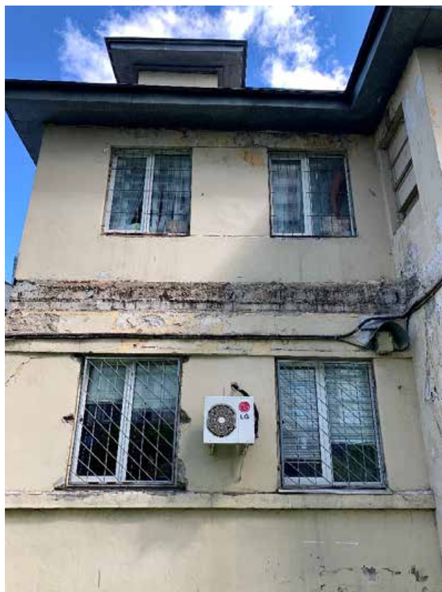
Фото №85. Фрагмент фасада. Наблюдается деструкция красочного и штукатурного слоя, сеть волосяных трещин, общая загрязненность.
