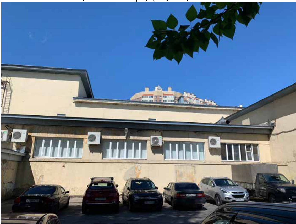
Фото №152 Фрагмент бокового фасада. Наблюдается деструкция красочного и штукатурного слоя, потеки, сколы, сеть волосяных трещин, общая загрязненность.
