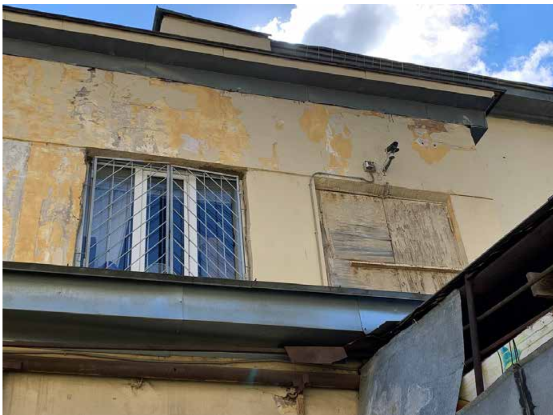
Фото №87. Фрагмент фасада. Наблюдаются деградация красочного и штукатурного слоя, общая загрязненность.
