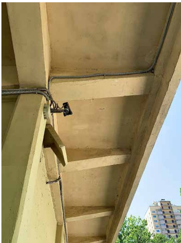
Фото №37. Фрагмент балкона докового фасада. Наблюдается деструкция красочного слоя, многочисленные волосяные трещины по красочному слою, общая загрязненность.
