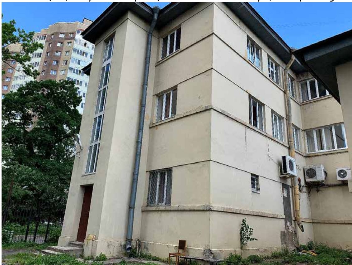
Фото №51. Общий вид дворового фасада. Наблюдается деградация красочного и штукатурного слоя, современные стеклопакеты, общая загрязненность фасада, многочисленные волосяные трещины по красочному слою.
