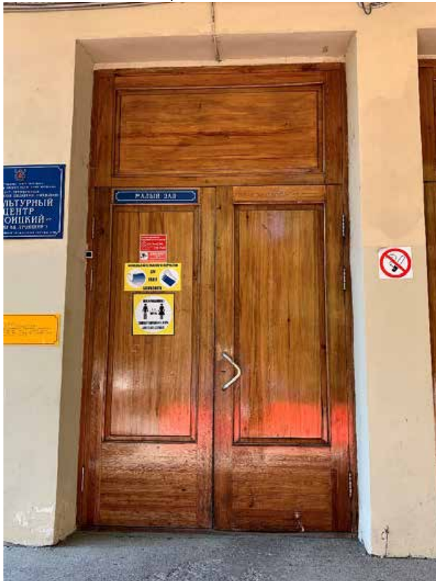
Фото №24. Фрагмент входной группы главного фасада с козырьком. Вид на входную деревянную дверь. Наблюдаются деструкция красочного слоя, поздние ремонтные вмешательства, общая загрязненность.
