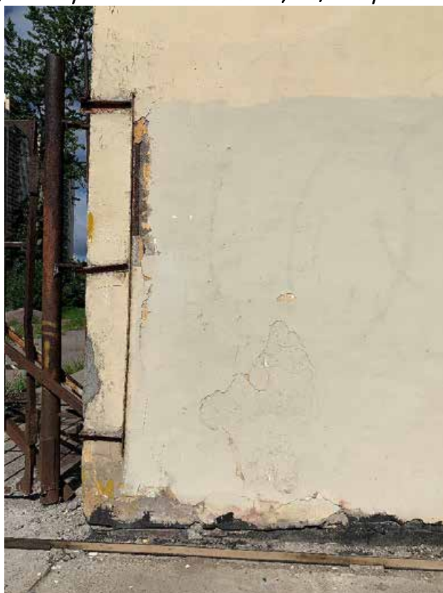
Фото №182. Фрагмент бокового фасада. Наблюдается деструкция красочного и штукатурного слоя, поздние ремонтные вмешательства, сеть волосяных трещин, сколы, общая загрязненность.
