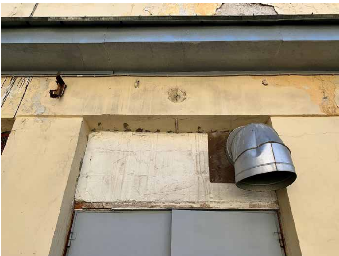
Фото №112. Фрагмент входной металлической двери дворового фасада. Наблюдаются деструкция красочного и штукатурного слоя, общая загрязненность.
