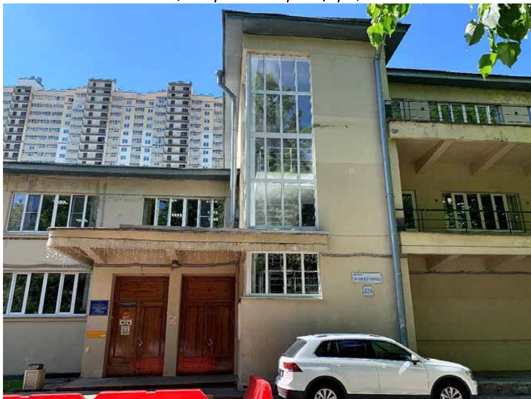
Фото №10. Фрагмент главного фасада с входной группой. Наблюдается деструкция штукатурного слоя, современные стеклопакеты, поздние ремонтные вмешательства, общая загрязненность фасада, трещины.
