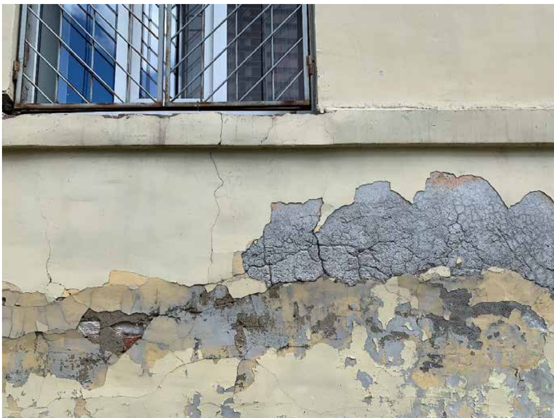
Фото №125. Фрагмент фасада. Наблюдаются деструкция красочного и штукатурного слоя, общая загрязненность.
