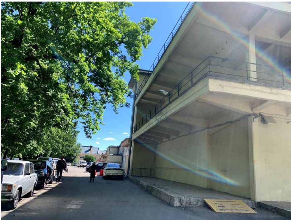
Фото №3. Главный фасад со стороны проспекта Одуховской Обороны. Наблюдается деструкция штукатурного слоя, общая загрязненность фасада, трещины.
