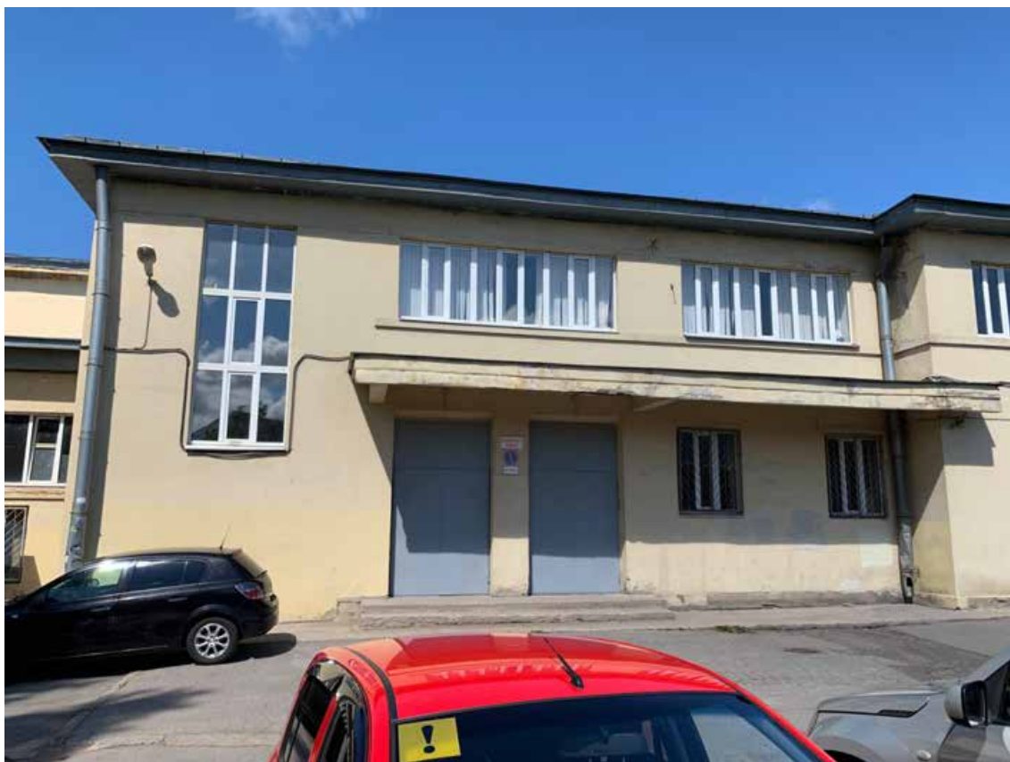
Фото №153. Фрагмент входной группы докового фасада с козырьком. Наблюдается деградация красочного слоя, сеть волосяных трещин, общая загрязненность фасада, поздние ремонтные вмешательства.
