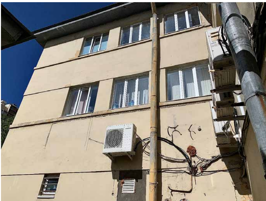
Фото №138. Фрагмент фасада. Наблюдаются деструкция красочного слоя, общая загрязненность.
