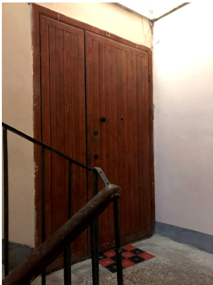
Фото 1. Вид на входную дверь в кв. № 32 с черной лестницы.
