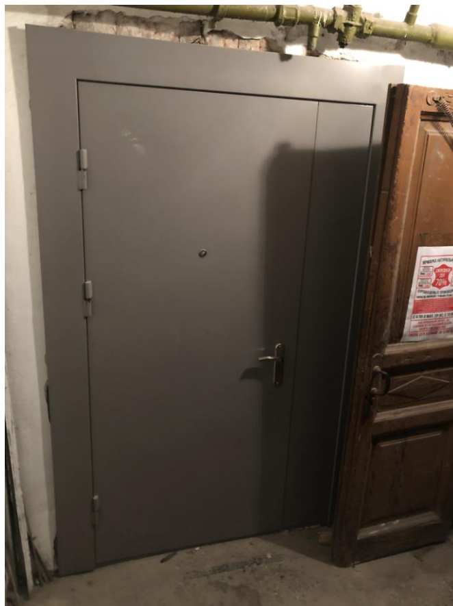
Фото 2. Вид на входную дверь в кв. № 32 с другой черной лестницы.
