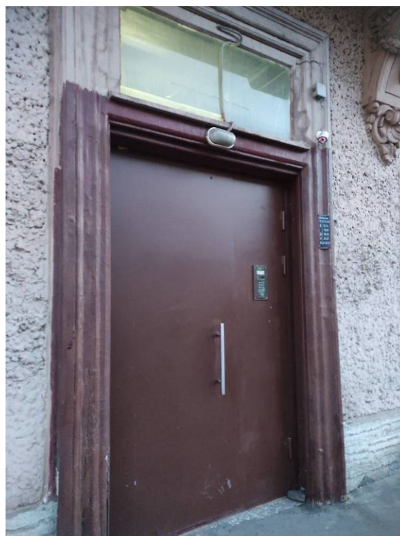
Фото 5. Фрагмент фасада объекта культурного наследия федерального значения «Дом, где в 1912-1918 гг. жил основатель оркестра русских народных инструментов Андреев В.В.», дверное заполнение парадной
