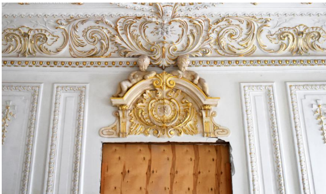
60. 3 этаж, кв. 5, пом. 10. Верхняя часть стены между пом. 10 и пом. 9. Восстановлены стеновые лепные панели.
