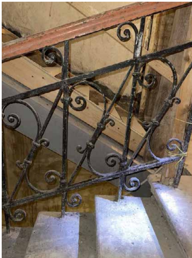
26. Объект культурного наследия регионального значения «Дом К.А. Шрейбера». Фрагмент ограждения «черной» лестницы (Л-3).
