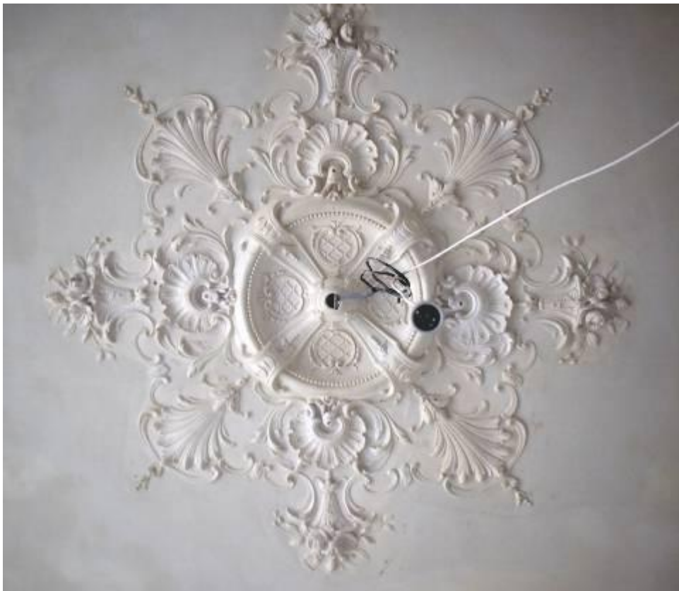
88. 3 этаж, кв. 14, пом. 4,3. Центральная часть плафона.
