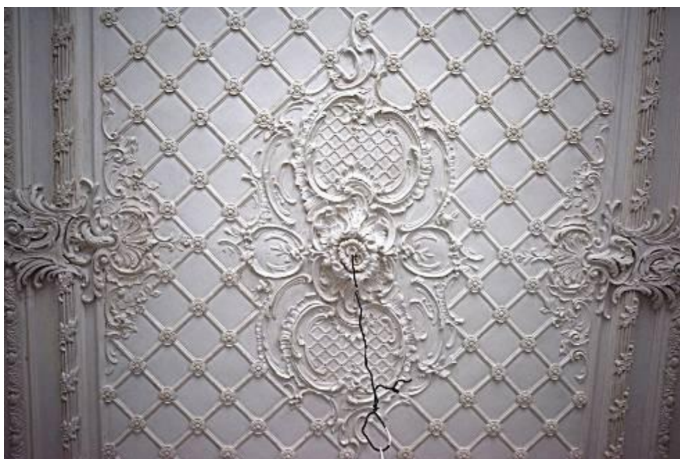
93. 3 этаж, кв. 14, пом. 2. Центральная часть плафона.
