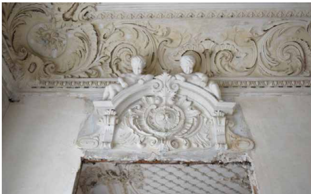
102. 1 этаж, кв. 2, пом. 2. Десудепорт дверного проема в пом. 3. Фрагмент декора плафона.
