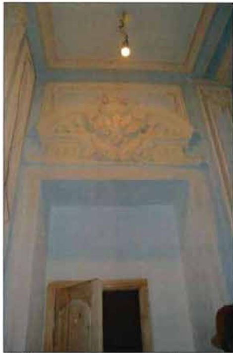
11. Десюдепорт на лестничной площадке 2ЛК. Фотофиксация от 15.09.2021.
