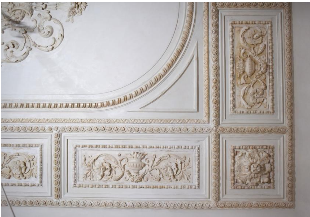
136. 2 этаж, кв. 4, пом. 6. Фрагмент угловой части плафона.
