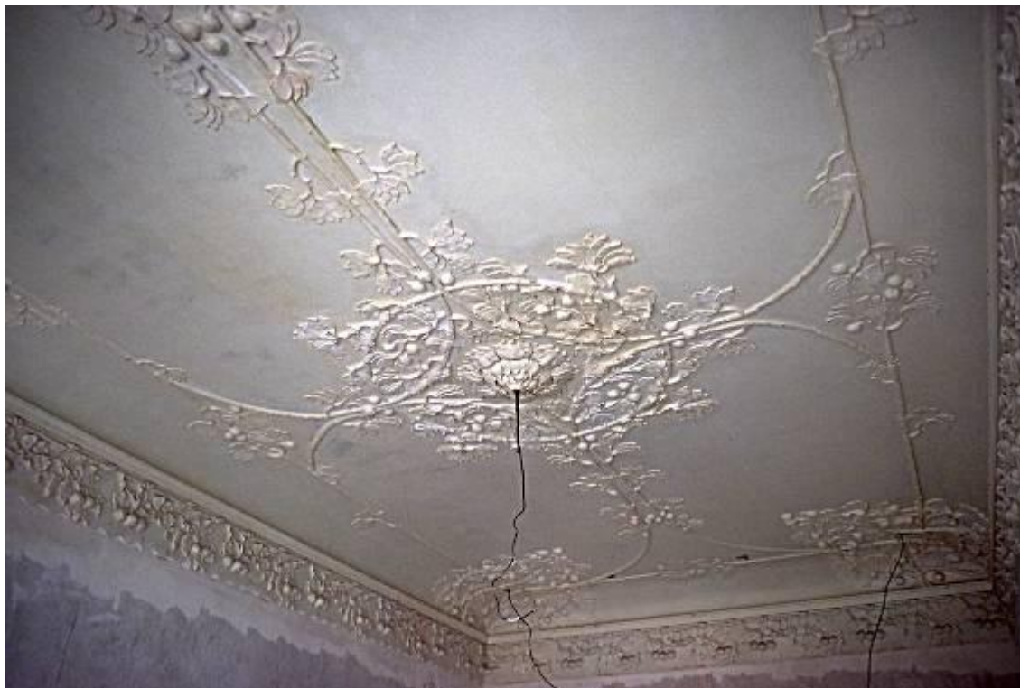
81. 2 этаж, кв. 12, пом.5, 12, 22. Комната объединена в результате демонтажа поздних перегородок и восстановления первоначальных габаритов помещений. Общий вид плафона..
