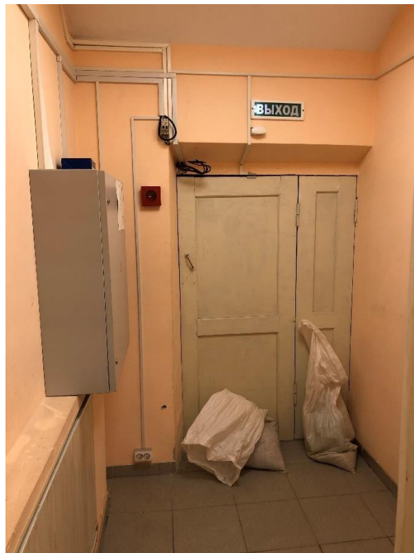
Фото 22. Неиспользуемая входная дверь.
